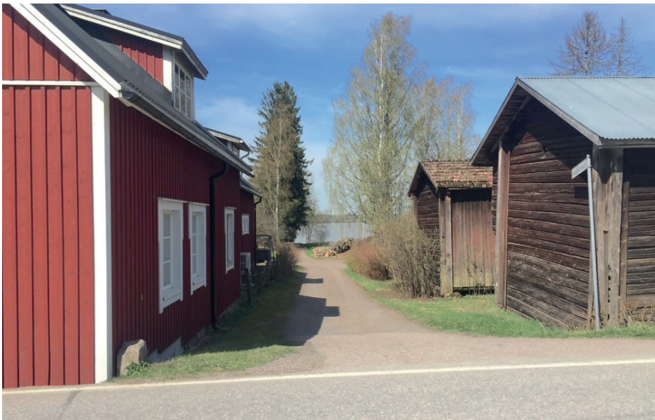
21. Saarelankuja Tuomalan kylässä Rantatien länsipuolella. Tien tasauksen nousun vuoksi vasemmanpuoleisen rakennuksen kivijalka on jäänyt kokonaan tien sisään. Myös oikeanpuoleinen aitta lahoaa tien pinnan nousun vuoksi. Samalla kujan liittyminen Rantatiehen on tullut jyrkäksi. Rakennukset estävät kujalta ajavia näkemästä Rantatien liikennettä, ja jyrkkä nousu Rantatielle lisää liittymän vaarallisuutta.
