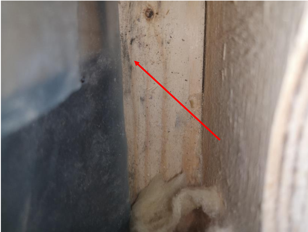
Kuva 10. Rakenneavaus luokkahuoneen 56 ulkovaipparakenteen alaosaan (JS2A). Höyrynsulkumuovin sisäpuoleisessa runkokuuussa havaittiin kasvustoa (mahdollisesti sinistäjäsieni).
