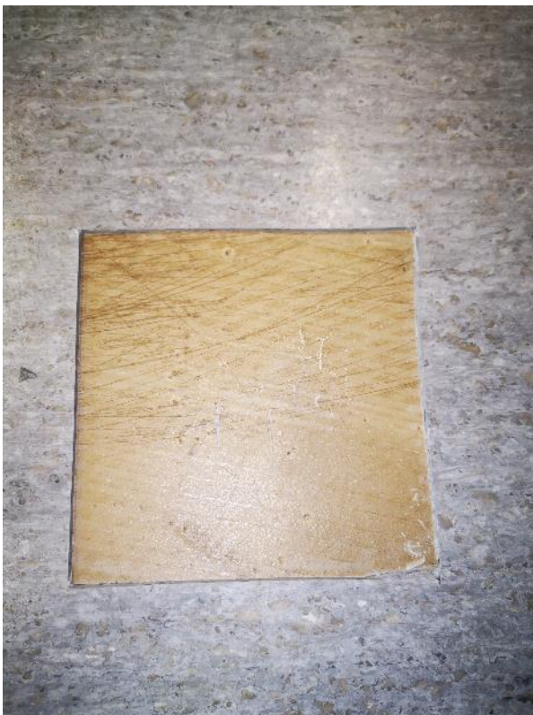
Kuva 22. Luokkahuoneen 58 lattian muovimaton kiinnitys alustaan oli hyvä ja liima oli hyvässä kunnossa. Liima tuoksui heikosti kemikaalimaiselle.
