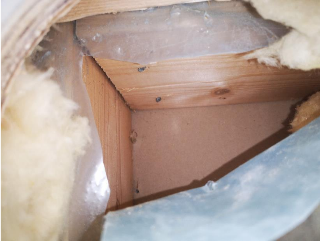
Kuva 12. Rakenneavaus luokkahuoneen 56 ulkovaipparakenteen alaosaan (JS2I). Höyrynsulkumuovin ulkopuolella ei havaittu vaurioita rakennusmateriaaleissa.
