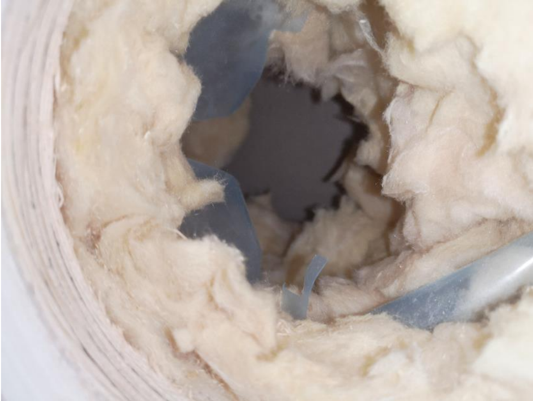
Kuva 6. Rakenneavaus luokkahuoneen 55 ulkovaipparakenteen yläosaan (JS1Y). Höyrynsulkumuovin ulkopuolella ei havaittu vaurioita rakennusmateriaaleissa.
