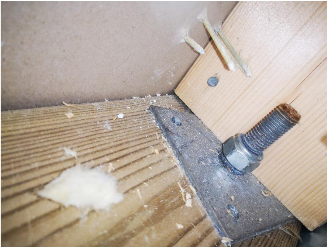
Kuva 13. Rakenneavaus luokkahuoneen 58 ulkovaipparakenteen alaosaan (JS1). Höyrynsulkumuovin ulkopuolella ei havaittu vaurioita rakennusmateriaaleissa.
