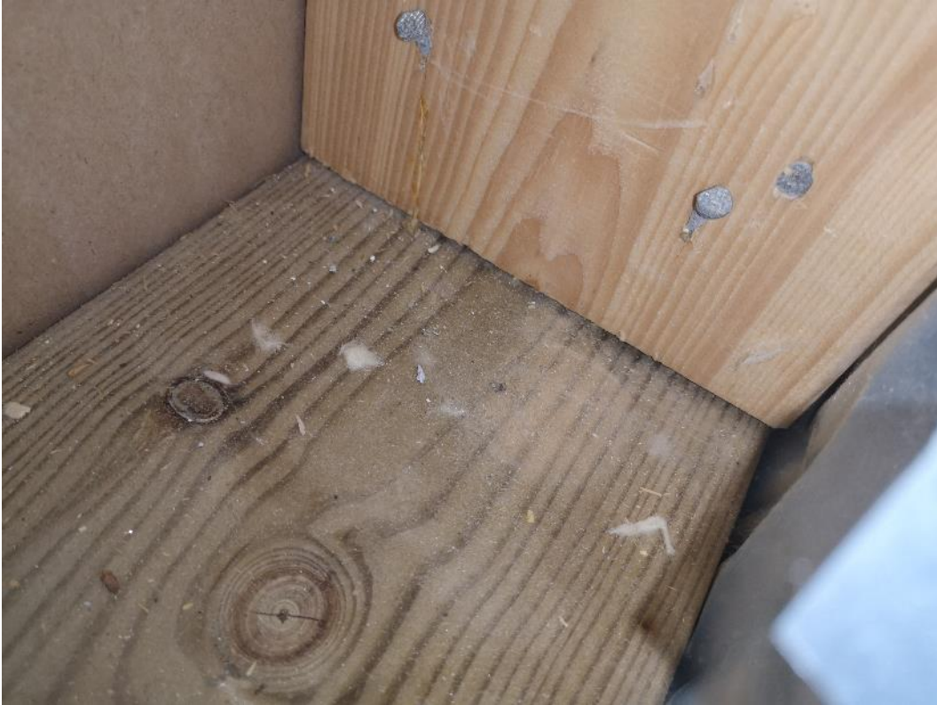
Kuva 2. Rakenneavaus luokkahuoneen 55 ulkovaipparakenteen alaosaan (JS1A). Puurungon alajuoksu on kyllästettyä puumateriaalia.
