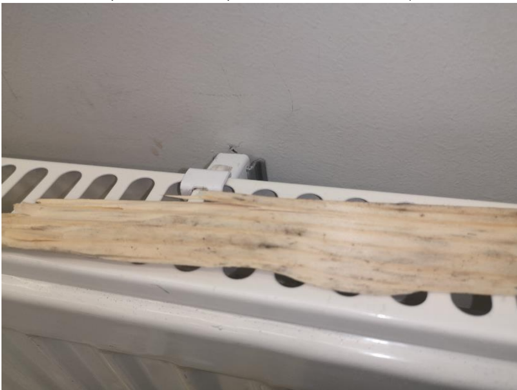
Kuva 11. Rakenneavaus luokkahuoneen 56 ulkovaipparakenteen alaosaan (JS2A). Höyrynsulkumuovin sisäpuoleisessa runkokuuussa havaittiin kasvustoa (mahdollisesti sinistäjäsieni).
