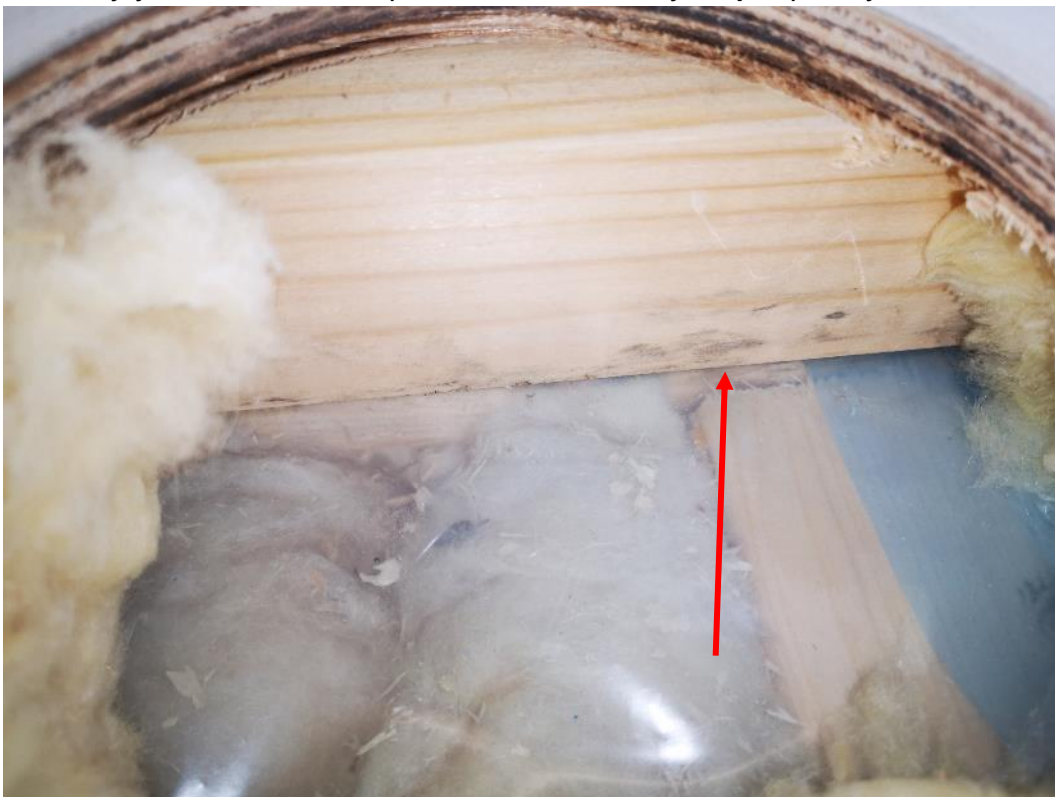
Kuva 15. Rakenneavaus luokkahuoneen 58 ulkovaipparakenteeseen (JS2) ikkunan alapuolelta. Höyrynsulkumuovin sisäpuoleisessa runkokuussa havaittiin kasvustoa (mahdollisesti sinistäjäsieni).
