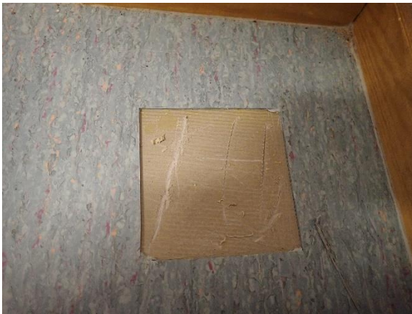
Kuva 7: Vesileikkihuoneen muovimaton näytteessä ei esiintynyt viitettä vauriosta.
