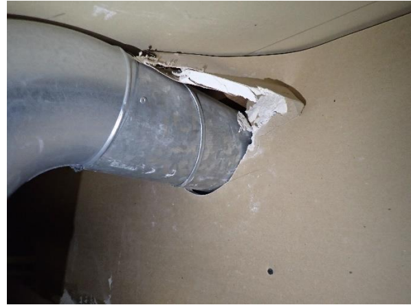
Kuva 5: Alakattotilassa oli tiivistämättömiä läpivientejä.
