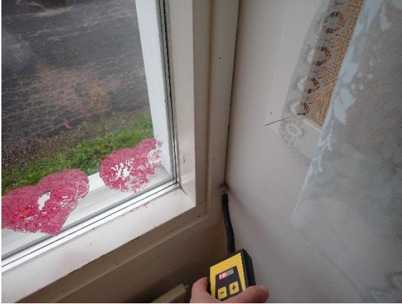
Kuva 11: Kissankulman lepohuone, ikkuna- ja seinärakenteiden liitoskohdilla ilmavuotoa.
