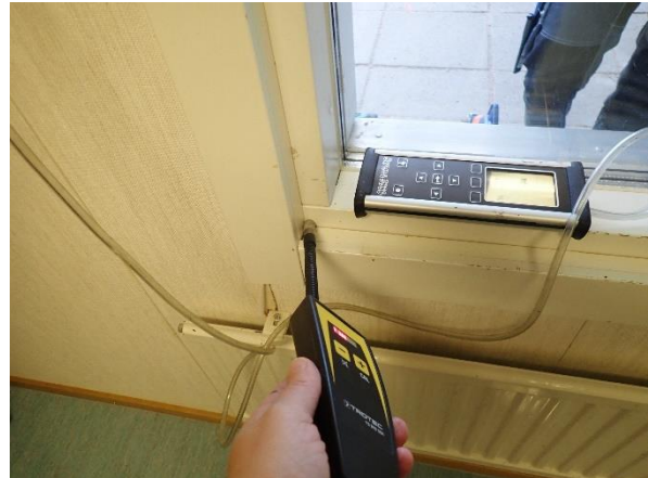
Kuva 14: Vesileikkihuone, ilmavuotoa ikkunaliittymistä.
