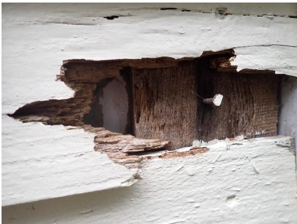
Kuva 2: Lautaverhous oli paikoittain lahonnut lautojen päistä.
