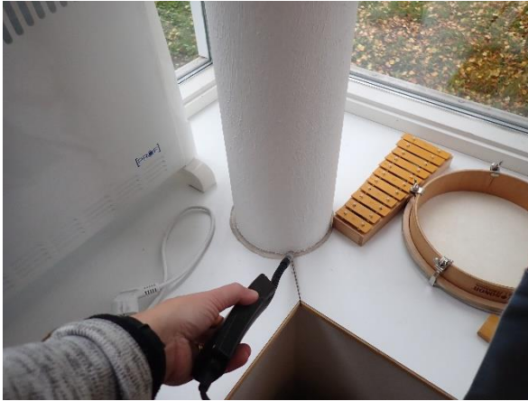
Kuva 17: Salin ulkoseinä- ja pilariliittymästä havaittiin ilmavuotoa.
