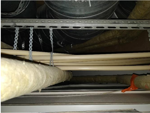
Kuva 4: Alakattotilassa oli paljasta putkieristettä.
