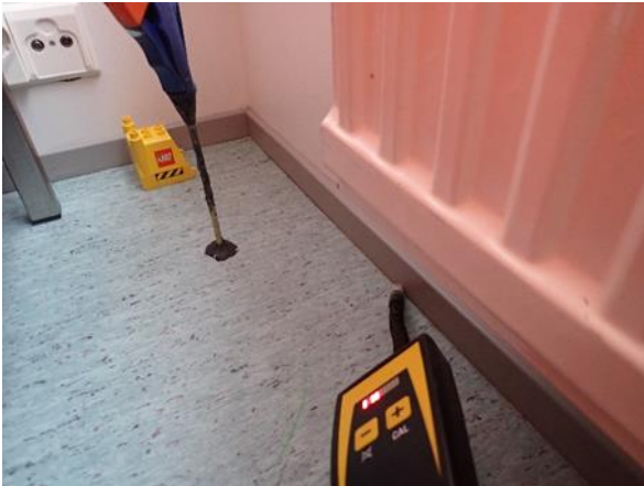
Kuva 13: Kissankulman ryhmähuone, ilmavuotoa havaittiin lattia- ja seinäliittymistä, sekä ikkuna- ja seinäliittymistä.
