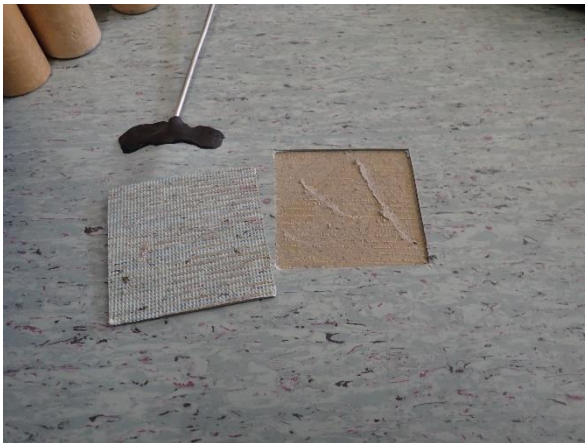
Kuva 10: Vaahteramäen lepohuoneen muovimatossa ei havaittu epätavallista hajua.
