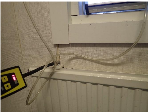
Kuva 15: Vesileikkihuone, ilmavuotoa patterin kannakkeiden ja seinän liittymästä.
