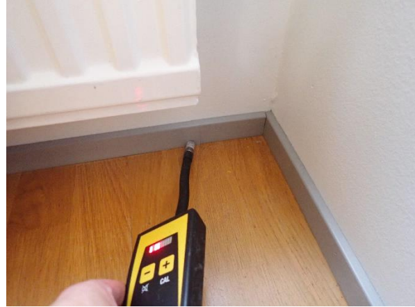
Kuva 12: Kissankulman lepohuone, ilmavuotoa ulkoseinä- ja lattialiittymästä.
