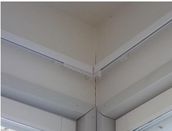
Kuva 6: Seinän ja katon liitoskohdissa, sekä seinien kulmissa on halkeamia.
