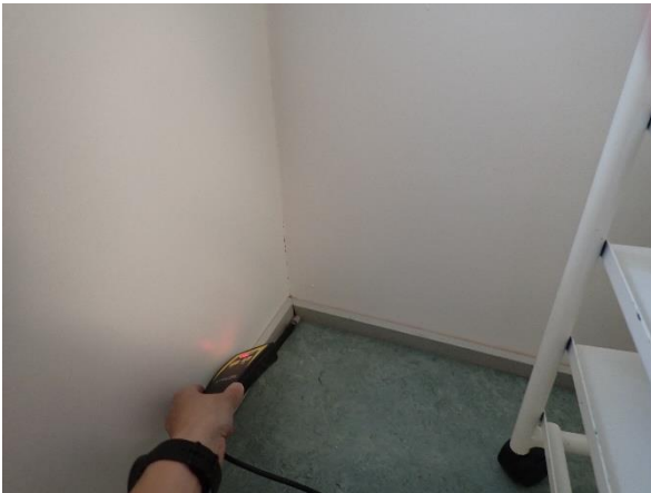
Kuva 13: Alapohjan ja ulkoseinän liittymissä havaittiin ilmavuotoa.
