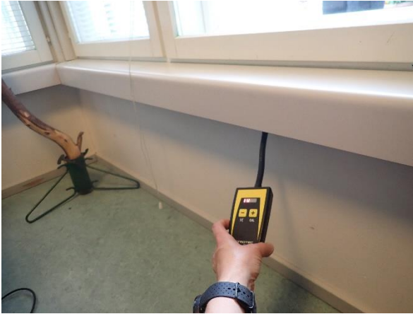
Kuva 11: Tutkittava tila 119, ikkunan ja ulkoseinän liitoskohdissa ilmavuotoa.
