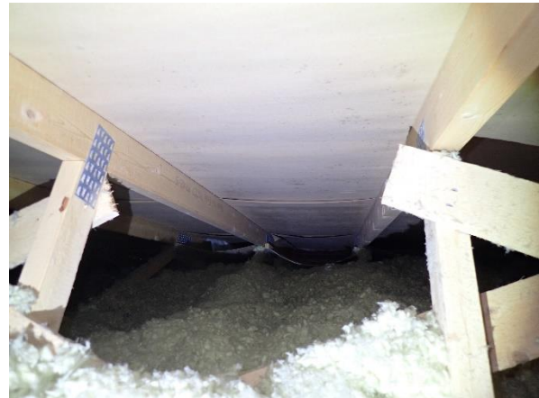
Kuva 20: Aluskatteessa oli paikoin havaittavissa mikrobivaurioita matalalla osalla.
