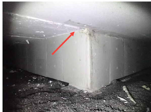
Kuva 16: Alapohja- ja seinäliittymästä ei havaittu ilmavuotoja, kun merkkiainetta laskettiin eristetilaan.
