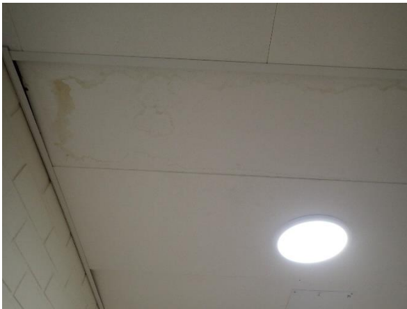
Kuva 2: Käytävän (103 ja 110 risteyskohta) kaikkia kosteusvaurioituneita akustolevyjä ei ole vaihdettu.
