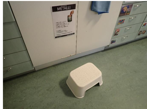
Kuva 3: Ryhmähuoneen 120 allaskaapin kosteusjäljet.
