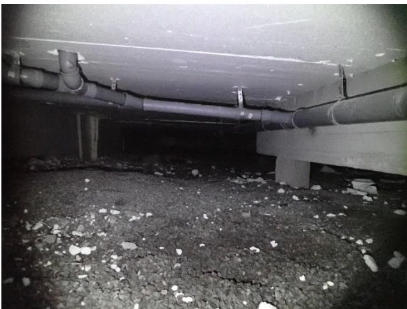
Kuva 15: Alapohjan merkkiainetutkimuksessa todettiin viemäriämpiviennit tiiviiksi.
