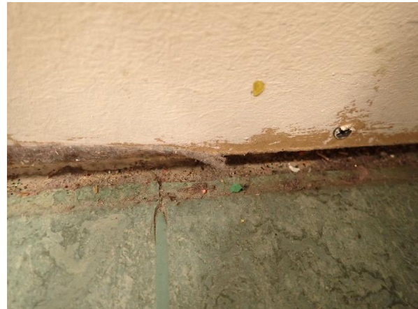
Kuva 14: Ulkoseinä- ja alapohjarakenteen liittymää ei ole tiivistetty (jalkalistaa raotettiin).
