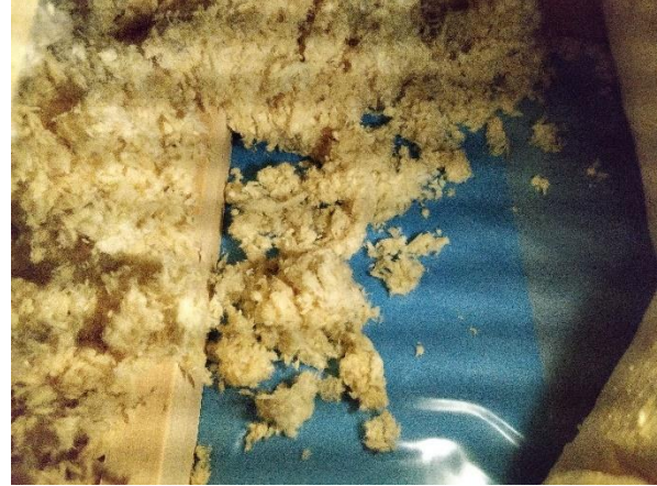
Kuva 18: Yläpohjarakenteessa on hyvin limitetty höyrynsulku.
