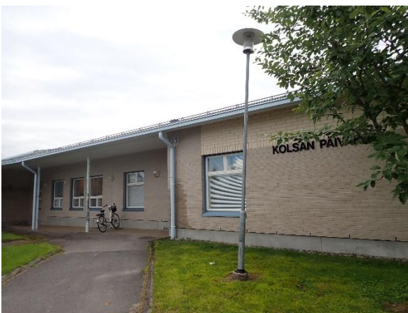
Kuva 8: Henkilökunnan sisäänkäynnin kohdalla sadevesi syöksytorvi valuttaa vettä ulkoseinään.
