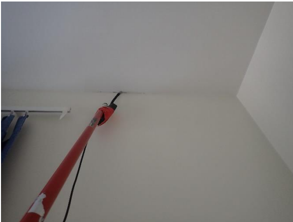
Kuva 19: Yläpohjan ja ulkoseinän liittymissä havaittiin ilmapuotoa.
