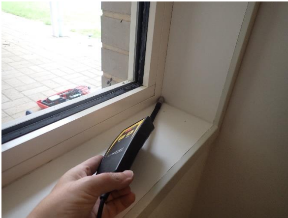
Kuva 9: Tutkittava tila 109, ikkunapenkin liitoskohdilla ilmapuotoa.
