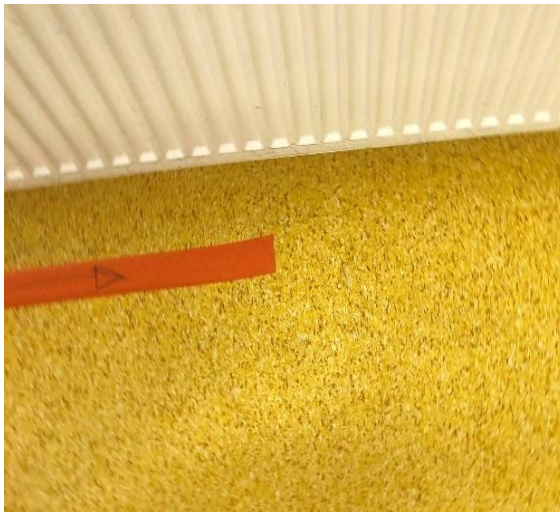
Kuva 26 Merkittävä ilmavuoto alapohjan ja ulkoseinän liittymässä.
