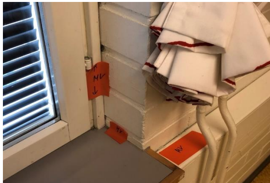
Kuva 19 Vähäisiä ilmavuotoja ikkunakarmin ja ulkoseinän liittymästä. Vähäisiä ilmavuotoja havaittiin myös sähkökotelon ja ulkoseinän rajalta
