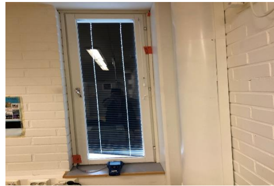
Kuva 20 Pistemäisiä ilmavuotoja ikkunakarmin ja ulkoseinän liittymässä
