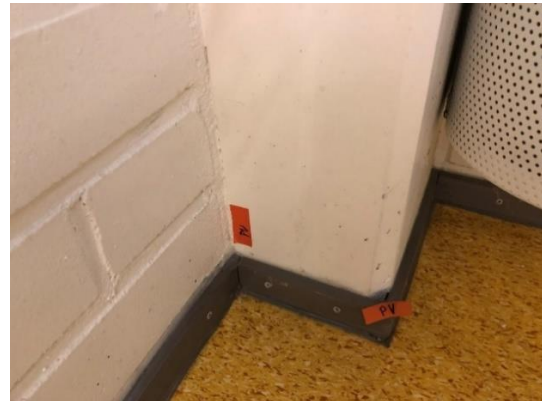
Kuva 4 Pistemäisiä ilmavuotoja havaittiin pienellä alueella nurkassa lattia- ja seinäliittymästä sekä lattia- ja pilariliittymästä.
