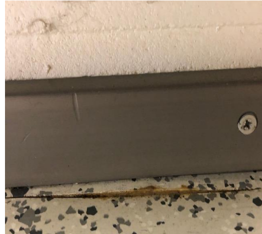
Kuva 16 Ilmavuodon kohdalla matossa halkeama
