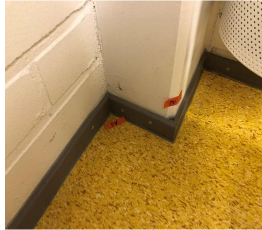
Kuva 22 Alapohjan ja ulkoseinän liittymästä, sekä lattia- ja pilariliittymästä havaittiin vähäistä ilmavuotoa.
