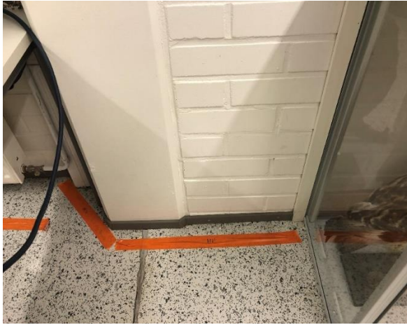
Kuva 15 Alapohjan ja pilarin rajapinnoilla sekä alapohjan -ja ulkoseinän liittymässä havaittiin merkittäviä ilmavuotoja
