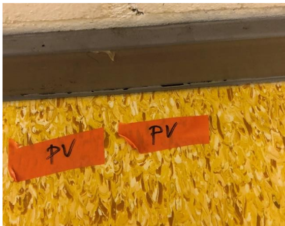
Kuva 23 Pistemäisiä ilmavuotoja lattialistan halkeamassa
