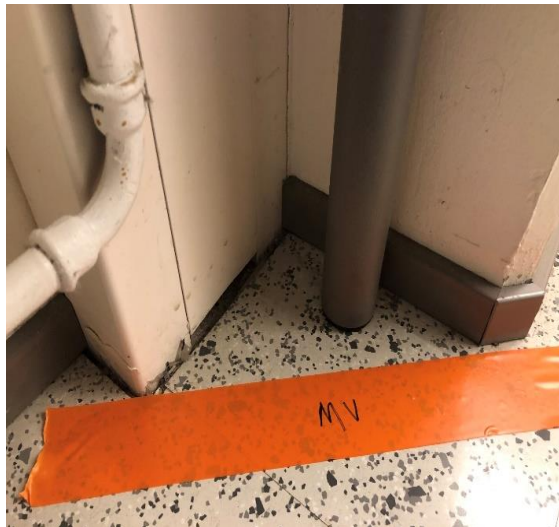
Kuva 13 Merkittävä ilmapuoto lattia- pilariliittymästä
