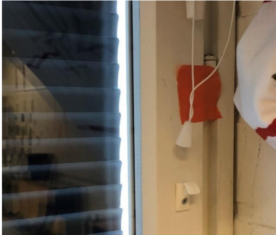
Kuva 21 Pistemäinen ilmavuoto ikkunasaranasta
