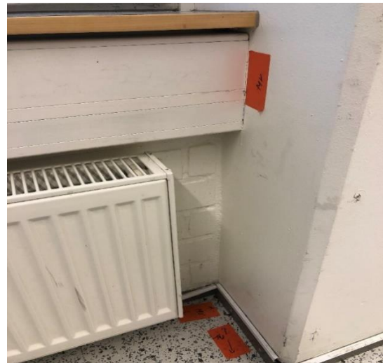
Kuva 14 Sähkökotelon ja pilarin liitoksessa havaittiin vähäisiä vuotoja. Pistemäisiä vuotoja todettiin lattia- ja pilarin liittymässä- sekä lattia- ja ulkoseinän liittymästä.
