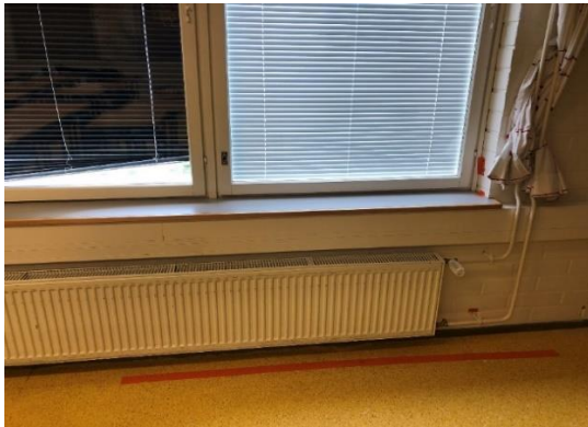
Kuva 3 Merkittävä ilmavuoto alapohjan ja ulkoseinän liittymästä
