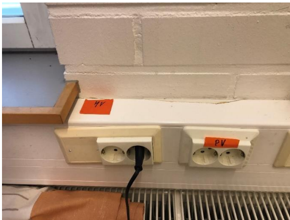
Kuva 17 Pistemäinen ilmavuoto pistorasiasta ja ulkoseinän ja sähkökotelon rajapinnalta
