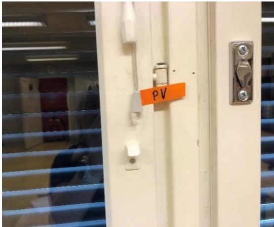
Kuva 11 Pistemäinen ilmavuoto ikkunasaranasta
