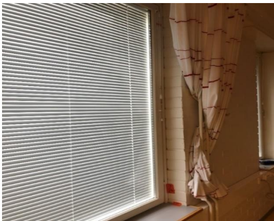
Kuva 5 Vähäisiä ilmavuotoja ikkuna- ja ulkoseinäliittymien nurkkakohdassa oikealla sekä ikkunalaudan ja ulkoseinän liittymästä.
