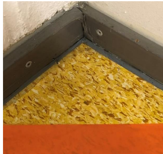
Kuva 27 Merkittävä ilmavuoto ulkoseinän ja alapohjan liittymässä lähellä huoneen oikeaa nurkkaa.
