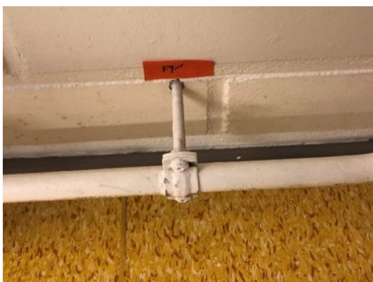
Kuva 7 Pistemäinen vuoto patteriputken kannakkeesta
