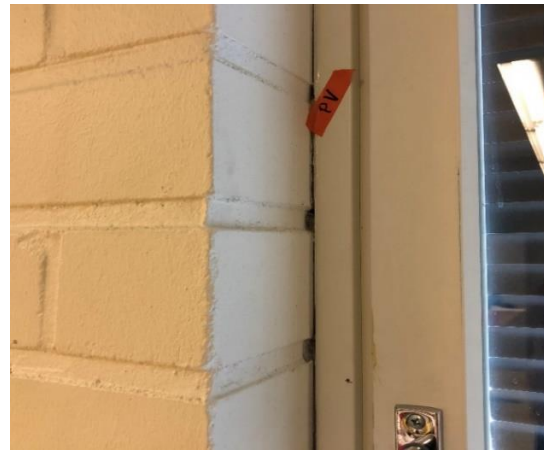
Kuva 31 Pistemäinen ilmavuoto ikkuna- ja ulkoseinäliitoksessa
