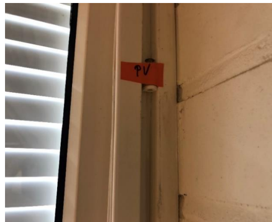
Kuva 6 Pistemäinen vuoto ikkunasaranan kohdalta
