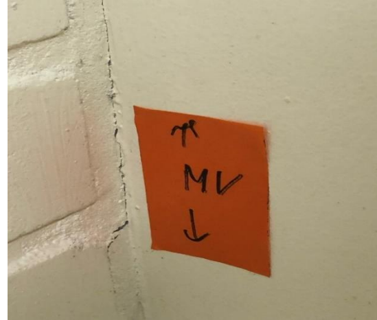
Kuva 10 Merkittävä ilmavuoto ulkoseinän ja pilarin välisessä halkemassa
