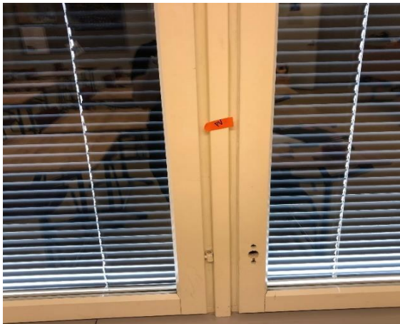
Kuva 30 Pistemäinen ilmavuoto ikkunaliittymässä
