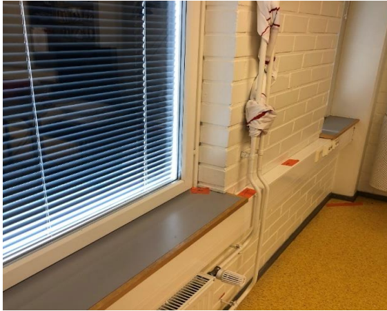
Kuva 28 Vähäinen ilmavuoto ulkoseinän ja sähkökotelon rajapinnalta sekä ikkunakarmien ja ulkoseinän liittymästä
