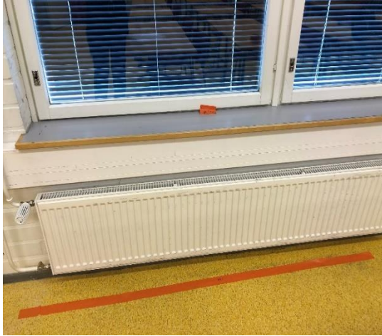
Kuva 9 Merkittävä ilmavuoto alapohjan ja ulkoseinän liittymässä ja pistemäinen ilmavuoto ikkunakarmissa
