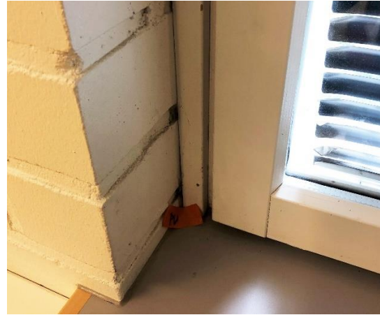
Kuva 29 Vähäinen ilmavuoto ikkuna- ja ulkoseinäliittymässä.
