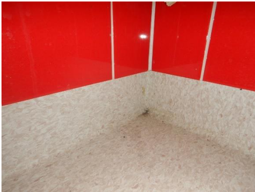
Kuva 7. Lattiamatot on nostettu ylös seinille märkäeteisissä.
