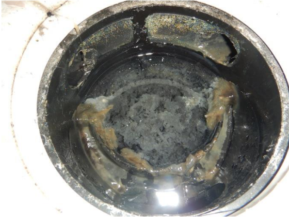
Kuva 6. Puhdistamaton lattiakaivo WC-tilassa B162. Kaivossa havaittiin voimakas haju.
