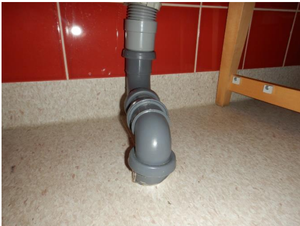
Kuva 4. Lattiamaton tiiveys viemärin läpiviennin kohdalla on arviolta puutteellinen. Kuva on märkäeteisestä B160.
