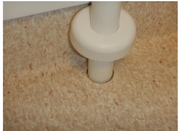
Kuva 5. Tiivistämättömän näköinen läpivienti WC-tilassa B158.
