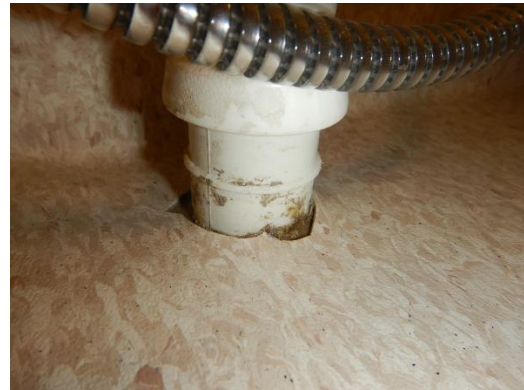
Kuva 8. Viemäriputken läpivienti on epätiivis WC-tilassa B162
