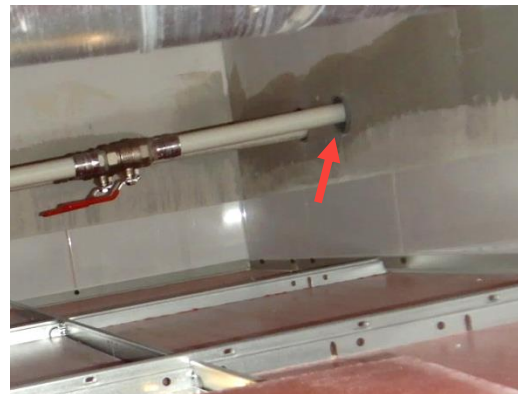
Kuva 10. Tiivistämättömiä läpivientejä WC-tilan alakaton sisällä. Kyseessä vain väliseinä. Kuva on tilasta B158.
