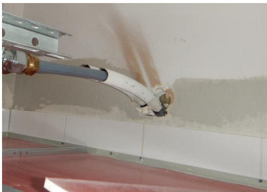
Kuva 11. tiivistämättömiä läpivientejä väliseinässä alakattotilan sisällä. Kuva on WC-tilasta B162
