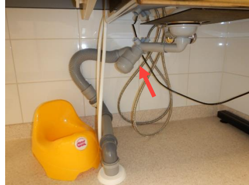
Kuva 13. Hajulukko on kääntynyt WC-tilassa B162
