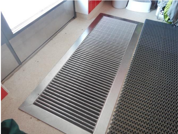
Kuva 2. Märkäeteisen B161 hiekkanerotuskaivo ja ulko-oven edusta. Lattiamaton päällä on osittain kumiritiliä.
