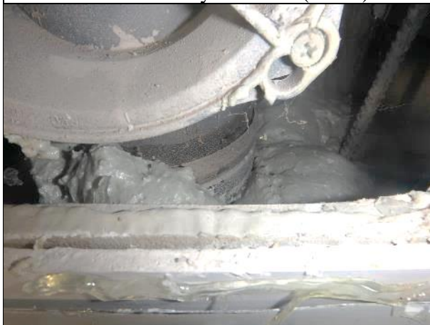
B-osan pohjakerroksen WC-tila. Viemäriputkien läpiviennit alapohjassa ovat valettu betonilla ja jotkut uretaanilla (kuvassa).
