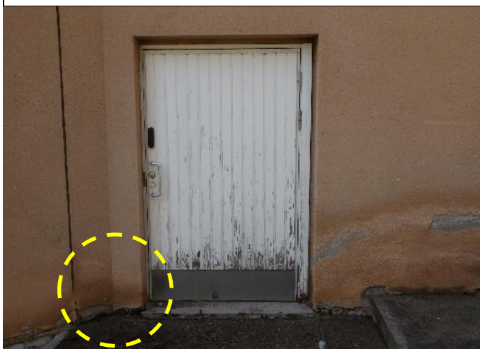
R5 sijainti ulkoa päin kuvattuna. Seinän alaosa on märkä.
