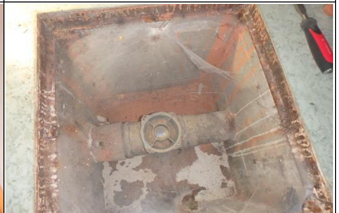
Tarkastusluukku on hyvin likainen sisältä, sen kannet ovat ruosteessa ja silmämääräisesti luukku on epätiivis.
