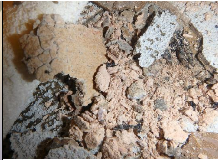
Aistinvaraisesti lattiapinnoite on kosteus- ja mikrobivaurioitunut. Kuvassa muovimaton tasoitteen alla olevaa asbestimassaa.
