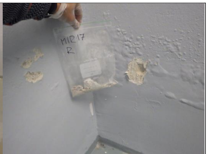
R36. Ulkoseinän pintamateriaaleista otettiin mikrobinäyte MIR18.
