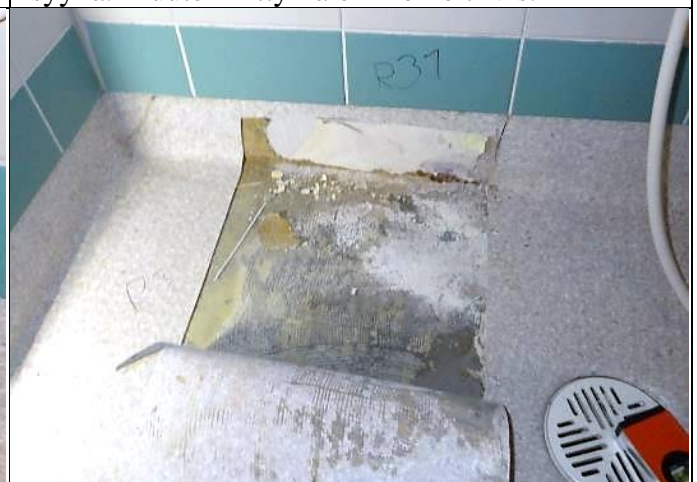
Rakennevauksessa havaittiin vanha kosteusvaurio. Homeen hajua ei havaittu, mutta tämä kohta vaatii korjausta.
