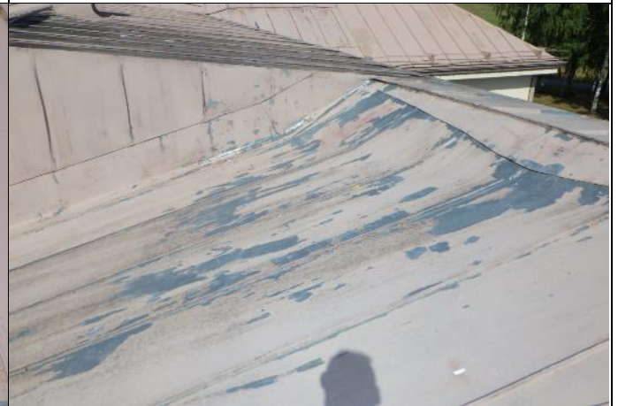
Pääsisäänkäynnin lähellä on vesikatteen pinnoitetta irronnut laajalti.
