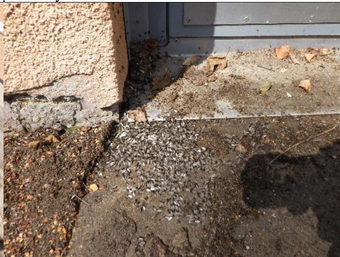
Aistinvaraisesti tämä nurkka on myös ulkoa kostea. Lentomuurahaisilla oli maton alla pesä.
