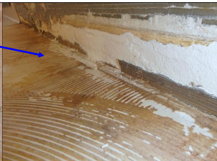
Aistinvaraisesti lattian muovimatto on kosteus- ja mikrobivaurioitunut kantavan seinän vieressä, rakenneselementissä havaittiin lievä homeen haju.
