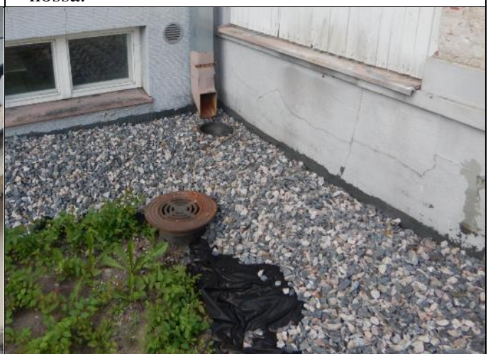
Sisäänkäynnin sokkelissa on halkeama.
