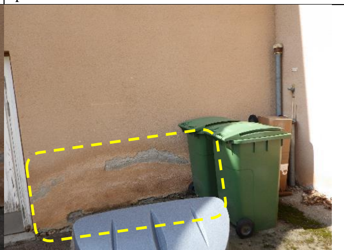
R4 sijainti ulkoa päin kuvattuna. Seinän alaosa on märkä ja rappaus irtoilee.
