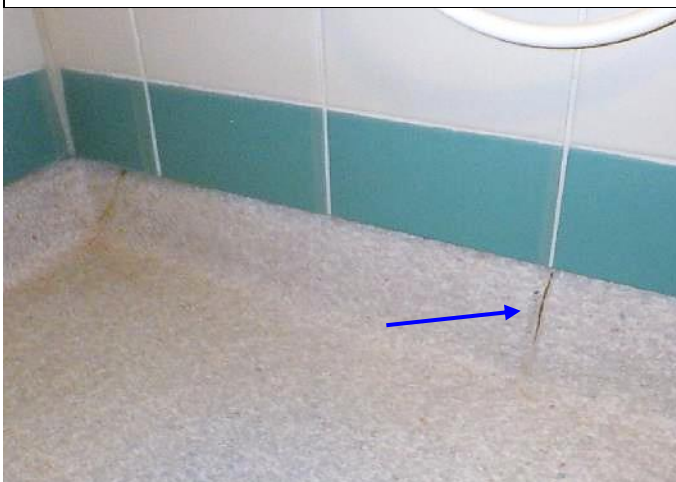
R31 tehtiin pesuhuoneen lattiaan, missä muovimatto oli irti alustasta. Kuvassa näkyy muovimatossa oleva halkeama.
