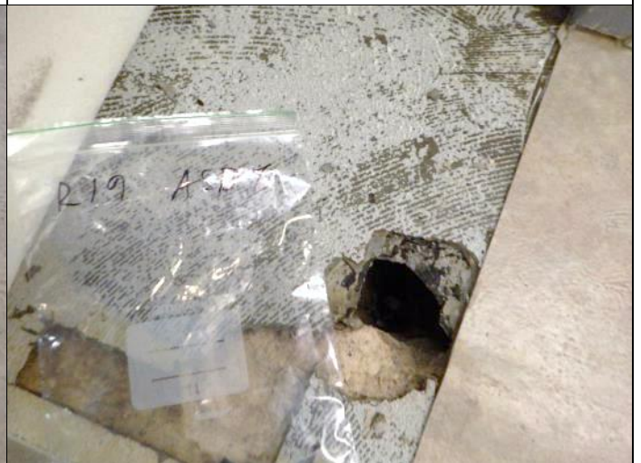
Vanhasta tasoitteesta otettiin myös asbestinäyte ASB 1.
