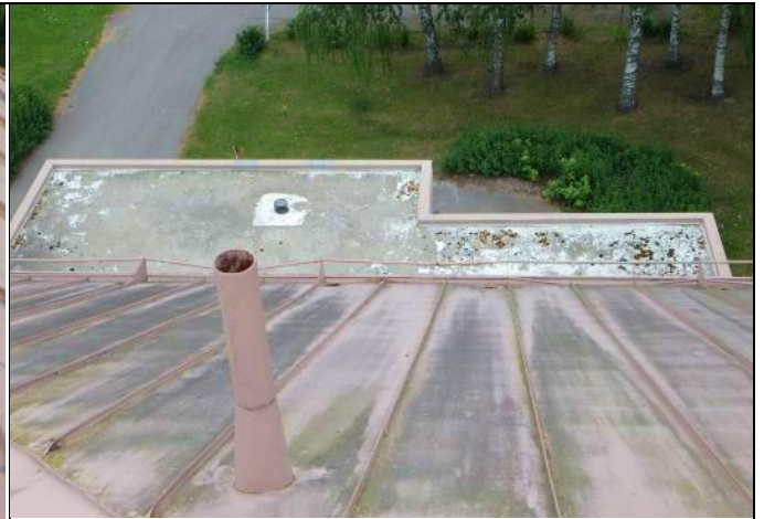
Pohjoispään peltikate on likainen ja maali irronnut laajalti.
