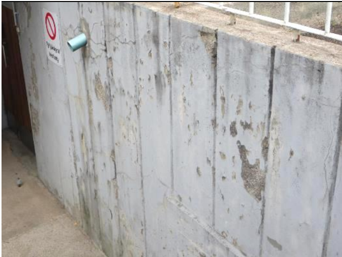
Kuvassa luiskan tukimuuri. Pinnote on irti monissa paikoissa kosteuden vaikutuksesta.
