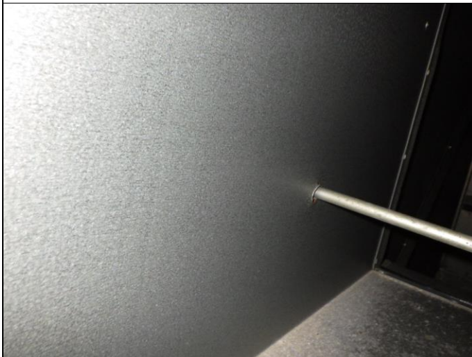
TK1/TF1 Myös lämpömittarin läpivienti on paljaana.
