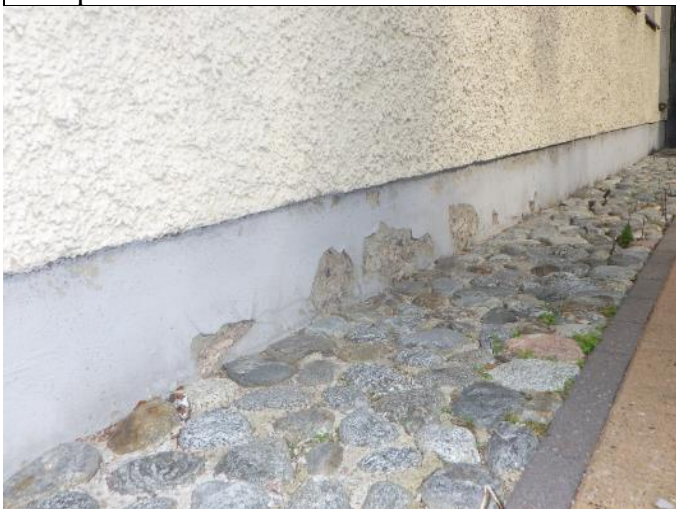
Kuvassa D-osan sisäpihan julkisivu (länsisivu). Sokkelin pinnote irtoilee alustastaan.
