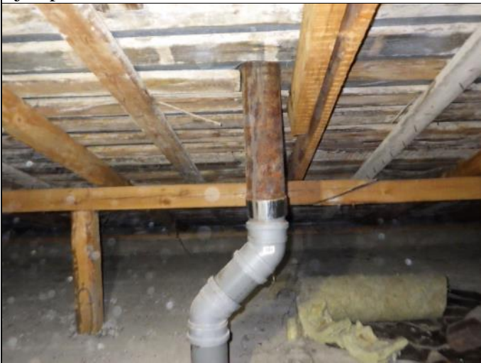
Osa viemäreiden tuuletusputkia on ilman lämmöneristettä.
