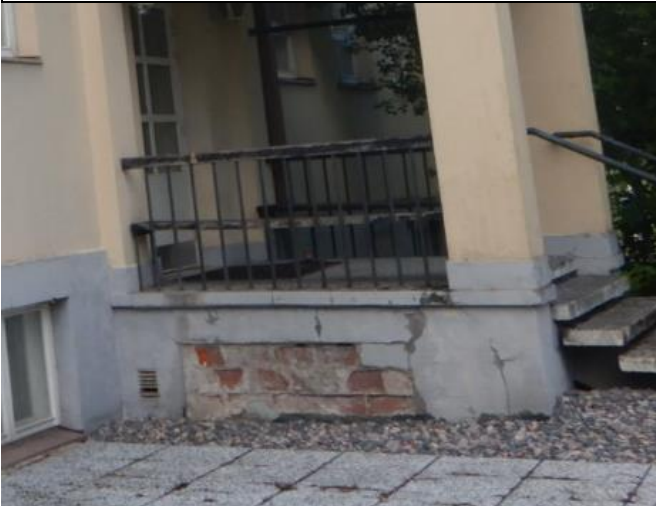
Oikeanpuoleisen sisäänkäynnin alaosien rappaukset ovat huonossa kunnossa.
