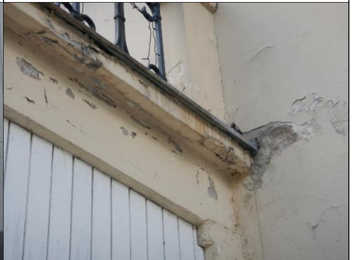
Katoksen ja parvekkeen liittymäkohtien pinnat varsinaiseen julkisivuun ovat huonossa kunnossa.
