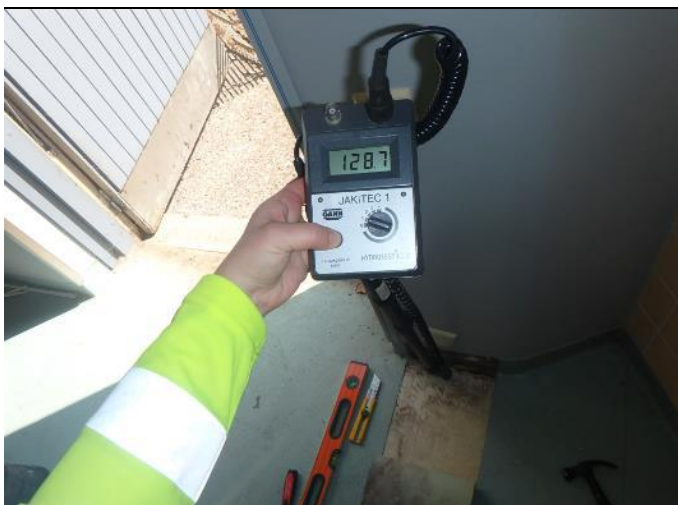
Muovimaton alta tarkasteltiin pintakosteutta ta-soitteen päältä: 129, kohonnut lukema.
