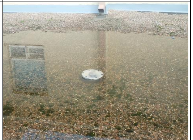
Syynä oli tämä tukossa oleva kattokaivo. Kaivo avattiin, puhdistettiin ja vesi lähti pois.
