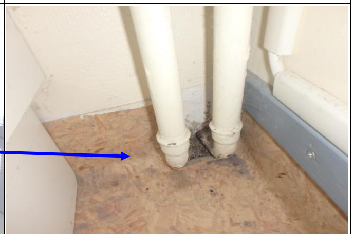
Putkien läpiviennit seinässä ovat silmämääräisesti epätiivisiä.
