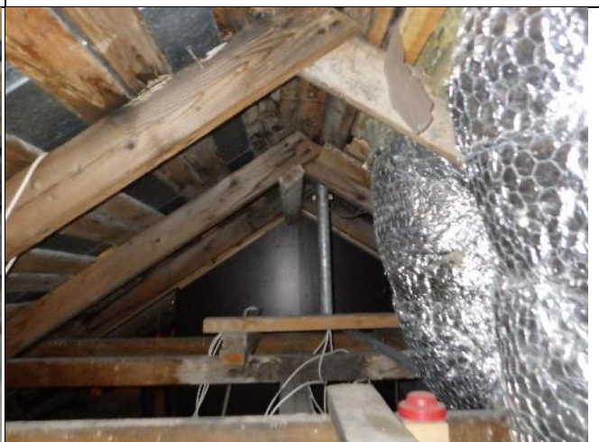
Aino selvä vanha vuotojälki on harjalla IV-konehuoneen päässä, portaikon lähellä. Paikassa on antenniputken läpivienti vesikatossa.
