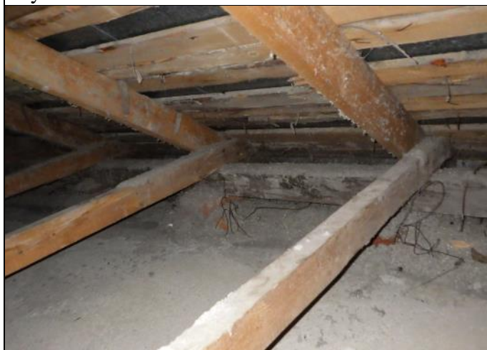
Vanhoja vuotojälkiä (kondenssi?) näkyy paikoin kattokannattajissa ja kattotuoleissa. Havaintojen mukaan rakenteet ovat kuitenkin kovia.
