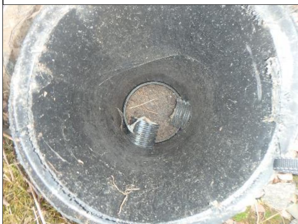
Kuvassa on terassin kulman kohdalla oleva salaojituksen tarkastuskaivo, joka on kuiva. Järven veden pinta on monta metriä alempana kuin tämän kavion pohja.
