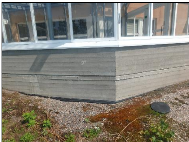
Kuvassa on vuonna 2005 B-osan ulkosivulle rakennettu terassi. Tämän uuden terassin perusmuurissa on havaittavissa patolevy.
