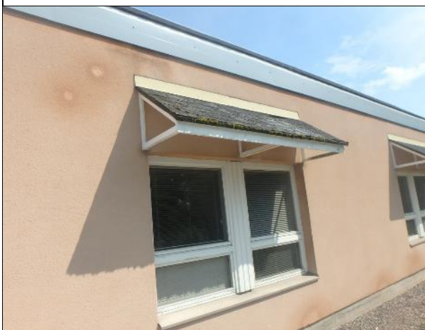
Muutaman ikkunan katoksesta havaittiin sammalta. Katoksen lappeen puurakenne on lahovaurioitunut.
