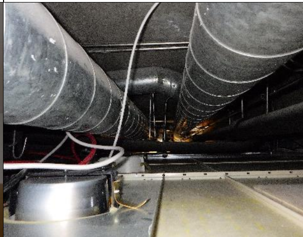
Tuloilmanvaihdon kanavistossa ei myöskään ole mineraalikulitulahdettä. Kanavissa ei ole äänenvaimentimia, joissa mineraalikulitulahdettä voisi olla.
