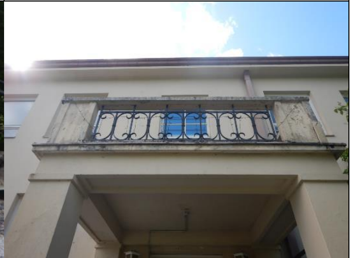
Yläosastaan rappaukset ovat melko hyvässä kunnossa, maali tosin hilseilee.
