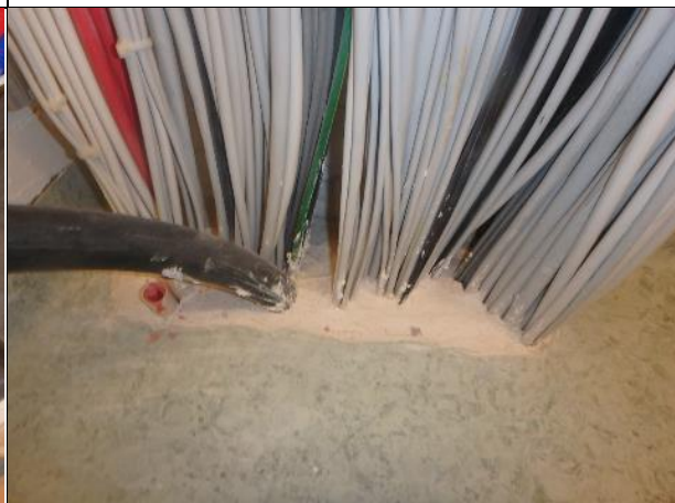
Sähkökeskuksessa sähköjohtojen läpiviennit lattiassa on myös tiivistetty massalla (A-osa).
