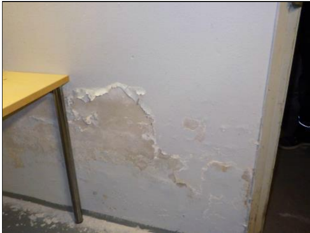
Myös seinien alaosissa on paikoin havaittavissa hilseilyä.
