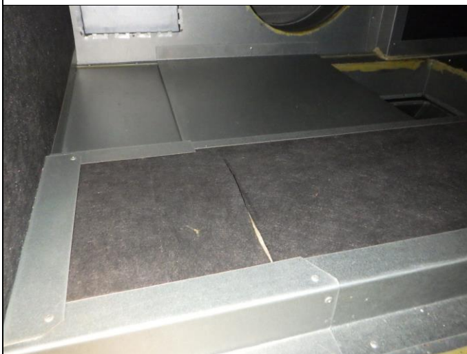
TK3/TF3 Koneen puhallin kammiosta seuraavassa kammiossa on lasivillainen äänieristemateriaali.
