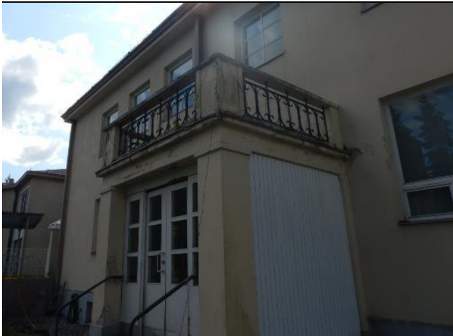
Oikeanpuoleinen sisäänkäynnin julkisivu on huonommassa kunnossa.
