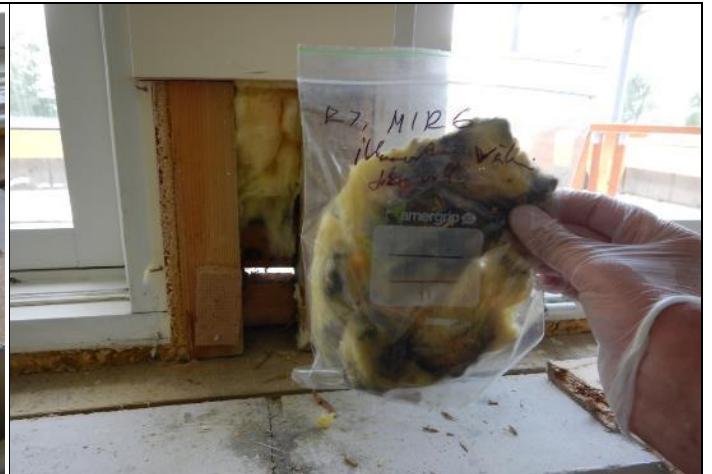
Ikkunavälin lämmöneriste oli tummentunut ilma-vootojen vaikutuksesta. Mineraalivillasta otettiin mikrobinäyte MIR6.
