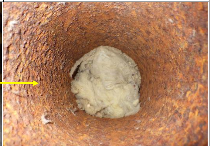
Vanha tukittu tuuletusputki. Ok.
