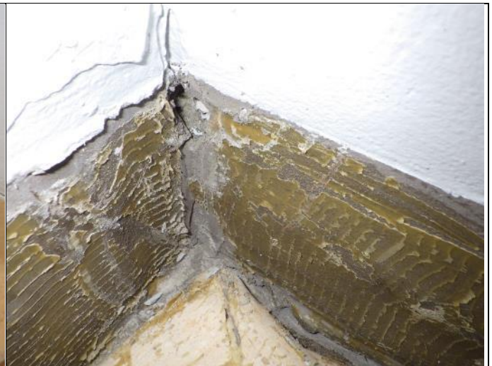
Aistinvaraisesti väliseinien välisestä liittymästä havaittiin rako.
