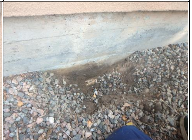
B-osan ulkosivun vierustalle tehtiin muutama kaivanto. Perumuurissa ei havaittu vedeneristystä. Kaivannosta havaittiin myös 50 mm styrox-eristettä pystyssä perusmuurissa.
