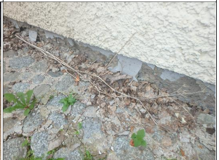
Kuvassa D-osan sisäpihan julkisivu (länsisivu). Sokkelin pinnote on irti alustastaan.
