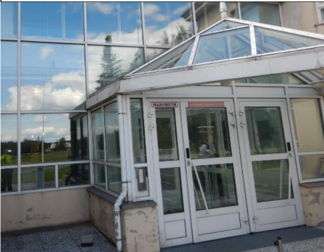
Nykyisen pääsisäänkäynnin betonirakenteisten alaosien maali irtoilee.
