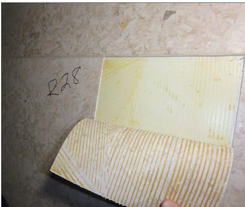
Vertailuavaus R28 tehtiin salin lattiaan kuivaan paikkaan. Täällä on kaikki kunnossa. Rakenneavauksen sijainti on esitetty paikannuspiirustuksessa 7.
