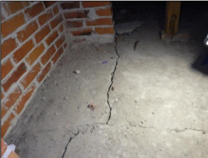
Tarkastelussa havaittiin isohko halkeama yläpohjan pinta betonilaatassa.
