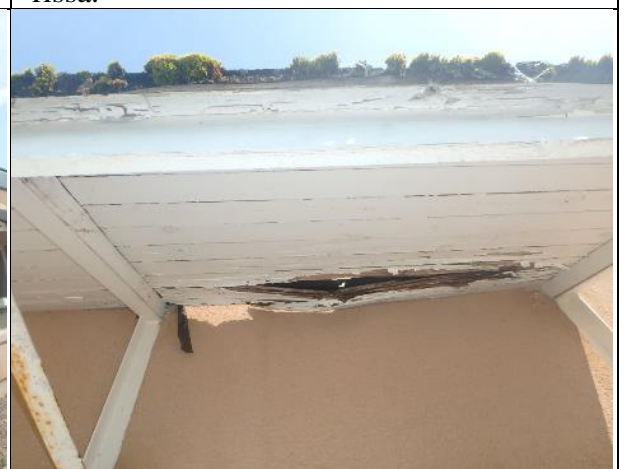
Muutaman ikkunan katoksesta havaittiin sammalta. Katoksen lappeen puurakenne on lahovaurioitunut.
