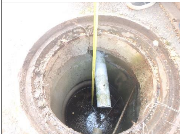
Kuvassa on salaojajärjestelmän tarkastuskaivo A-osan sisäpihalla. Veden pinnalta pihakivituksen pintaan on noin 1,45 metriä. Tähän kaivoon on vedetty myös sadevesiputki (näkyvä kuvassa).
