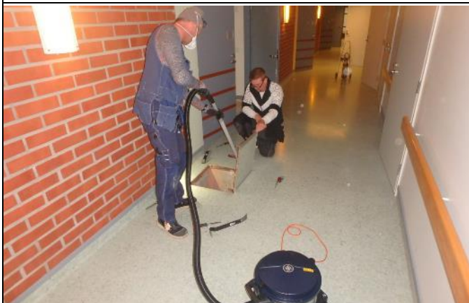
Tutkimuksissa tarkastettiin kaikki homekoiraraportissa mainitut koiran merkinnät, mm B-osan pohjakerroksen viemärituuletusputken tarkastusluukku käytävässä.
