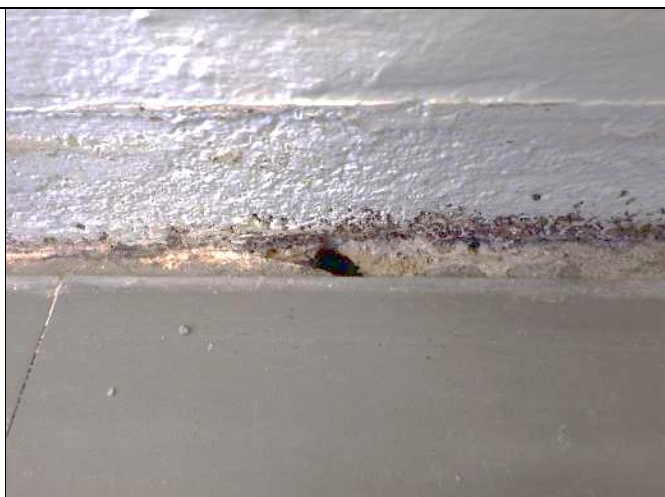
Rakenneseävauksen R23 vieressä tarkasteltiin väliseinä-alapohjaliittymä poistamalla jalkalista. Liittymä ei ole tiivis, siinä näkyy rako.
