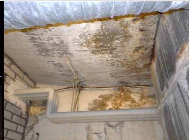
Kuvassa kellarikerroksen pienempi varasto-tila. Seinissä ja katossa on havaittavissa kosteusjälkiä.
