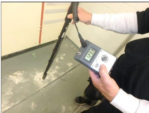
Kuvassa on kellarikerroksessa sijaitseva sähköpääkeskus. Pintakosteuskartoituksessa lattiasta kauttaaltaan havaittiin koholla olevaan kosteuteen viittaavia lukemia.
