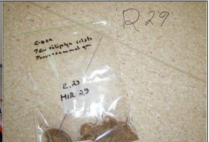
Välipohjan eristeenä on luonnonmateriaali (sammal, turve ym.). Materiaalista otettiin mikrobi-näyte MIR29.
