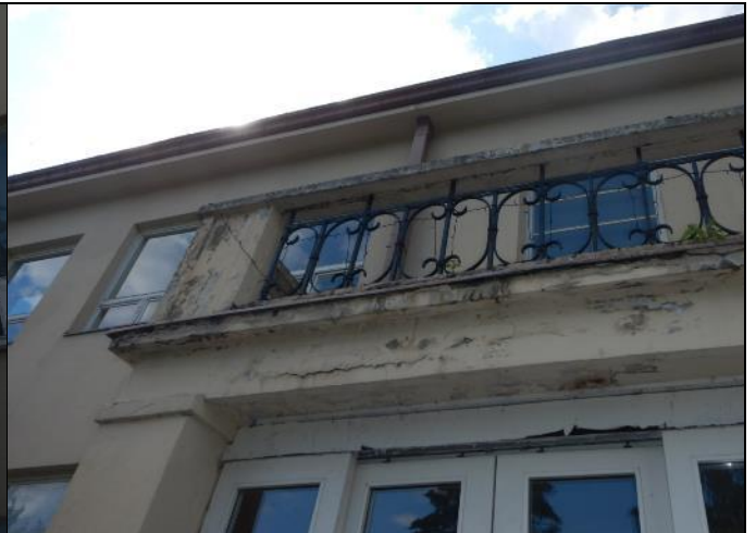
Otsan betonirakenne on rapautunut.
