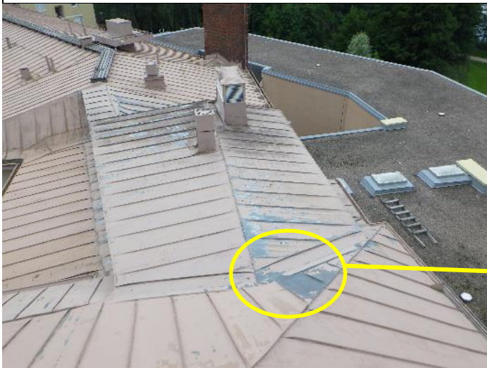
Keskiosalla vesikatteen maali on myös laajalti irronnut.
