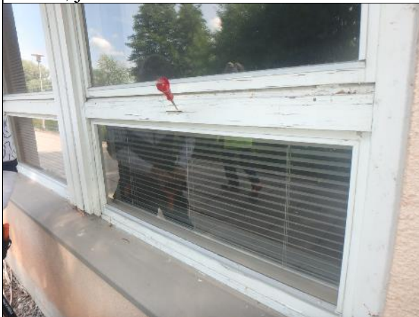
Järvenpuoleisen julkisivun ikkunat ovat myös hyväkuntoisia, tosin huoltomaalausta vaille.
