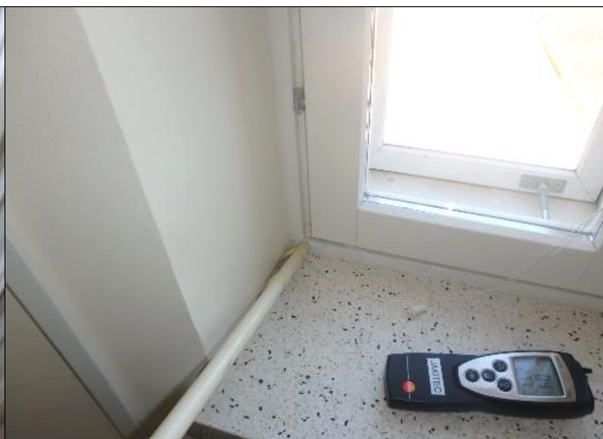
MA25. 2 min päästä ikkunaliittymistä havaittiin merkittäviä ilmavuotoja.
