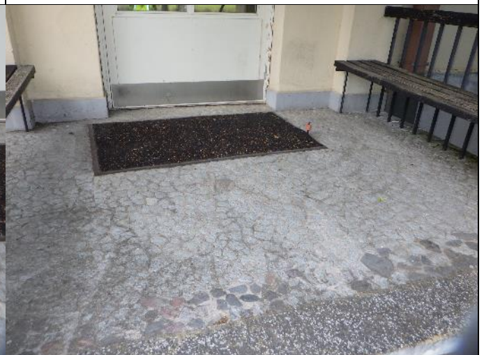
Lattiapinnan kivetys on hyvässä kunnossa.
