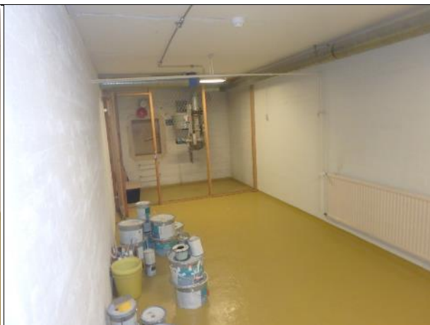
Väestönsuojan tiloissa lattia- ja seinäpinnoitteet ovat melko hyvässä kunnossa, paitsi että lattiapinnoitteessa (maali) on paikoin hilseilyä. Tiloissa on kellarimainen haju.
