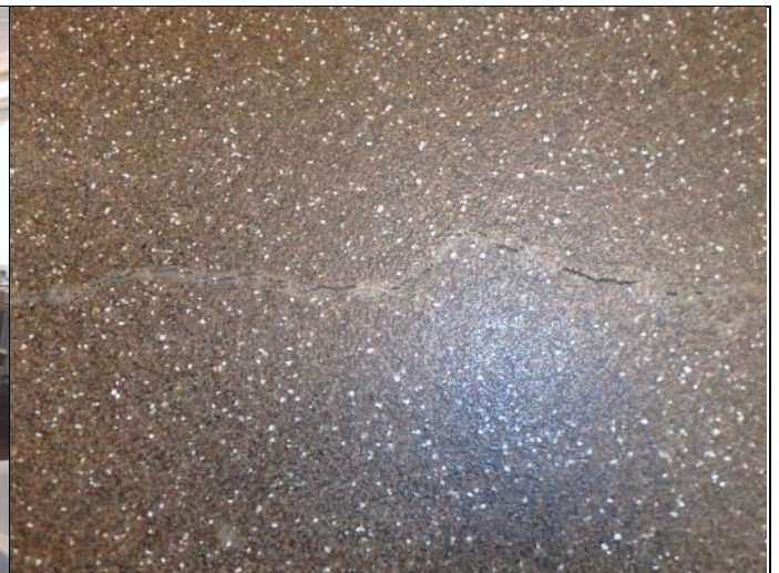
Keittiön lattiapinnoitteessa on havaittavissa paikoin suurehkoja halkeamia. Riskinä on epäpuhdas vuotoilma maaperästä. Pintakosteuskartoituksessa ei havaittu poikkeavaa.
