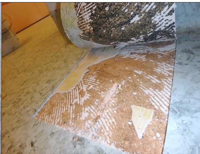
Rakenneseävauksessa R22 havaittiin selvä kosteus- ja mikrobivaurio, voimakas homeen haju, muovimatto ei ollut kiinni alustasta. Lattian tasoitteesta ja massasta otettiin mikrobinäyte MIR12.
