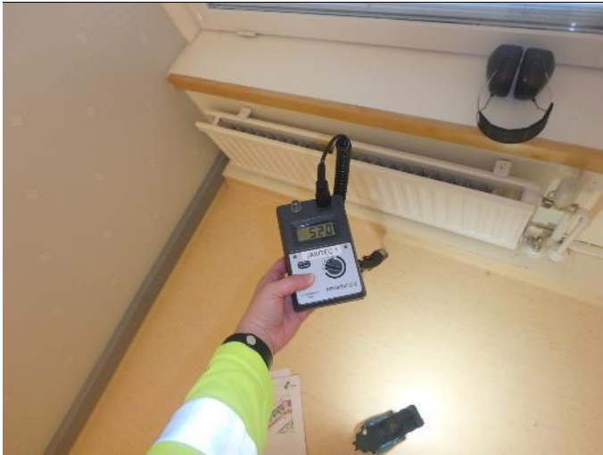
Rakenneavauspaikka R2. Pintakosteuskartoituksen perusteella lattia on kuiva tässä paikassa. Sijainti on esitetty paikannuspiirustuksessa 2.
