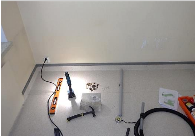
R29 tehtiin päätyhuoneeseen avaamalla ensin lattian muovimatto ja sitten poraamalla lattiaan Ø 50 mm reikä, josta tarkastettiin välipohjarakenne.
