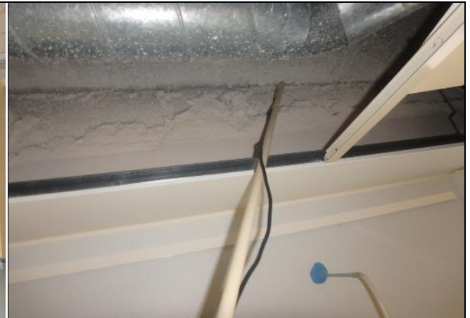
MA8. Merkkiainekokeessa ei havaittu ilmapuotoja yläpohja-ulkoseinäliittymästä, mutta...
