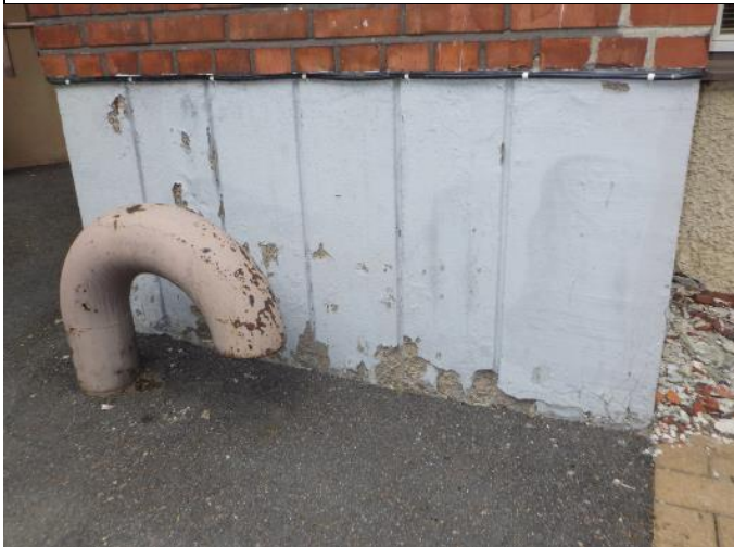
Kuvassa on vanhan piipun alaosa. Sokkelin pinnoite on osittain lähtenyt.
