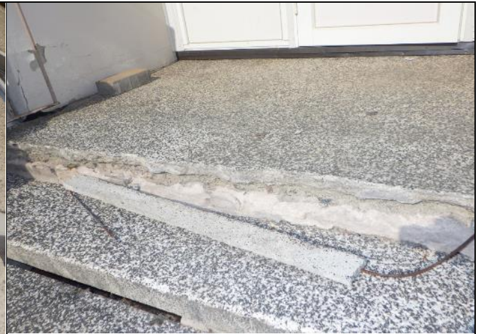
D-osan sisäpihan sisäänkäynnin portaikon askelma on mennyt poikki.
