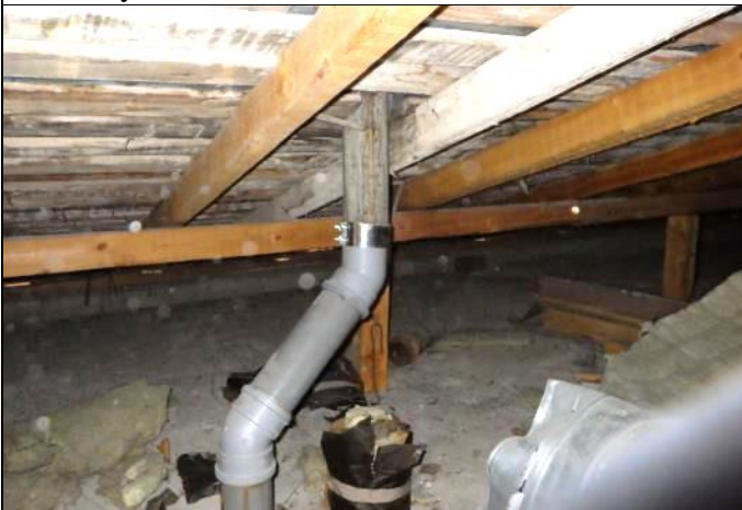
Osa viemäreiden tuuletusputkia on ilman lämmöneristettä.
