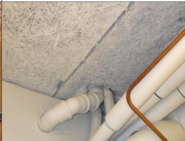
Tele- ja turvalaitteet -tilassa sisäkatto on kunnossa. Putkiläpiviennit tosin ovat silmämääräisesti epätiivitä.
