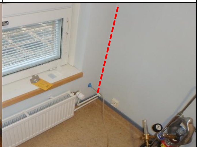
Lisäksi havaittiin merkittäviä ilmavuotoja ulkoseinä-väliseinäliittymästä (kuvassa merkattu punaisella katkovivalla).
