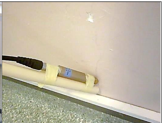
MA16. Merkittäviä ilmavuotoja havaittiin lämmityspatterin kiinnikkeistä sekä putkiläpivienneistä ulkoseinässä. Lisäksi havaittiin merkittäviä ilmavuotoja ulkoseinän sisäkuoren halkeamista (kuvassa).
