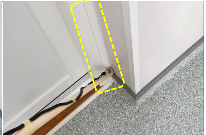
MA21. Lisäksi havaittiin ilmvuotoja parvekeovi-ulkoseinäliittymistä.
