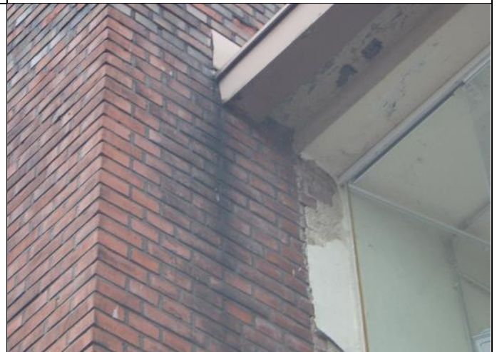
Tässä piipun ja sadevesikourun/vesikaton liittymästä on päässyt kosteutta rakenteeseen.
