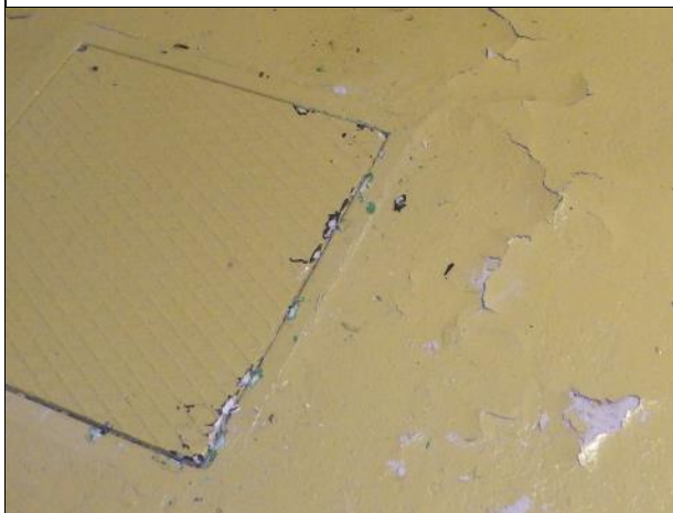
Lattiapinnoitteena oleva maali on paikoin hilseillyt. Talotekniikan tarkastusluukku avattiin
