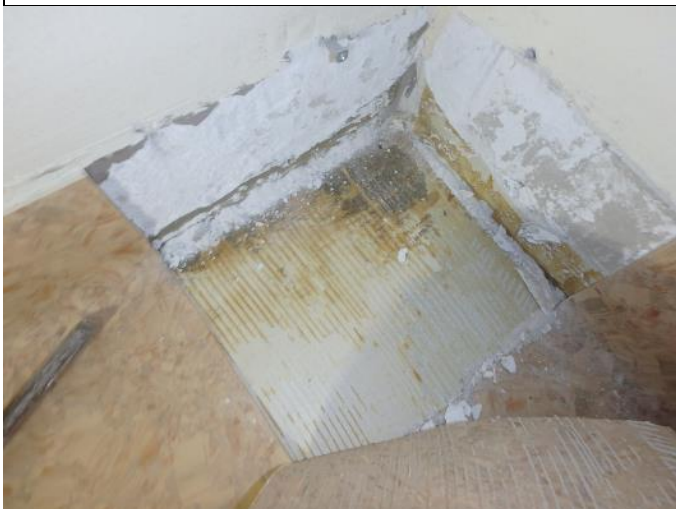
Rakennevaus R10. Sijainti on esitetty paikannuspiirustuksessa 2. Nuoli osoittaa kantavan väliseinän alaosa, jonka tasoite oli pehmeää.
