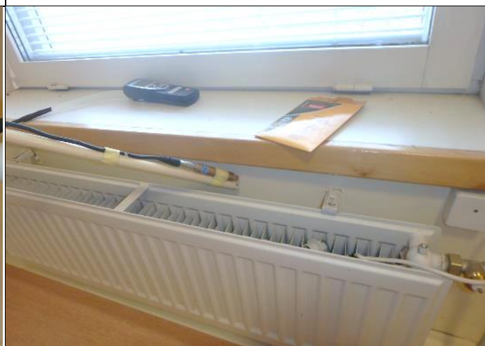
Lisäksi 10 min päästä havaittiin vuotoja ikkuna-ulkoseinäliittymästä ikkunalaudan kohdalta.
