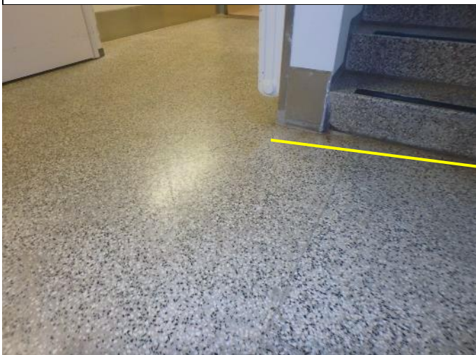
D-osan pohjakerroksen muissa tiloissa on myös havaittavissa hiusmaisista halkeamia lattiapinnoitteessa. Kuvassa käytävä.
