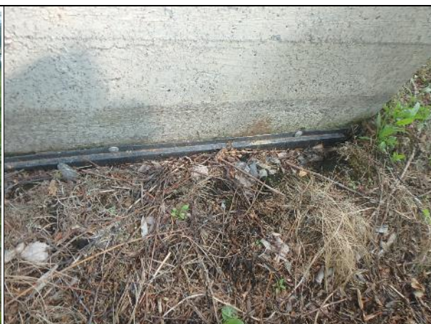
Toisen uuden terassin perusmuurissa (A-osan ulkosivu) tehtiin samat havainnot patolevystä.
