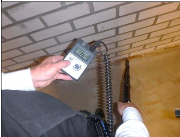
Kuvassa lattian ja väliseinän liittymä varastotilassa, josta havaittiin pintakosteuden suuri lukema (yli 136).
