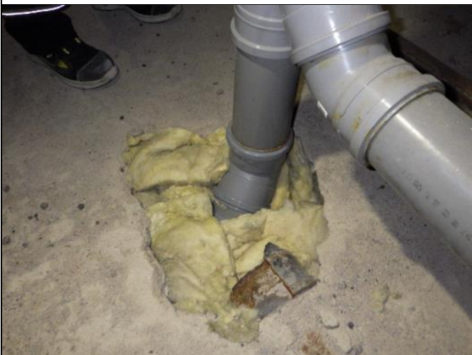
Kuvassa olevan viemärin tuuletusputken läpivienti yläpohjan betonilaatassa on tiivistetty mineraalivillalla.
