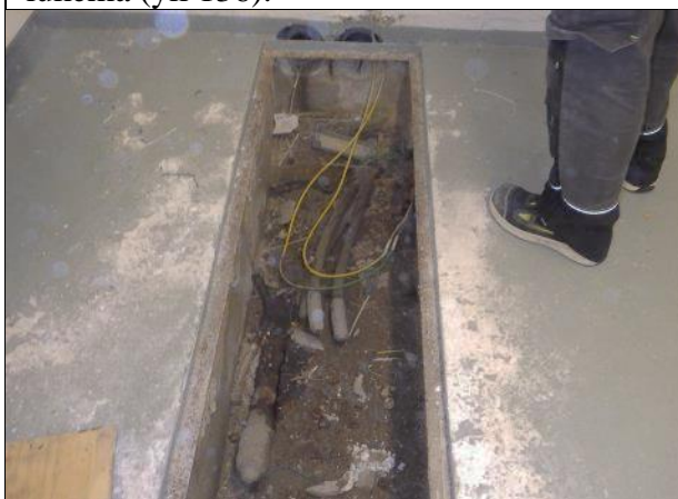
Sähköpääkeskuksessa tarkasteltiin vanha putkikanaali avaamalla kansi. Kanaali oli erittäin likainen. Mikrobiperäinen haju.
