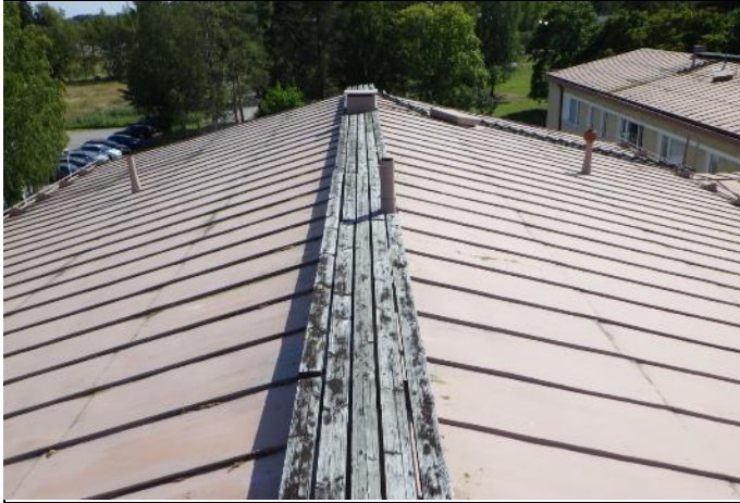
Kuvassa D-osan vesikatto. Harjalinjalla olevat puiset kulkusillat alkavat olla huonossa kunnossa.
