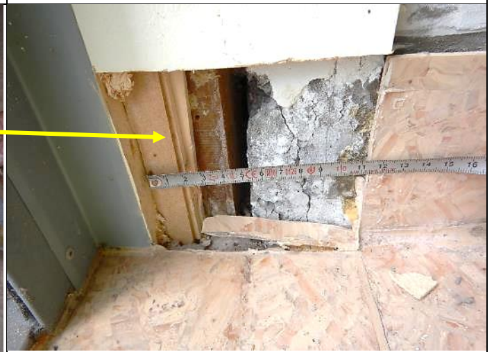
Ulko-oven karmin ja ulkoseinän välisestä liittymästä havaittiin suurehko rako.
