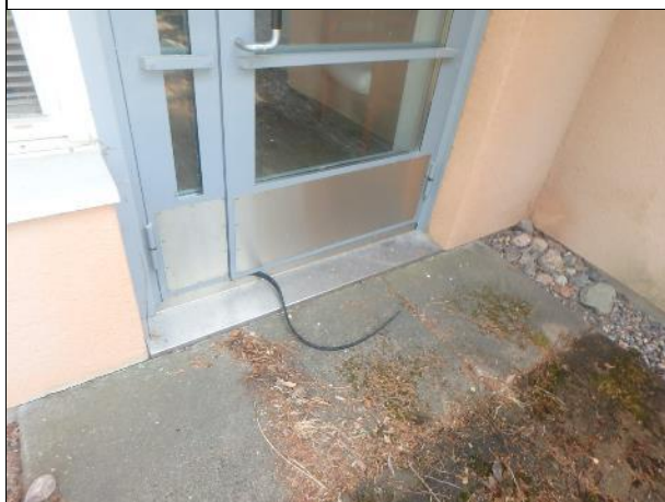
A-osan ulkosivun oven tiiviste on pois paikaltaan.
