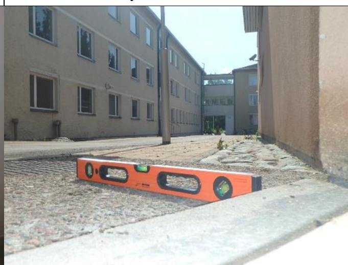
Ulko-oven kohdalla sisäpihan kivetyksen maan kaadot eivät ole riittäviä ohjauseen pintavettä pois päin rakennuksesta.
