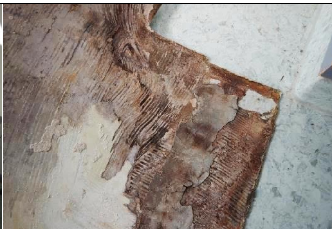
Aistinvaraisesti lattian muovimatto on kosteus- ja mikrobivaurioitunut, rakenneavauksessa havait- tiin voimakas homeen haju.
