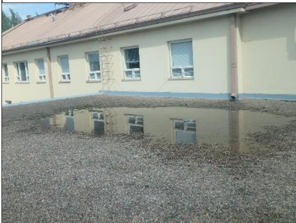
Kuvassa on vesikatto keskiosan kohdalla, jossa havaittiin iso lammikko.
