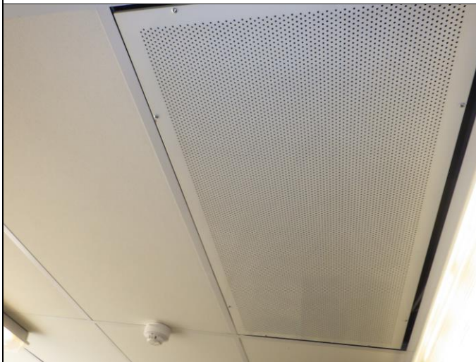
Näissä keittiön isoissa tuloilman päätelaitteissa (2kpl) ei ole kuitulähdettä.
