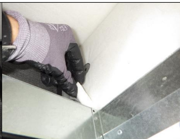
Saman päätelaitteen puhallinkonvektorin alkupuolella on antiallerginen äänenvaimennusmateriaali.
