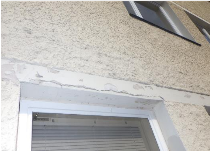
D-osan sisäpihan julkisivun pohjakerroksen ikkunat. Lattarauta ikkunoiden yläpuolella on altis ruosteelle.
