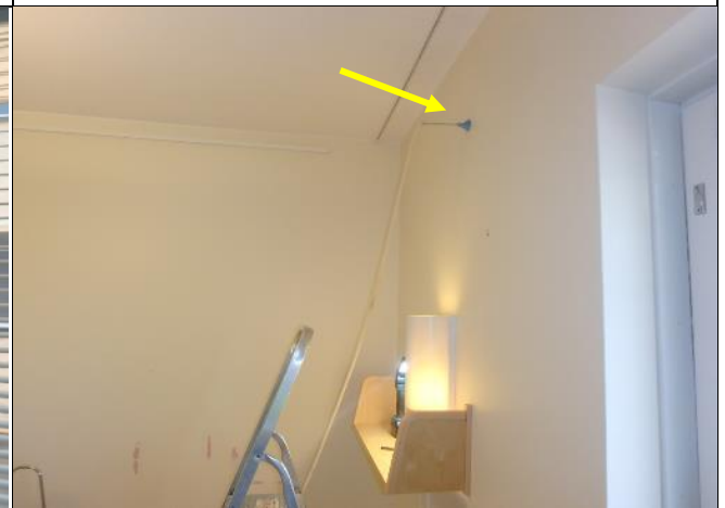
Merkkiainekoe MA9 tehtiin huoneen (31) ulkoseinän yläosaan, missä yläpohjan liittymässä oli ehjä massatiiviste. Merkkiainekokeessa ei havaittu ilmapuotoja yläpohjaliittymästä, mutta havaittiin kuitenkin merkittäviä ilmapuotoja ikkuna-ulkoseinäliittymästä sekä sähköpistorasian liitoksista.
