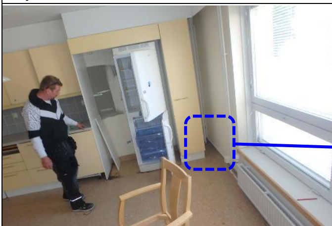
Aulan keittiökaapistojen takana nurkasta havaittiin lämmitysputkien läpiviennit seinässä, jotka ovat silmämääräisesti epätiivisiä. Homekoira on ilmaissut myös tämän kohdan.
