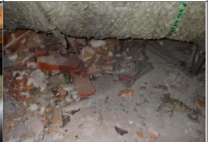
Yläpohjatilassa on havaittavissa tiilimurskaa ja muuta kuulumatonta ainesta.
