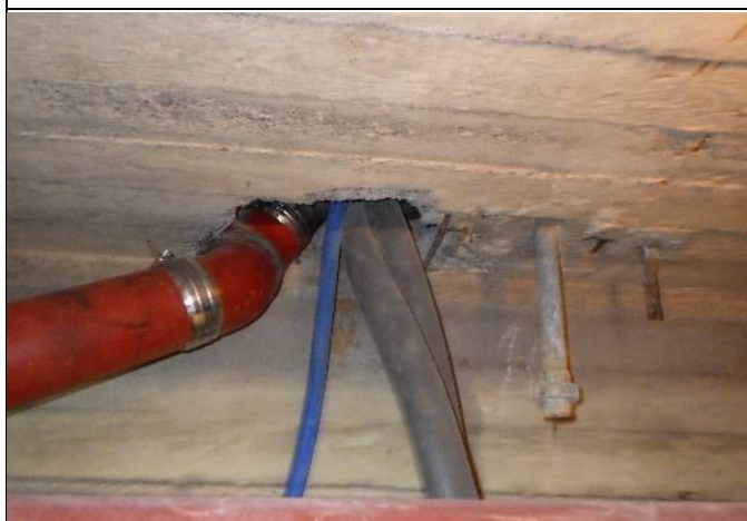
Näitä epätiivittä läpivientejä - ainakin alhaalta käsin - on putkikanaalissa useita.
