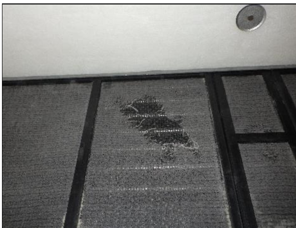
Saman päätelaitteen puhallinkonvektorin suodatin on pölyinen jokaisessa huoneessa.
