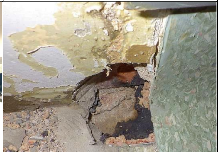
Muovimatto avattiin välipohja-ulkoseinäliittymän kohdalta, josta havaittiin murtuma ulkoseinän sisäkuoressa. Tämä saattaa olla homekoiran ilmaisen syy. Muuten liittymä on melko tiivis.
