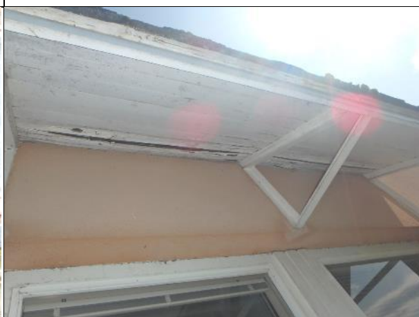
A-osan ulkosivun (julkisivu länteen) ikkunoissa ja katoksissa on samanlaiset havainnot lahovaurioista kuin B-osassa.
