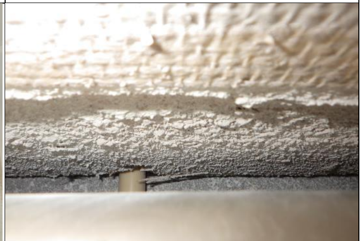
Yläpohja-ulkoseinäliittymän tarkastelu tästä avauspaikasta oli kuitenkin hankalaa. Liittymässä havaittiin epätiivis sähköputken läpivienti.
