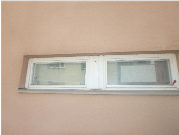
Kuvassa on B-osan sisäpihan julkisivun ikkuna. Ikkunapuitteet ovat pääosin hyväkuntoisia, jotkut huoltomaalausta vaille.
