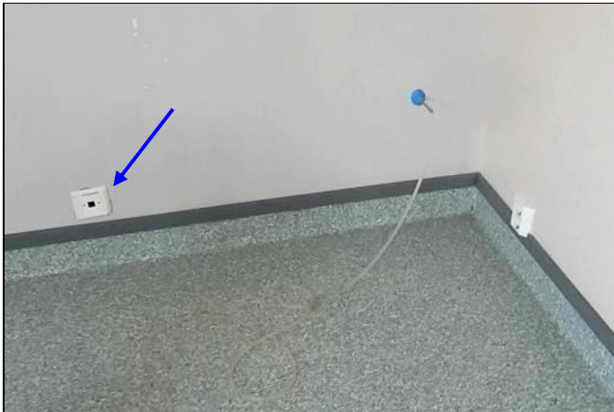
Merkkiainekoe MA21 suoritettiin D-osan 1. kerroksen huoneen (numero 44) ulkoseinään. Noin 3 min päästä merkkiainekokeessa havaittiin vuotoja potilashälytin -pistokkeesta ulkoseinässä.
