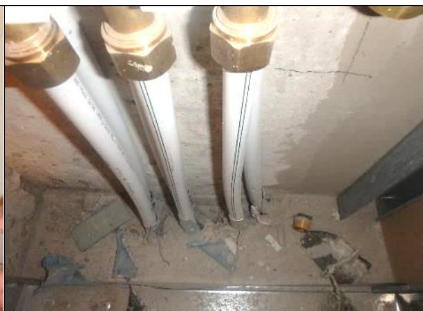
Kuilun pohjassa on havaittavissa jotain roskaa ja rakennusainesta.
