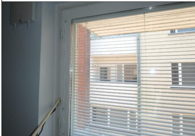
MA8. 10 min päästä merkkiainekaasun syöttämisen aloittamisesta havaittiin ilmapuotoja ikkuna-ulkoseinäliittymistä.
