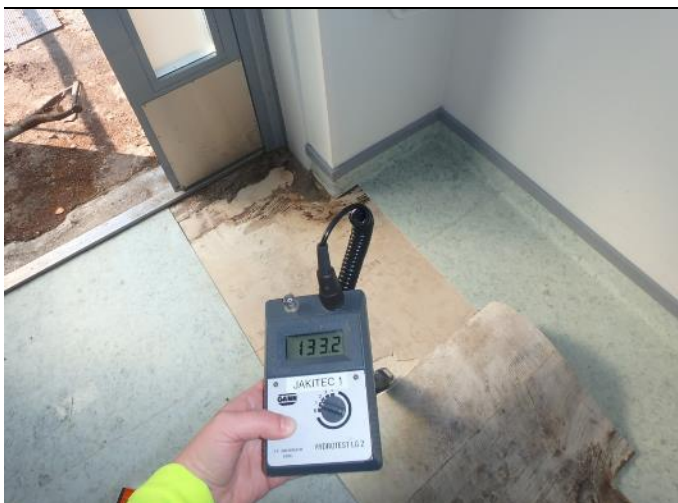
Muovimaton alta tarkasteltiin pintakosteutta tasoitteen päältä, kohonnut lukema.
