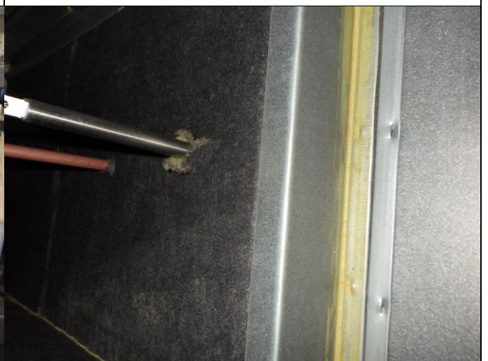
TK8/TF8 Lämpö-/virtausanturin läpivienti on auki ja mineraalivillaeriste näkyy.
