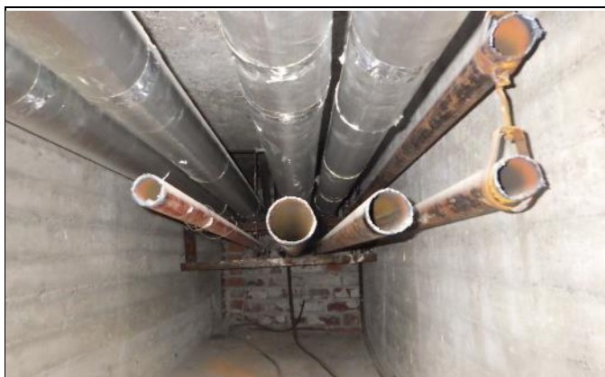
Kuva kanaalin päädystä. Käytöstä poistetut putket ovat tulppaamatta.
