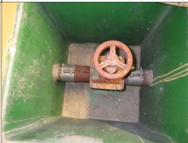
Pohja oli melko likainen. Mikäli tiloissa oleskellaan, tulee luukut puhdistaa ja päälle asentaa kaasutiiviit kannet.
