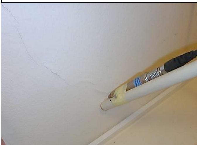
MA5. 3 min päästä merkkiainekaasun syöttämisen aloittamisesta havaittiin vuotoja ulkoseinän sisäkuoren halkeamista. Homekoira oli merkannut tämän paikan.
