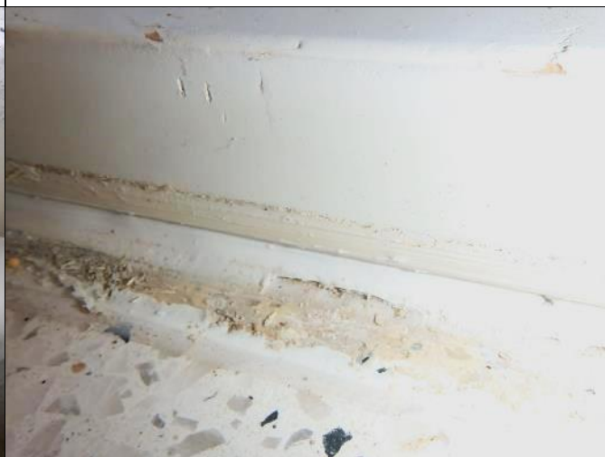
Ikkunaliittymään tehtiin rakenneavaus R44 ja havaittiin, että ikkunoiden massaukset eivät ole tiiviitä.
