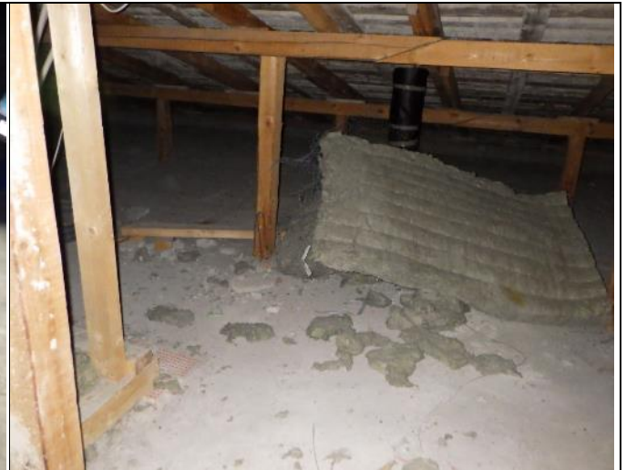
Kuvassa on yläpohjatilassa havaittu paljas villa.
