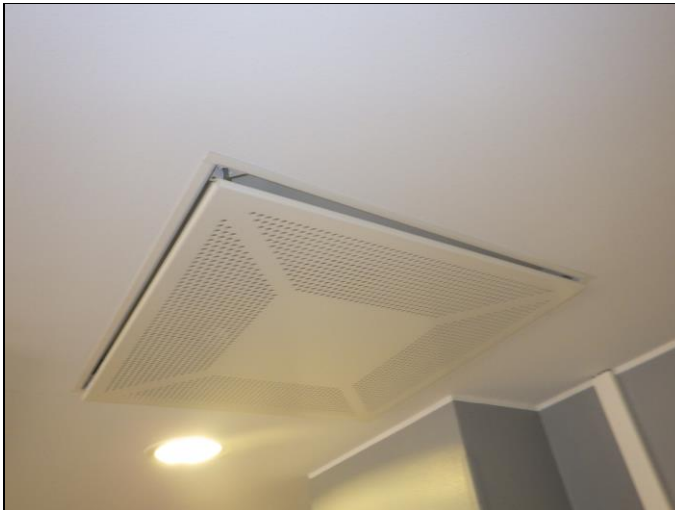
Näissä tulevan ruokasalin tuloilman päätelaitteissa ei ole kuitulähdettä.
