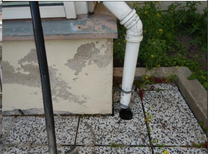
Nykyisen pääsisäänkäynnin betonirakenteisten alaosien maali irtoilee. Rännikaivo on ilmeisesti laattojen alla syvemmällä, mutta vesitiiviyys on syytä tarkastaa.
