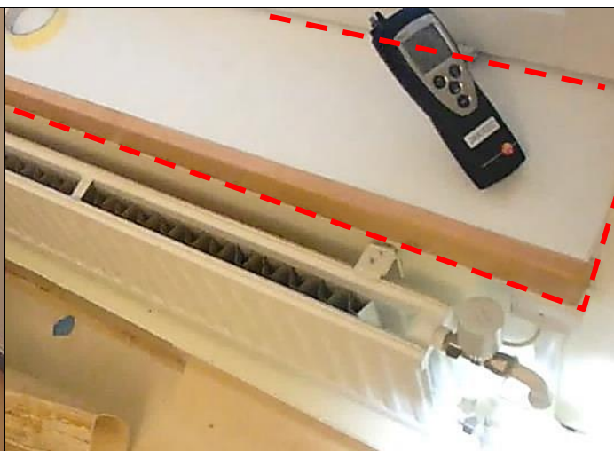
Merkkiainekokeessa MA2 havaittiin ilmapuotoja ikkuna-ulkoseinäliittymästä ikkunalaudan kohdalta.
