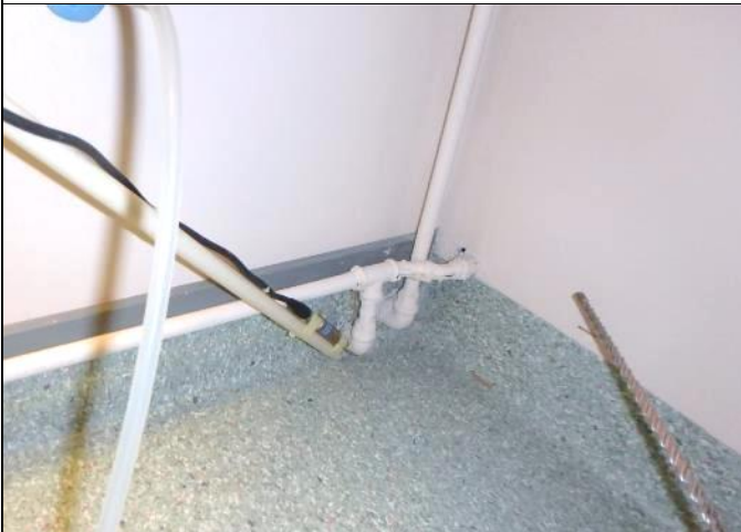
Merkkiainekokeessa MA15 havaittiin merkittäviä ilmavuotoja putkiläpivienneistä ulkoseinässä.
