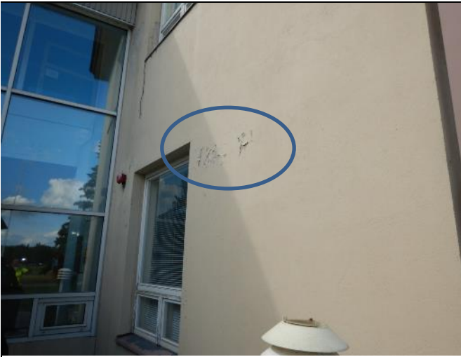
Nykyisen pääsisäänkäynnin C-osan vastainen pääty. Ulkoseinässä on pieni alue, josta pinnoite irtoilee.
