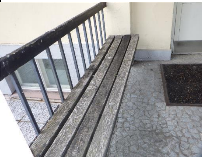
Kuvassa C-osan etupihan toinen parveke. Istumapenkit ovat huoltomaalausta vaille.
