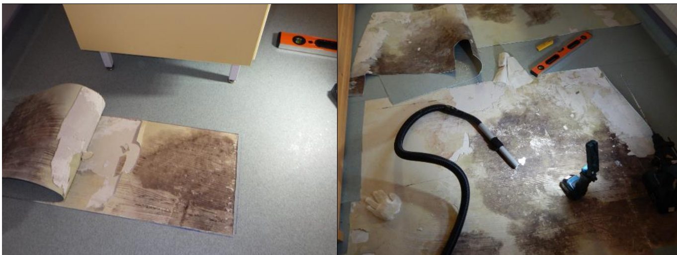
Rakenneavaus R6. Sijainti on esitetty paikannuspiirustuksessa 2. Aistinvaraisesti lattiapinnoite on kosteus- ja mikrobivaurioitunut, rakenneavauksessa havaittiin voimakas homeen haju.
