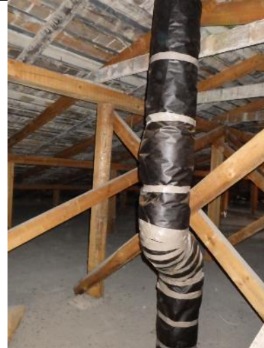
Osa viemäreiden tuuletusputkista lämpöeristetty, ok.
