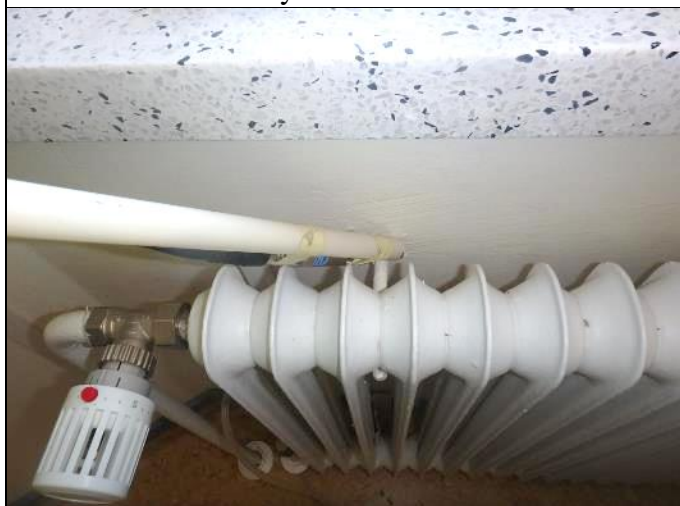
MA25. Lisäksi havaittiin ilmavuotoja lämmityspatterin kiinnikkeistä ulkoseinässä.
