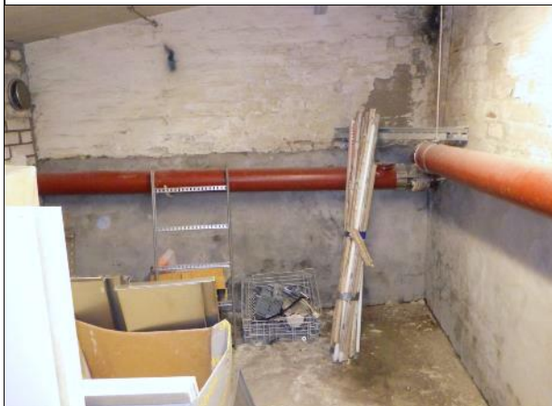
Kellaritilojen seinissä ja lattiassa on havaittavissa kosteusjälkiä.
