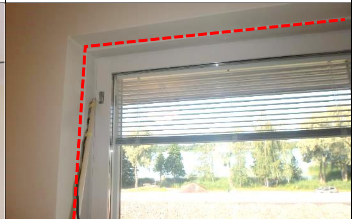
Lisäksi havaittiin vuotoja ikkunaliittymistä.
