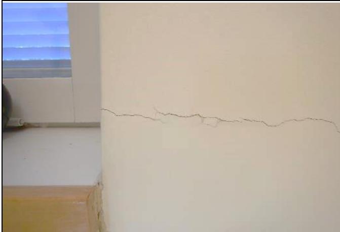
Huoneissa on paikoin havaittavissa hiusmaisia halkeamia seinäpinnoitteessa.
