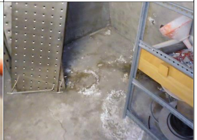
Kellaritilojen seinissä ja lattiassa on havaittavissa kosteusjälkiä.
