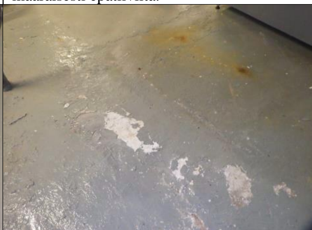
Lattiapinnoitteena oleva maali hilseilee irti.
