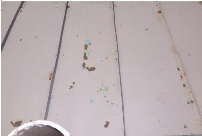
Vesikatteen maalipinnoite on lähtenyt muutamassa paikassa irti ja pelti alkanut ruostua.
