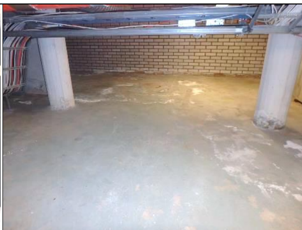
Kuvassa varastotila kellarissa. Täällä havaittiin myös korkeat lukemat pintakosteuskartoituksessa lattiasta. Tiloissa on tunkkainen ilma ja kellarimainen haju.
