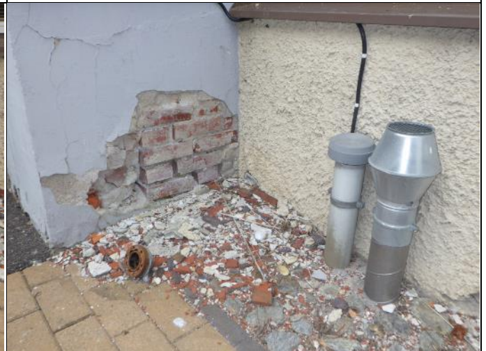
Piipun pinnoitteita on irronnut jo runsaasti.
