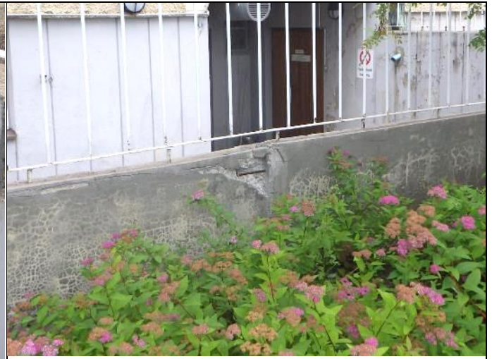
Kuvassa luiskan tukimuuri. Tällä puolella on runsaasti kasvillisuutta, mikä lisää kosteusrasitusta betonirakenteeseen. Kuvassa näkyy paljas raudituksen teräs.
