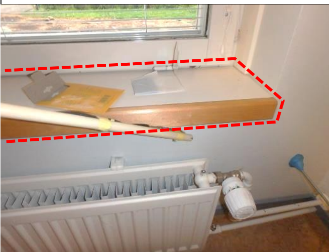
Merkkiainekokeessa MA4 havaittiin ilmavuotoja ikkuna-ulkoseinäliittymästä ikkunalaudan kohdalta (samanlainen rakenne, kuin B-osassa).
