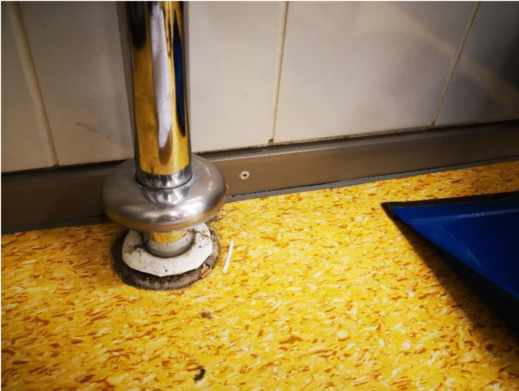
Kuva 5. Luokkahuonesiiven viemärin läpiviennissä havaittiin vuotopaikkoja.
