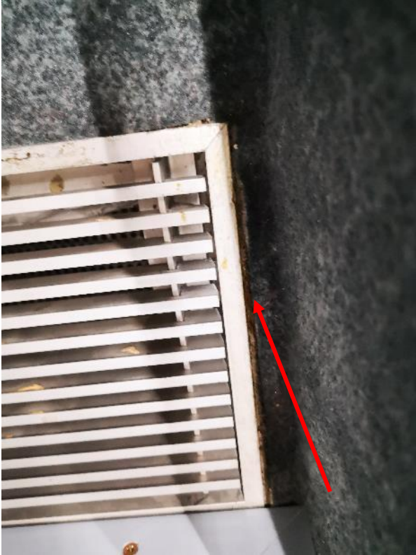
Kuva 3. Tuloilmakotelon kehyksen ja lattiamaton rajapinnoilla havaittiin vuotopaikkoja.
