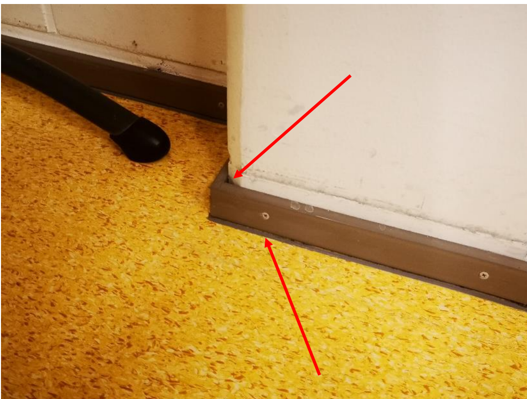
Kuva 6. Luokkahuonesiiven pilareiden ja lattian rajapinnoilla havaittiin vuotopaikkoja.
