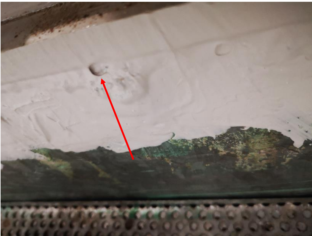
Kuva 2. Muutamissa tuloilmakotelon tiivistyksissä havaittiin rakoja tai reikiä rajapinnoilla.
