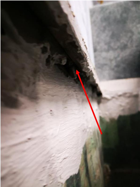
Kuva 1. Muutamissa tuloilmakotelon tiivistyksissä havaittiin rakoja tai reikiä rajapinnoilla.
