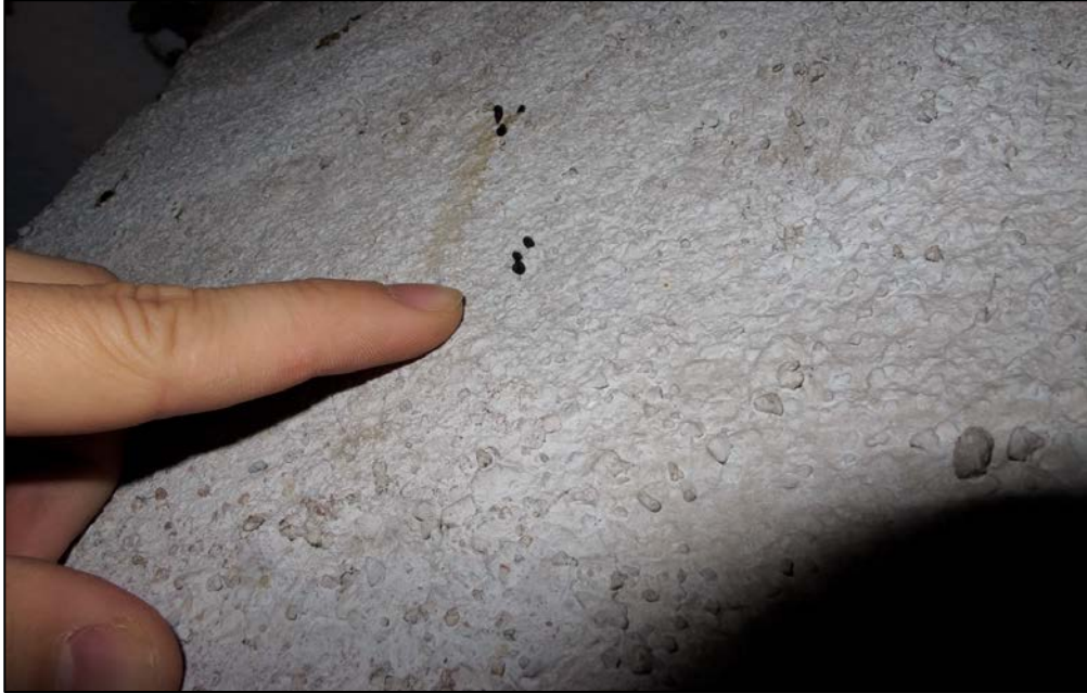
Kuva 2. Rakennuksessa 10 löydettiin lepakoiden papanoita hormen kyljestä.
