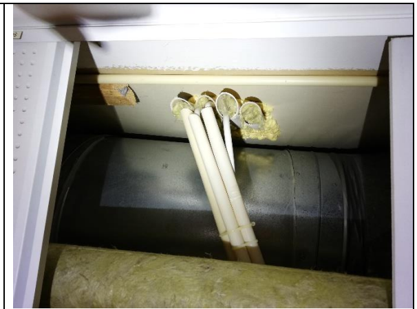
Kuva 3: Mineraalivillaeristettä käytetty tiivisteinä läpivienneissä.
