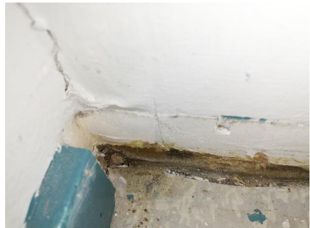
Kuva 11: Silikonitiivistys on epätiivis nurkassa.
