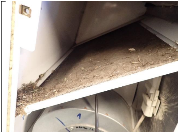
Kuva 25: Tuloilman karkea suodatin on erittäin likainen.
