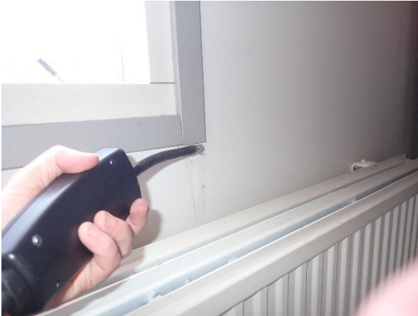
Kuva 12: Merkkiainevuotoa Joukahaisten nukkumatilán ikkuna-seinäliitoksesta.
