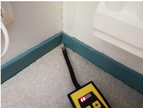
Kuva 10: Merkkiainevuotoa Lemminkäisten nukkumattilan alapohjarakenteesta.
