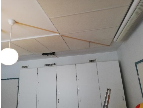
Kuva 29: Tuloilmavirrat osuvat katon akustiikkalevyn reunaan.
