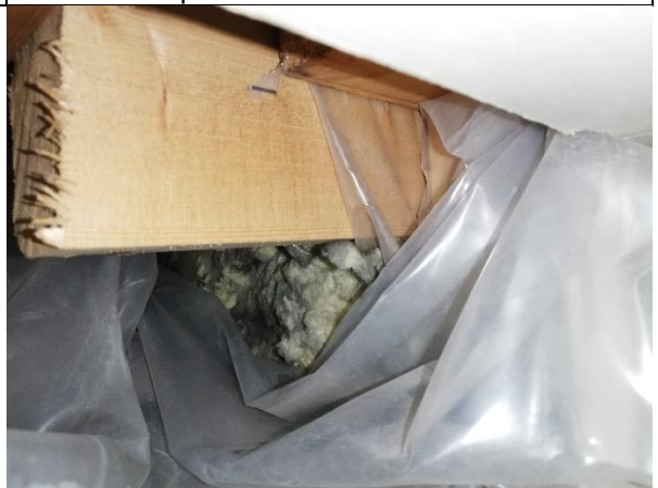
Kuva 5: Höyrynsulkumuovi on epätiivis, puhallusvillat näkyvillä.
