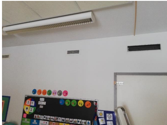
Kuva 32: Tiloissa olevia tulo- ja poistoilmapäätelaitteita.
