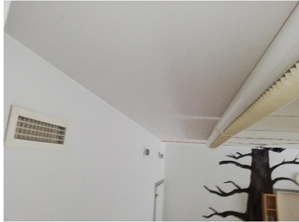
Kuva 30: Tuloilmavirran suuntaus muuttuu ilmavirran osuessa valaisimeen.
