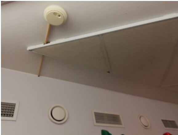
Kuva 31: Tiloissa olevia tulo- ja poistoilmapäätelaitteita.
