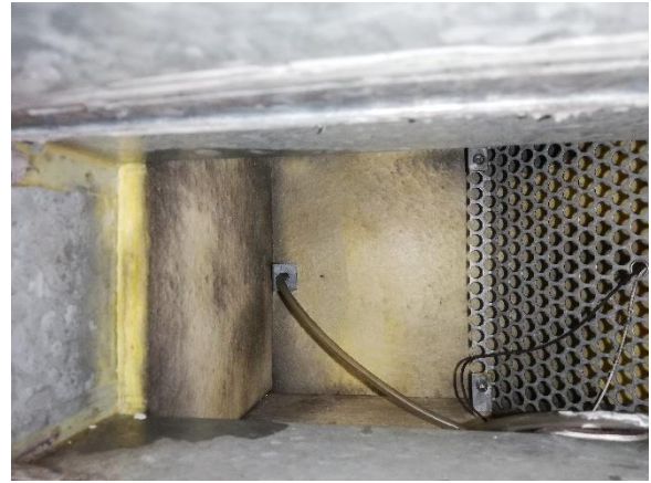
Kuva 36: Joukahaiset-tilan tuloilmapäätelaitteessa öljyjalkia.
