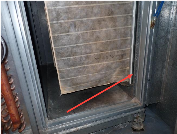
Kuva 21: Tuloilmasuodattimien kehikko ei ole tiivis.
