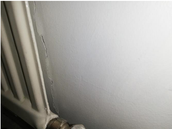
Kuva 14: Joukahaisten huoneessa epätiiveyttä seinälevyjén saumakohdassa.
