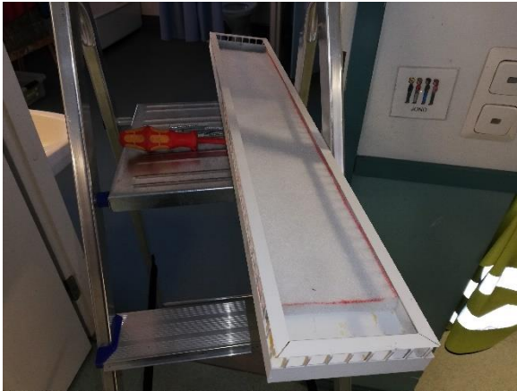
Kuva 35: Siirtoilma-aukon äänenvaimennin on puhdas.
