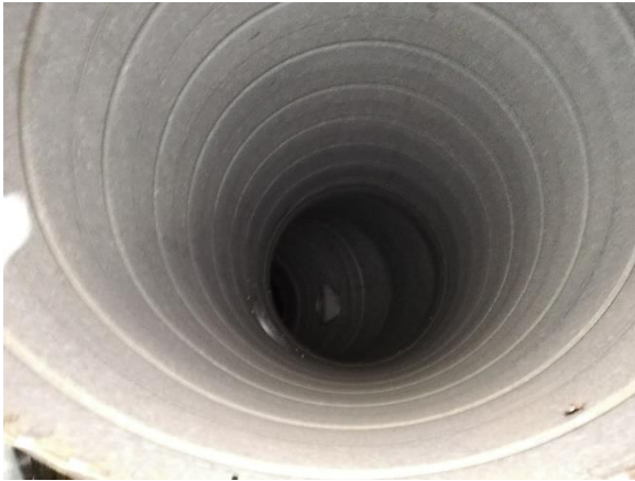
Kuva 27: Tuloilmakanavassa jonkun verran pölyä.
