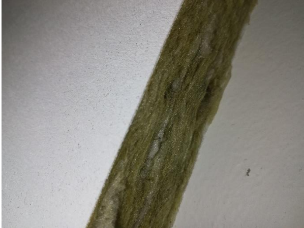
Kuva 6: Akustiikkalevyjen seinänpuoleiset reunat ovat pinnoittamatta.
