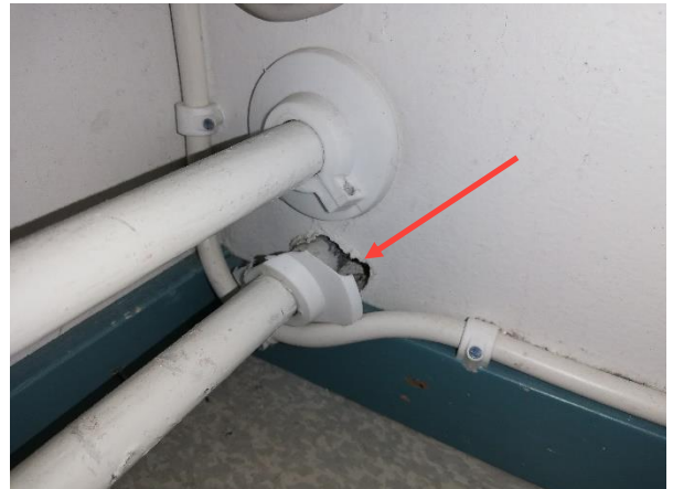
Kuva 15: Epätiivis putkiläpivienti Kissa-eskareiden tilassa.
