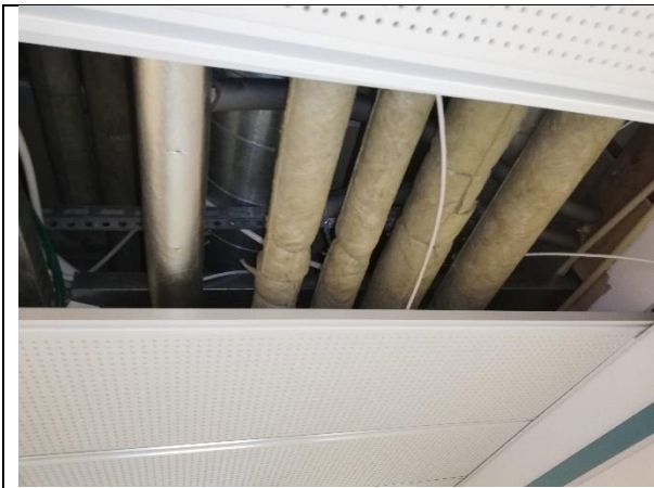
Kuva 2: Putkieristeet ovat pinnoittamatta.
