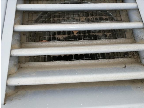
Kuva 23: Vallox Ilmavan raitisilmaventtiili on likainen.
