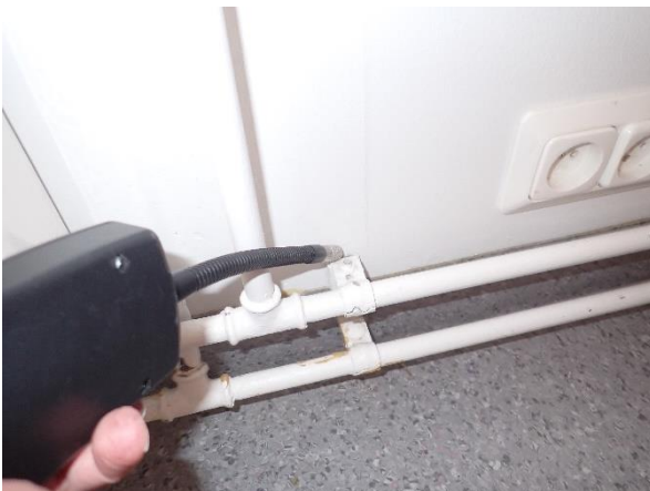
Kuva 16: Merkkiainevuotoa kahvihuoneen patteriputkikannakkeen kautta.
