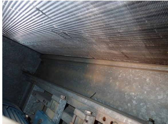
Kuva 22: Likaa lämmittimen kammiossa
