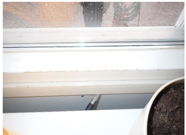
Kuva 17: Merkkiainevuotoa kahvihuoneen ikkuna-seinäliitoksen kautta.
