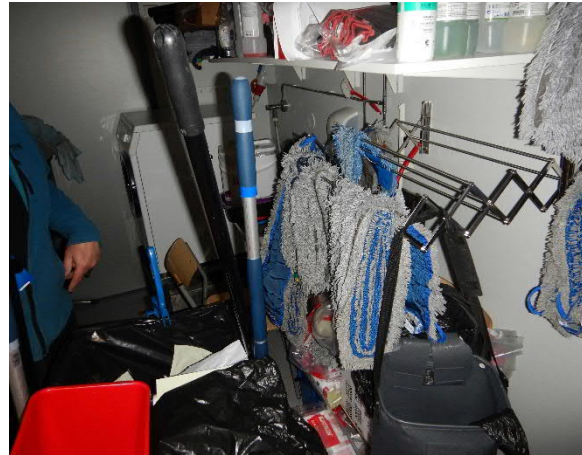
Siivouskeskuksen poistoilmamäärät ovat kosteuskuormiin nähden liian pienet
