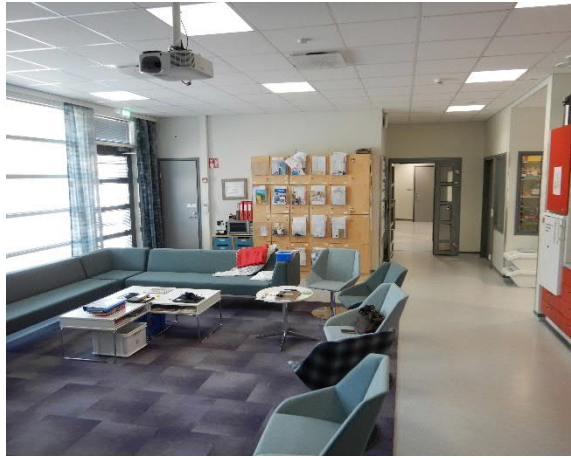
Hallintotilan sisäilma on aistittavasti tunkkainen
