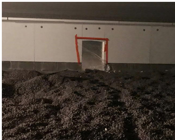
Ryömintätilan aukot tiivistettiin ennen kaasun syöttöä ryömintätilaan
