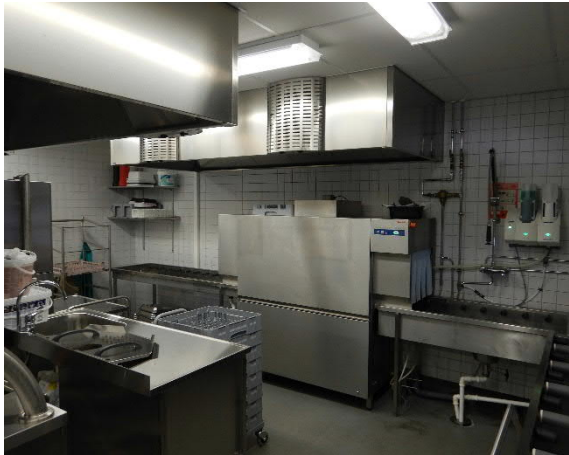
Keittiön tiskikoneen huvasta ei havaittu poistoilmavirtausta
