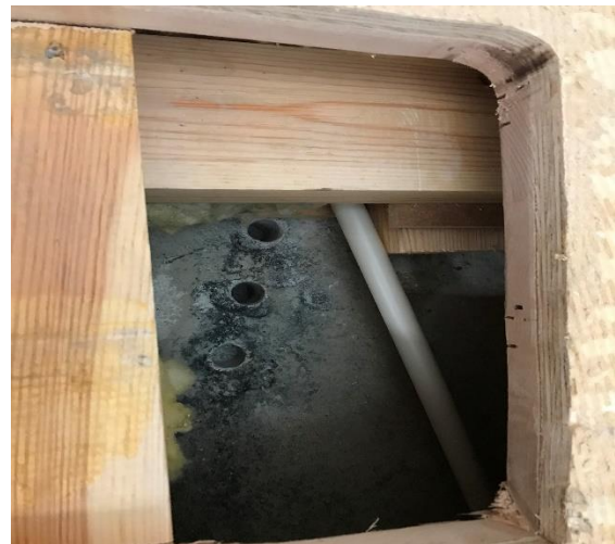
Kuva 2 Rakennusavaus 2. Lattian betonilaatan pinnalla havaittiin kasvustoa
