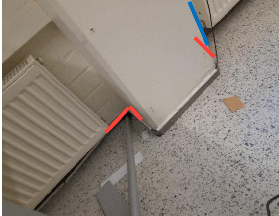
Kuva 3. Normaalityilassa ja alipaineistettuna havaittiin merkittävää ilmavuotoa pilarin liittymässä. Vähäistä ilmavuotoa pilarin ja ulkoseinänliittymässä noin 300 mm matkalla lattianpinnasta.
