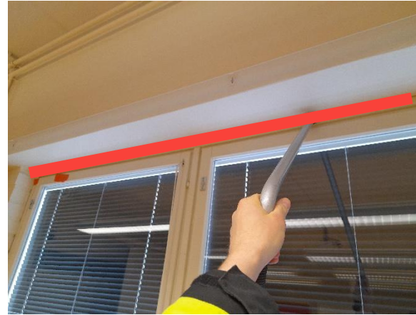
Kuva 12. Normaalissa / alipaineistettuna ikkunan yläosassa havaittiin merkittävää vuotoa n. 2500 mm matkalla.
