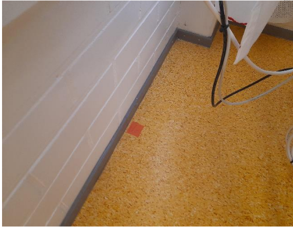
Kuva 22. Alipaineistettuna alapohjarakenteen ja ulkoseinän liittymässä pistemäinen ilmavuoto.
