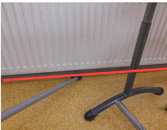
Kuva 15. Normaalissa / alipaineistettuna, alapohjarakenteen ja ulkoseinärakenteen liittymässä havaittiin merkittävää ilmavuotoa yksittäisessä kohdassa.
