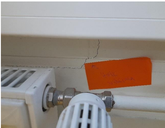
Kuva 20. Normaalissa / alipaineistetussa tilassa, seinän halkeamassa vähäistä ilmuvuotoa.
