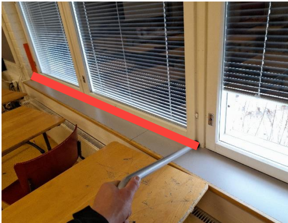
Kuva 13. Normaalissa / alipaineistettuna, ikkunan alaosassa havaittiin merkittävää vuotoa n. 2500 mm matkalla.
