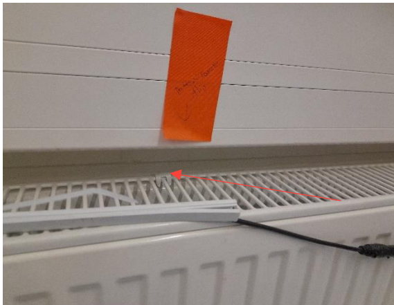
Kuva 5. Alipaineistettuna havaittiin pistemäistä ilmavuotoa, patterikannakkeen kohdalla.
