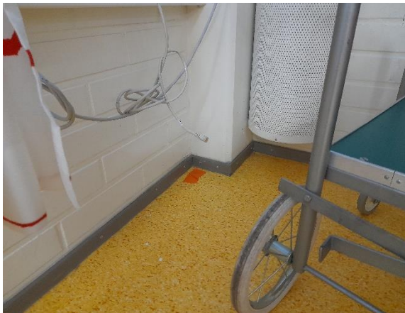
Kuva 26. Normaalissa / alipaineistetussa tilassa, pi- larin liittymässä vähäistä ilmavuotoa.
