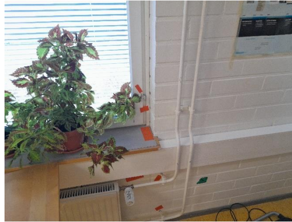
Kuva 19. Normaalissa / alipaineistetussa tilassa, patterinkannakkeissa havaittiin pistemäistä vuotoa. Ikkunaliittymässä havaittiin vähäistä vuotoa ja ikkunansaranoissa pistemäistä vuotoa.
