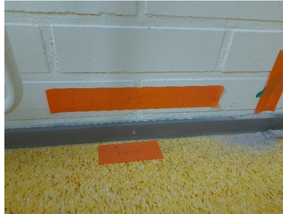
Kuva 29. Normaalissa ja alipaineistettuna lattialiitymässä vähäistä ilmavuotoa.
