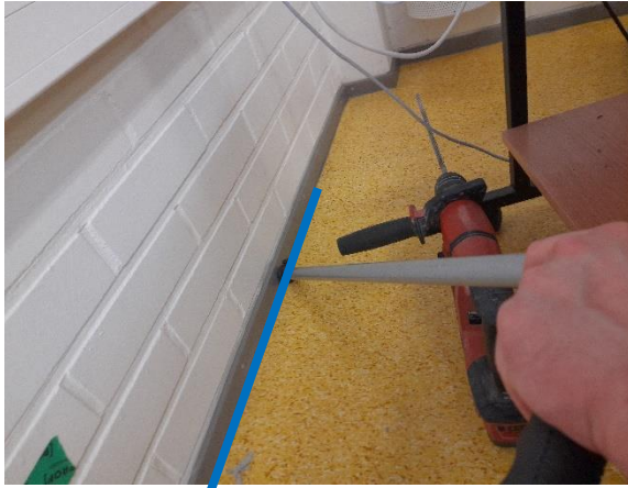
Kuva 7. Normaali ja alipaineistetussa tilassa havaittiin vähäistä ilmapuotoa alapohjarakenteen ja ulkoseinänliittymässä.
