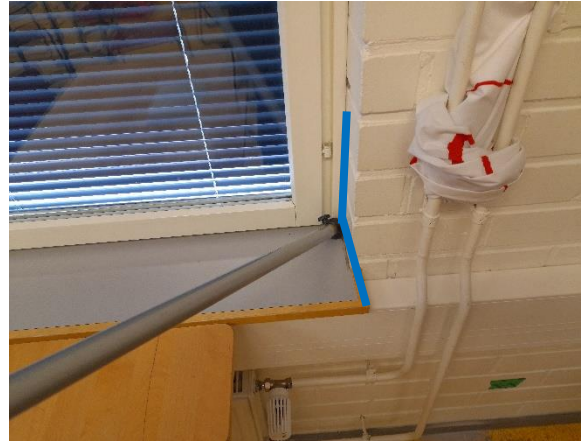
Kuva 8. Normaali ja alipaineistetussa tilassa havaittiin vähäistä ilmapuotoa ikkunalaudan ja seinän liittymässä.
