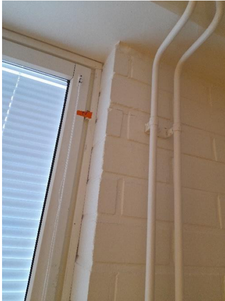
Kuva 28. Alipaineistettuna ikkunan saranoissa pistemäistä ilmavuotoa.
