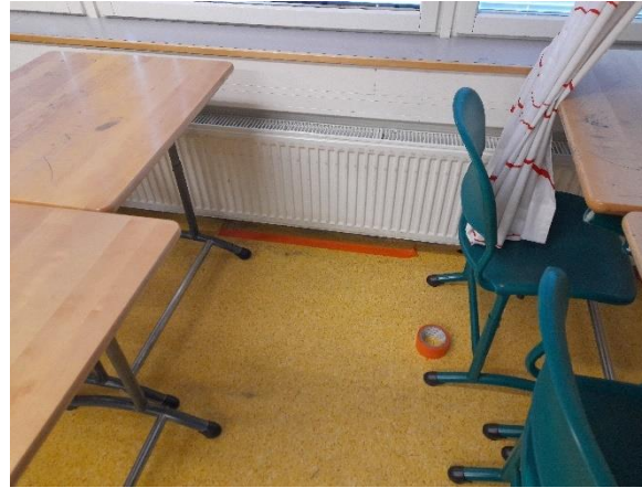
Kuva 25. Alipaineistetussa tilassa, ulkoseinän ja ala- pohjarakenteen liittymäkohdassa merkittävää ilma- vuotoa.
