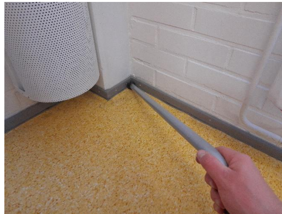
Kuva 27. Alipaineistettuna pilarin ja lattian liittymässä vähäistä ilmavuotoa.
