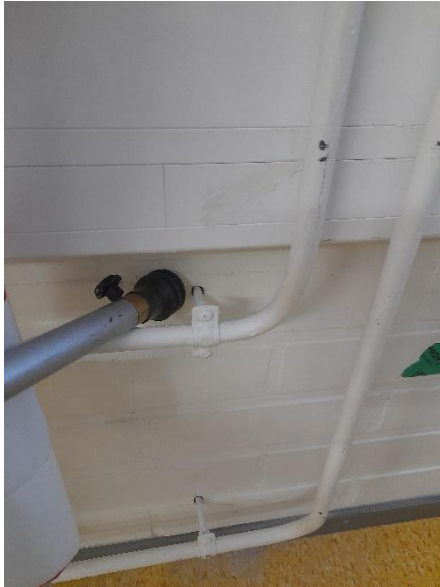
Kuva 18. Normaalissa / alipaineistetussa tilassa, patterin vesiputken kannattimessa havaittiin pistemäinen ilmuvuoto.
