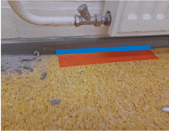
Kuva 11. Normaalissa / alipaineistettuna, alapohjarakenteen ja ulkoseinärakenteen liittymässä havaittiin vähäistä ilmavuotoa yksittäisessä kohdassa.
