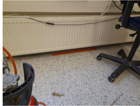
Kuva 4. Normaalityilassa ja alipaineistettuna alapohjan ja ulkoseinän liittymässä havaittiin merkittävää ilmavuotoa.
