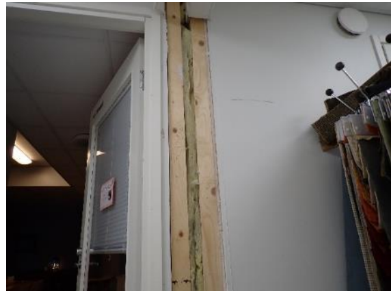
Kuva 38. 108 käytävällä avattiin väliseinäelementin peitelista. Väliseinän villat ovat suojaamattomina peitelistan takana. Ilmavirtauksien mukana on mahdollista, että epätiivisiin peitelistan ja seinärakenteen välistä kulkeutuu kuituja sisäilmaan.
