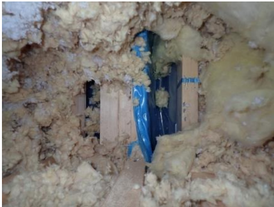
Kuva 34. Höyrynsulkumuovi on rullattu kasaan ja niitattu puurunkoon. Elementtiliittymän kohtaa ei ole toteutettu suunnitelmien mukaisesti. Kohdassa ei kuitenkaan havaittu silminnähtäviä tiiveyspuutteita.
