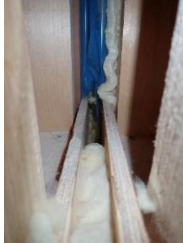
Kuva 26. Tilan 134/135 ulkoseinäelementin sauma-kohta avattu sisäpuolelta. Höyrynsulkumuovin välissä rako, höyrynsulkumuovissa epätiiveyttä. Alapohjarakenteen ja ulkoseinän välissä ei havaittu höyrynsulkumuovin liittymistä.
