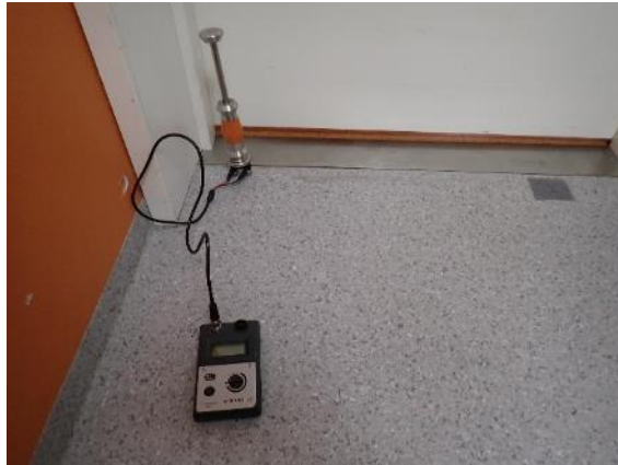
Kuva 15. Tilojen 108/118 välille toteutettiin kosteusmittaus. Kosteusmittauksessa ei esiintynyt poikkeavia kosteusarvoja ja tulokset olivat normaalit.
