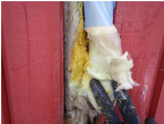
Kuva 24. Tilan 134/135 ulkoseinäelementin saumakohta avattu ulkopuolelta. Elementtisauman kohdalla mineraalivillat julkisivulaudoitusta vasten. Höyrinsulkumuovin liittyminen on epätiivis.
