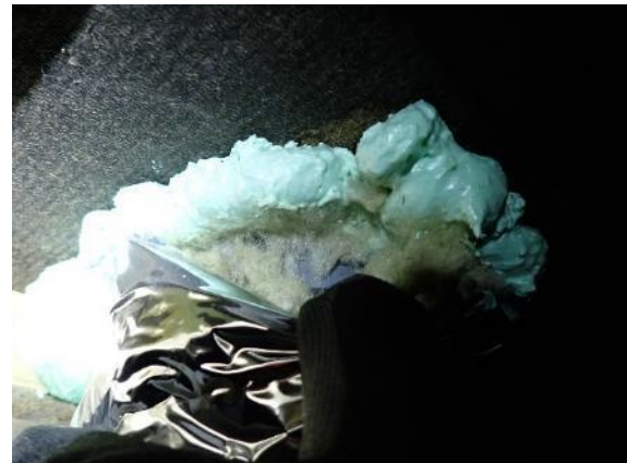
Kuva 4. Uretaanivaahtoa ei ole asennettu tiiviisti.
