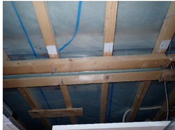
Kuva 35. Yläpohjarakennetta tarkasteltiin alapuolelta. Kohdassa höyrynsulku on limitetty vastaavasti yläpuolella, kun kuvassa 34. Kohdassa kuuluisi olla myös höyrynsulun alapinnassa SPU-vaahto elementtisauman kohdalla.
