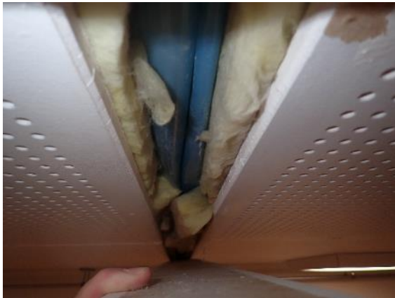
Kuva 37. Pienryhmähuone 117 tilassa avattiin alakaton elementtiliittymän saumalista. Listan takaa paljastui avoimia mineraalivillapintoja.
