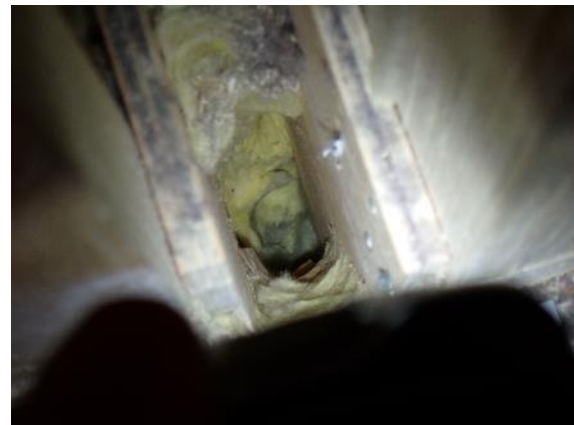
Kuva 10. Väliseinäessä ei havaittu höyrynsulkua / ilmansulkupaperia, joka kuuluisi olla limitettynä alapohjarakenteen alaosassa.
