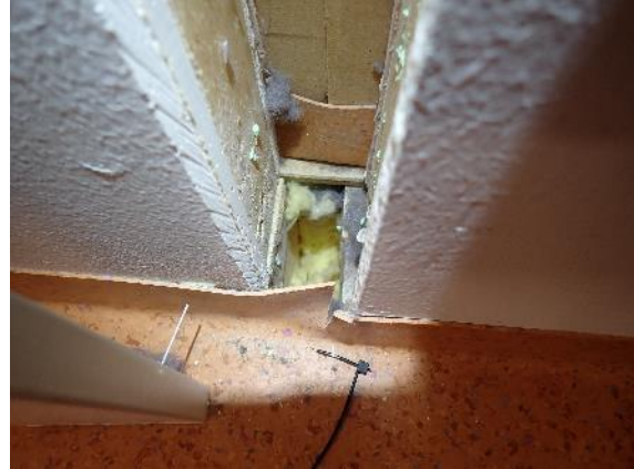
Kuva 12. Väliseinässä ei havaittu ilmansulkupap- eria, joka kuuluisi olla limitettynä alapohjarakenteen alaosassa.
