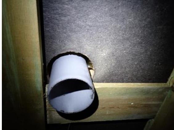
Kuva 1. Ryömintätilassa havaittiin kaksi läpivienttiä, joita ei ole tiivistetty.
