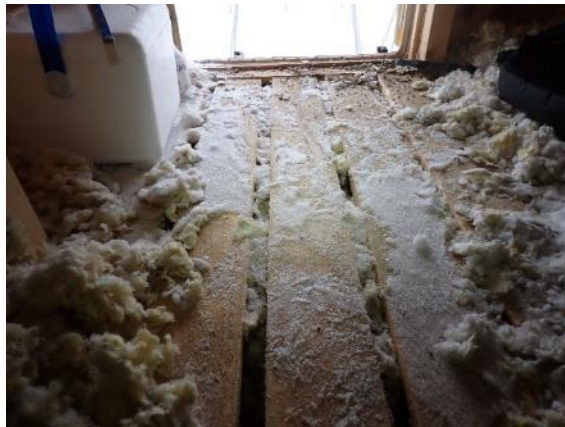
Kuva 27. Yläpohjaan johtavassa luukussa havaittiin epätiiveyttä. Luukun kautta pääsee lumi kulkeutumaan yläpohjarakenteeseen.
