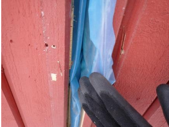
Kuva 22. Ulkoseinäelementin saumakohta avattu tilan 119 kohdalla. Höyrinsulussa epätiiveyttä.
