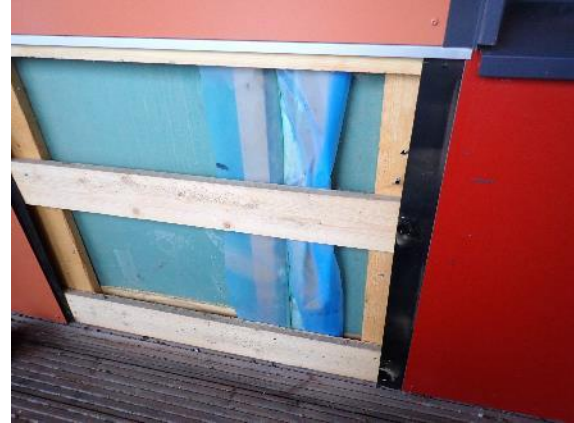
Kuva 23. Ulkoseinäelementin saumakohta avattu tilan 117 kohdalla. Höyrinsulku kiinnitetty pysty-laudoitukseen. Höyrinsulku ei ole tiivis.
