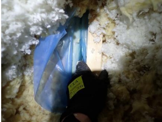
Kuva 32. Kohdassa ei havaittu suunnitelman mukaista teippausta eikä spu-vaahtoa. Mikäli ilmavirta liikkuu rakennuksen sisätiloja kohden, on mahdollista, että saumakohdassa tapahtuu ilmavuotoa.
