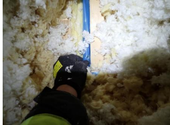
Kuva 33. Höyrynsulkumuovissa havaittiin niitin tekemä reikä. Höyrynsulussa ei ole teippausta, eikä suunnitelmien mukaista SPU-vaahtoa. Höyrynsulku on rullattu ristikoiden alapaarteen välissä.
