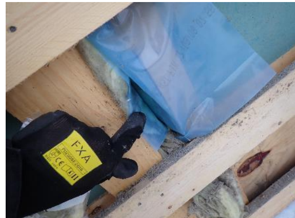
Kuva 25. Ulkoseinäelementin saumakohta avattu tilan 139 ulkopuolelta. Höyrinsulussa epätiiveyttä.
