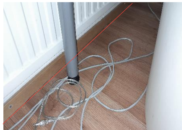
Kuva 6. Korotetun lattian ja ulkoseinän välisessä liittymässä merkittävää ilmavuotoa.
