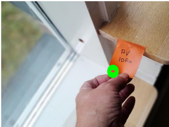
Kuva 12. Ikkunan alakarmien kulmissa pistemäistä ilmavuotoa alipaineistetussa tilassa.
