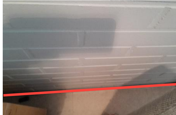
Kuva 11. Alapohjan ja ulkoseinän liittymän kohdalta pistemäistä ilmavuotoa normaalissa tilassa ja merkittävää alipaineistetussa tilassa.
