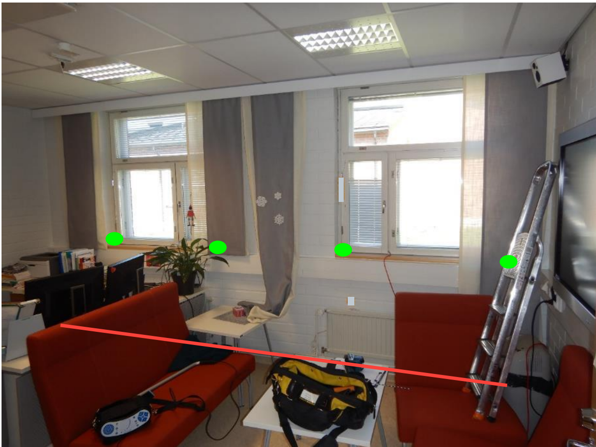
Kuva 3. Havaitut ilmvuodot 1191 tilassa. Vihreät ovat pistemäisiä ilmvuotoja alipaineistetussa tilassa, ikkunan alakarmien kulmissa. Punainen viiva on alapohjan ja ulkoseinän liittymässä havaittu merkittävä ilmvuoto.
