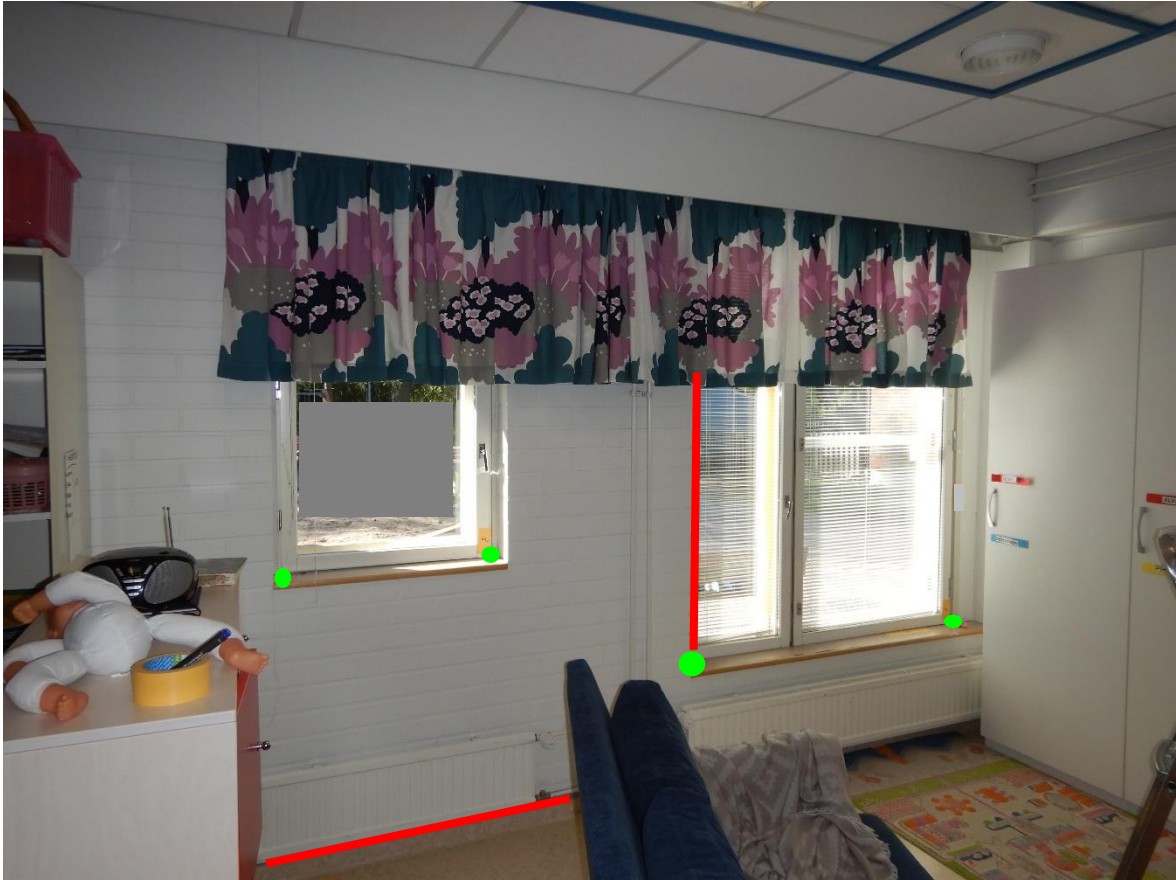
Kuva 17. Havaitut ilmapuotokohdat tilassa 1199. Vihreät värit ovat pistemäisiä ilmapuotoja ikkunakarmien kulmissa. Punaiset värit ovat merkittäviä ilmapuotoja ulkoseinän ja alapohjan liittymässä sekä ikkunan pystykarmin ja ulkoseinän välisessä liittymäkohdassa.
