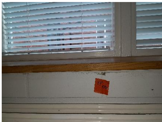
Kuva 5. Ikkunan alapuolella pieni halkeama, jossa merkittävää ilmavuotoa alipaineistettuna.
