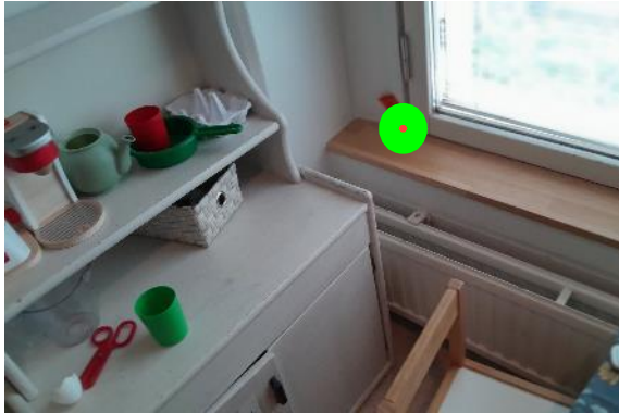
Kuva 10. Ikkunan alakarmien kulmissa pistemäistä ilmavuotoa normaalissa tilassa.
