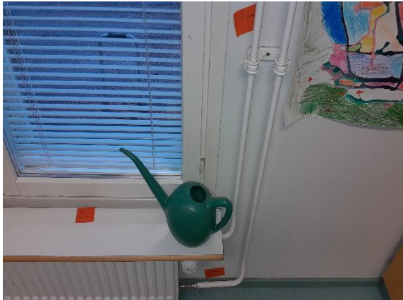
Kuva 26. Patterinkannakkeissa havaittiin piste-mäistä ilmavuotoa. Lattianrajassa myös vähäistä ilmavuotoa.
