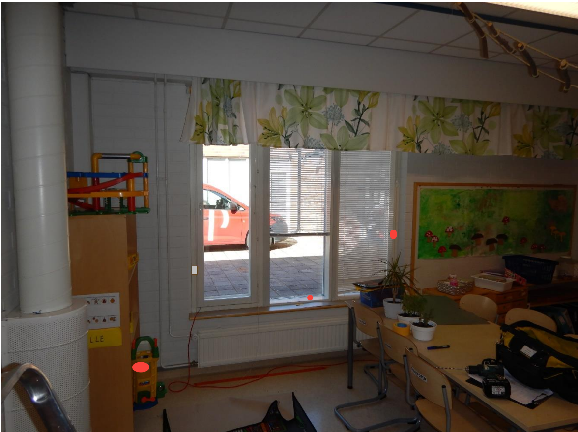
Kuva 15. Tilassa havaittiin merkittäviä ilmavuotoja (punaiset merkinnät), ikkunankarmeissa olevissa rei'issä, sekä sähkörasiassa.
