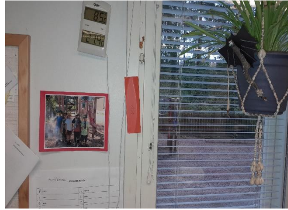
Kuva 25. Ikkunan pystykarmin keskialueella havaittiin vähäistä ilmavuotoa. Samassa kohden ikkunan yläkulmassa vähäistä ilmavuotoa karmien liittymäkohdalla.
