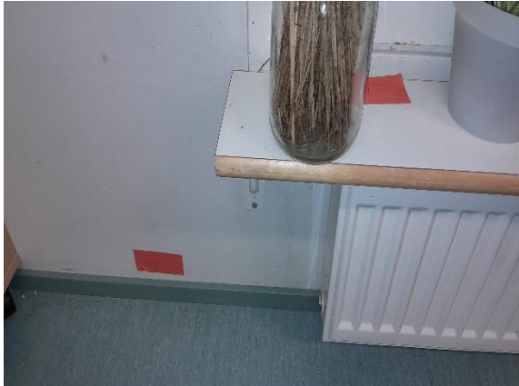
Kuva 24. Alapohjan ja ulkoseinän välisessä liittymässä havaittiin vähäistä ilmavuotoa.
