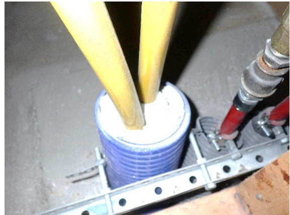
Kuva 5 Putkilpivienti tiivistetty. Vesiputkissa (punaiset putket) tiivistettä ei havaittu. Ei ilmavirtauksia tai hajuhavaintoja
