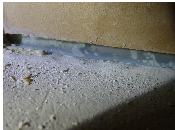
Kuva 7 Ulkoseinän höyrnsulku on katkaistu lattia tasolla. Höyrnsulkumuovia ei ole tiivistetty rakenteeseen.
