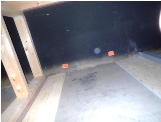
Kuva 4 Tuolivaraston väliseinän vuotohavaintoja. Takana luokkahuone
