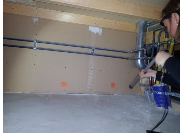
Kuva 3 Lyhyen päätyseinän ilmavuotohavaintoja
