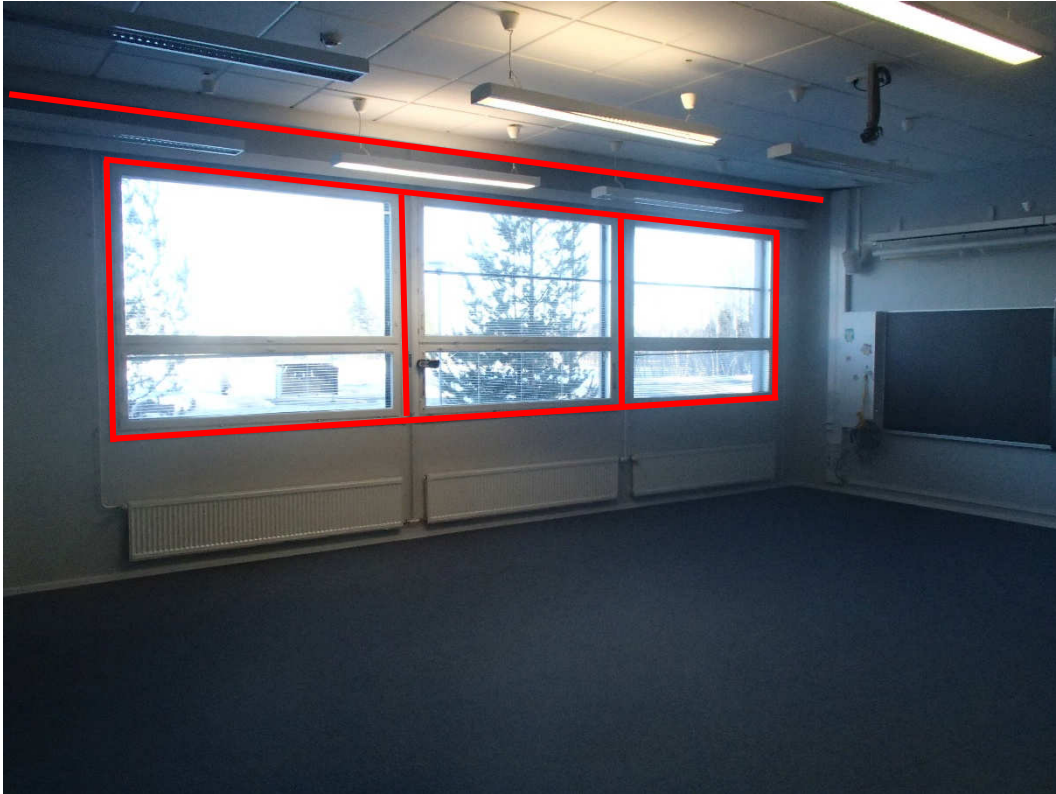
Kuva 19. Ilmavuotoja havaittiin ikkunoiden reuna-alueilla sekä seinän ja katon rajapinnalla.
