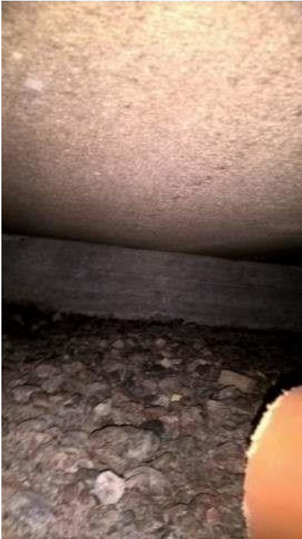
Kuva 15. Tuulensuojalevy on taipunut vassojen välissä.
