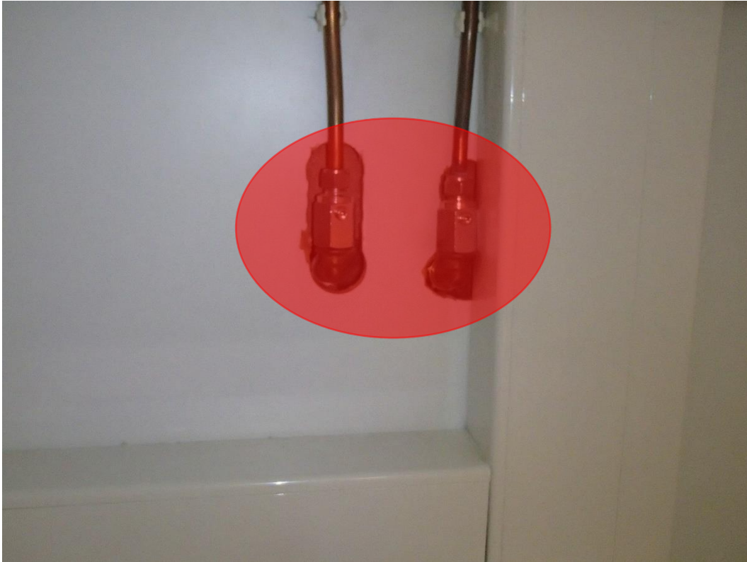
Kuva 13. Ilmavuotoja havaittiin käyttövesiputkien läpivientien kautta
