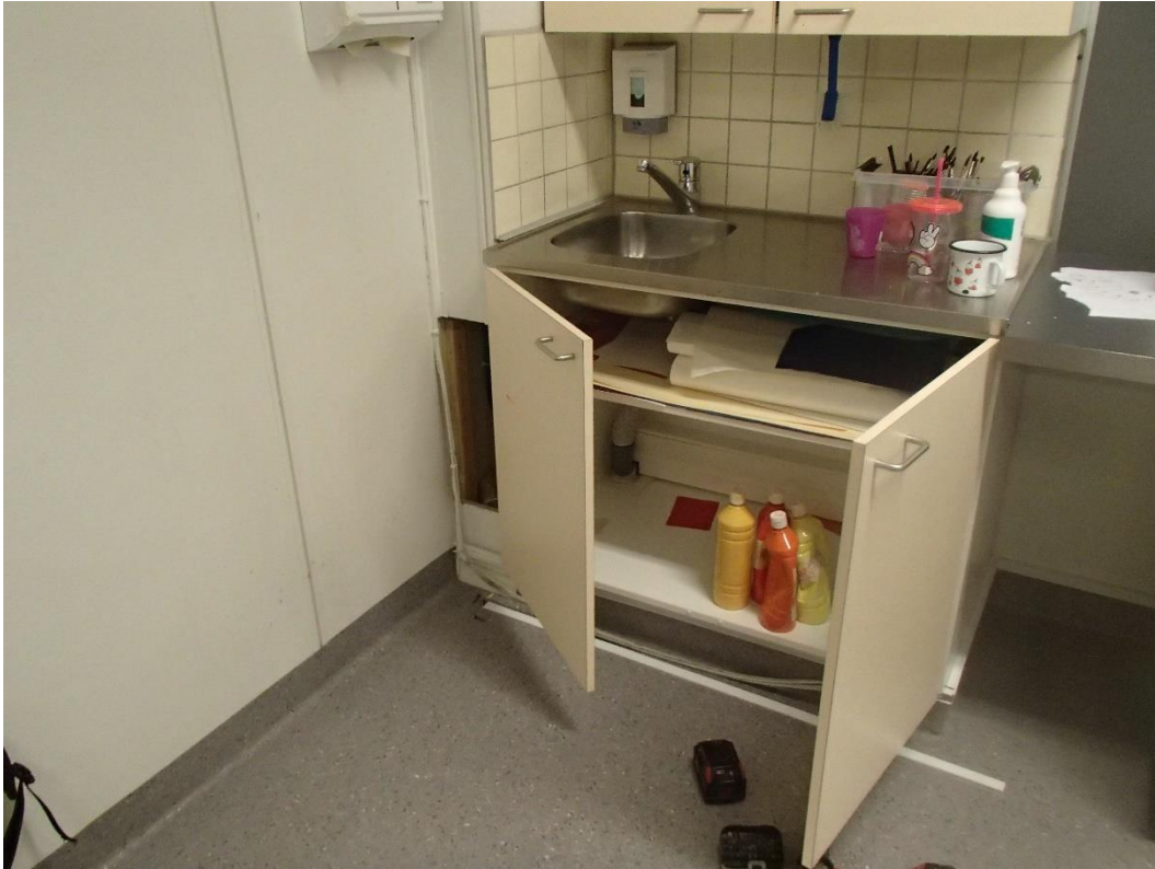
Kuva 11. Ilmavuotopaikkoja havaittiin vesipisteen alapohjan läpivientien kautta.
