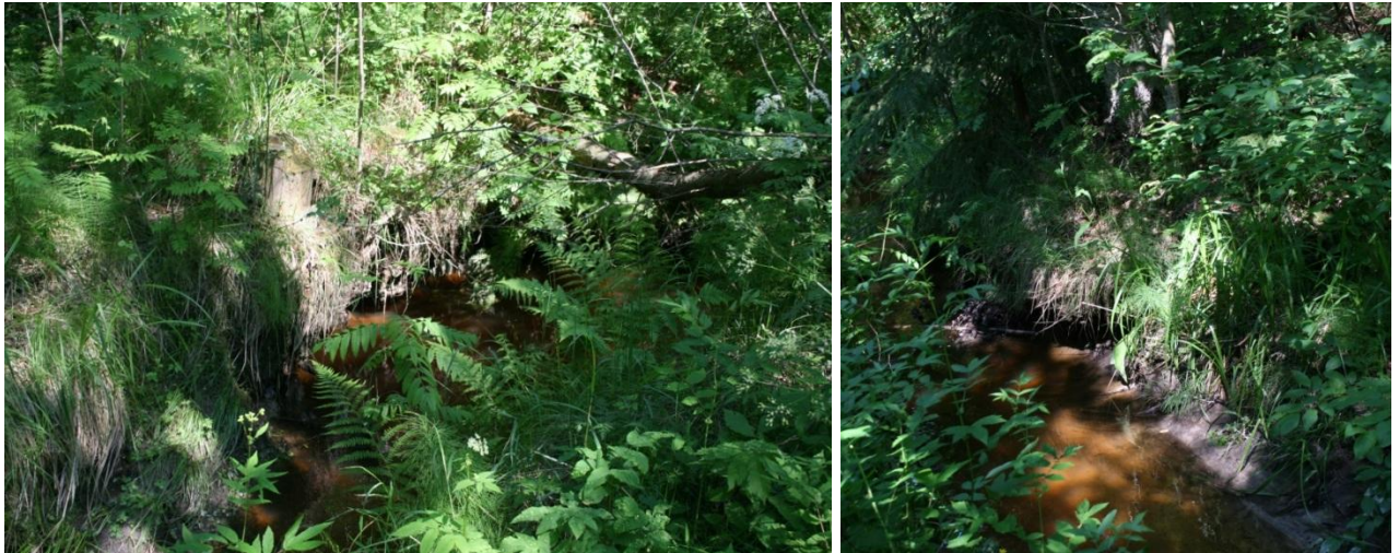
Kuva 5.18. Eroosio on syöpinnyt uoman syvämmäksi ja uoman penkat ovat syöpinneet alaosistaan.
