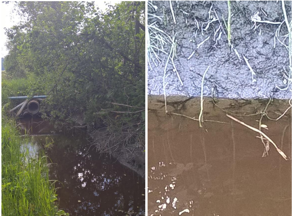
Kuva 5.26. a) Uomaan on asennettu liian pienet rummut, jotka ovat ylävirran puolelta täynnä roskaa. b) Uoman pohjassa on mustaa tuntematonta likaa ja veden väri on koko purossa erikoinen.
