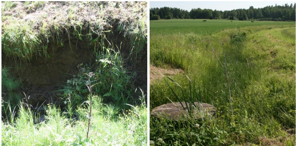
Kuva 5.5. a) Pellon reuna on syöpynyt uoman haaran kohdalta. b) Uoma jatkaa putkitetun osuuden jälkeen avo-ojana peltoaukealla.
