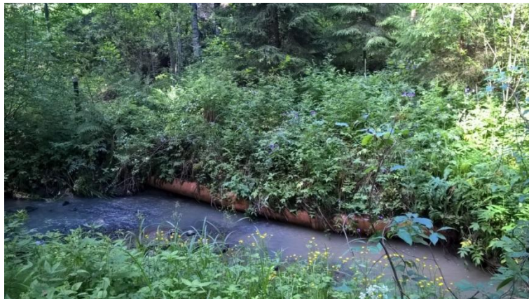
Kuva 6.17. Myös maahan upotettu putki oli syöpynt osittain esiin uoman siirtyessä.
