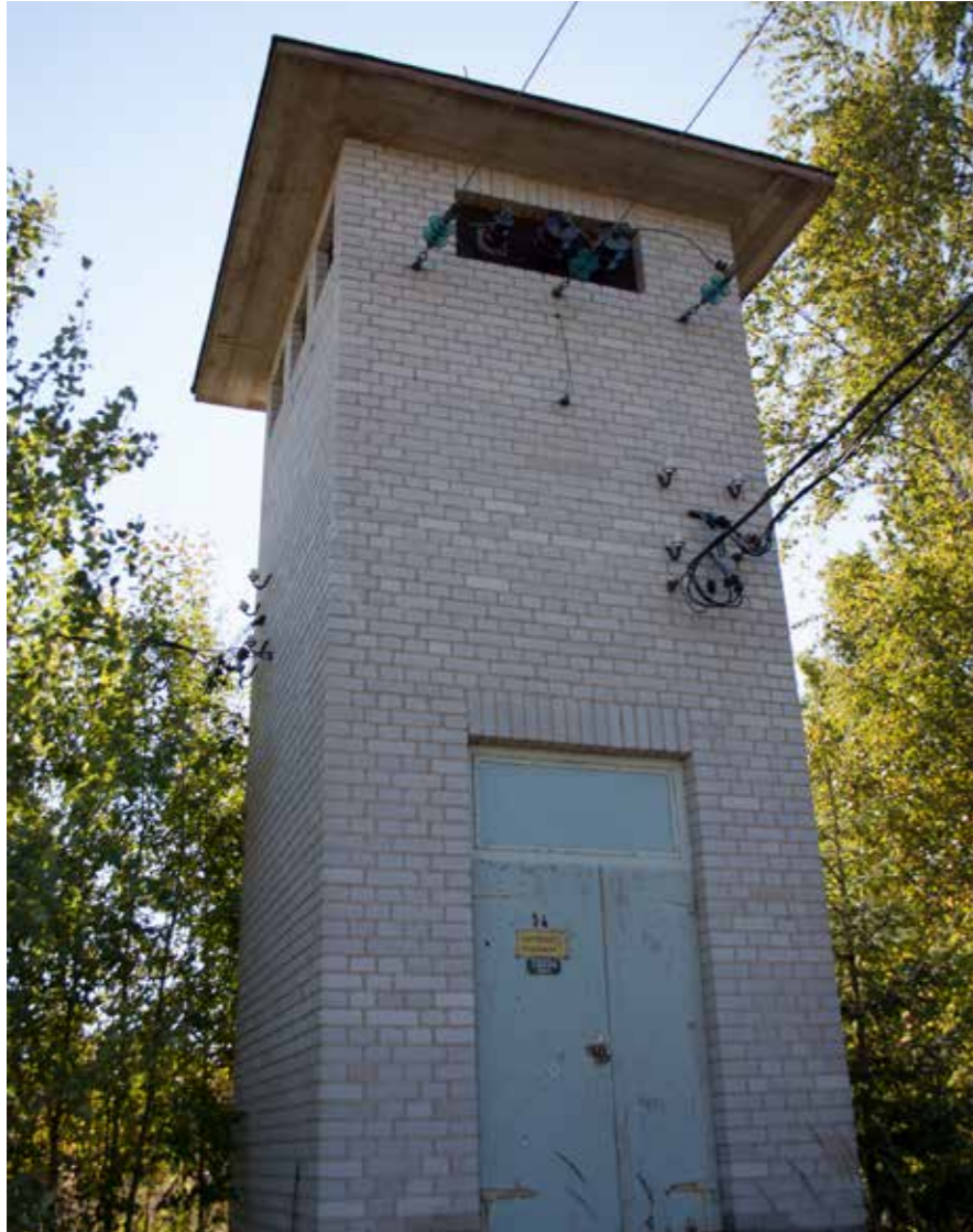
252 Vaasan yksityistie Revenneen ja Palaneenkallion välillä muuntamotorni.
