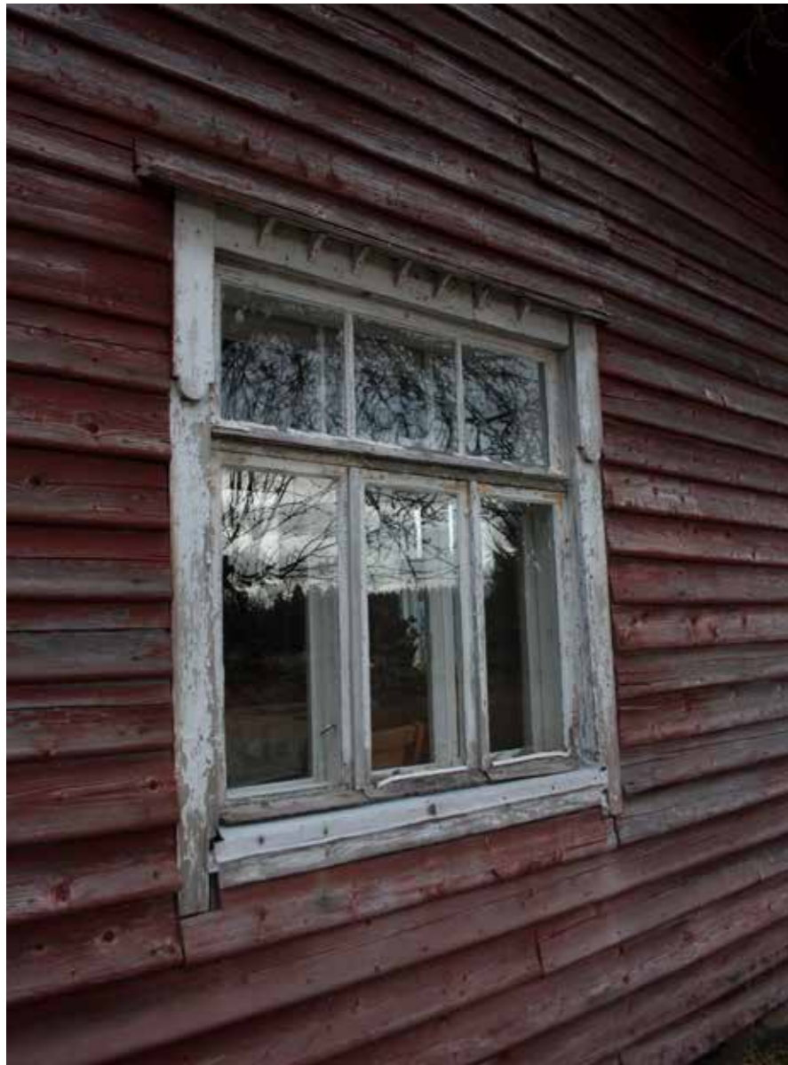
147 Talon ulkoverhous on tyypillinen 1950-luvun mutta ikkunan verholaudat ja vesilauta koristeineen ovat nikkarivaikutteista 1910-lukua.
