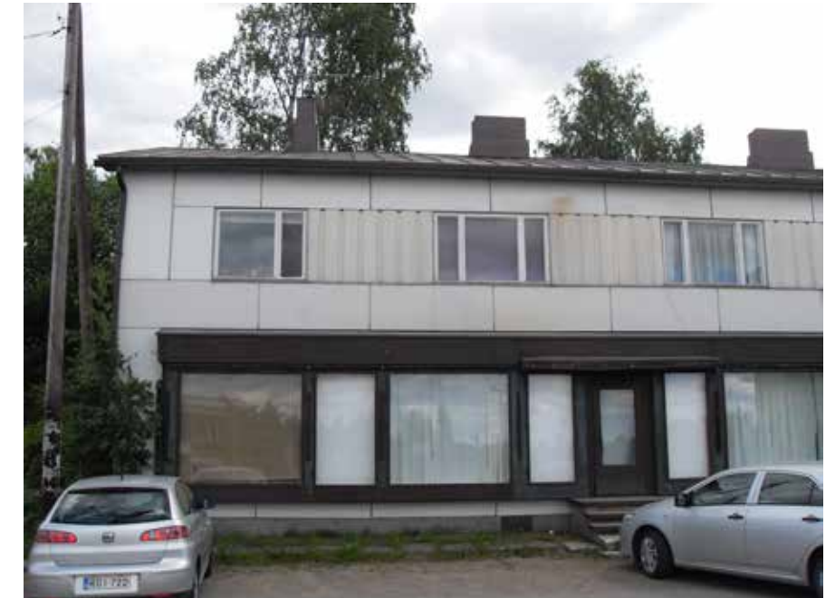
Haikosen kirjakauppa muodistettiin 1960-luvulla lisäämällä suuret näyteikkunat ja verhoilemalla julkisivu ajalle ominaisilla pelti- ja mineriittilevyillä. Lopputulos ei ole kestänyt aikaa.
