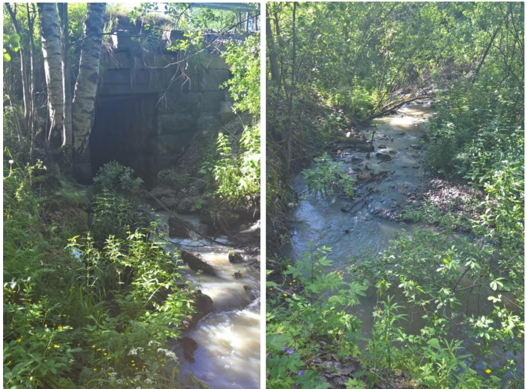
Kuva 6.13. a) Kivirumpu Vanhan valtatieen alla. b) Uoma jatkuu vaihtelevana alavirtaan.
