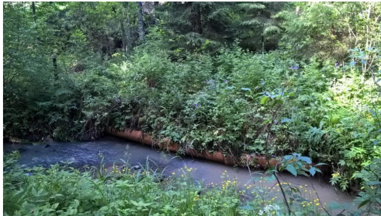
Kuva 6.17. Myös maahan upotettu putki oli syöpynyt osittain esiin uoman siirtyessä.
