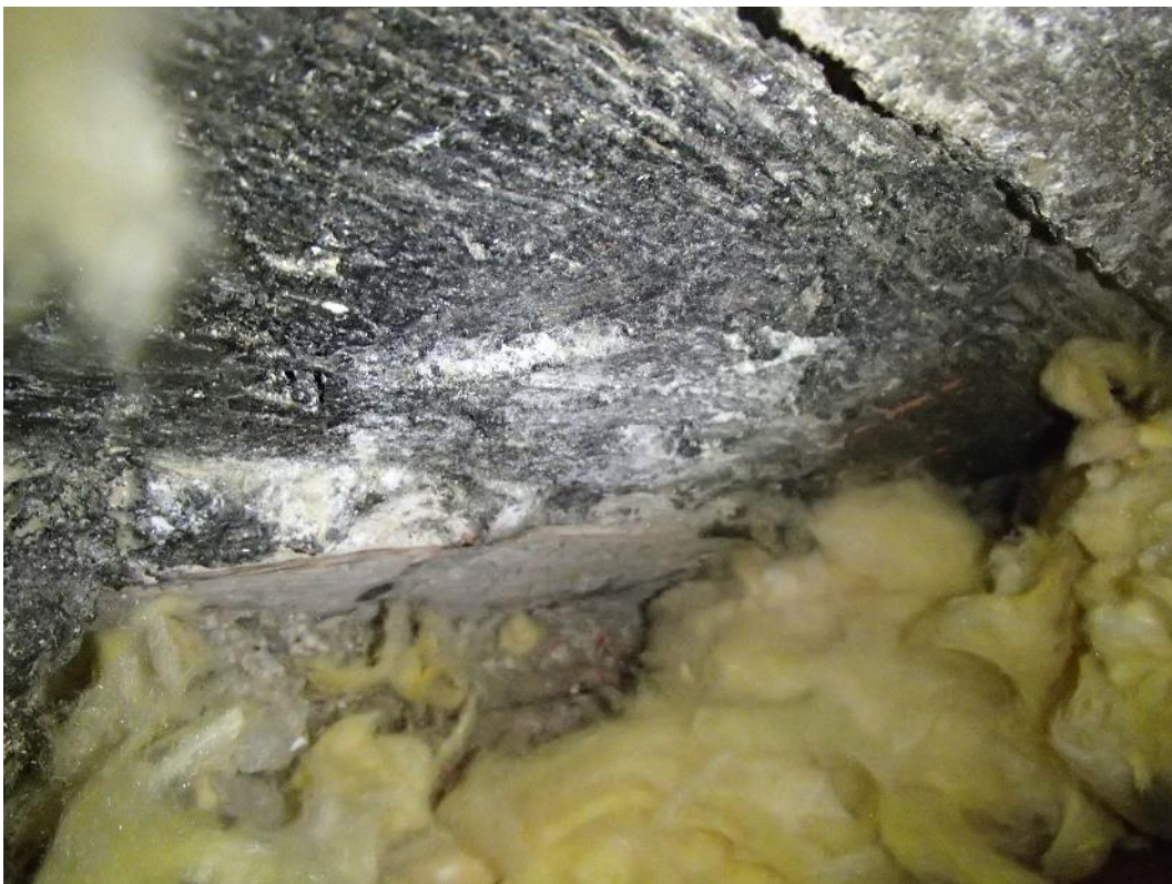
Kuva 3. Sokkelin sisäpinnassa havaittiin kalkkihärmekertymiä.
