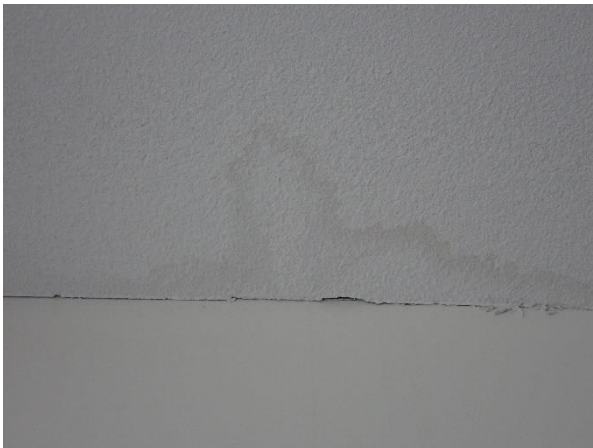
Kuva 2: Opinto-ohjaajan toimiston (166) katossa kosteusjälkiä.
