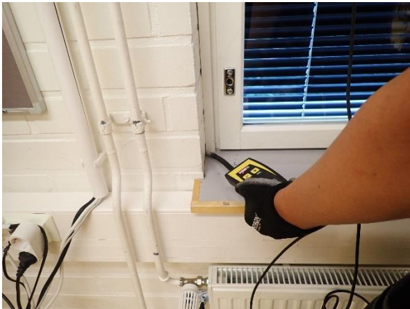
Kuva 30: Luokka L22: merkkiainetutkimuksessa ilmavuotoa ikkuna- ja seinäliittymistä.
