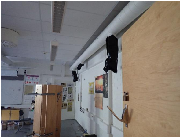
Kuva 20: Auditorio oli alipaineinen noin -25 Pa viereiseen käytöstä poistettuun luokkaan (1.044) nähden.
