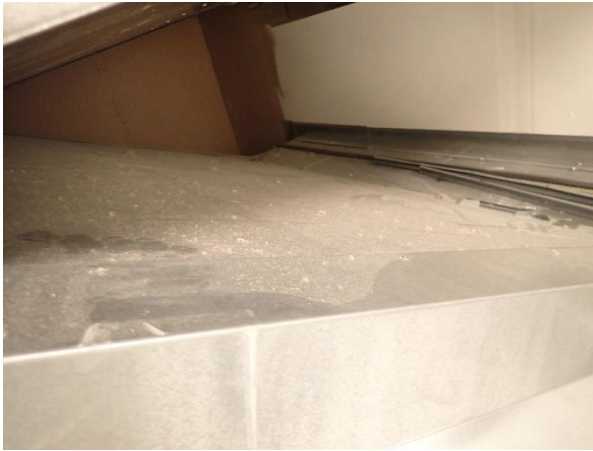
Kuva 22: Ilmanvaihtokonehuoneessa pölykertymää koneiden ja kanavien päällä.
