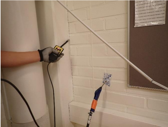
Kuva 32: Luokka L22: merkkiainetutkimuksessa havaittiin ilmavuotoa ulkoseinä- ja pilariliittymistä.
