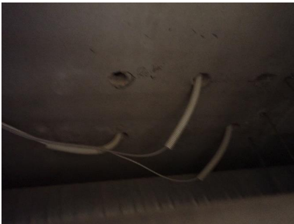
Kuva 9: Alakattotilasta on avoimia läpivientejä yläpohjaan.
