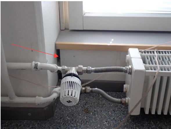
Kuva 6: Opinto-ohjaajan toimistossa (166) ulkoseinärakenne ei ole tiivis.
