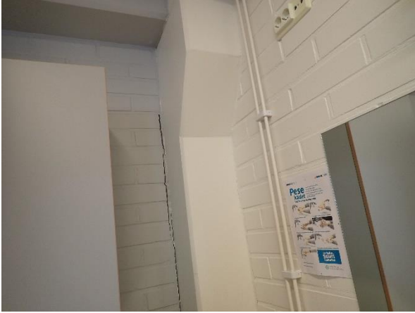
Kuva 4: Rakenteiden liitoksissa halkeilua.
