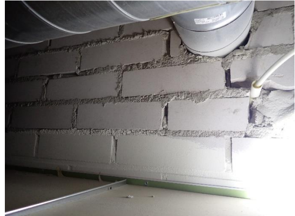
Kuva 8: Alakattotilassa maalaamatonta tiilipintaa, josta aiheutuu betonin hajua.
