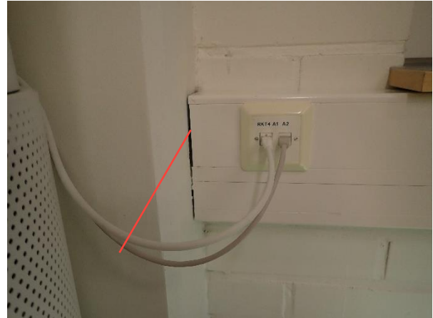
Kuva 12: L23 luokassa sähkökoteloinnissa havaittavissa mineraalivillaa.
