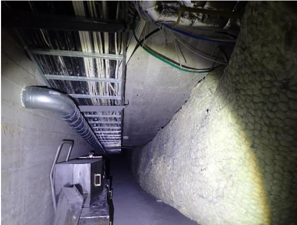
Kuva 18: Auditorion alaosan tekniikkahormissa pinnoittamatonta mineraalivillaputkieristettä.
