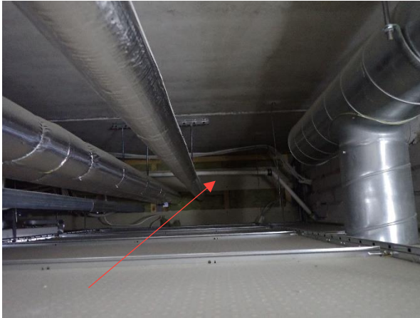
Kuva 7: Alakattotilassa paljaita mineraalivillapintoja.
