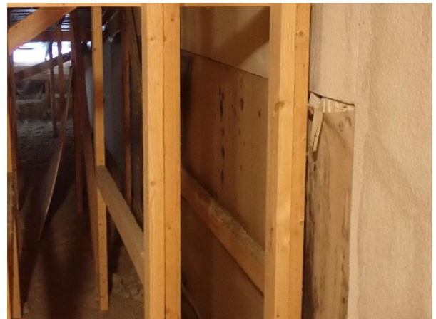
Kuva 3: E-siiven yläpohjassa paikoin veden valumajälkiä (opo:n huoneen kohdalla).
