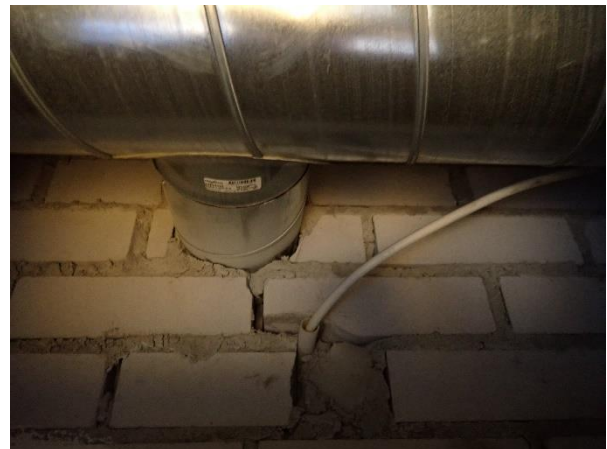
Kuva 10: Alakattotilassa on epätiivitä läpivientejä luokkiin.
