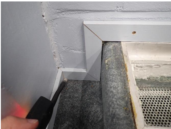
Kuva 34: Auditorio: paikoin ilmavuotoa väliseinä- ja välipohjaliittymistä alapuolen tekniikkatunnelista.
