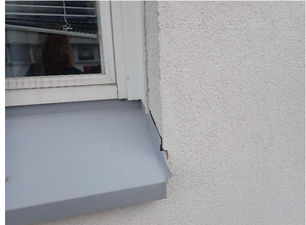
Kuva 25: Rakennuksen ulkopuolella ikkunapellityksien liittymät eivät ole tiiviitä.
