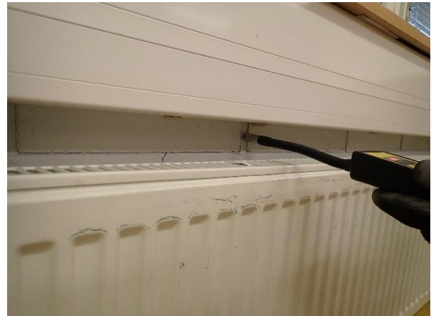
Kuva 31: Luokka L22: merkkianetutkimuksessa ilmavuotoa tiiliseinän halkeamista.
