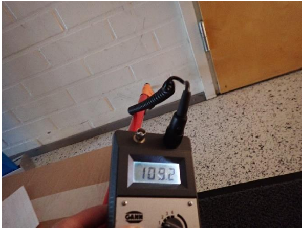
Kuva 26: Auditorion kohdalla käytävän puolella seinän alaosassa kosteuspoikkeamaa.
