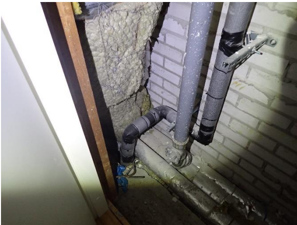
Kuva 16: Auditorion etuosan tekniikkahormissa paljaita mineraalivillapintoja ja rakennusjätteitä.
