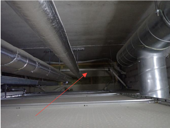
Kuva 7: Alakattotilassa paljaita mineraalivillapintoja.
