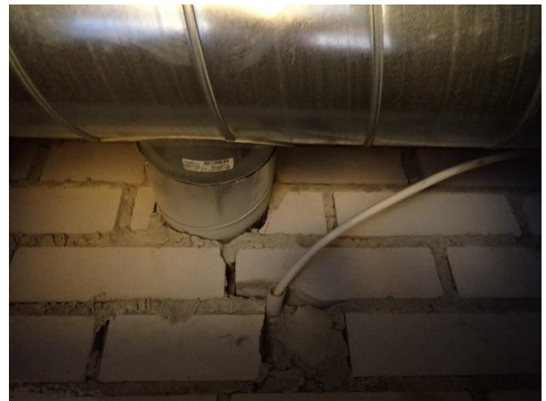
Kuva 10: Alakattotilassa on epätiivittä läpivientejä luokkiin.
