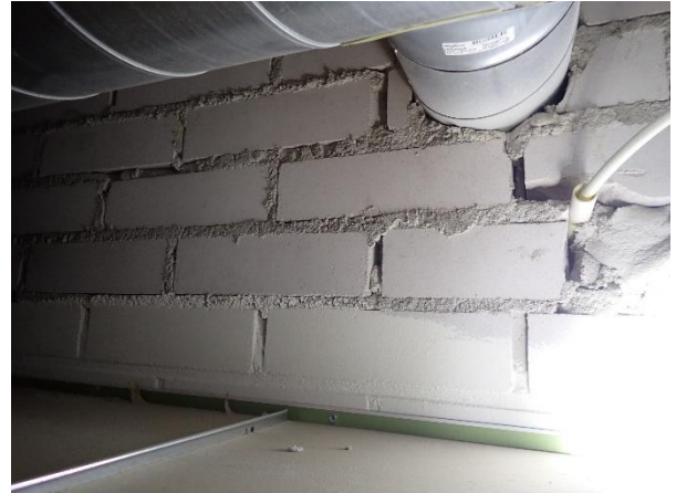
Kuva 8: Alakattotilassa maalaamatonta tiilipintaa, josta aiheutuu betonin hajua.
