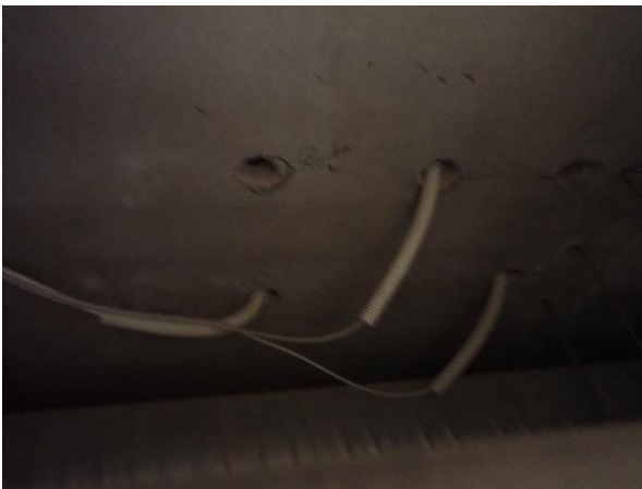
Kuva 9: Alakattotilasta on avoimia läpivientejä yläpohjaan.
