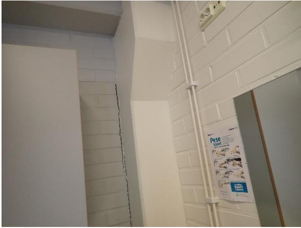
Kuva 4: Rakenteiden liitoksissa halkeilua.
