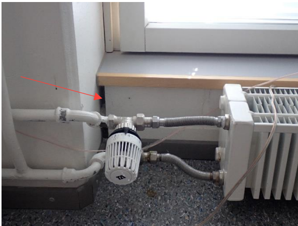
Kuva 6: Opinto-ohjaajan toimistossa (166) ulkoseinärakenne ei ole tiivis.
