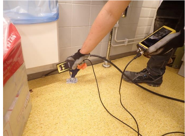
Kuva 33: L25: merkkiainetutkimuksessa havaittiin ilmavuotoa alapohja- ja väliseinäliittymistä ja viemäriämpivienneistä.
