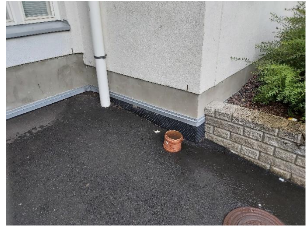
Kuva 23: Rakennuksen ulkopuolella, opinto-ohjaajan toimiston edessä avoin sadevesiputki (täynnä vettä). Onko käytöstä poistettu?
