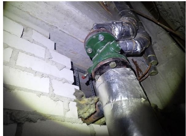
Kuva 17: Auditorion etuosan tekniikkahormissa avoimia läpivientejä.
