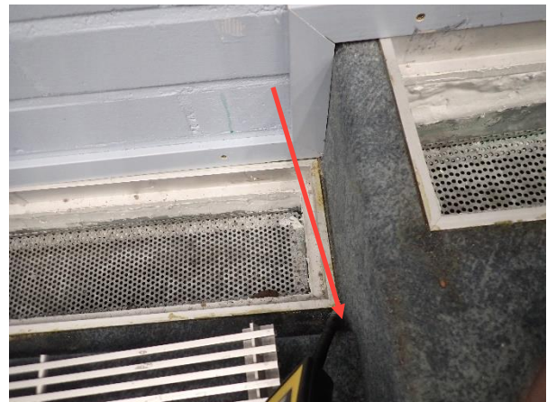
Kuva 35: Auditorio: paikoin ilmavuotoa tuloilmapäätelaitteiden ja välipohjaliittymistä alapuolen tekniikkatunnelista.
