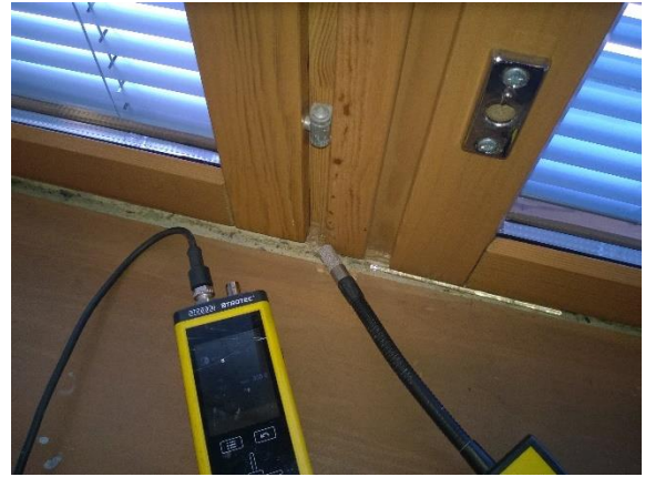
Kuva 13: Ikkunalaudoitusten alta havaittiin myös vuotoa.
