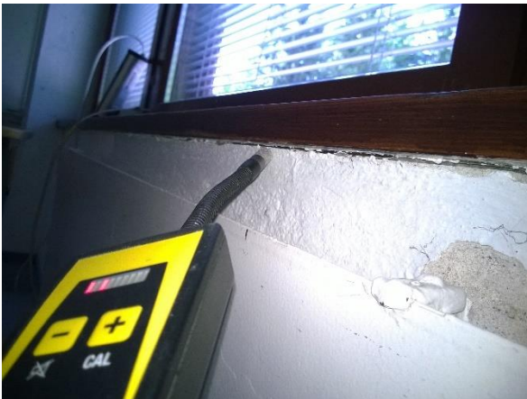
Kuva 22: Vuotoa tilan 6 ikkunaliittymistä, kun tilat alipaineistettiin.
