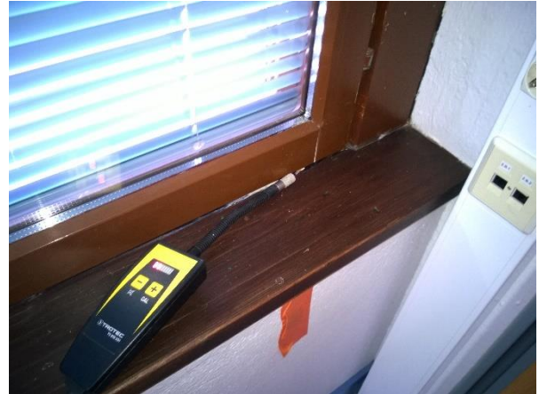
Kuva 21: Vuotoa tilan 6 ikkunaliittymistä, kun tilat alipaineistettiin.
