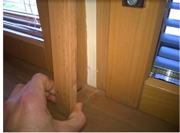
Kuva 11: Vuoden 2006 rakennetun osan ikkunaliittymät on tiivistetty elastisella saumamassalla.
