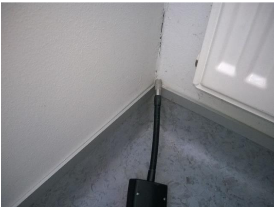
Kuva 14: Uuden osan lattia-seinäliittymissä havaittiin vuotoa nurkkakohdilla, jossa muovimaton ylösnoston liimaus ei ole tiivis.
