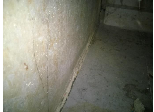
Kuva 7: Teknisen tilan lattia-seinäliittymä on avoin, josta maaperän epäpuhtaudet kulkeutuvat sisäilmaan.
