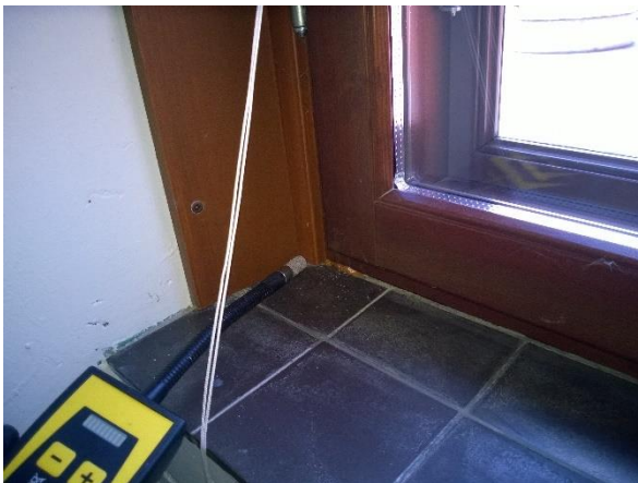
Kuva 18: Selvää merkkiainevuotoa ikkunalistoitusten alta.
