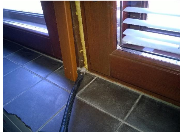
Kuva 17: Tilan ikkunaliittymät ovat epätiivitä.
