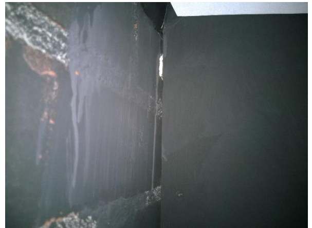
Kuva 5: Koteloinnin ja sitä ympäröivien seinärakenteiden liittymät ovat epätiivisiä.
