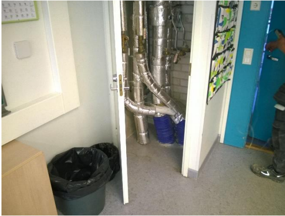
Kuva 6: Tilan 91 tekninen tila, jossa lämpöjohtoja.
