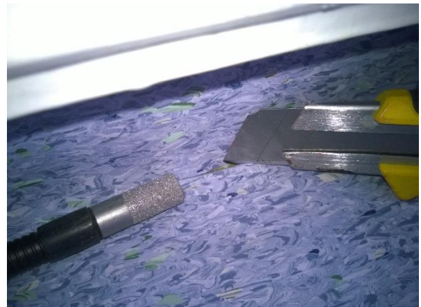
Kuva 19: Alapohjan rakenneliittymät tiiviitä, nurkkaliittymiä lukuun ottamatta. Muovimaton alla liittymissä selvä rako.
