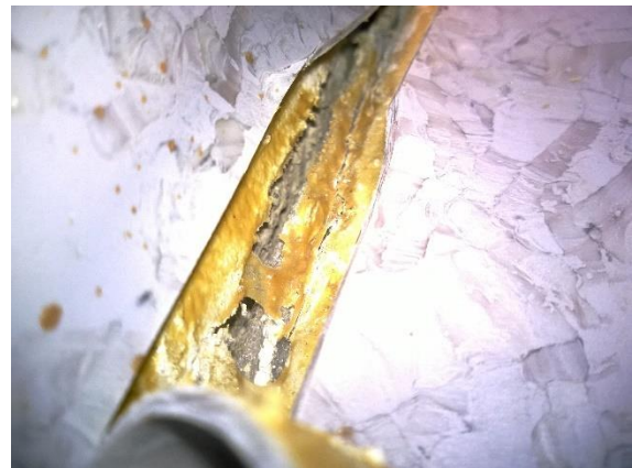
Kuva 15: Muovimaton alla alapohjan ja seinän liittymissä selvä rako.
