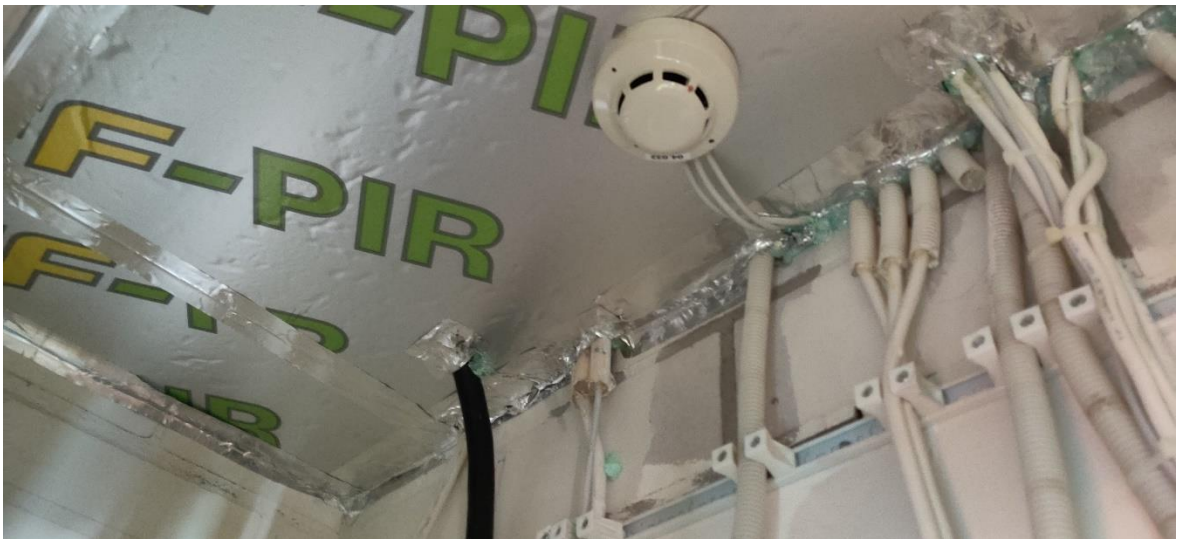
Kuva 24 Sähkökeskuksen välipohjaan asennettu alumiinilaminoitu polyuretaanilevy, joka on teipattu seinää vasten alumiiniteipillä
