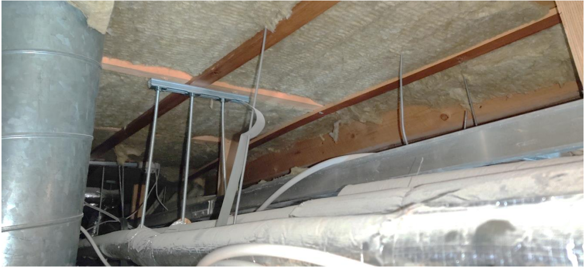
Kuva 23 Välitilassa on runsaasti pölyä
