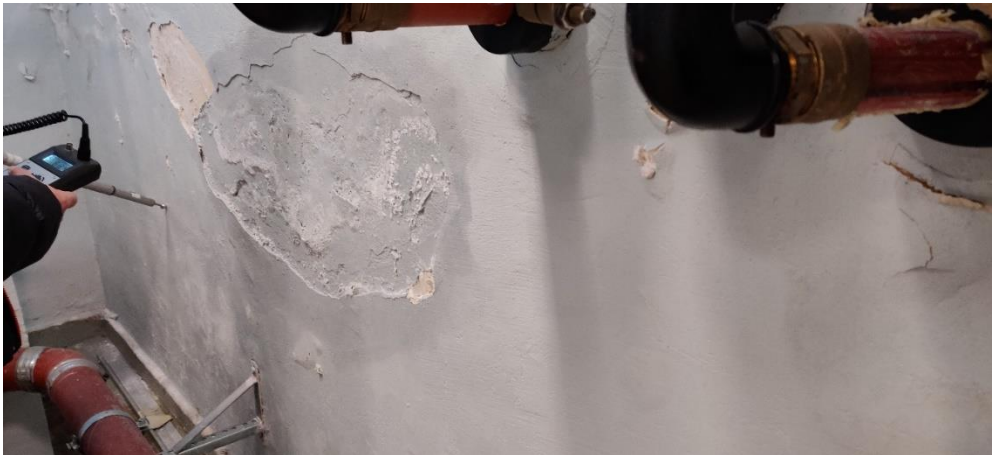
Kuva 29 Maapaineseinän kosteusvauriot vaakasuuntaan noin 80 - 100 cm lattiasta
