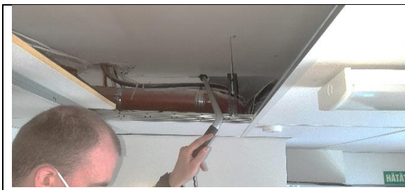
Kuva 18 Alaslaskukaton välitilassa havaittiin merkkiainetta
