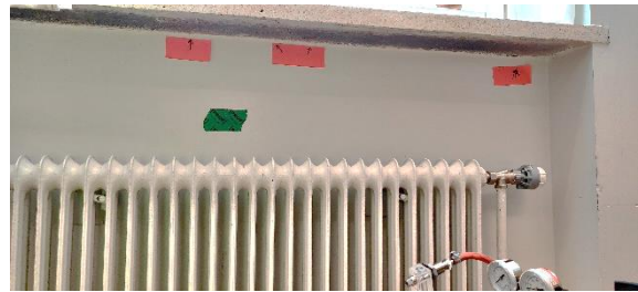
Kuva 7 Ikkunalaudan alapuolen ilmavuotoja
