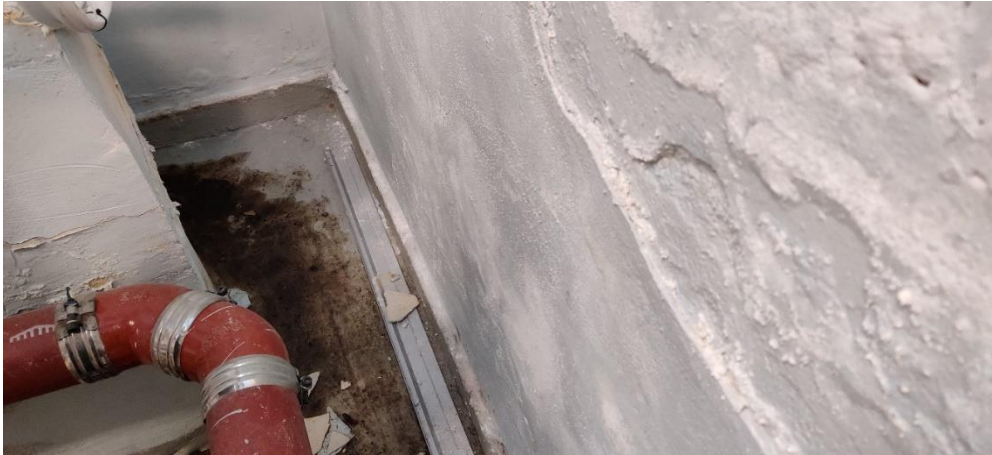
Kuva 28 Pumppuhuoneen lattia vanhoja kosteusjälkiä
