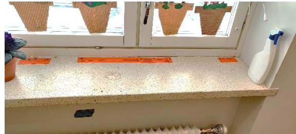
Kuva 5 Ikkunalaudan yläosan vuodot karmiliittymistä
