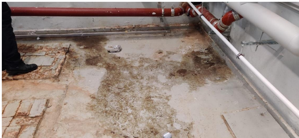
Kuva 27 Pumppuhuoneen 002 lattialla kosteusjälkiä ja paikoin vapaata vettä
