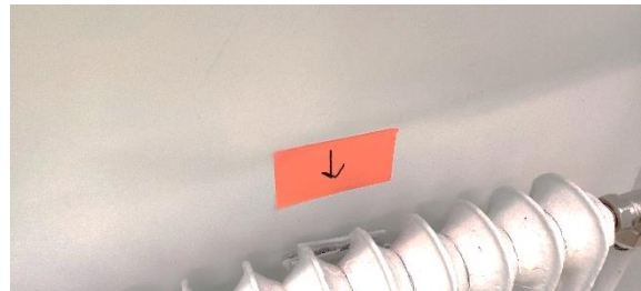
Kuva 9 Patterin kiinnityksen ilmavuoto kannakkeessa
