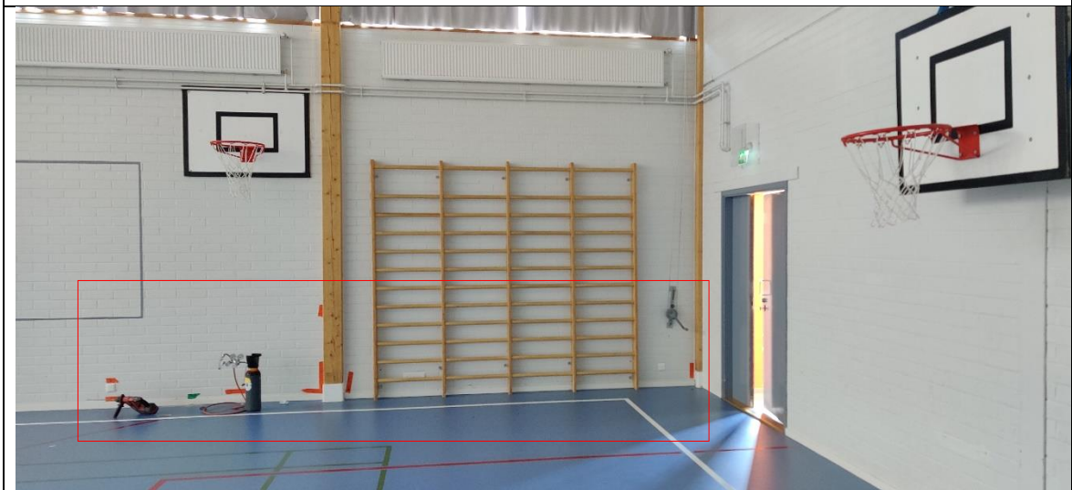
Kuva 2 Oikea sivu. Ilmavuotoja pilariliittymät, -sivut, sähkörasia ja pilarien sivut sekä kulma
