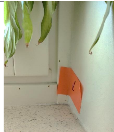
Kuva 14 Alakulman ilmavuotokohta. Näkyviä rakoja
