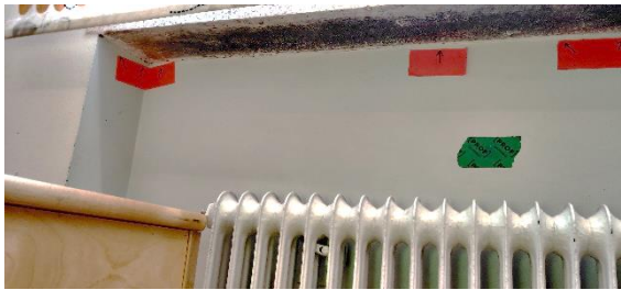
Kuva 6 Ikkunalaudan alapuolen liittymävuotoja
