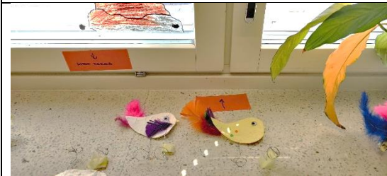
Kuva 13 Ikkunan keskiosassa karmin liittymän vuotokohta
