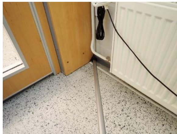
Kuva 8. Normaalitilassa ja alipaineistettuna havaittiin vähäistä ilmavuotoa siirtoseinän ja ulkoseinän liittymän alaosassa.
