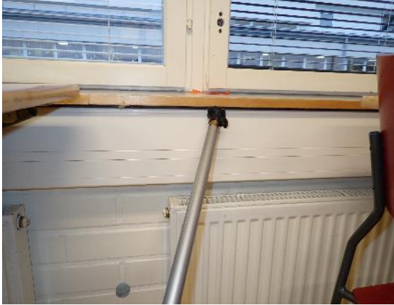
Kuva 10. Normaali ja alipaineistetussa tilassa havaittiin merkittävää ilmavuotoa ikkunalaudan alta.
