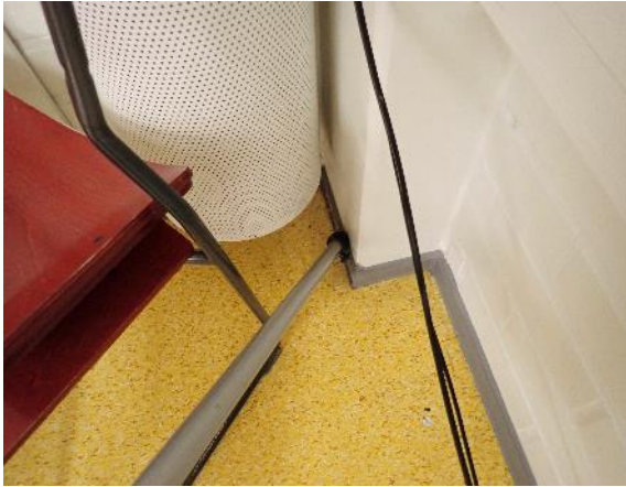
Kuva 17. Normaalisti / alipaineistettuna , pilarin juuressa merkittävää vuotoa.
