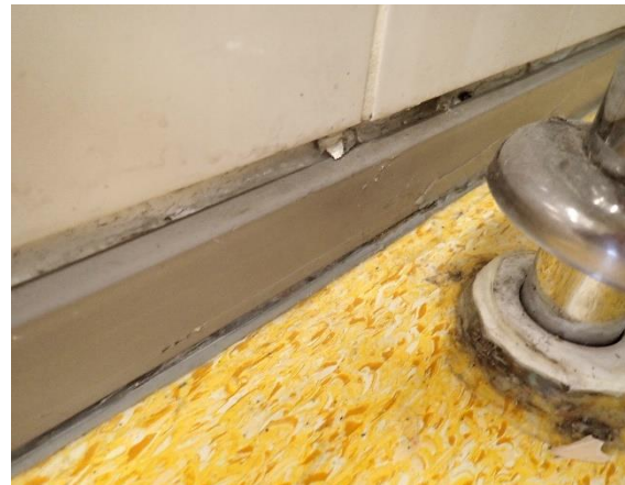
Kuva 27. Lavuaarin läpivienti on silmämääräisesti katsottuna epätiivis, samoin lattialistan alue.
