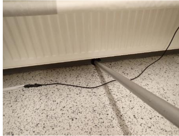
Kuva 4. Normaalitilassa havaittiin vähäistä ja alipaineistettuna havaittiin merkittävää ilmavuotoa alapohjan ja ulkoseinän liittymässä.
