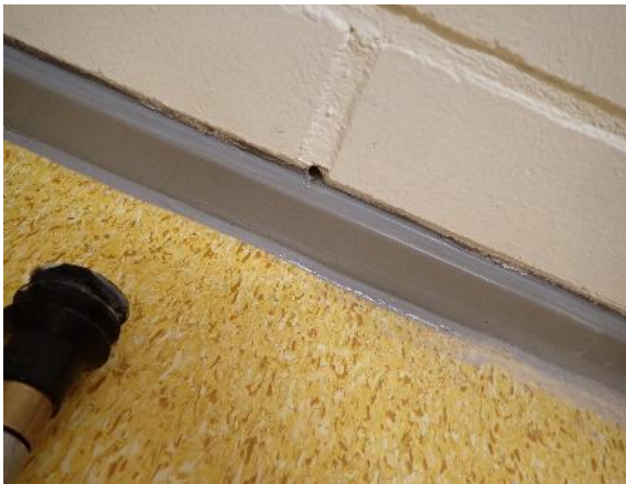
Kuva 14. Normaali ja alipaineistetussa tilassa havaittiin merkittävää ilmavuotoa listan yläpuoleisessa reiässä tiilimuurauksessa.
