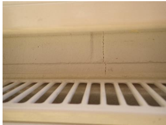
Kuva 15. Normaali ja alipaineistetussa tilassa havaittiin merkittävää ilmavuotoa muurauksen halkeamassa.
