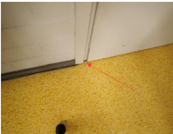
Kuva 21. Normaalisti / alipaineistettuna , muovimaton halkeamassa merkittävää ilmavuotoa.
