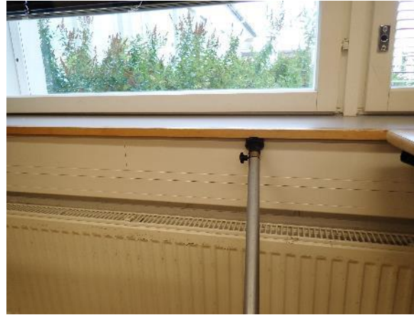
Kuva 18. Normaalisti / alipaineistettuna ikkunan alaosassa havaittiin merkittävää vuotoa n. 2000 mm matkalla.
