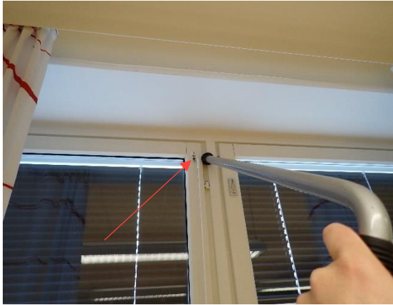
Kuva 29. Normaalissa ja alipaineistettuna ikkunan sälekaihtimen säätimen läpiviennin kohdalla merkittävää ilmavuotoa.
