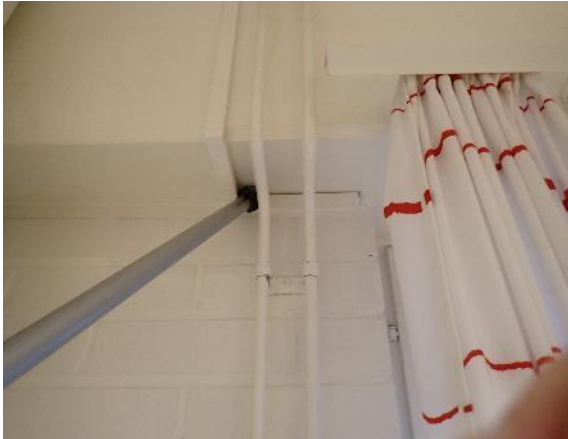
Kuva 12. Normaali ja alipaineistetussa tilassa havaittiin merkittävää ilmavuotoa sähkökotelon taustapinnalla.
