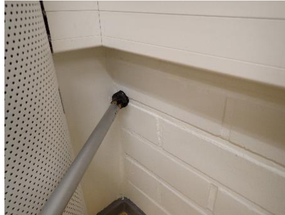
Kuva 13. Normaali ja alipaineistetussa tilassa havaittiin merkittävää ilmavuotoa tiivistysnauhan kohdalla, tiilimuurauksen saumoissa.
