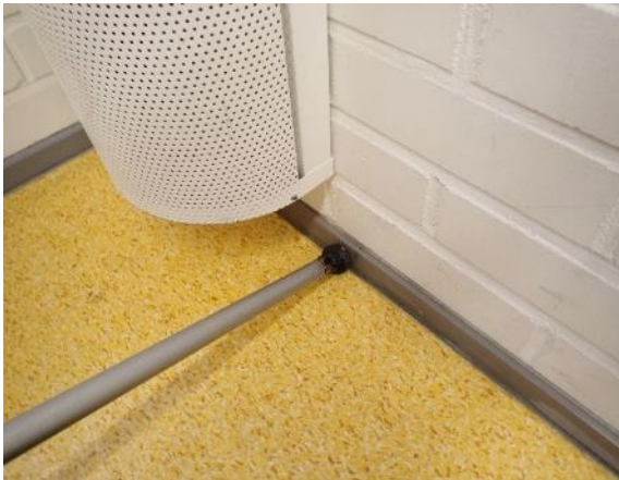
Kuva 19. Normaalisti / alipaineistettuna , pilarin juuressa ja väliseinän ja alapohjan liittymässä merkittävää ilmavuotoa.
