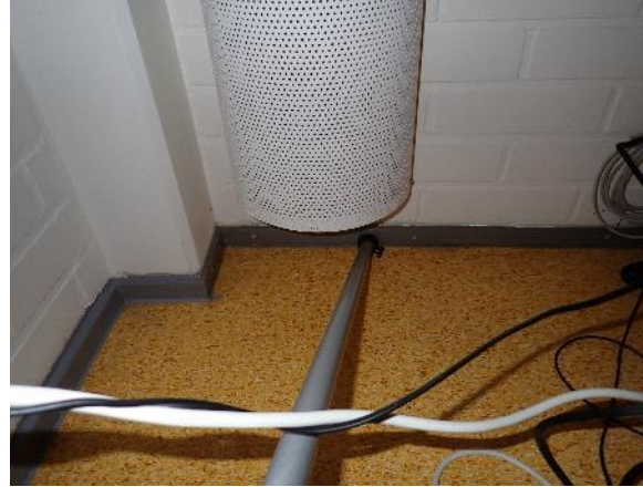
Kuva 11. Normaali ja alipaineistetussa tilassa havaittiin vähäistä ilmavuotoa pilarin ja alapohjan liittymässä sekä väliseinän ja alapohjan liittymässä.
