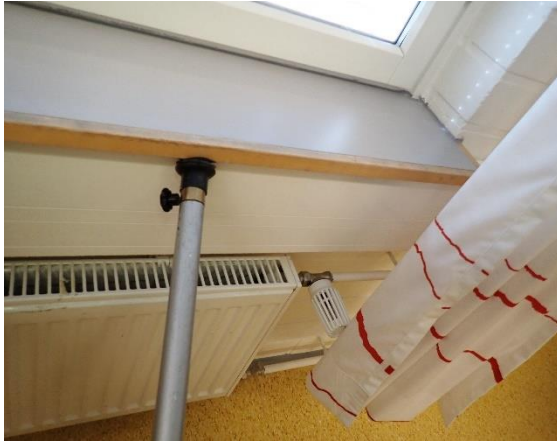
Kuva 24. Normaalisti / alipaineistetussa tilassa, merkittävää ja vähäistä ilmavuotoa ikkunalaudan alapuolella.
