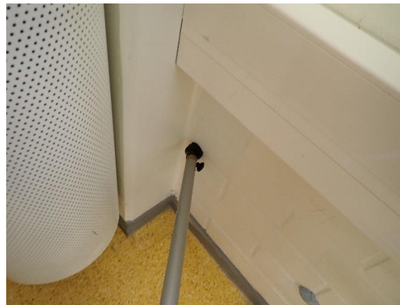
Kuva 32. Normaalissa ja alipaineistettuna pilarin ja ulkoseinän liittymän tiivistysnauhan kohdalla merkittävää ilmavuotoa.
