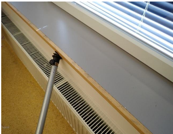
Kuva 31. Normaalissa / alipaineistetussa tilassa, ikkunalaudan alapuolella merkittävää vuotoa.
