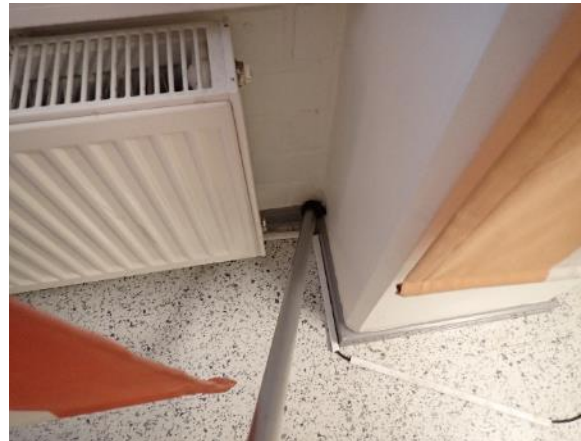
Kuva 6. Normaalitilassa ja alipaineistettuna pilarin liittymässä havaittiin vähäistä ilmavuotoa.
