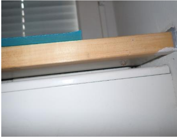
Kuva 3. Normaalitilassa ja alipaineistettuna havaittiin merkittävää ilmavuotoa ikkunalaudan alapuolelta.
