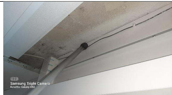
Kuva 15 Seinän levytys on auki katonrajasta. Merkkiaine virtaa alakattorakenteeseen.
