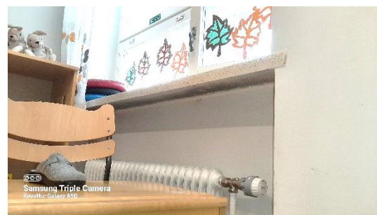
Kuva 9 Toisen ikkunan tiivistys on samankaltainen.
