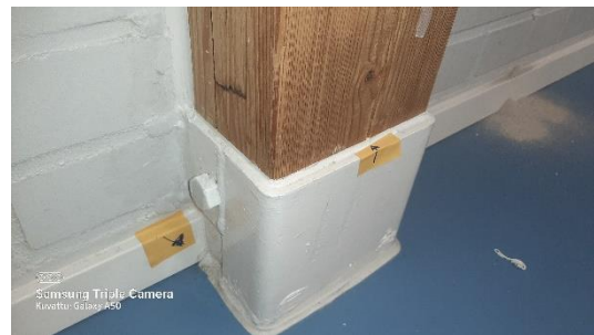
Kuva 3 Pilari 2 lattia-ajan kulmassa pistemäinen vuoto. Pilarin halkeamassa pistemäinen vuoto. Tiivistystyö on tehty hyvin.
