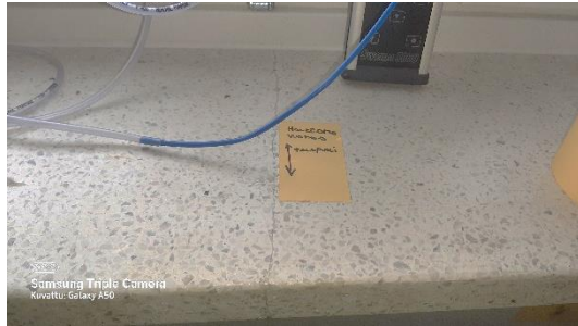
Kuva 11 Ikkunalaudassa halkeama, jossa havaittiin ilmavuotoa
