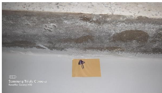
Kuva 13 ikkunalaudan halkeaman alapuolen kohdalla ilmavuotoa.
