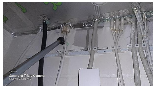
Kuva 6 Merkkiainevuotoja havaittiin läpivienneistä ja sähköputkien kautta.
