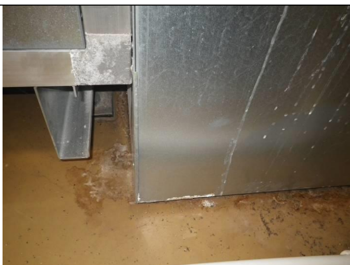
10. IV-koneen pinnan ja lattian valumajälkiä
