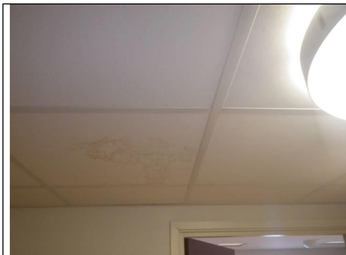
1. Sisäkaton levyn kosteusjälkiä
