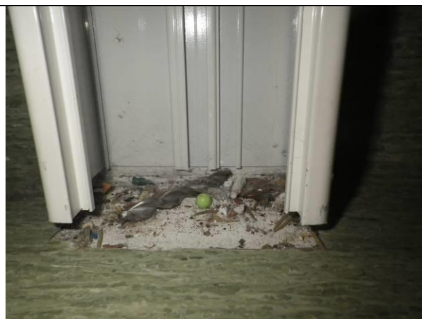
15. Johtimien kotelo lavan taustalla, lattiataso
