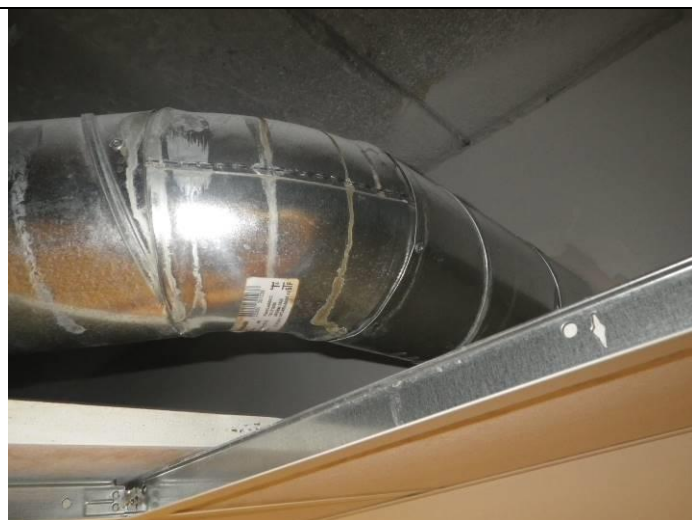
2. Valumajälkiä alaslasketun katon yläpuolisen kanavan pinnalla
