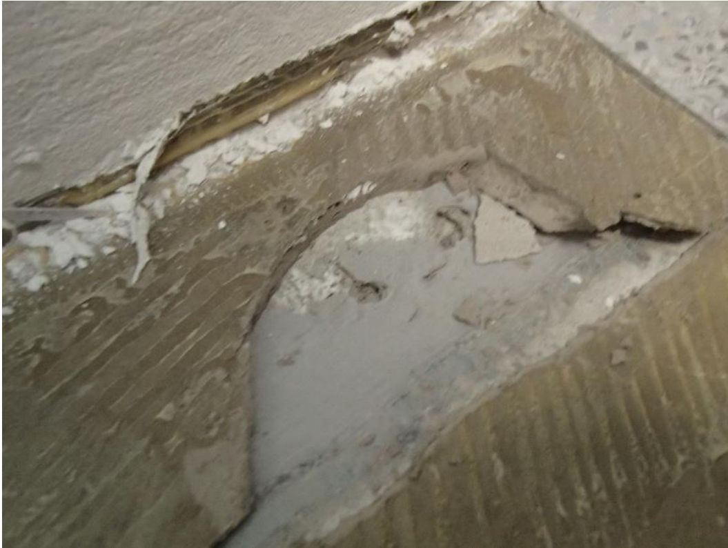
Kuva 3. Tasoitteet ovat irronneet pohjastaan elastisten saumamassojen päältä.
