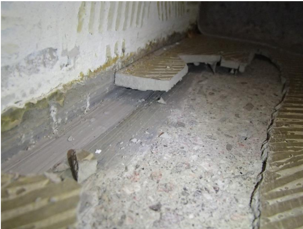
Kuva 2. Tasoitteet ovat irronneet pohjastaan elastisten saumamassojen päältä.
