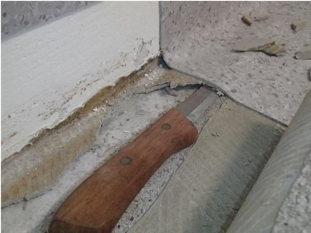
Kuva 4. Tasoitteiden irtoaminen pohjastaan on aiheuttanut muovimattojen poimuuntumista lattioiden ja seinien kulmissa sekä liikuntasauvojen läheisyydessä.
