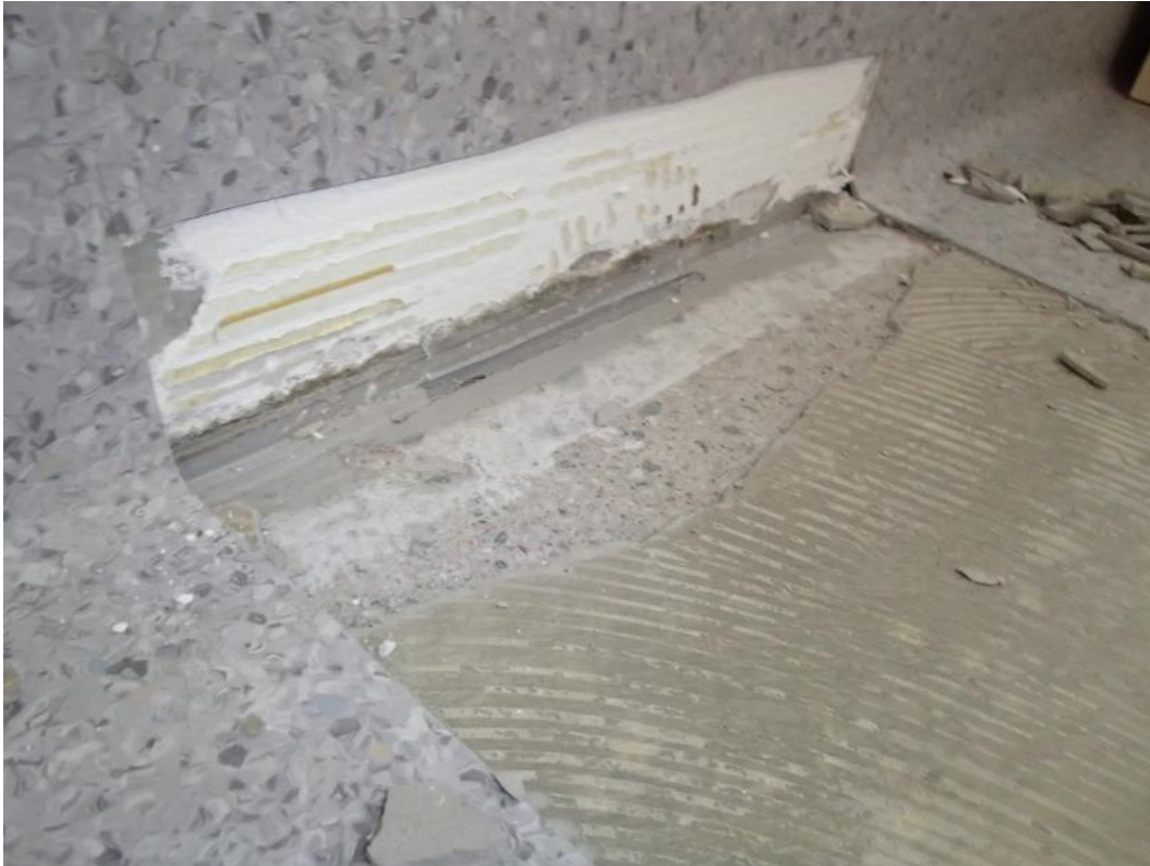
Kuva 1. Tasoitteet ovat irronneet pohjastaan elastisten saumamassojen päältä.
