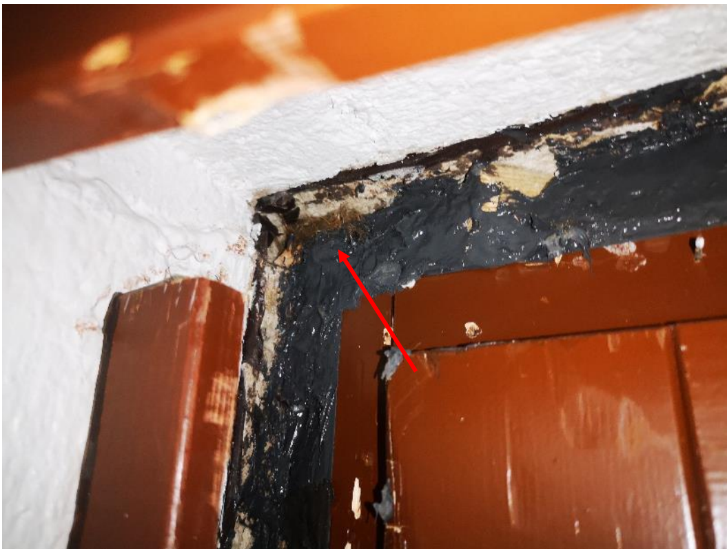
Kuva 19. Tiivistettyjen tilkkelojen rei'istä havaittiin paikallista ilmavuotoa.
