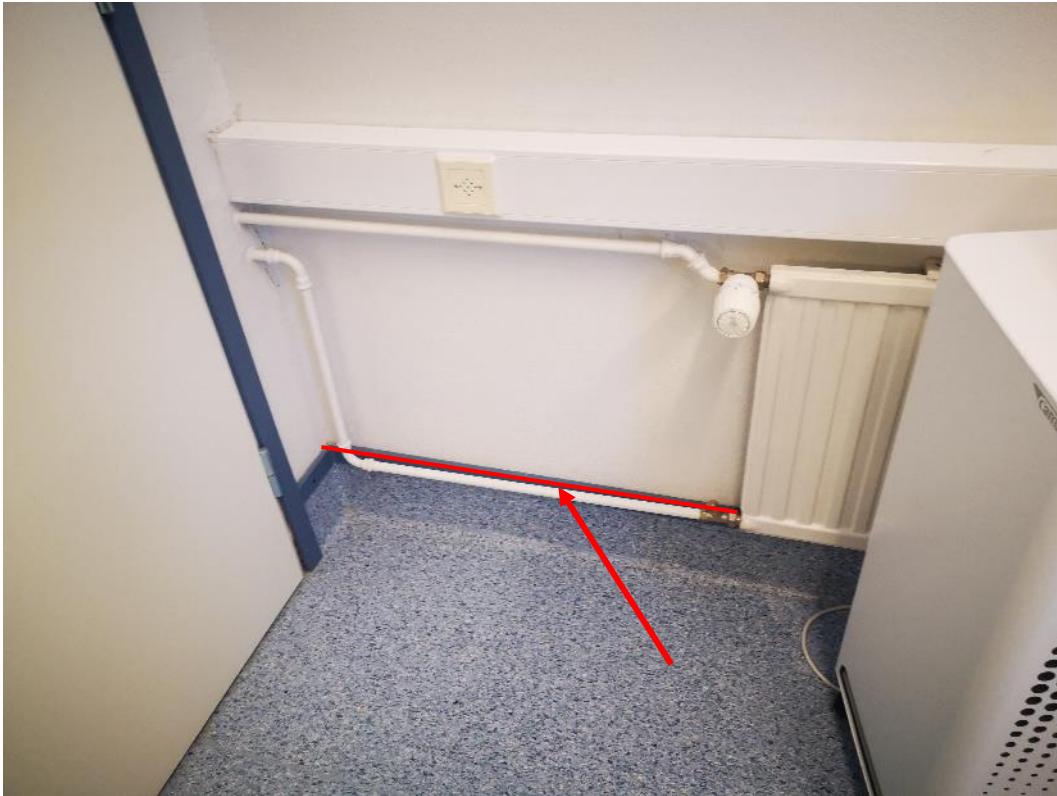
Kuva 20. Lattiamattojen ja seinien rajapinnoissa havaittiin paikallisesti heikko viite vuodosta.
