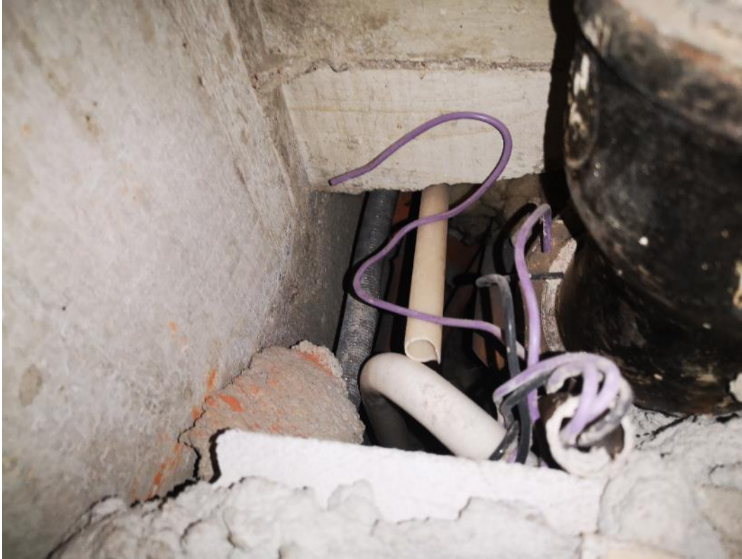
Kuva 8. Alaslasketun katon yläpuolella havaittiin suora ilmayhteys putkikuiluun.
