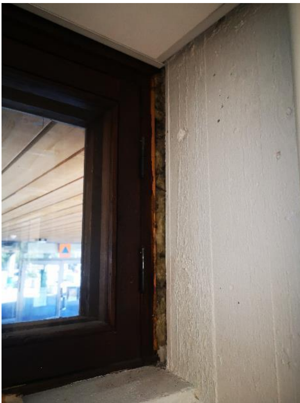
Kuva 9. Kuraattorin huoneen tilketilat ovat tiivistämättä ja tilketilan mineraalivillat ovat tummentuneet.
