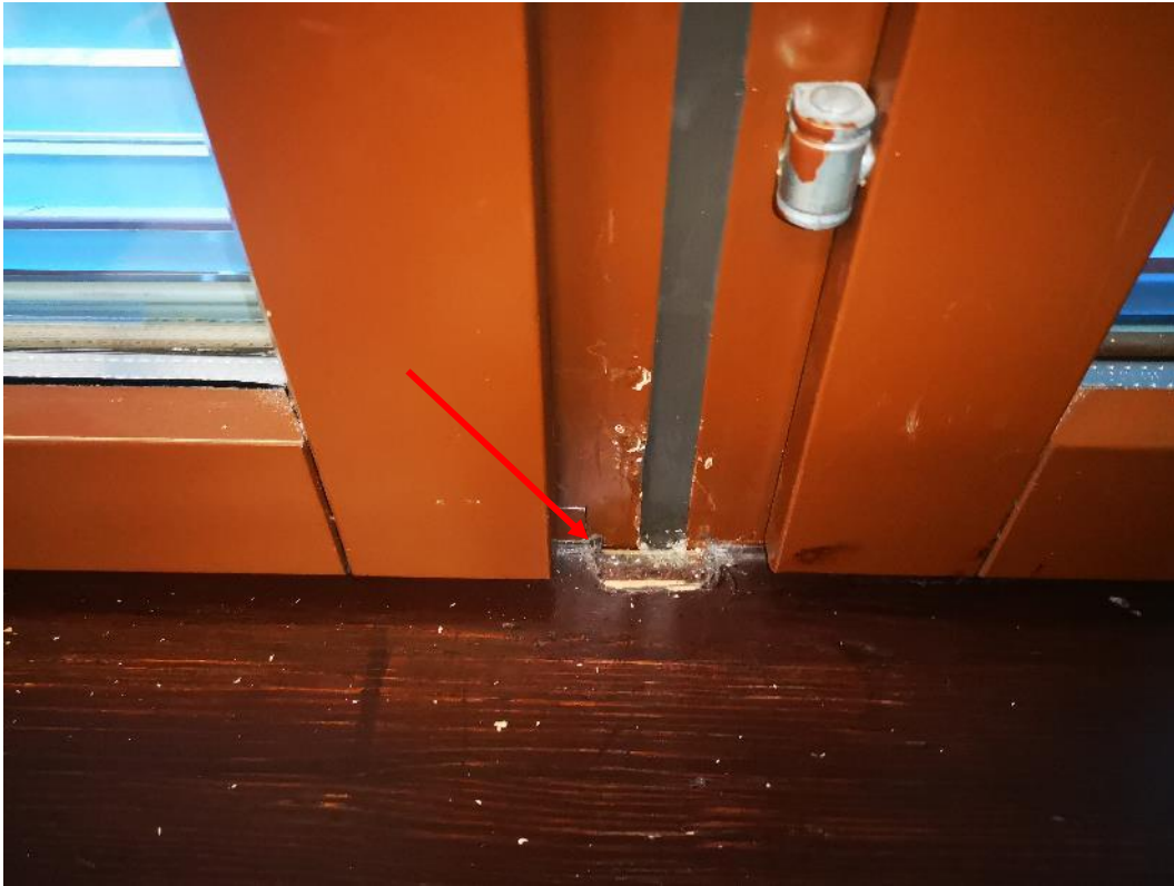
Kuva 18. Ikkunalaudan ja ikkunakarmin rajapinnassa havaittiin ilmavuotoa.
