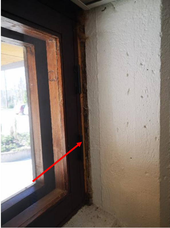
Kuva 16. Pienten ikkunoiden ja rajapinnoissa havaittiin ilmavuotoa.
