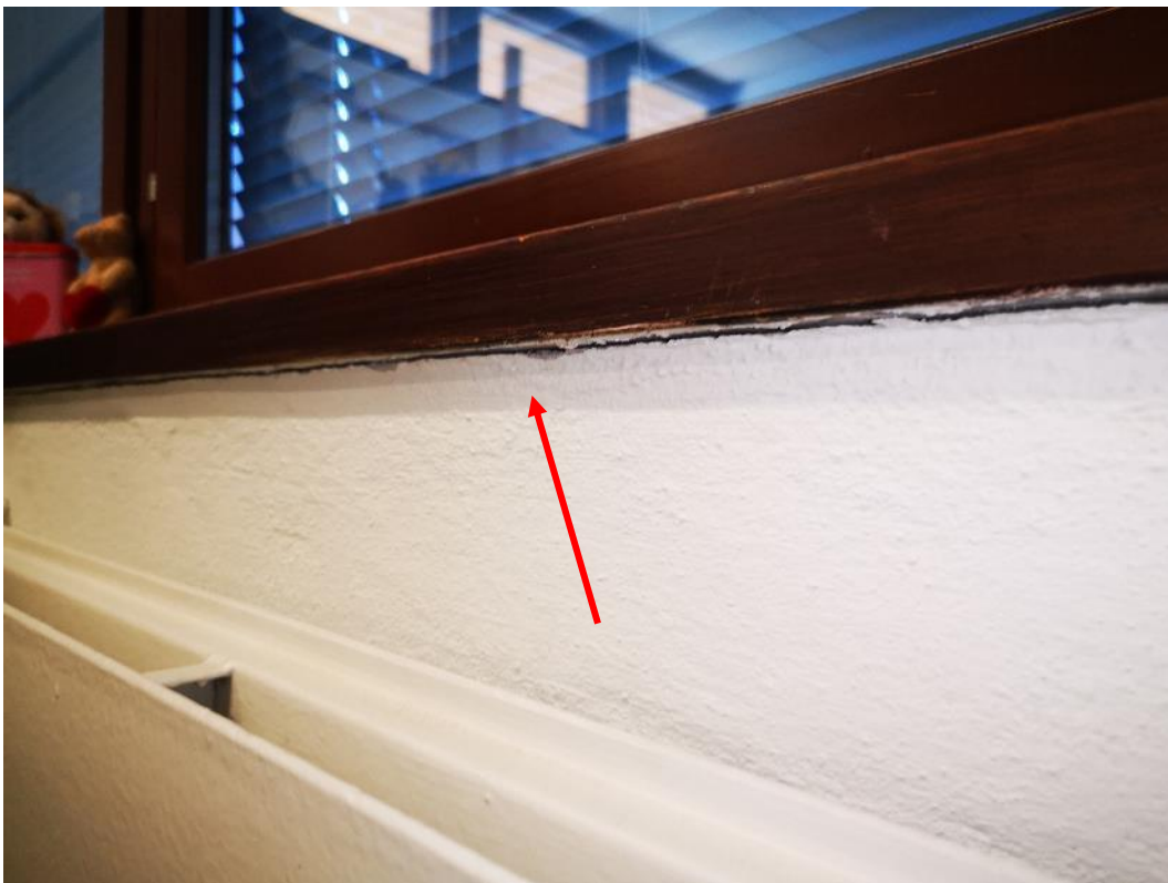
Kuva 17. Ikkunalaudan ja seinän rajapinnassa havaittiin ilmavuotoa.
