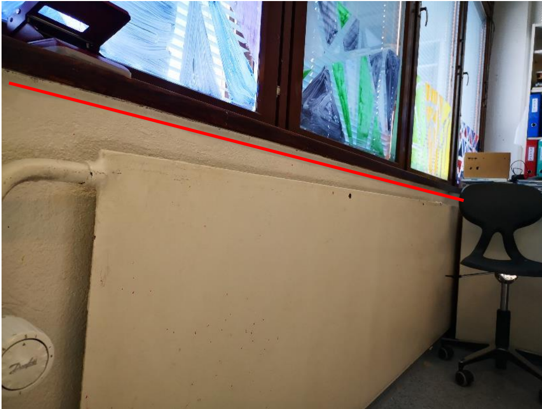
Kuva 21. Ikkunalautojen ja seinien rajapinnoissa havaittiin vahva viite vuodosta.
