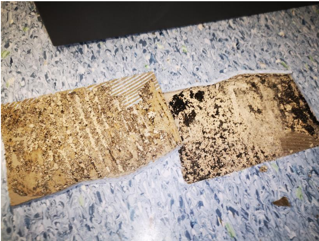
Kuva 12. Koulukuraattorin huoneen lattiamaton alapuoleiset tasoitteet irtosivat näytteenoton yhteydessä ja tasoitteen alapuolella on musta bitumiliima.
