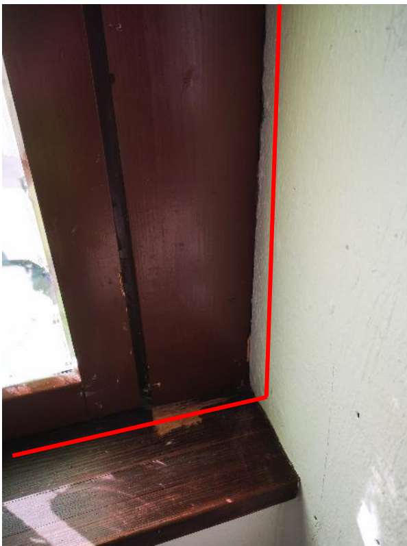
Kuva 22. Ikkunoiden ja ikkunalautojen rajapinnoissa havaittiin vahva viite vuodosta sekä ikkunoiden ja pilareiden rajapinnoilla havaittiin paikallista vuotoa.
