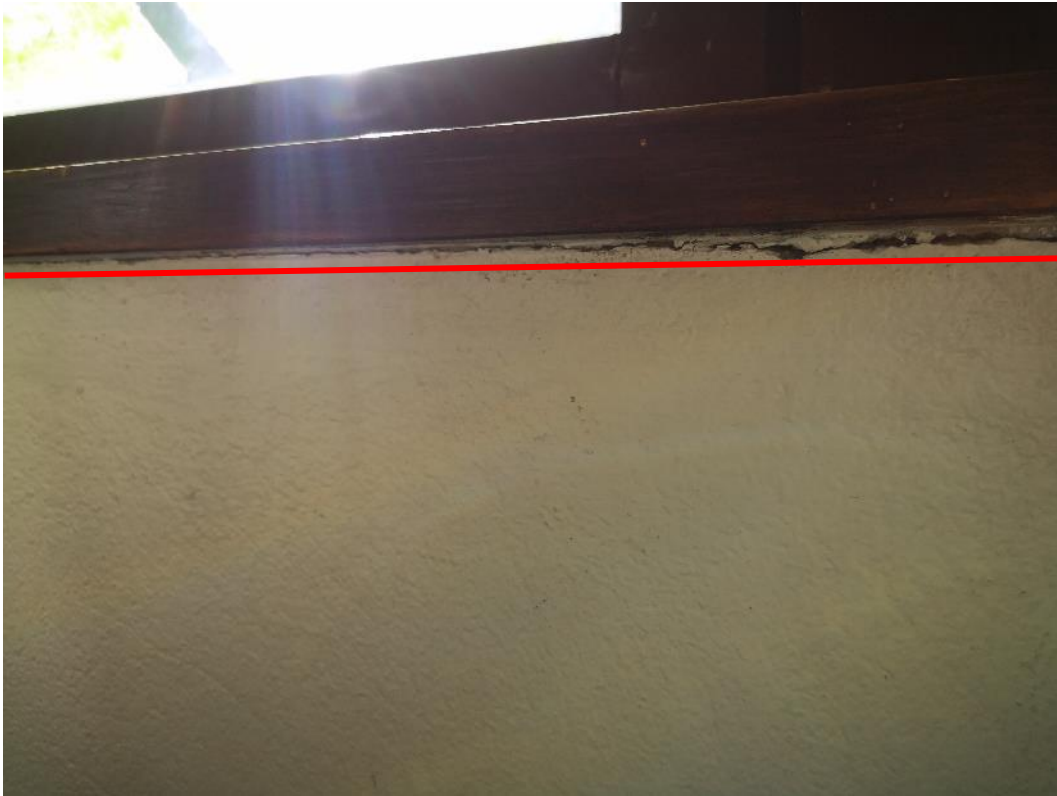
Kuva 23. Ikkunalautojen ja seinien rajapinnoissa havaittiin vahva viite vuodosta.
