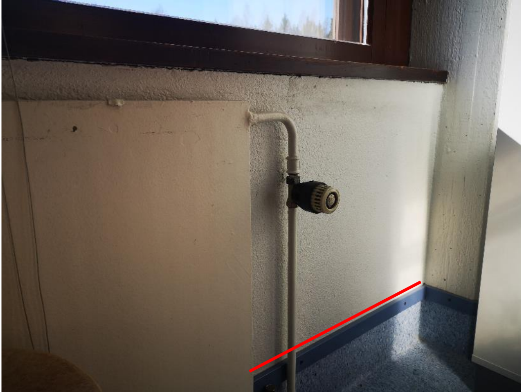
Kuva 25. Muovimaton ja seinän rajapinnassa havaittiin paikallisesti heikko viite vuodosta.
