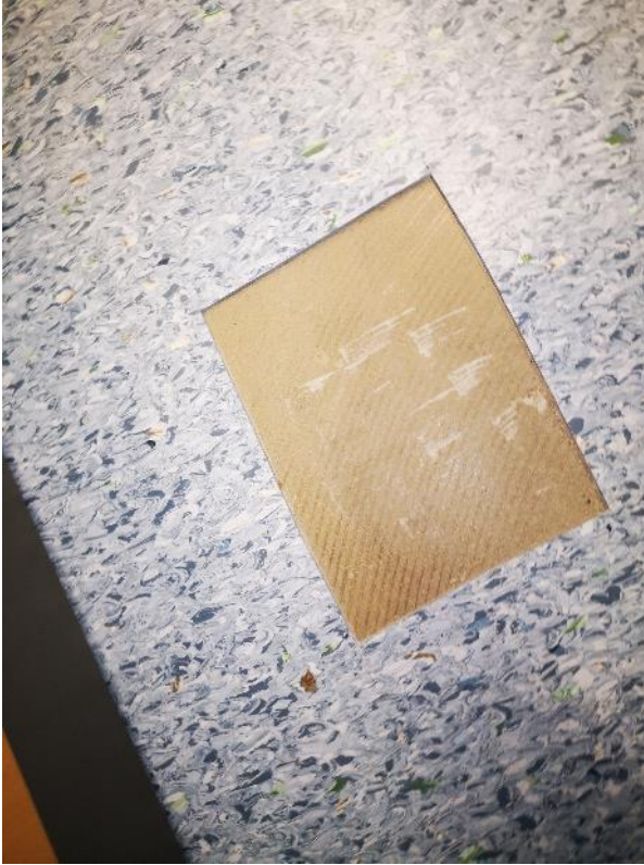
Kuva 12. Terveystoimijan huoneen matto oli heikosti kiinni pohjassaan ja liima tuoksui hie- man kemikaalimaiselle.
