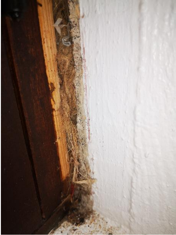
Kuva 10. Terveystoimijan huoneen tilkkeitilat ovat tiivistämättä ja tilkkeitilassa on eristeenä orgaanista tilkemateriaalia.
