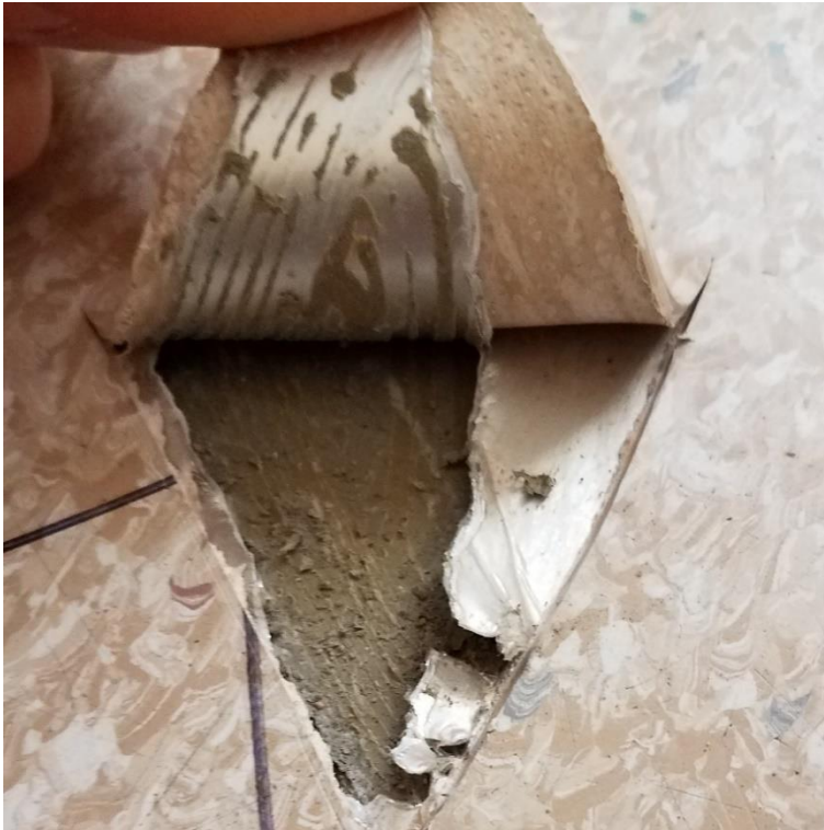
Kuva 10. Maton kunto D - siivessä kohdassa, jossa oli alumiinen alusta maton alla. Viiltomittauksen yhteydessä havaittiin mikrobiperäistä ja kemikaalimaista hajua.
