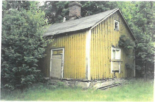
Keittiö-ruokalarakennus ränsistyneenä ja haisevana. Se purettiin viimeisenä vuonna 2002.
