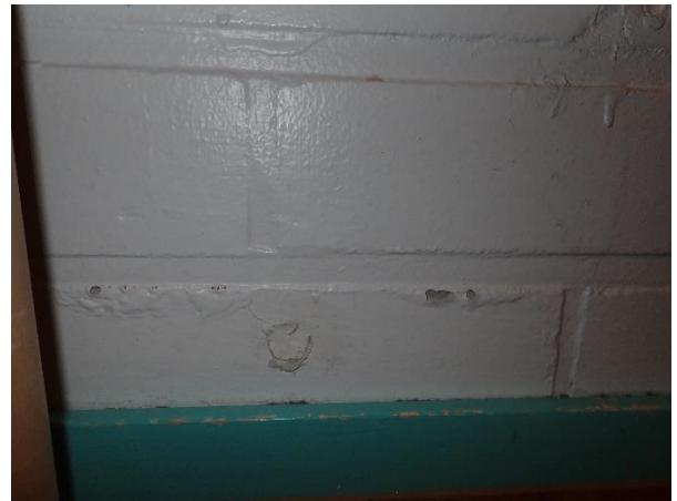
Kuva 8: Käytävällä askartelutilan edessä tiiliväliseinän alaosassa kosteuspoikkeamaa ja maalipinnan irtoamista.
