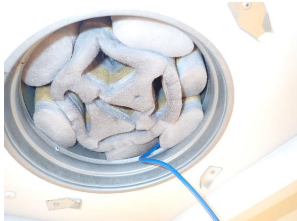
Kuva 27: Osassa tuloilmapäätelaitteita on irrotettava/uusittava äänenvaimennin.
