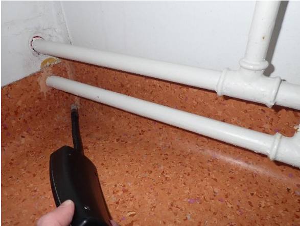
Kuva 4: Haituloiden tilassa ilmavuotoa havaittiin pienellä alueella nurkassa lattia- ja seinäliittymästä (kohdalla matossa halkeama).
