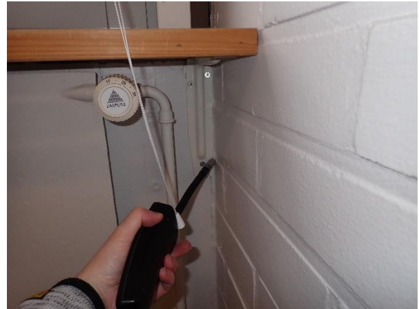
Kuva 3: Palaverihuoneessa ilmavuotoa havaittiin väliseinä- ja ulkoseinäliittymässä.
