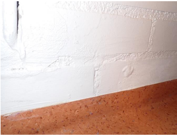
Kuva 7: Pukuhuoneen tiiliväliseinän alaosassa kosteuspoikkeamaa ja maalipinnan irtoamista.
