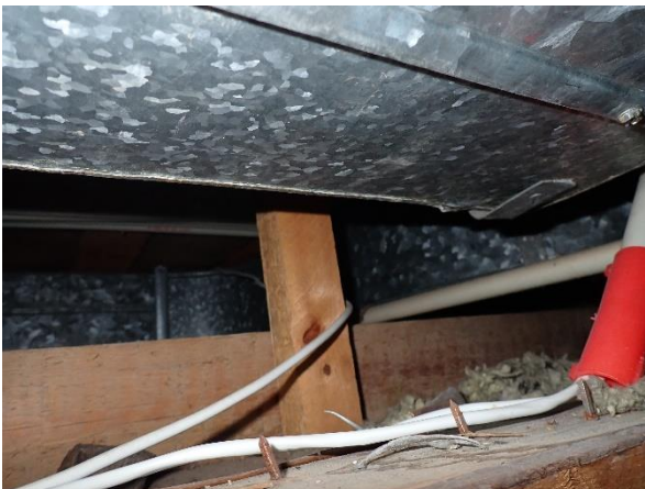
Kuva 13: Alaslaskettujen kattojen tekniikkatilassa paikoin puhallusvillaa.
