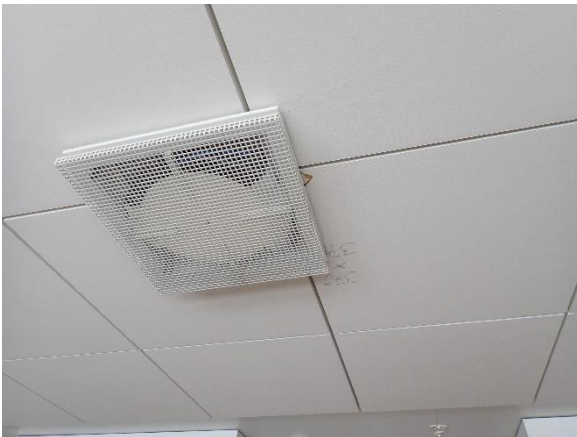
Kuva 26: Tiloissa oleva tuloilmapäätelaitte.
