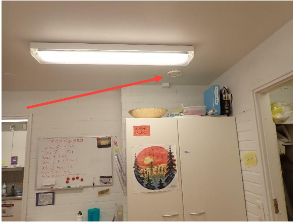
Kuva 28: Tiloissa oleva poistoilmapäätelaite.
