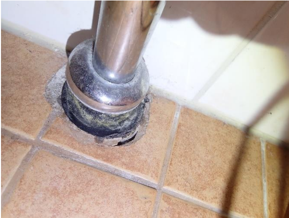
Kuva 11: Pörräisten WC:ssä viemäriputken saumaus epätiivis.
