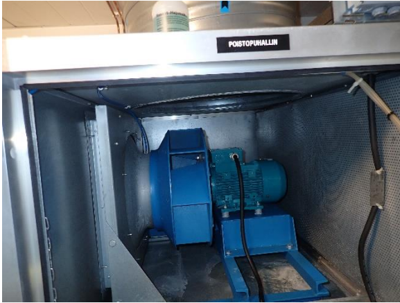
Kuva 23: Poistoilmapuhaltimen pohjalla kosteus- tai öljyjälkiä.
