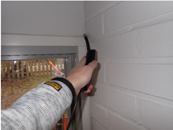
Kuva 2: Haituloiden tilassa ilmavuotoa havaittiin ikkuna- ja väliseinäliittymistä.
