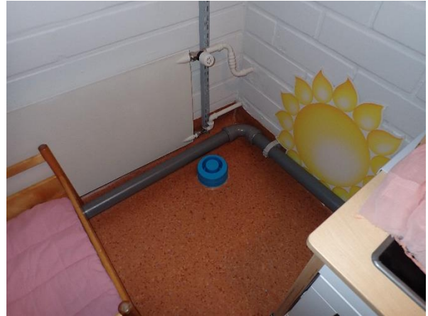
Kuva 12: Tiitäisten leikkihuoneen lattiatasossa oleva putki on suositeltavaa kannakoida paremmin.
