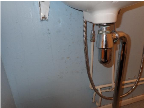
Kuva 9: Henkilökunnan pukuhuoneen WC:ssä lastulevyssä kosteusvauriojälkiä altaan kohdalla.
