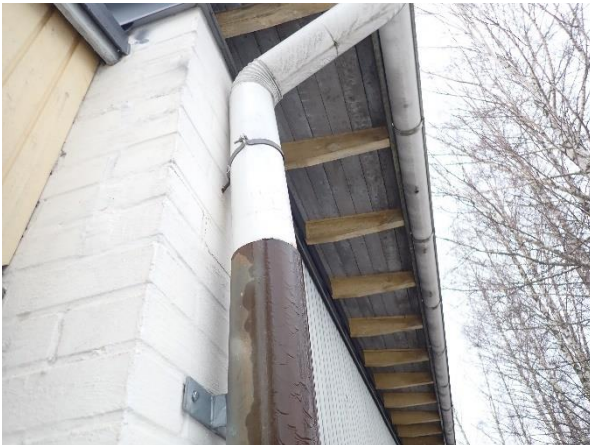
Kuva 17: Sadeveden syöksyputken liitos vuotaa.
