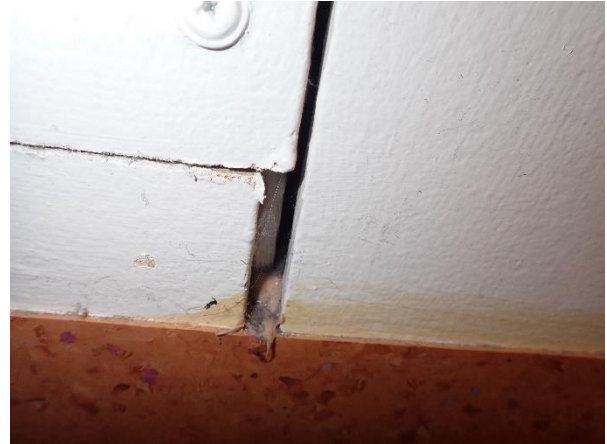
Kuva 5: Palaverihuoneessa rakoa ulkoseinällä olevaan kotelointiin.
