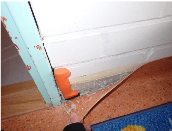
Kuva 6: Tiiliväliseinien ja alapohjan liittymät eivät ole tiiviitä.
