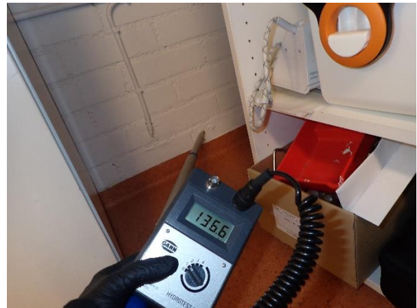
Kuva 20: Pukuhuoneen tiiliväliseinässä oli kosteuspoikkeamaa.
