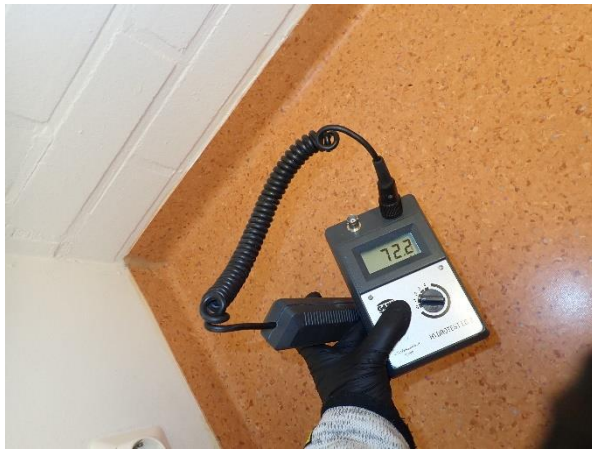
Kuva 19: Kahvitilassa pintakosteusmittauksissa havaittiin poikkeamaa.
