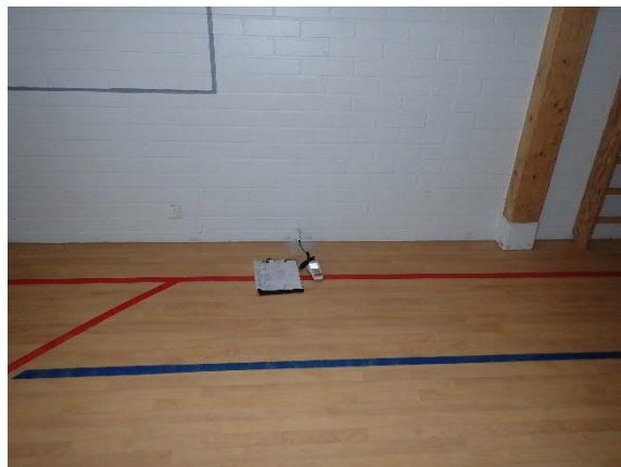
Kuva 2 Liikuntasalin eristetilan kosteus tavanomainen
