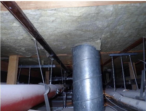
Kuva 5 Käytävän 118 katon välitilassa eristevillat paljaana.
