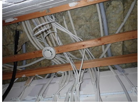
Kuva 4 Sähkökaapin eristeet näkyvissä ei höyrynsulkua. Eristeistä suora ilmayhteys kattorakenteisiin
