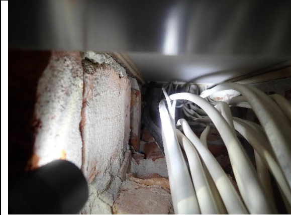
Kuva 3 sähkökaapin lattian kautta on ilmavuotoja sisätiloihin
