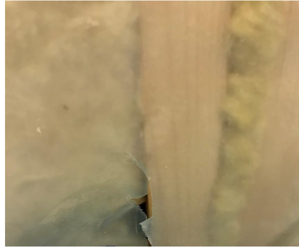
Kuva 8 Ulkoseinän alaosan sisäpuolinen höyrysulkumuovi oli rikki.
