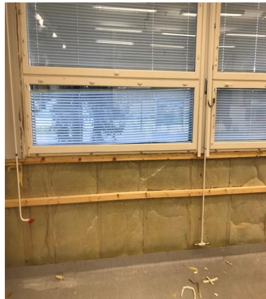
Kuva 2 Ulkoseinän sisäpuolella eristevilla oli puhdasta ja kirkasta.
