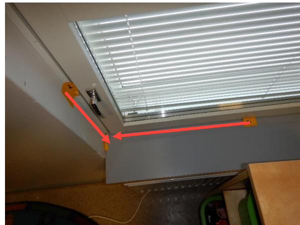
Kuva 25 Ulkoseinien ja ikkunoiden liittymistä ja ikkunalaudasta runsasta ilmavuotoa.
