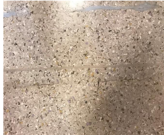
Kuva 9 Kellarikerroksen käytävällä lattiamatossa halkeamia
