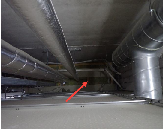
Kuva 24 Käytävän alakattotilassa paljaita mineraalivillapintoja
