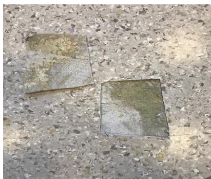
Kuva 17 Perhekeskuksen ryhmätalassa 003 VOC- materiaalinäytteessä on viite vauriosta.
