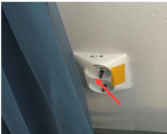
Kuva 21 Merkkiaineella voimakas merkkiainevuoto sähkörsiassa.
