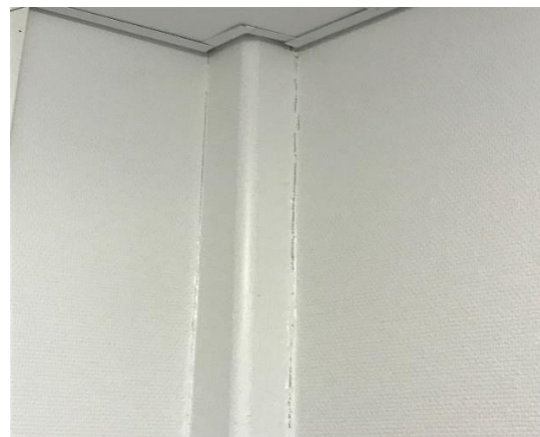
Kuva 7 Paikoin seinäliittymissä on halkeamaa
