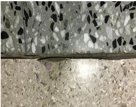
Kuva 10 Kahden eri lattiamateriaalin epätiivis saumaus
