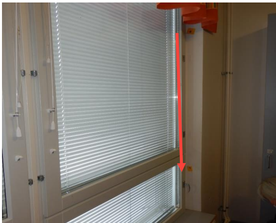
Kuva 24 Merkkiainetutkimuksessa ilmavuotoa ikkuna- ja seinäliittymistä.
