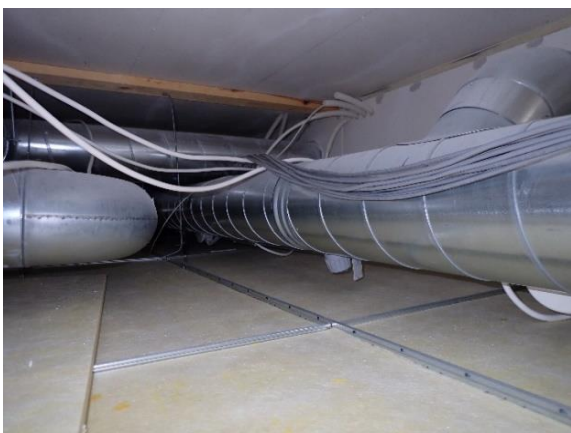
Kuva 12 Käytävän alaslaskettujen kattojen tekniikkatiloissa pölyjä iv-putkien päällä.
