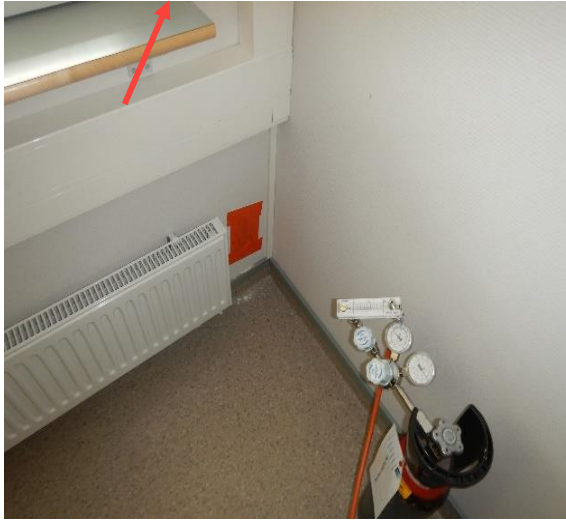
Kuva 26 Pistemäinen pieni ilmavuoto ikkunan nurkassa.
