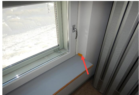
Kuva 20 Ikkunoiden liittymien kulmissa havaittiin ilmavuotoa.
