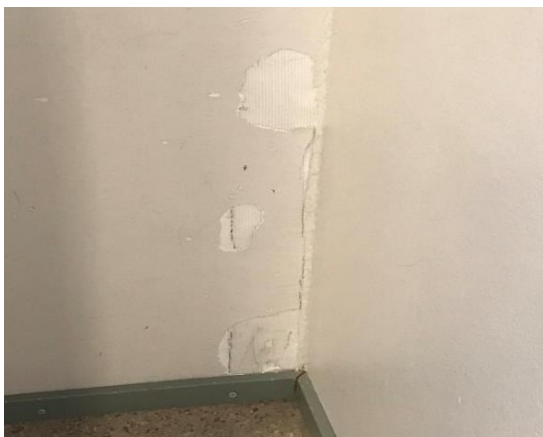
Kuva 6 Delfiiniin lepohuoneen ja keittiön välisellä väliseinällä havaittiin seinätapetin irtoamista
