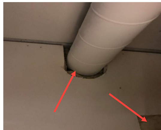
Kuva 13 Paikoin alakattotilassa oli paljaana mineraalivill-eristeitä
