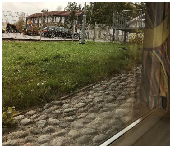
Kuva 3 Rakennuksen vierustan maanpinnat paikoin kallistuvat loivasti pois päin rakennusta.
