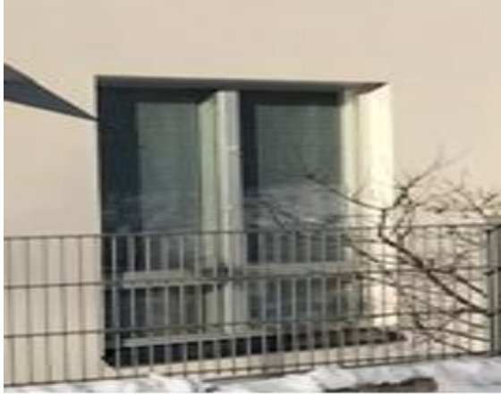
Kuva 5 Ikkunapellitysten kallistus on melko loiva.
