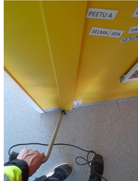
Kuva 22. Alipaineistettuna kotoissa havaittiin merkittävää ilmapuotoa. Ilmapuotoa oli lähes koko kotelon matkalla.
