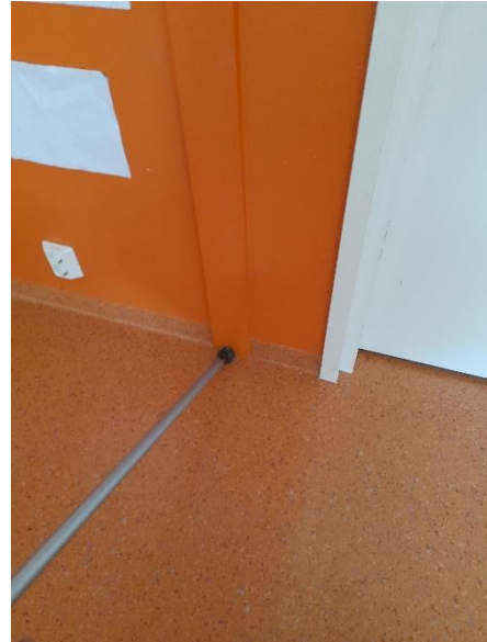
Kuva 14. Alipaineistettuna koteloidissa havaittiin merkittävää ilmavuotoa. Ilmavuotoa oli lähes koko kotelon matkalla.
