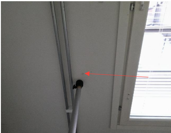
Kuva 19. Paikatussa kohdassa pistemäistä vuotoa.
