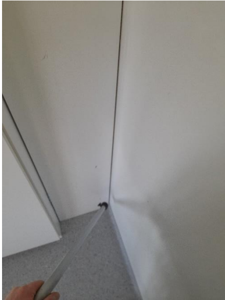
Kuva 17. Lepohuoneessa on kotelorakenne. Kotelorakenne vuotaa koko kotelorakenteen matkalta normaalissa ja alipaineistetussa tilassa. Vuoto on merkittävää.
