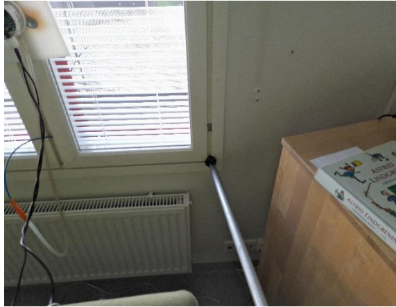
Kuva 21. Normaali tilassa ja alipaineistettuna havaittiin ikkunanliittymissä pistemäisiä vuotokohtia.
