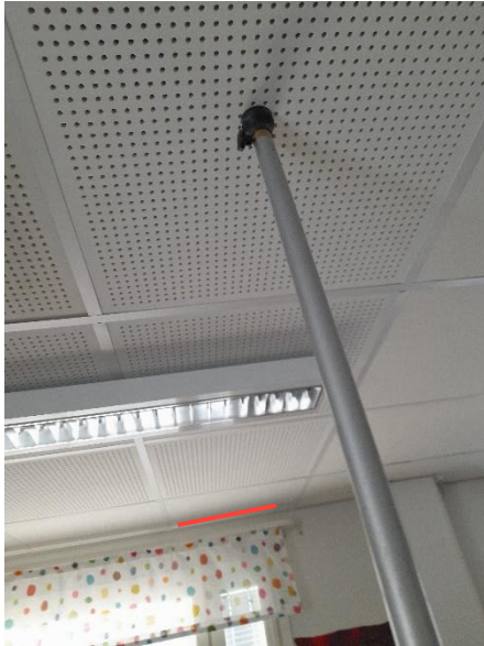
Kuva 31. Yläpohjan ja ulkoseinän liittymästä havaittiin vähäistä vuotoa. Ilmavuotoa havaittiin rei'itetyn alakattolevytyksenkin kautta.
