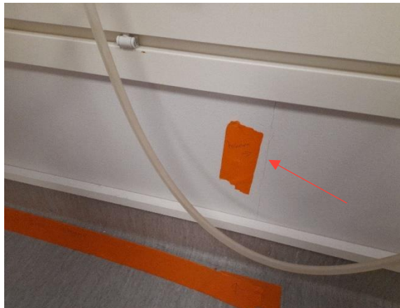
Kuva 5. Alipaineistettuna havaittiin vähäistä ilmapuotoa seinän halkeamassa. Lattian ilmapuoto alue loppui halkeaman kohdalla.
