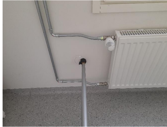
Kuva 18. Paikatuissa kohdissa havaittiin normaali tilassa pistemäistä vuotoa. Alipaineistettuna kohdassa havaittiin vähäistä vuotoa.
