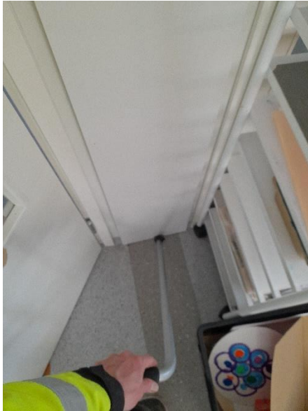
Kuva 27. Elementtiliittymissä havaittiin alipaineistettuna vähäistä vuotoa.
