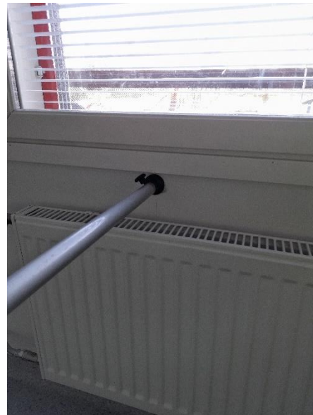
Kuva 20. Seinän halkeamassa havaittiin vähäistä vuotoa alipaineistettuna .
