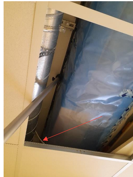
Kuva 6. Normaali tilassa havaittiin ruuvien rei'issä pistemäistä vuotoa. Kohta on laajennusosan ja vanhan osan rajapinnassa. Nuolen osoittamassa suunnassa havaittiin alipaineistettuna yläpohjan ja ulkoseinän liittymässä vähäistä ilmapuotoa.
