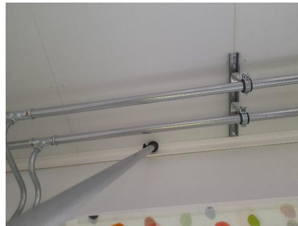
Kuva 24. Alipaineistettuna yläpohjan ja ulkoseinän liittymässä havaittiin vähäistä vuotoa.
