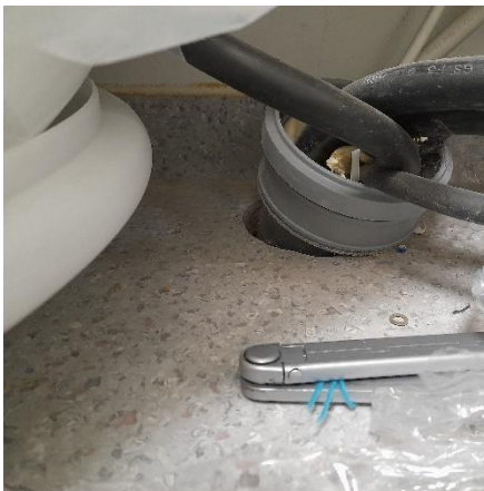
Kuva 32. Läpivienti sähköpääkeskuksesta alapohjaan ei ole tiivis (käytävä 108).
