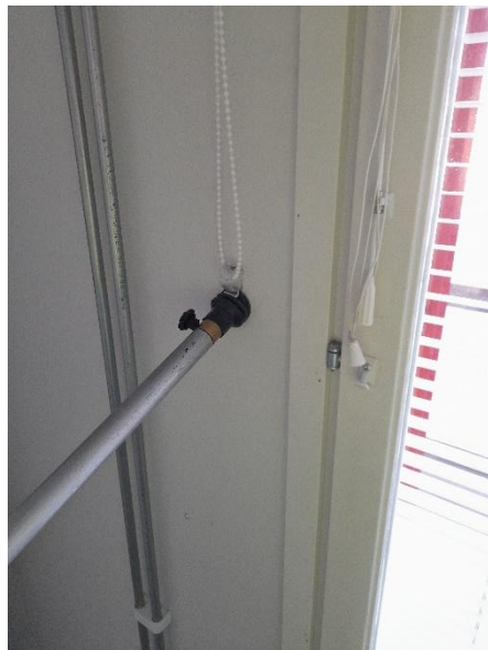
Kuva 23. Normaali tilassa ja alipaineistettuna havaittiin koukussa pistemäistä vuotoa.
