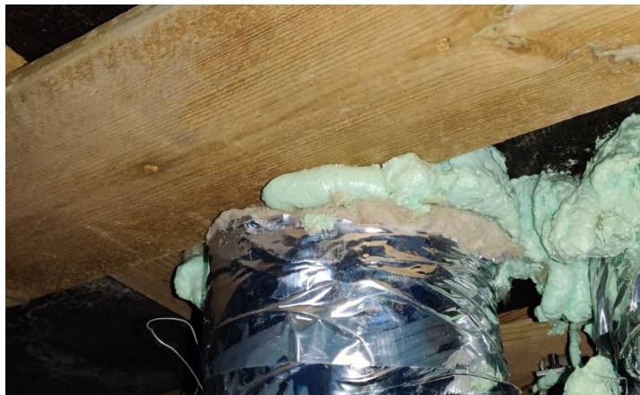
Kuva 33. Uretaanivaahtoa ei ole paikoittain tiiviisti asennettu. Vaahto olisi syytä asentaa kauttaaltaan tiiviisti, jotta ilmavuoto reitit saadaan tukittua.
