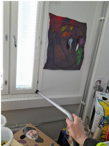
Kuva 29. Ikkunaliittymissä havaittiin vähäistä ilma- vuotoa.
