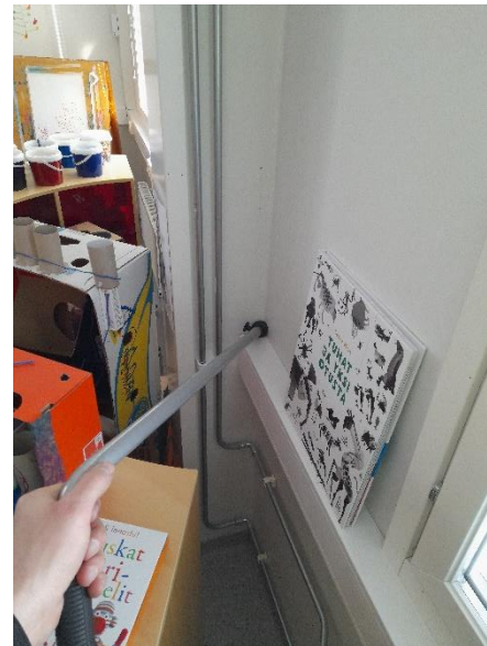
Kuva 30. Elementin liittymässä havaittiin merkittä- vää ilmapuotoa alipaineistettuna . Normaali tilassa vuoto oli vähäisempää.
