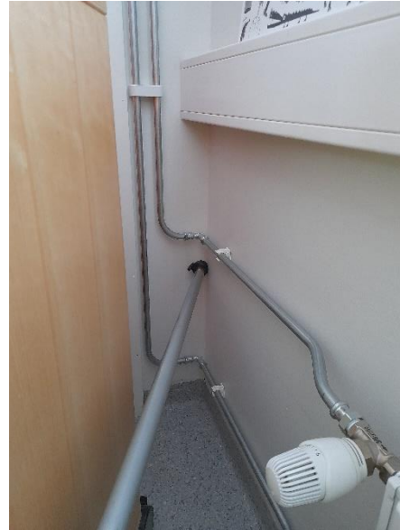
Kuva 28. Ulkoseinärakenteen liittymässä vähäistä il- mavuotoa.
