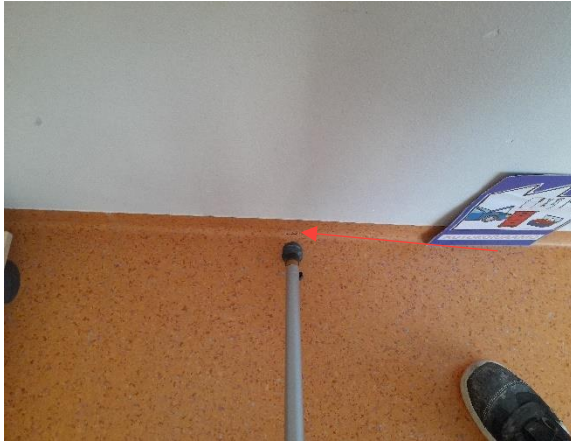
Kuva 13. Alipaineistettuna Muovimaton halkeamissa havaittiin vähäistä vuotoa.
