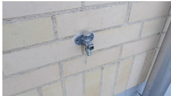
Kuva 7. Vesipostin kiinnitysruuvi on katkennut.
