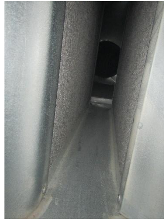
Kuva 35. Lamelliäänenvaimentimien suojakankaat ovat ehjiä.
