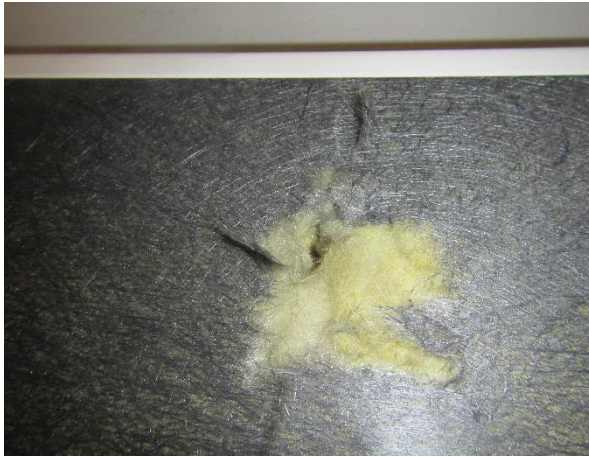
Kuva 42. Tuloilman päätelaitteiden (TLB) suojakankaat ovat osin rikki.
