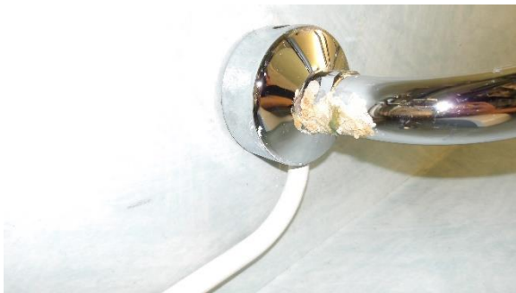
Kuva 14. Rättipattereissa on syöpymää.
