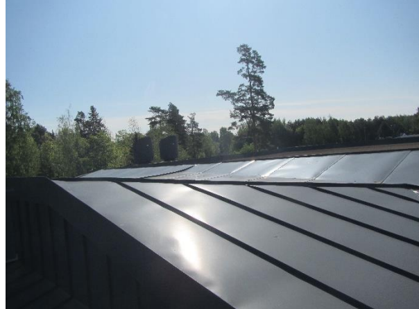
Kuva 31. Ulospuhallushajottajat sijaitsevat riittävän etäällä raitisilmasäleiköstä.
