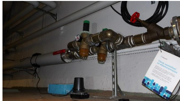
Kuva 9. Paineenalennusventtiilit ja etäluettava vesimittari lämmönjakohuoneessa.
