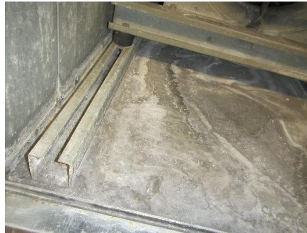
Kuva 33. Poistoilmapuhaltimen puhallinkammiossa on runsaasti hapettumaa ja kosteusjälkiä.
