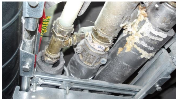
Kuva 15. Messinkiosassa on yksittäinen vuotojälki.
