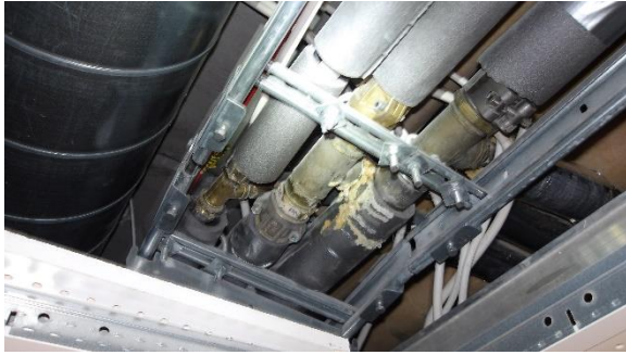
Kuva 4. Eristeet runkolinjoissa solumuovia.
