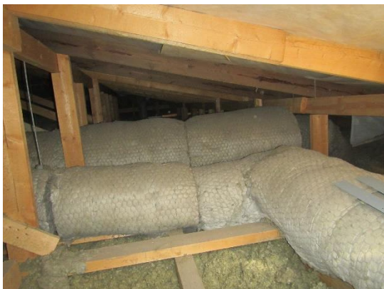
Kuva 36. Kylmässä ullakkotilassa kanavat ovat eristettyjä.
