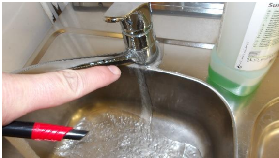
Kuva 6. Kalusteissa on huollon tarvetta. Kiinnityksissä on löysyyttä ja tiivistevuotoja. Myös Wc-istuimet lotisevat paikoin.
