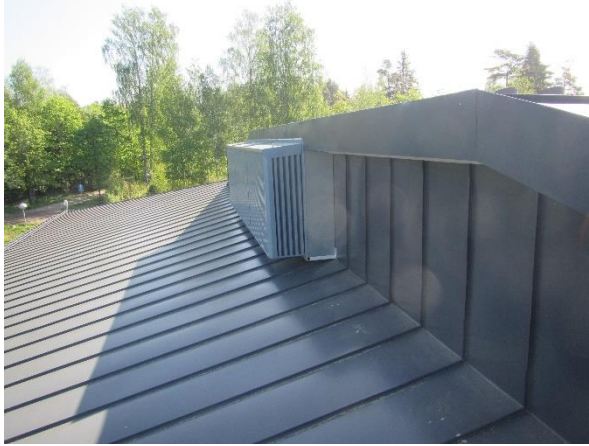
Kuva 30. Raitisilmasäleikkö vesikatolla sijaitsee lähellä vesikattopintaa.
