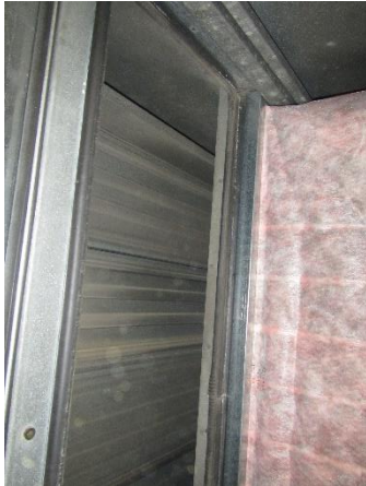
Kuva 34. Tuloilmasuodattimen suodatinasennus on tiivis, eikä ohivirtauksia havaittu.
