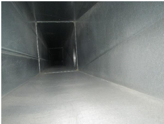
Kuva 40. Poistoilman runkokehanavassa (1 krs) on hieman näkyvää pölykertymää.
