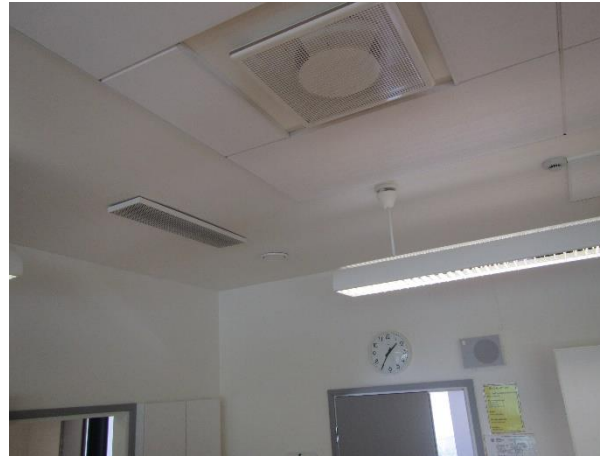
Kuva 43. Ensimmäisen kerroksen tuloilman kattohajottaja (TKB).
