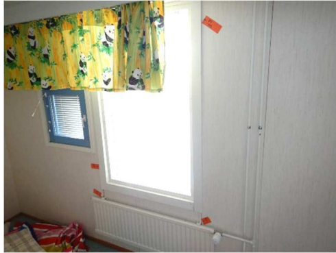
Kuva 19. Vähäisiä ilmavuotoja ikkunan yläosassa ja alaosassa liittymässä ulkoseinään sekä lämmityspatterin vasemmassa kiinnikkeessä. Pistemäinen ilmavuoto lämmityspatterin oikeassa kiinnikkeessä.
