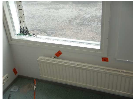
Kuva 8. Pistemäisiä Ilmavuotoja ulkoseinässä lämpöpatterin kiinnityksessä ja ikkunan alanurkassa.
