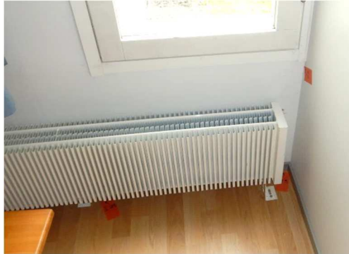
Kuva 15. Vähäisiä ilmapuotoja ulkoseinän ja alapohjan liittymässä sekä ikkunan alanurkassa. Vasemman puolimmainen ilmapuoto lattian rajassa on pistemäinen.
