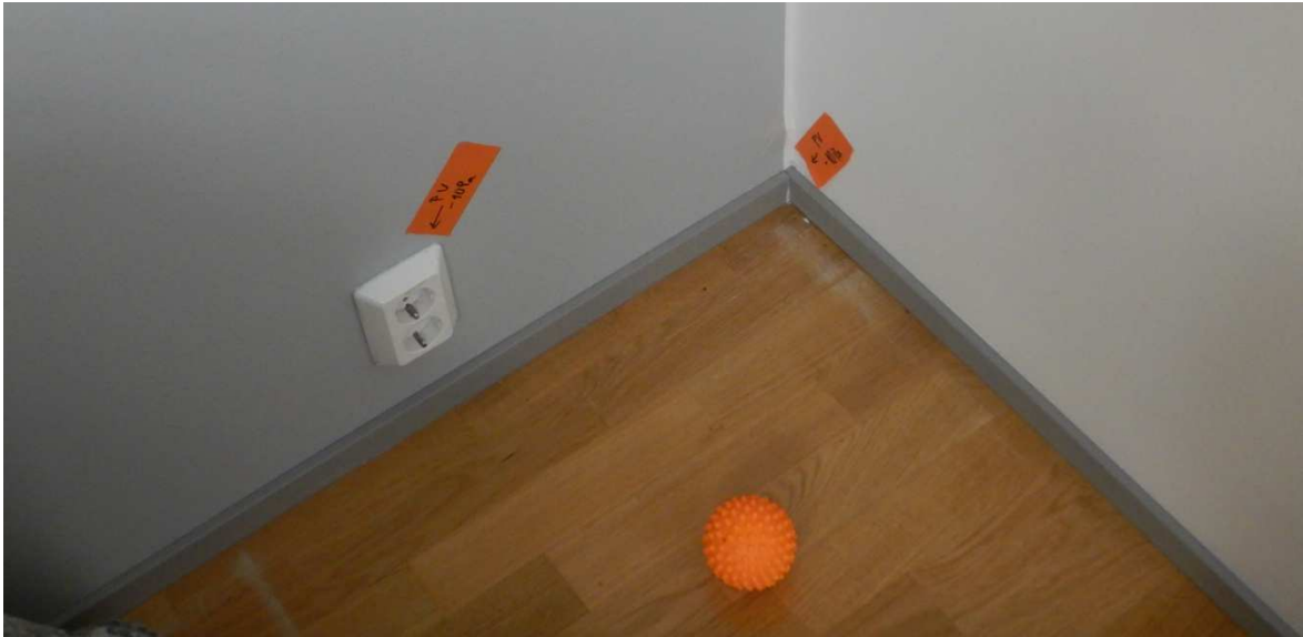
Kuva 4. Huoneen 2.23 havaitut pistemäiset ilmavuotokohdat sähkörasiassa ja seinien nurkassa. -10 Pa alipaine.
