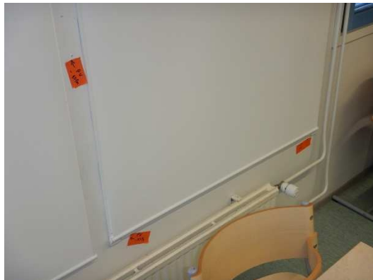
Kuva 9. Pistemäistä Ilmavuotoa ikkunan ympärillä ulkoseinässä (reikä ja alanurkat). Verho peittää ikkunan.
