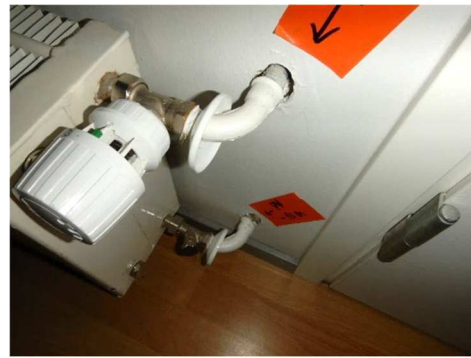
Kuva 18. Putkiläpivienneissä vähäinen ja pistemäinen ilmapuoto.
