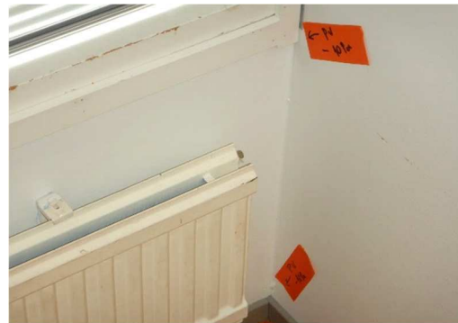
Kuva 6. Pistemäiset ilmavuodot ulkoseinän liittymässä. -10 Pa alipaine.
