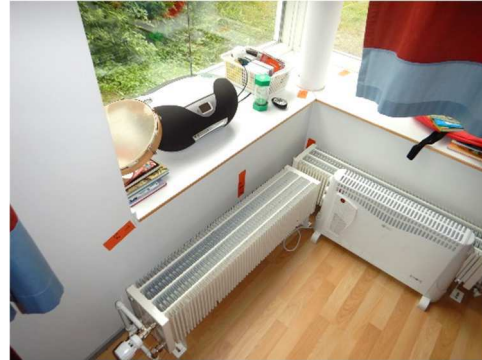
Kuva 16. Vähäisiä ilmapuotoja ikkunapenkin ja pilarin liittymässä sekä ulkoseinän ja alapohjan liittymässä. Pistemäisiä ilmapuotoja lämmityspatterin kiinnityksessä sekä ikkunapenkin ja ulkoseinän liittymässä.
