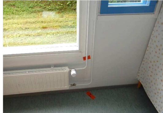
Kuva 13. Pistemäisiä ilmapuotoja ikkunan alanurkassa ja ulkoseinän ja alapohjan liittymässä.
