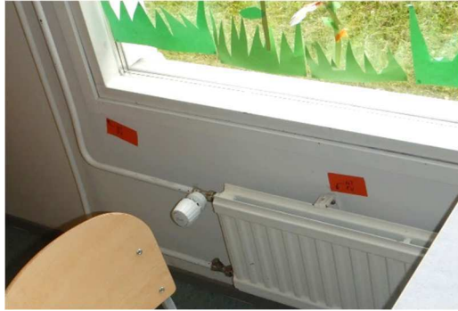
Kuva 10. Pistemäisiä ilmapuotoja ikkunan alanurkassa ja lämmityspatterin kiinnikkeen kohdalla. Ilmapuodot havaittiin jo ilmanvaihdon normaalissa käyttötilassa.
