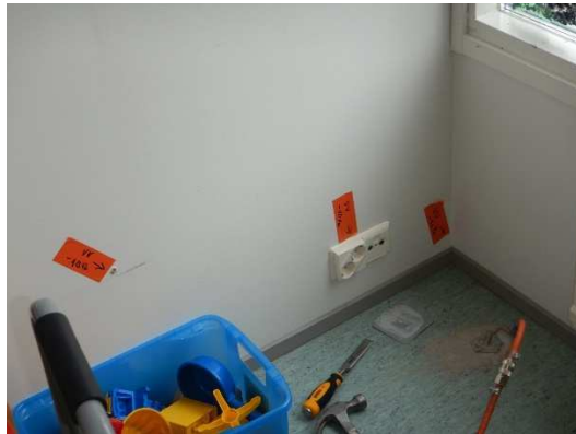
Kuva 7. Ilmavuotoja ulkoseinään liittyvässä väliseinässä (vähäinen ilmavuoto = reikä ja lattian liittymä, pistemäinen ilmavuoto = sähkörasia)
