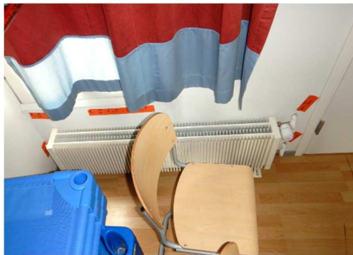
Kuva 17. Vähäisiä ilmapuotoja ikkunan liittymässä ulkoseinään, ulkoseinän ja alapohjan nurkassa.
