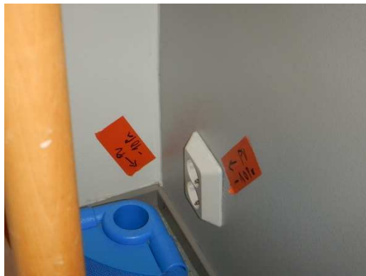
Kuva 14. Pistemäiset ilmapuodot alapohjan ja ulkoseinän liittymässä sekä väliseinän pistorasiassa alipaineistettuna.
