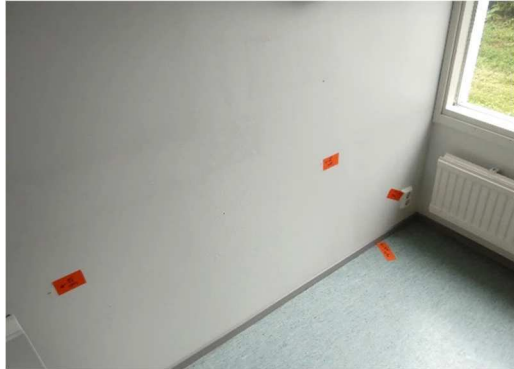
Kuva 12. Pistemäisiä ilmapuotoja väliseinän rei'istä, sähkörsiasta ja väliseinän sekä alapohjan rajasta (vähäinen ilmapuoto).
