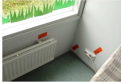
Kuva 11. Vähäinen ilmapuoto alapohjan, ulkoseinän ja väliseinän liittymässä. Pistemäinen ilmapuoto sähkörsiassa väliseinässä sekä ulkoseinässä lämmityspatterin kiinnikkeessä.
