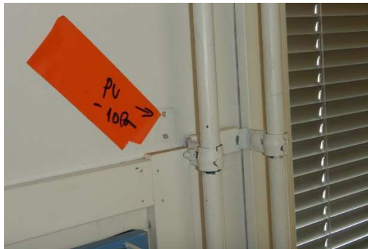
Kuva 5. Pistemäinen ilmavuoto ulkoseinän sisäpinnan levytyksen reiästä. -10 Pa alipaine.
