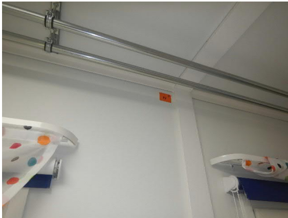
Kuva 11. Pistemäinen vuoto ulkoseinä- ja yläpohjaelementtien liittymästä.
