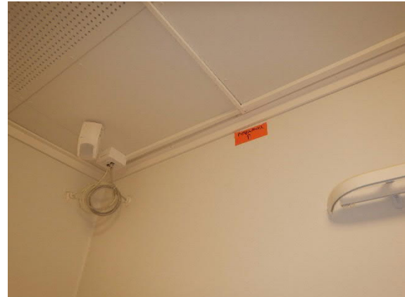
Kuva 4. Pistemäinen vuoto ulkoseinän ja yläpohjan liittymästä.
