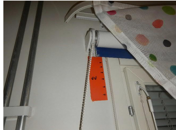
Kuva 10. Vähäistä vuotoa ikkunan ja ulkoseinän liittymästä. Lista irronnut.
