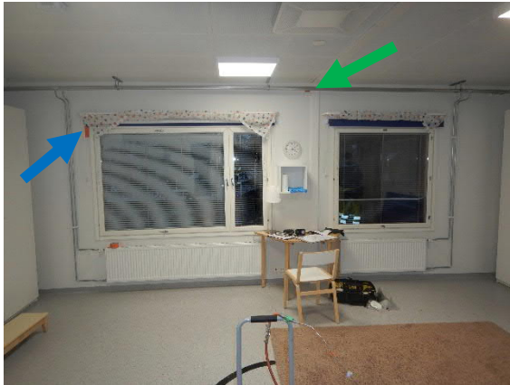
Kuva 9. Yleiskuva tilasta 127. Pistemäinen vuoto merkitty vihreällä nuolella ja vähäinen vuoto sinisellä.
