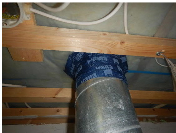
Kuva 15. IV-kanavan teippausta korjattava.
