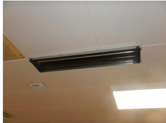
Kuva 7. Merkittävää vuotoa IV-poistoilmasäleikön reuna-alueelta.
