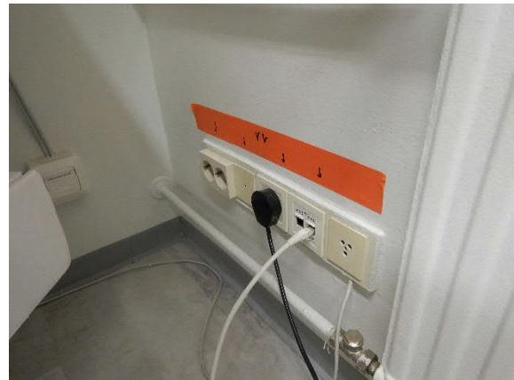
Kuva 13. Vähäistä vuotoa sähkörasioiden kautta (3).
