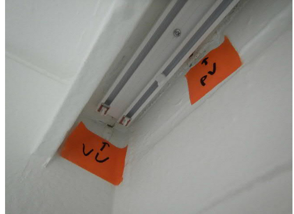
Kuva 7. Vähäistä ja pistemäistä vuotoa haljenneista levysaumoista ikkunan yläpuolella (2 ja 3).
