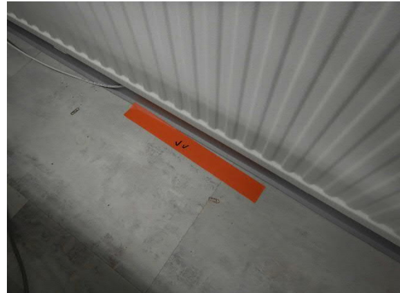
Kuva 11. Vähäistä vuotoa ulkoseinän ja alapohjan liittymästä (2).
