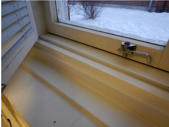
Kuva 8. Vähäistä vuotoa tuuletusikkunan tiivisteiden läpi. Ei havaittu mistä vuotoa ikkunan sisälle (4).
