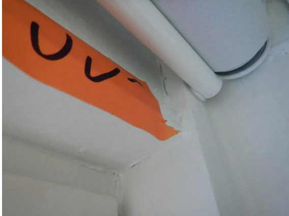
Kuva 6. Vähäistä vuotoa ikkunan yläpuolella olevan kotelorakenteen haljenneesta levysaumasta (1).
