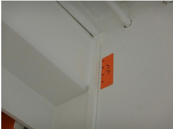
Kuva 10. Vähäistä vuotoa sähkölistan takaa palkin kyljestä (1).
