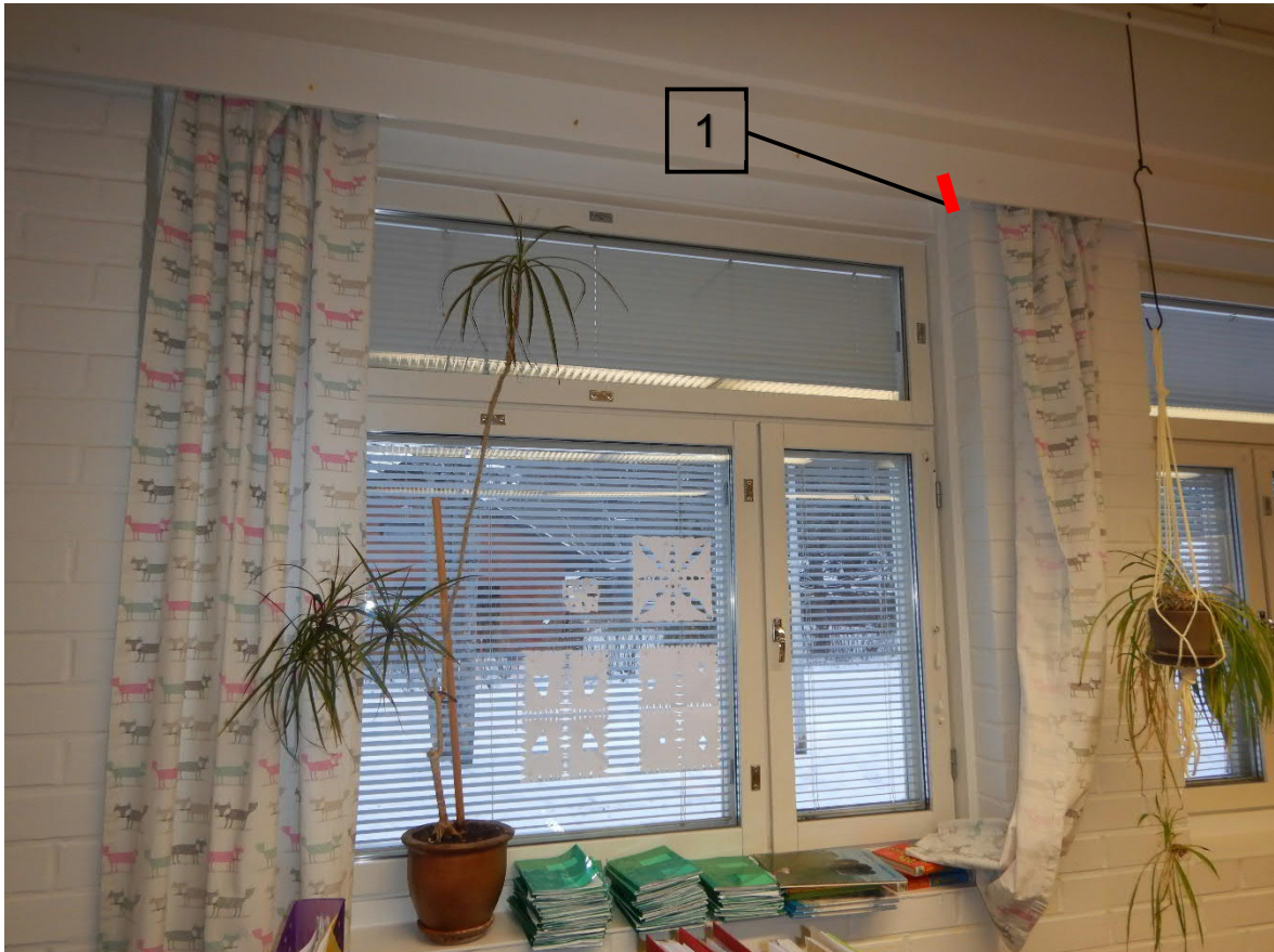
Kuva 1. Havaitut ilmavuotokohdat tilassa 1002.
