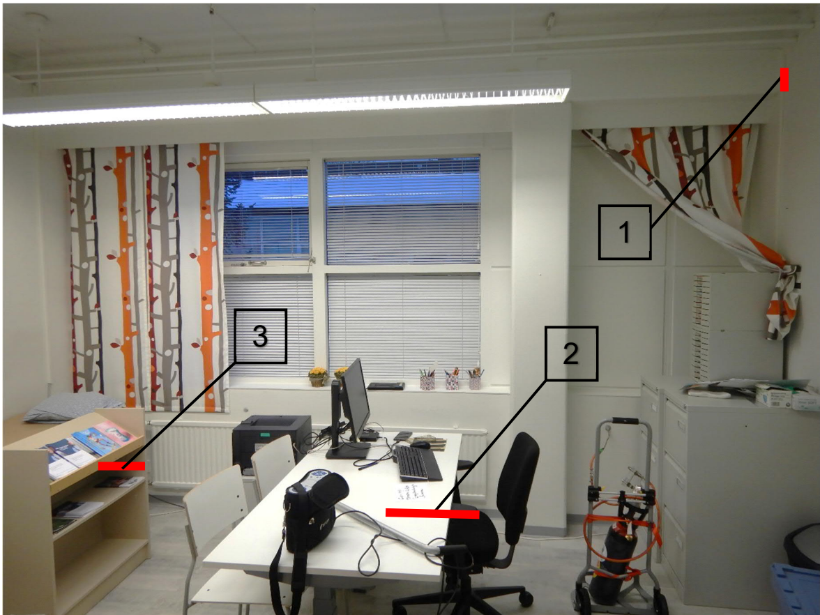
Kuva 9. Havaitut ilmvuotokohdat terveydenhoitajan huoneessa.
