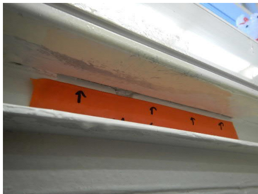
Kuva 4. Merkittävää vuotoa sähkökotelon ja tiiliseinän välisistä raoista (1).
