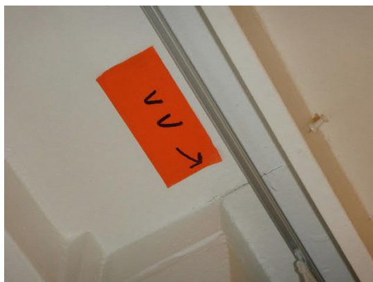
Kuva 2. Vähäistä vuotoa ikkunan yläpuolella olevan kotelorakenteen haljenneesta levysaumasta (1).
