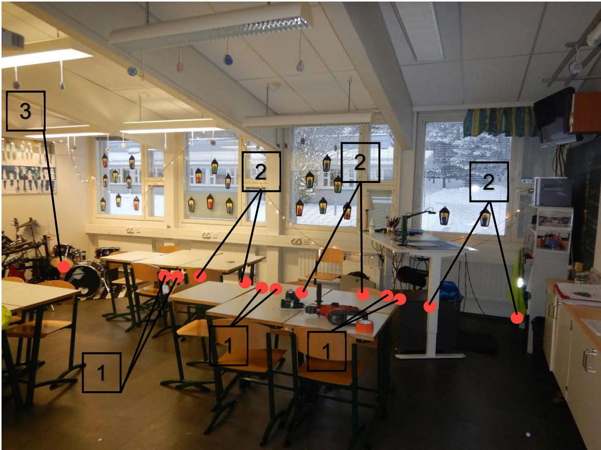
Kuva 1. Havaitut ilmapuotokohdat tilassa 17.
