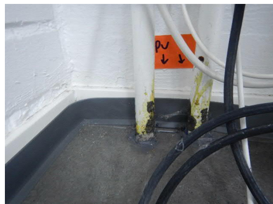
Kuva 19. Pistemäistä vuotoa patteriputkien lattian läpivientien kautta (8).
