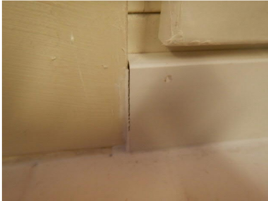
Kuva 8. Ikkunalistan päädyssä rakoja (1).
