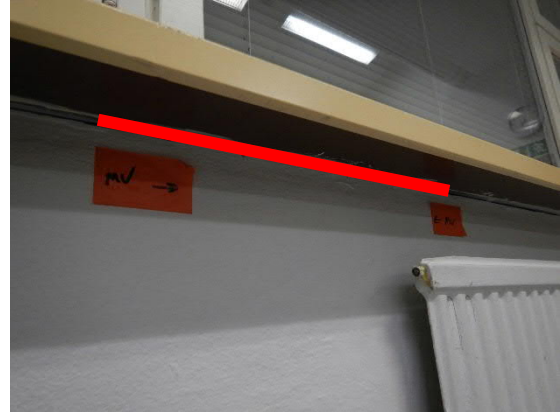
Kuva 27. Merkittävää vuotoa ikkunapenkin alaliittymästä (2).
