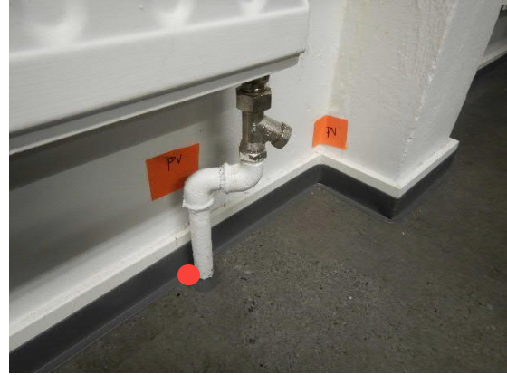
Kuva 3. Pistemäistä vuotoa patteriputkien läpivientien kohdista (2).
