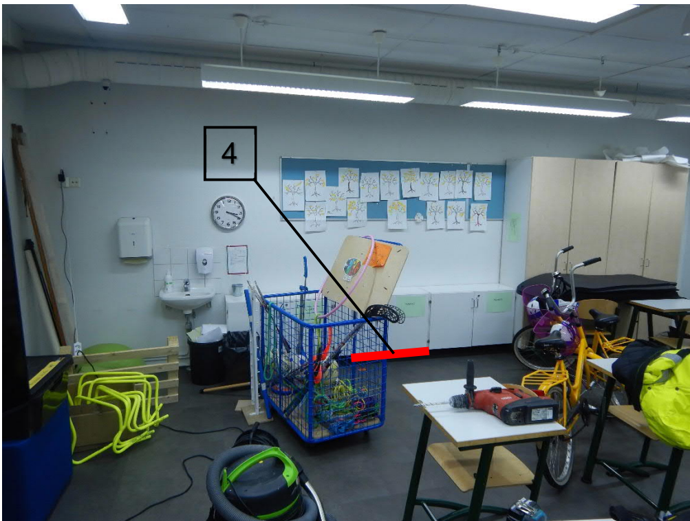
Kuva 13. Havaitut ilmavuotokohdat tilassa 25 käytävän vastaisen väliseinän puolella.
