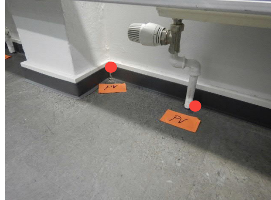
Kuva 36. Pistemäistä vuotoa pilarin ja lattian liitoksen sisänurkista (5). Pistemäistä vuotoa patteriputkien läpiviennestä putkikanaaliin (6).
