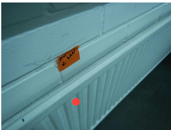
Kuva 18. Pistemäistä vuotoa patterikannakkeiden kautta (6).
