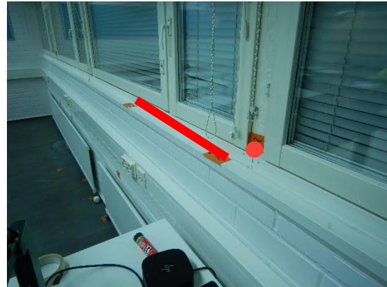
Kuva 15. Merkittävää vuotoa ikkunalistan ja ikkunakarmin saumasta (2) sekä ikkunalistan ja ikkunapenkin saumasta (3).
