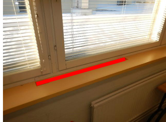
Kuva 22. Vähäistä vuotoa ikkunapenkin ja ikkunaliittymästä (2).
