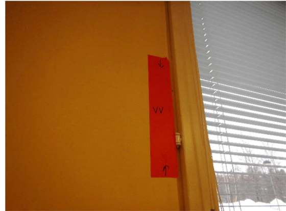
Kuva 9. Vähäistä vuotoa ikkunan ja ulkoseinän liittymästä (2).
