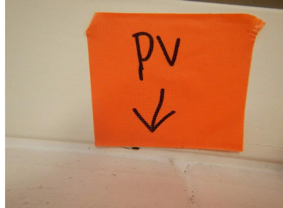
Kuva 7. Useita rakoja ikkunalistan ja ikkunapenkin saumassa (1 ja 3).
