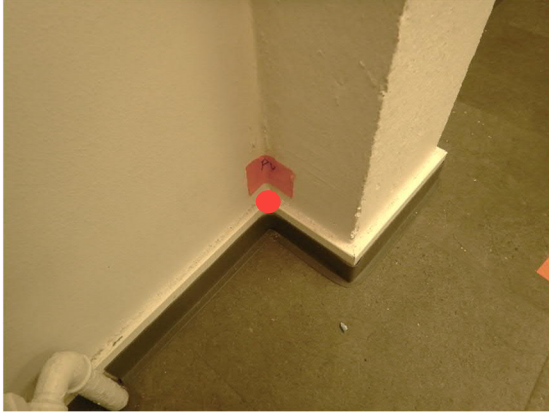
Kuva 2. Pistemäistä vuotoa pilarin ja lattian liittymien sisäkulmista (1).
