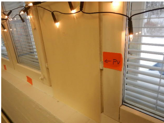
Kuva 10. Pistemäistä vuotoa ikkunan saranan kohdalta (4).
