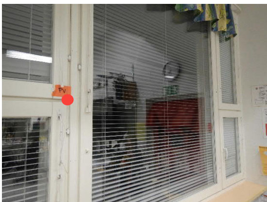
Kuva 30. Pistemäistä vuotoa ikkunakarmin kulmalitoksesta (5).
