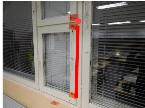
Kuva 29. Vähäistä vuotoa ikkunan pystykarmin liittymästä (4) ja pistemäistä vuotoa ikkunakarmin kulmalitoksesta (5).
