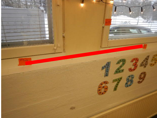
Kuva 6. Merkittävää vuotoa ikkunalistan ja ikkunapenkin saumasta sekä listojen päädyistä (1).
