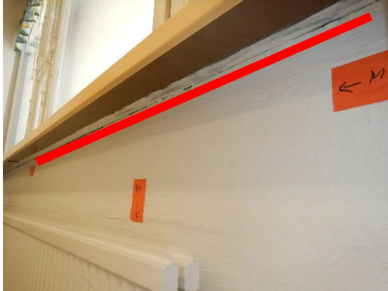
Kuva 21. Merkittävää vuotoa ikkunapenkin alaliittymästä (1).
