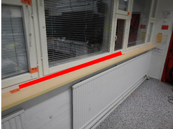
Kuva 26. Merkittävää vuotoa ikkunalistan ja ikkunapenkin saumasta (1).
