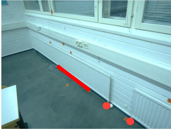
Kuva 14. Merkittävää vuotoa lattian ja ulkoseinän liittymästä (1). Pistemäistä vuotoa patteriputkien läpiviennistä (8).
