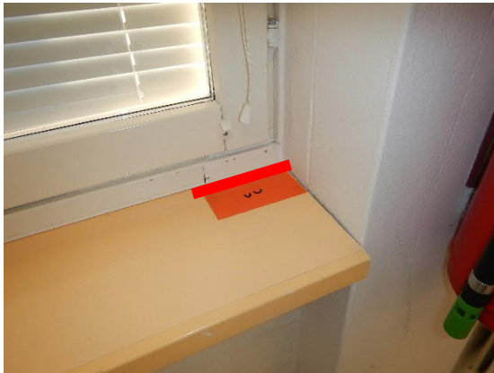
Kuva 23. Vähäistä vuotoa ikkunapenkin ja ikkunaliittymästä (3).
