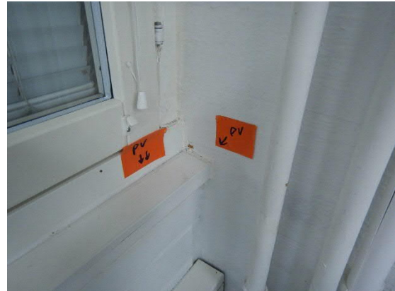
Kuva 17. Pistemäistä vuotoa ikkunapenkin liittymistä (5).
