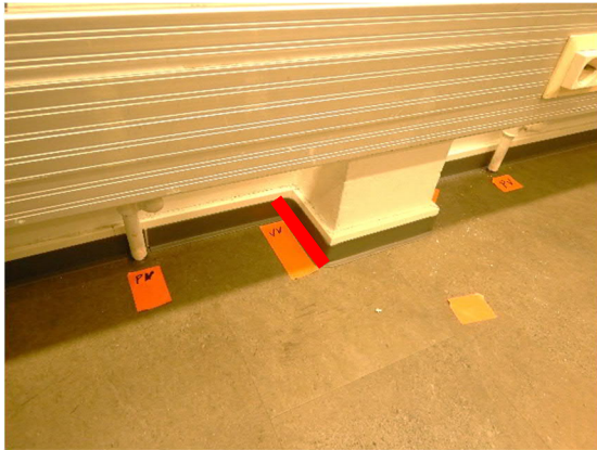
Kuva 37. Vähäistä vuotoa pilarin ja lattian liittymästä (4).
