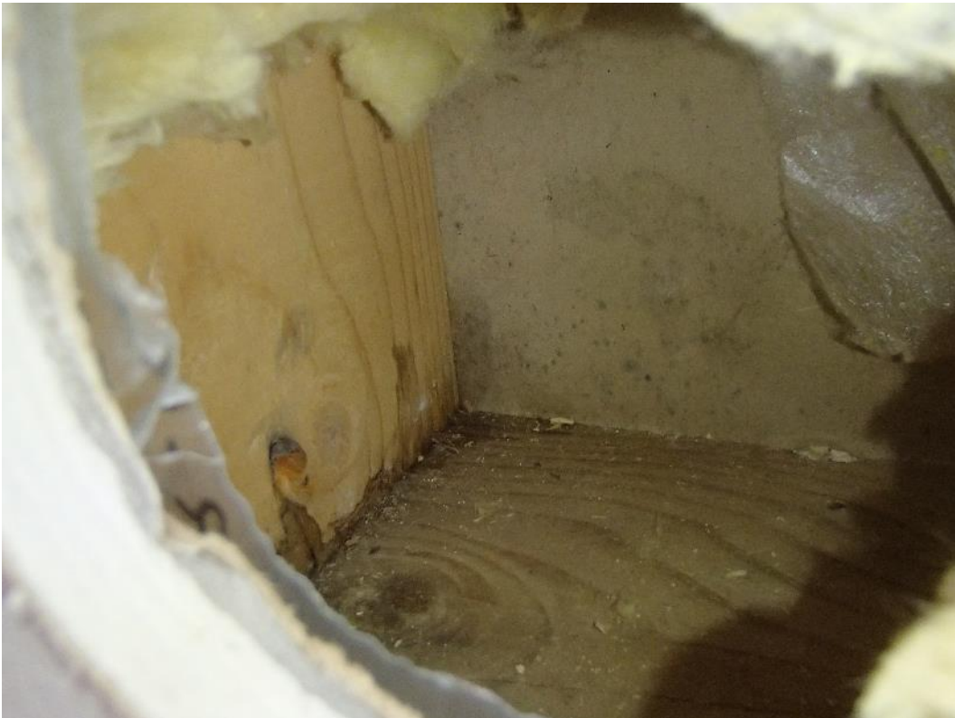
Kuva 4. Rakenneavauskohta RAKS2. Pysty-, alajuoksun ja kipsilevyn rajapinnassa havaittiin mustaa pilkkumaista kasvustoa ja alakulman rakenteet havaittiin aistinvaraisesti kosteaksi.
