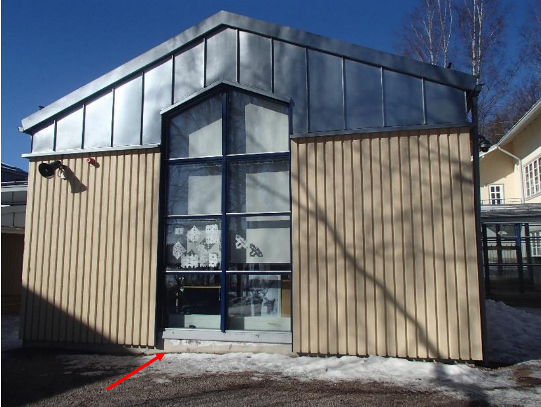
Kuva 7. Opetustilan 7 päätyikkunan alaosaan havaittiin viitteitä kosteudesta.
