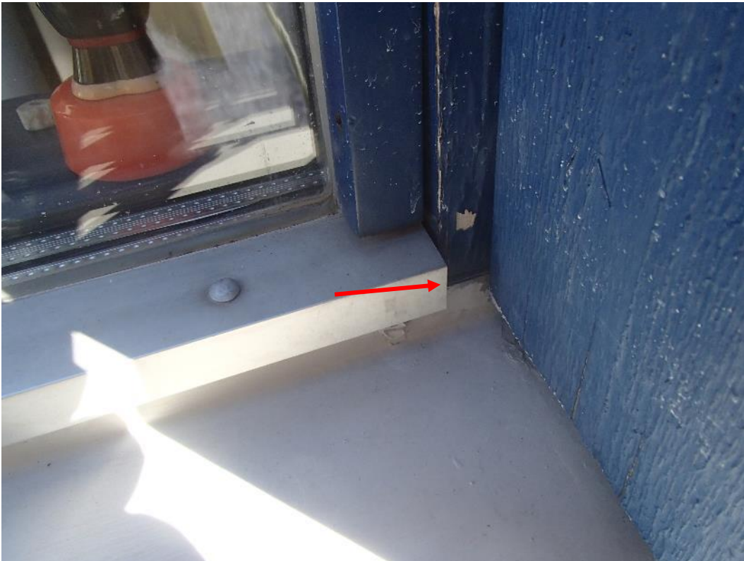
Kuva 8. Ikkunoiden pielilautojen ja pellityksien rajapinnoilla havaittiin pieniä rakoja rakenteisiin.
