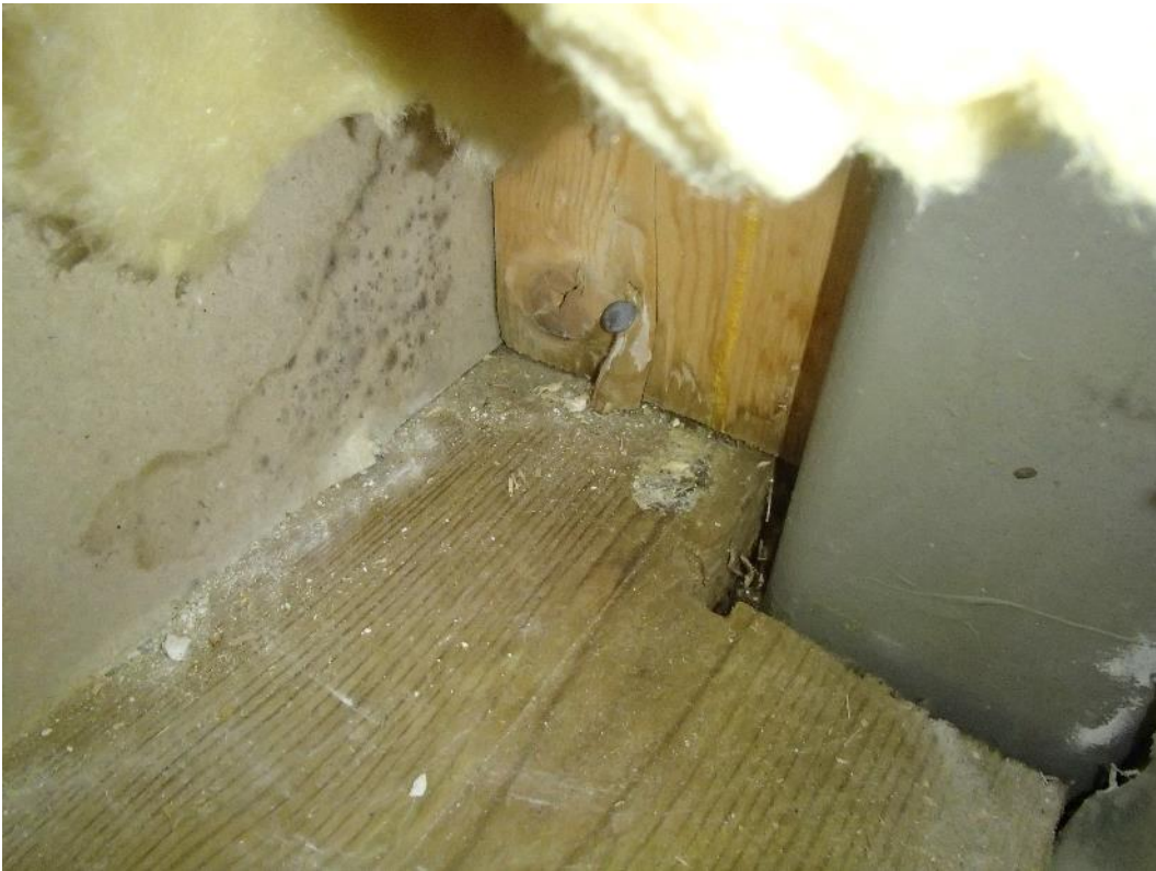
Kuva 3. Rakenneavauskohta RAKS1. Pysty-, alajuoksun ja kipsilevyn rajapinnassa havaittiin mustaa pilkkumaista kasvustoa ja vanhoja kosteusjälkiä.
