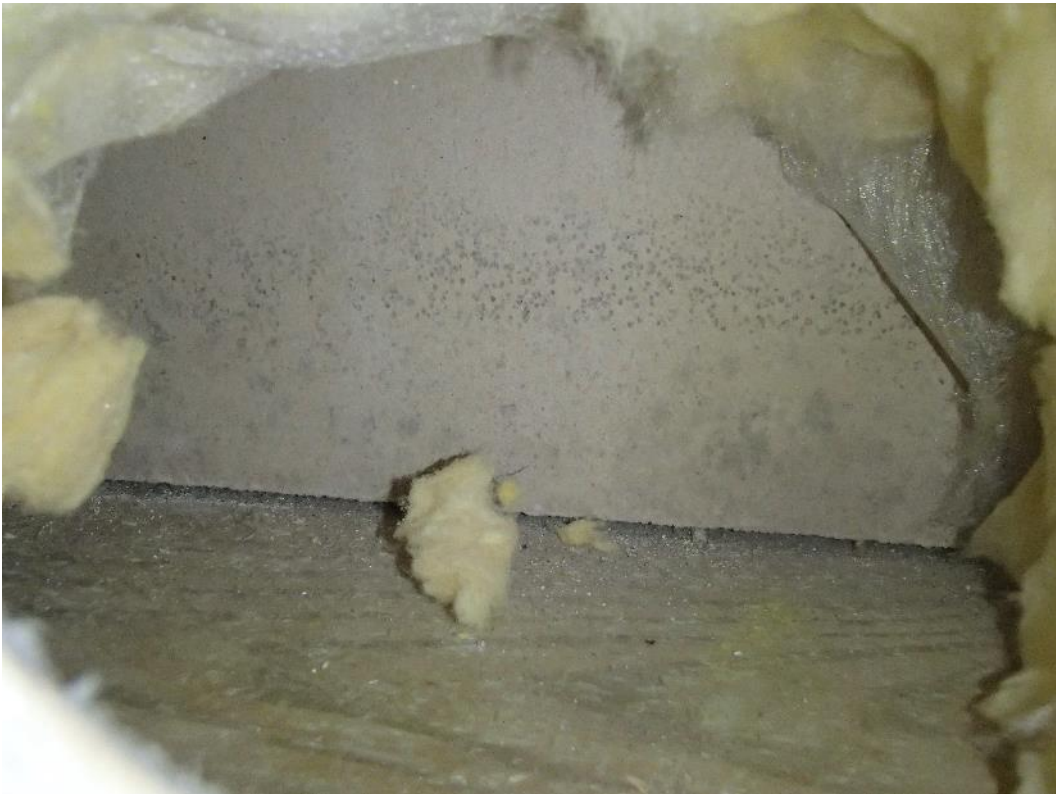
Kuva 6. Rakenneavauskohta RAKS4. Alajuoksun ja kipsilevyn rajapinnassa havaittiin mustaa pilkkumaista kasvustoa.
