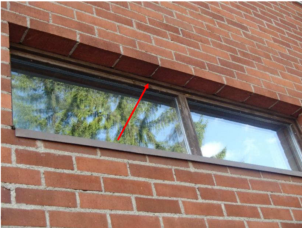
Kuva 107. Liikuntasalirakennuksen ikkunoiden liitokset tiilimuuraukseen ovat avonaiset.
