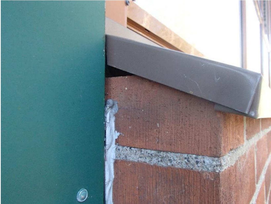
Kuva 100. Pellityksien ja julkisivujen liitoskohdissa on rakoja rakenteiden sisään.
