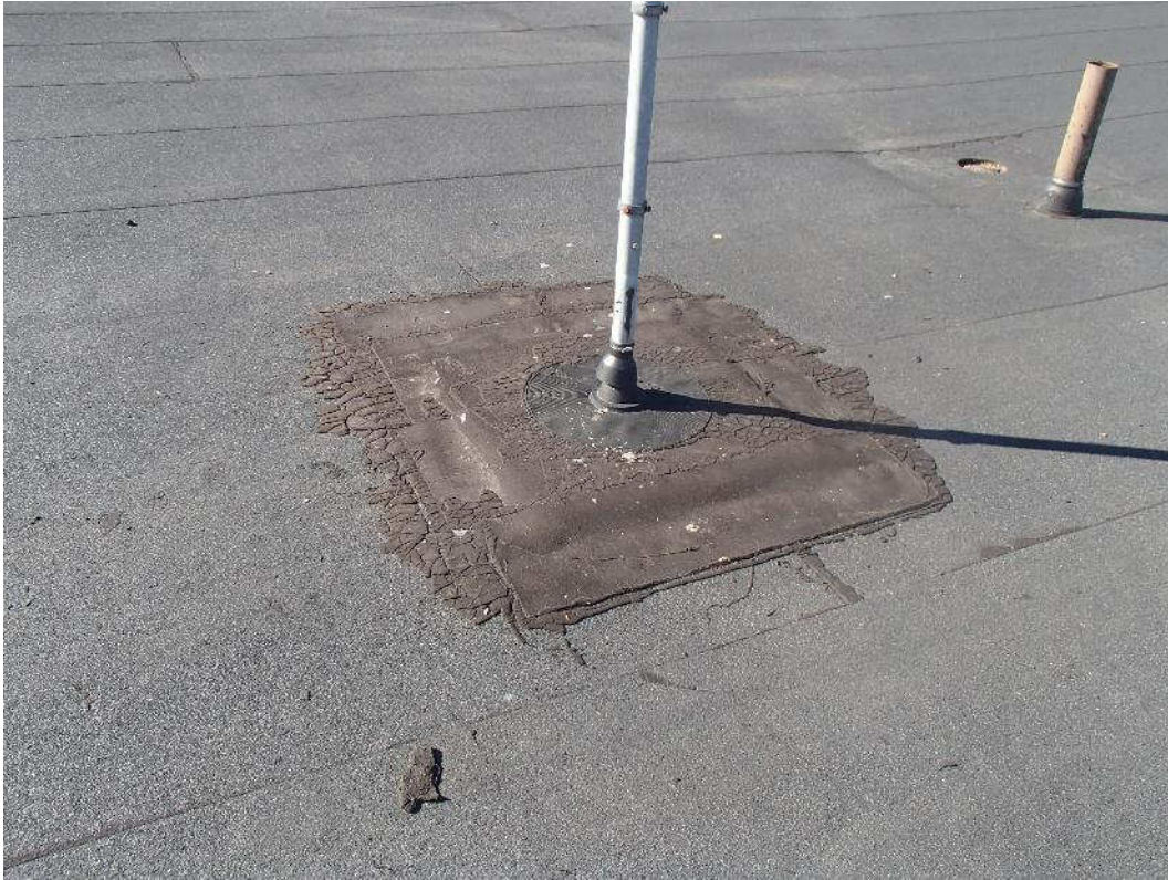
Kuva 64. Antennin tiivistysbitumit ovat halkeilleet.
