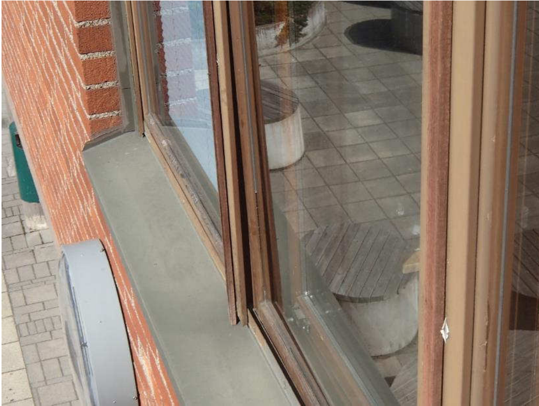
Kuva 23. Ikkunoiden maalipinnat ovat ikääntyneet ja puuosissa havaittavissa halkeilua sekä paikoin peitelistat irtoilevat.
