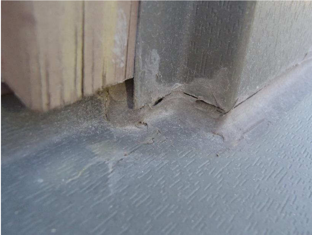
Kuva 15. Pellityksien ja ikkunoiden rajapinnoilla havaittiin reikiä ja rakoja rakenteisiin.
