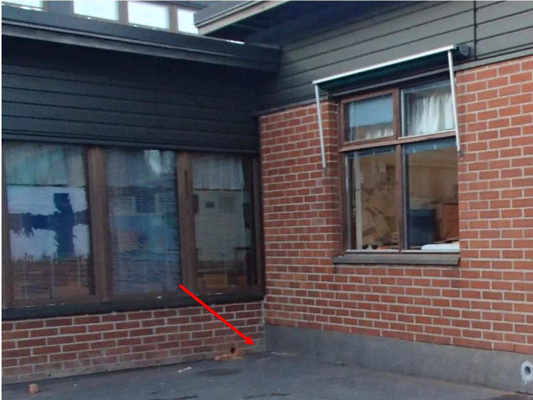
Kuva 27. Sokkelit ovat paikoin erittäin matalat.
