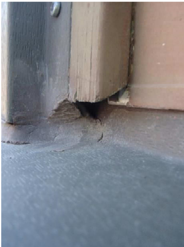
Kuva 14. Pellityksien ja ikkunoiden rajapinnoilla havaittiin reikiä ja rakoja rakenteisiin.
