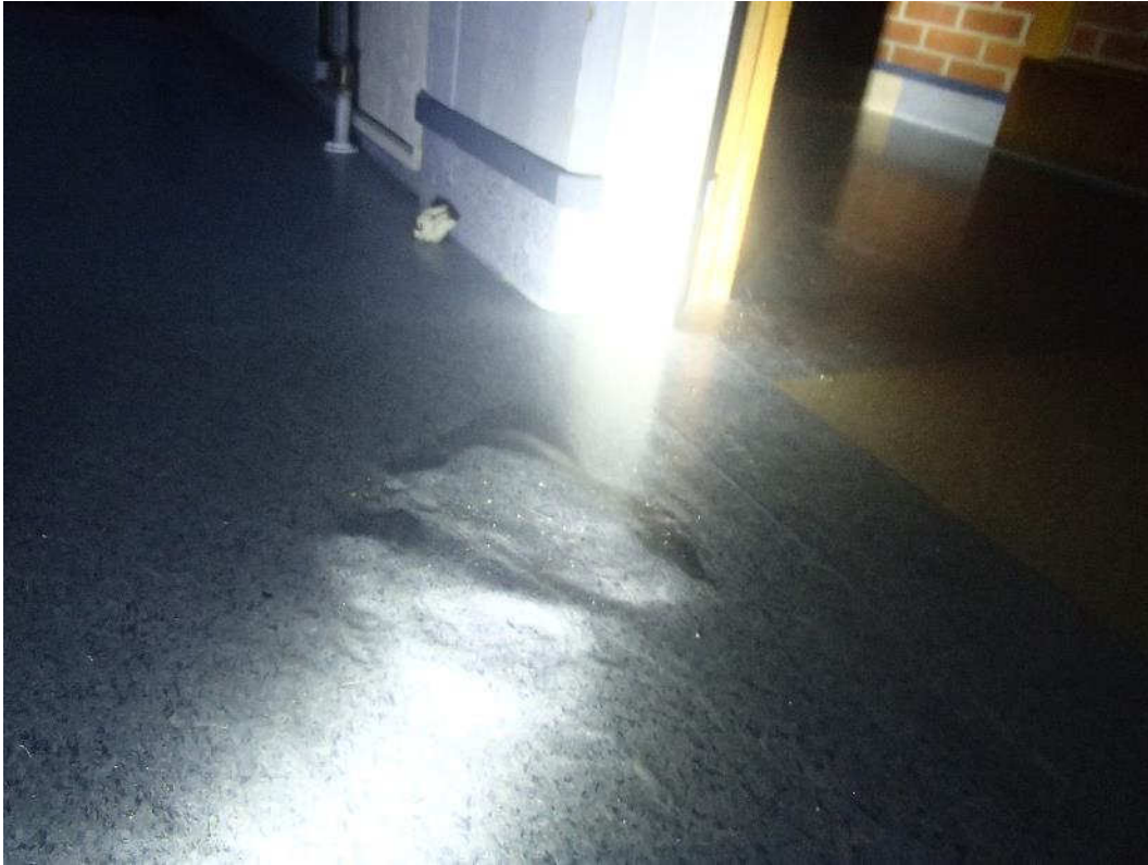
Kuva 88. Ruokalan lattian pintamateriaalissa havaittiin kosteudesta aiheutunutta pintamateriaalien irtoilua.
