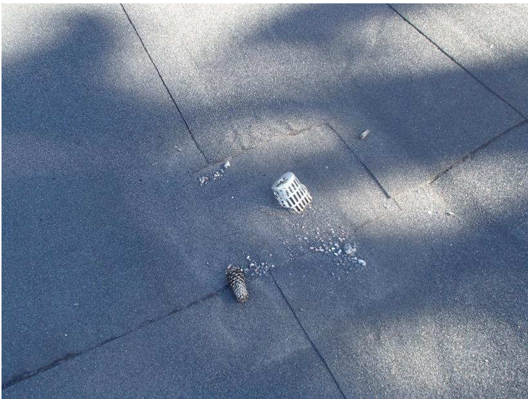
Kuva 65. Osa kattokaivoista on vaurioitunut.
