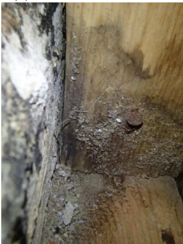
Kuva 46. Valopihan kevytrakenteisen seinän alaosissa havaittiin kosteusvaurioita rungon alapuussa ja pystytolpan alaosassa.
