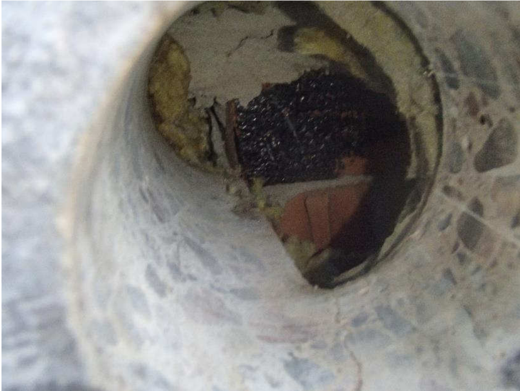
Kuva 116. Sokkeleiden ulkokuoren betonikerroksen vahvuus on paikoin 75 mm, jonka pitäisi suunnitelmien mukaan olla 190 mm.
