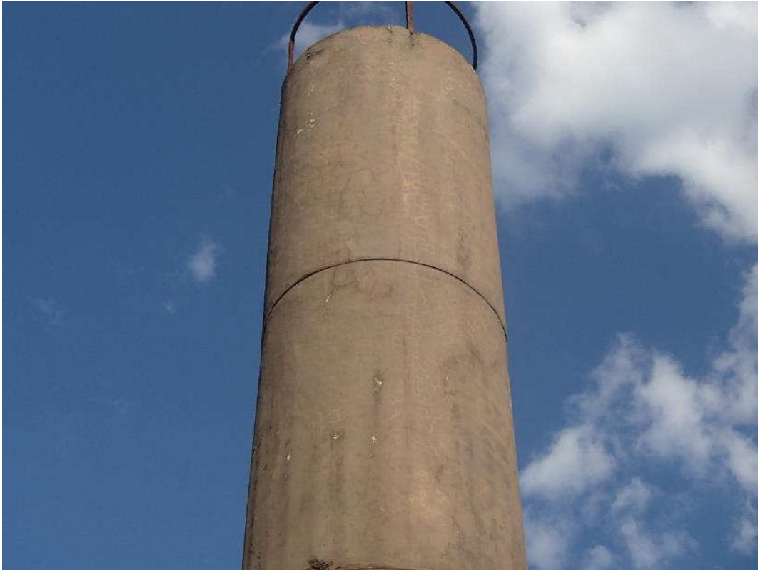
Kuva 25. Rakennuksen piipussa on pakkasrapautumiseen viittaavaa verkkomaista halkeilua.
