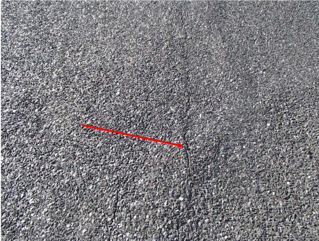
Kuva 62. Vesikatteessa havaittiin paikoin lievää halkeilua.
