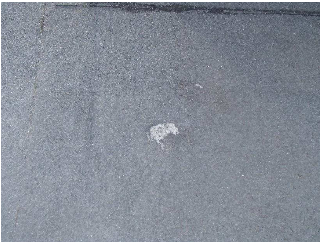
Kuva 63. Vesikatteessa havaittiin paikoin kulumaa ja sirotteet ovat irronneet kokonaan.
