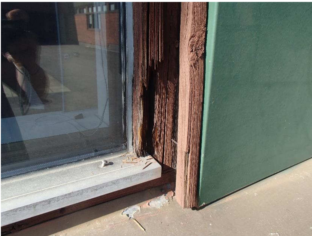
Kuva 113. Ikkunoiden alaosissa oli havaittavissa lahovaurioita.
