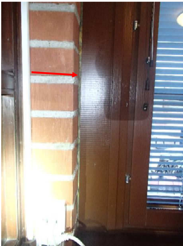
Kuva 42. Vanhojen julkisivujen ja ikkunoiden rajapinnasta on tilketilasta suora ilmayhteys sisäilmaan.
