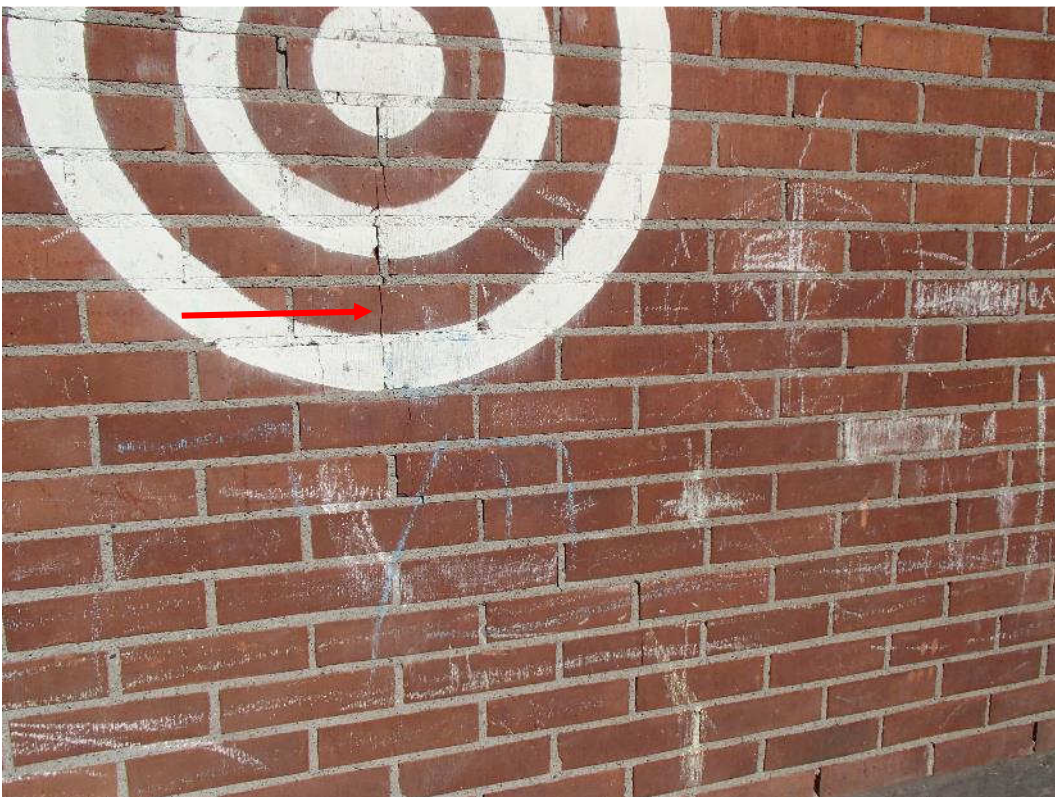
Kuva 105. Tiilimuurauksessa havaittiin halkeilua.
