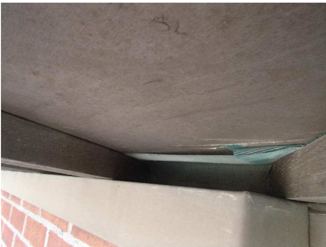
Kuva 70. Tuuletusraon hyönteisverkot ovat paikoin irronneet kiinnityksestään.
