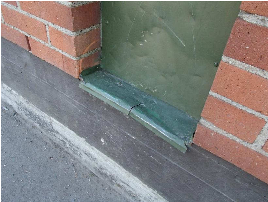
Kuva 103. Paikoin vesipellitykset ovat vaurioituneet.
