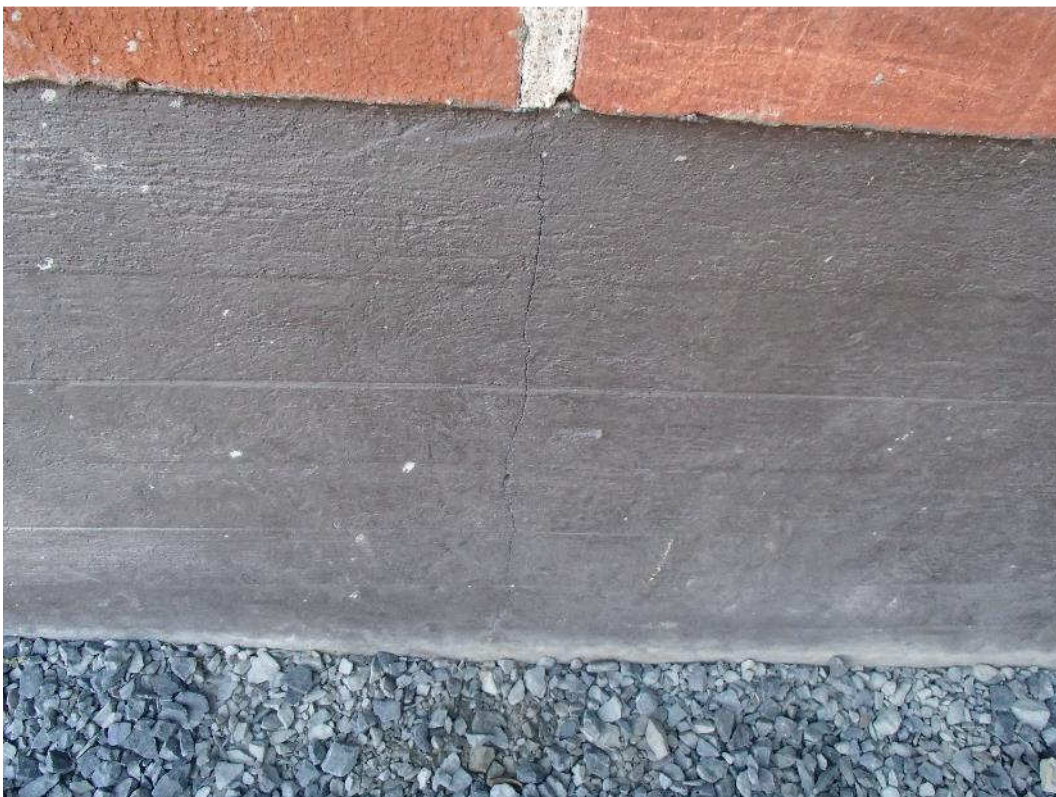
Kuva 27. Sokkelissa havaittiin halkeilua.
