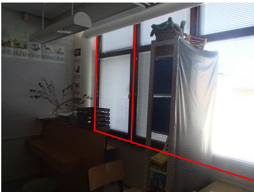
Kuva 159. Luokan 51 tyypillisimmät epätiiveyskohdat.
