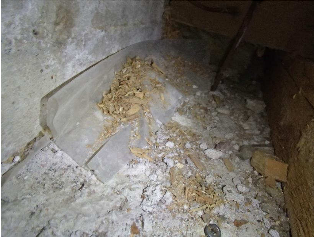
Kuva 90. Kotitalousluokan eristetilassa havaittiin rakennusaikaista puujäätteitä. Lankkulat-tian puurunko on asennettu suoraan alapohjan betonivalun päälle.
