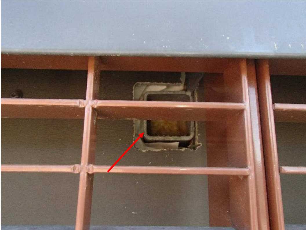
Kuva 139. Julkisivuilla havaittiin avonaisia neliöputkia.
