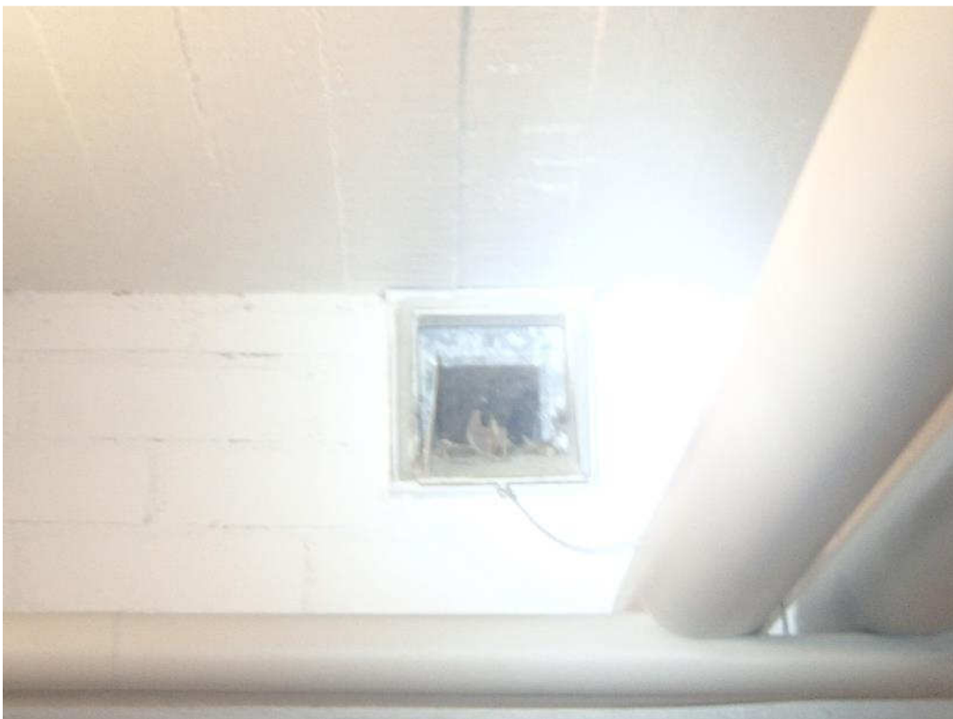
Kuva 94. Kellarin sisäilmaan virtaa korvausilmaa vanhan likaisen IV-kanavan kautta.
