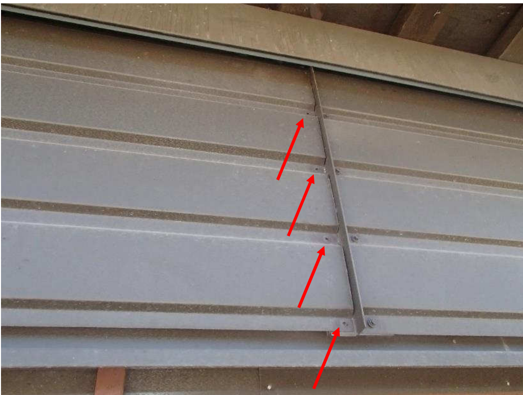
Kuva 22. Julkisivujen profiilipellityksistä on irronnut kiinnitysruuveja.
