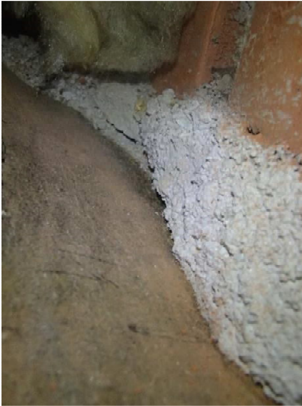
Kuva 37. Sokkelin ja tiilimuurauksen välissä havaittiin bitumikermikaistale.
