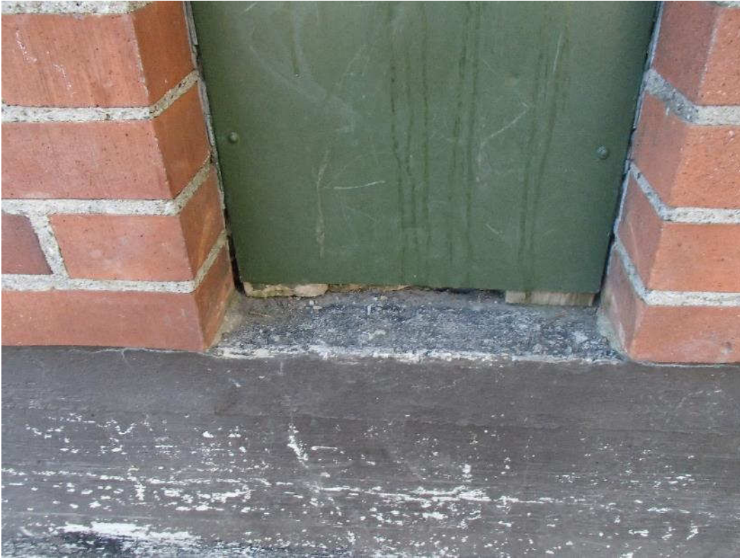
Kuva 104. Paikoin vesipellitykset on revitty irti.
