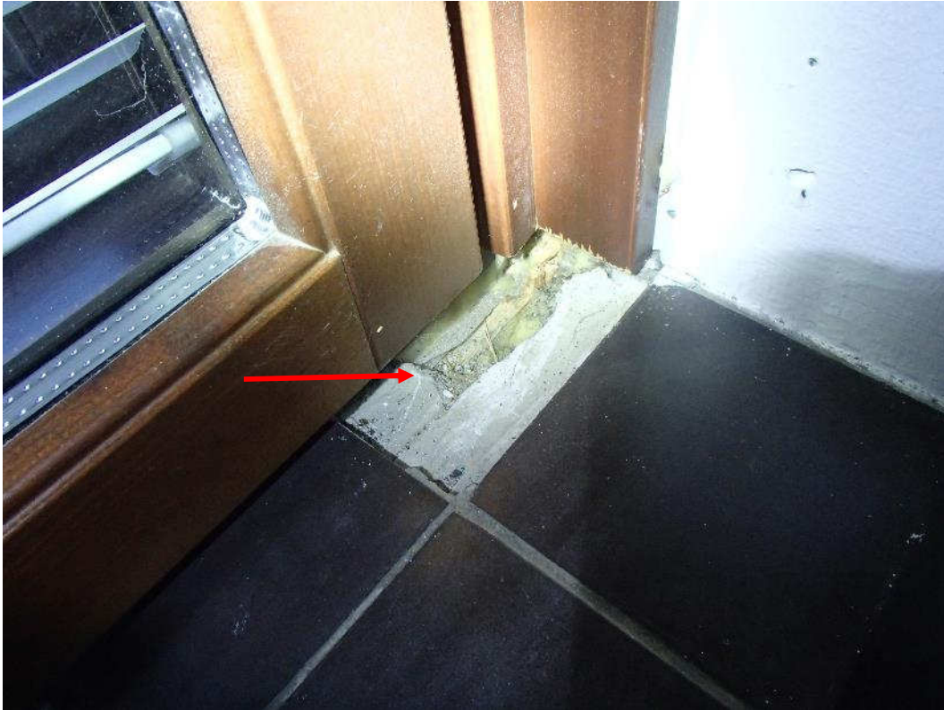
Kuva 120. Ikkunapenkkin ja ikkunarakenteiden välisistä havaittiin suoria ilmayhteyksiä eristettiin.
