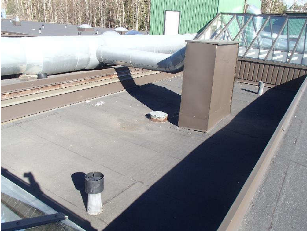
Kuva 67. Osa kattokaivoista on irti paikoiltaan.
