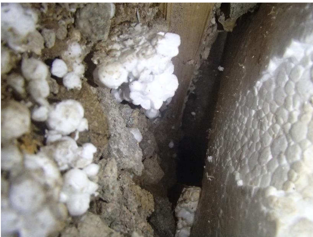
Kuva 133. Pilarianturan muottilaudoitukset on jäänyt purkamatta rakennusaikana.
