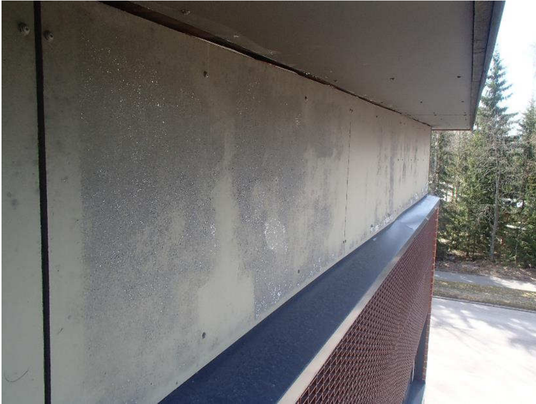
Kuva 143. Räystäiden alla oleva levytysten maalipinnat hilseilevät.
