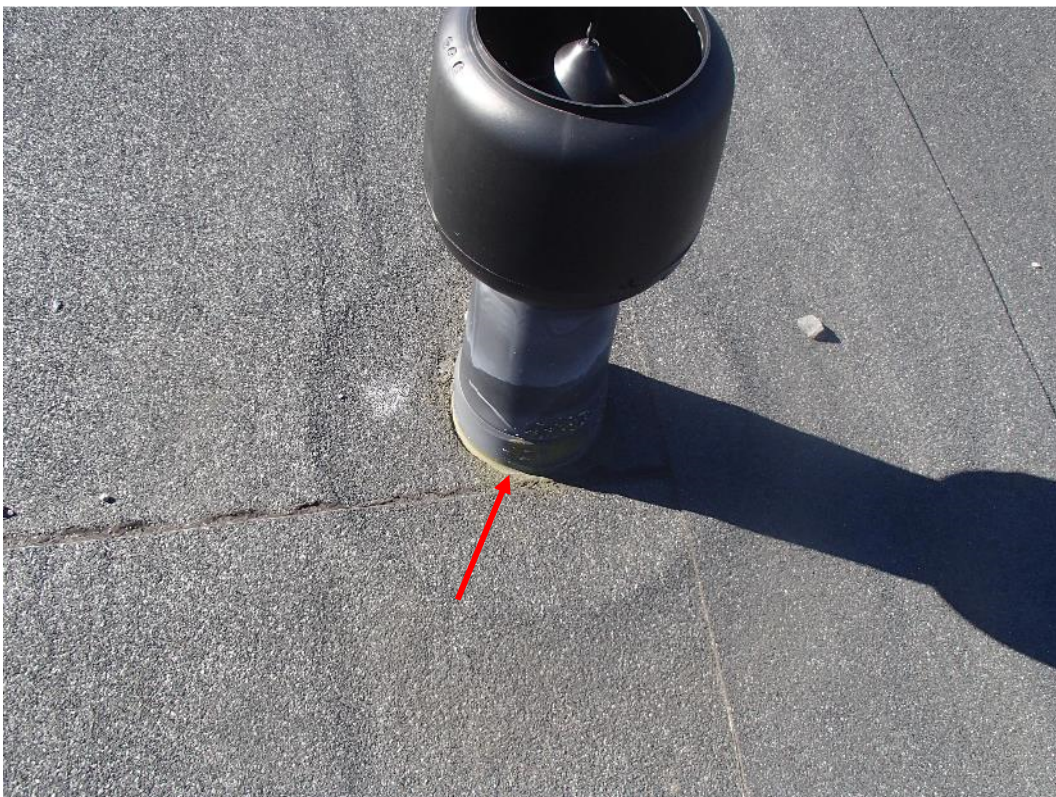
Kuva 61. Kattotarvikkeiden ja bitumikermin välissä ei havaittu tiivistysmassaa, mutta bitumikermin välissä on vedeneristyslaippa.
