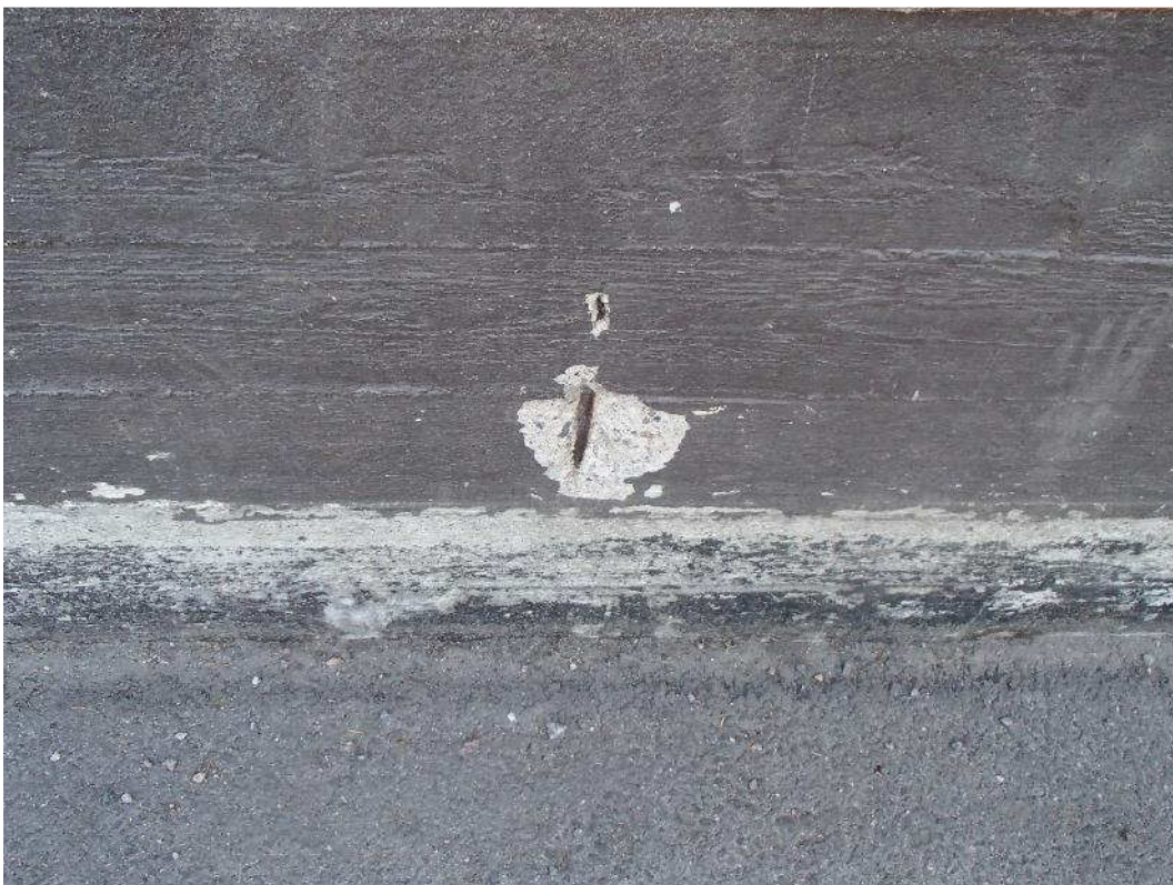
Kuva 115. Sokkeleissa havaittiin betoniteräskorroosion aiheuttamia vaurioita.
