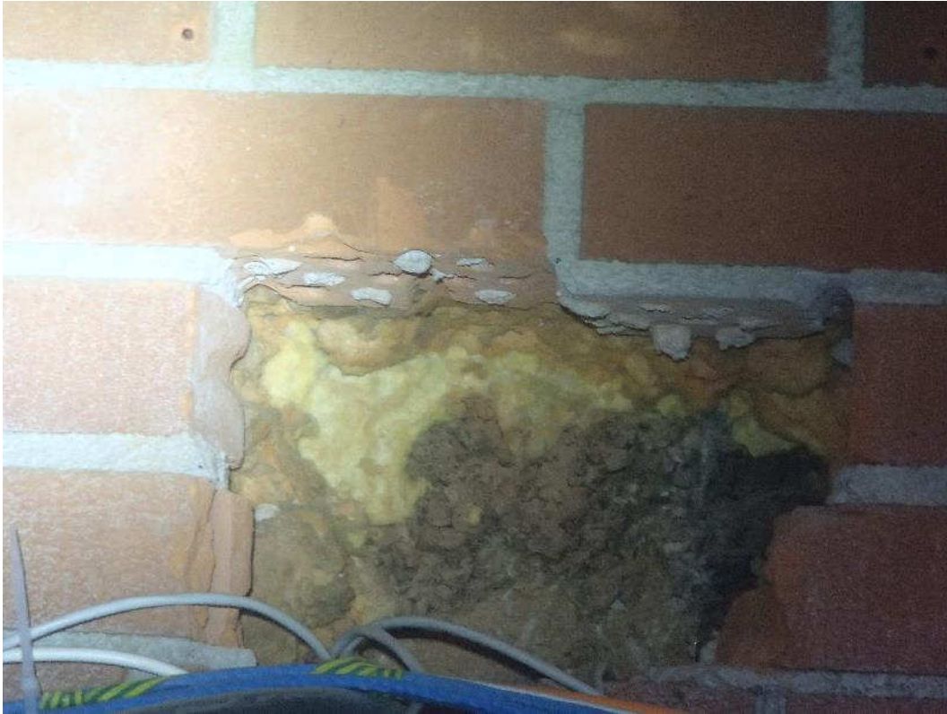
Kuva 43. Vanhoissa julkisivuissa on aukkoja, joista on suora ilmayhteys käytävään.
