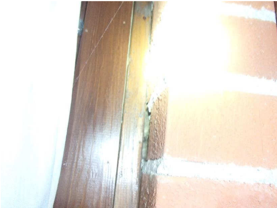
Kuva 16. Luokahuoneiden sisältä tarkastettuna ikkunoiden ja tiilimuurattujen rajapinnassa on tilktilasta suora yhteys sisäilmaan.
