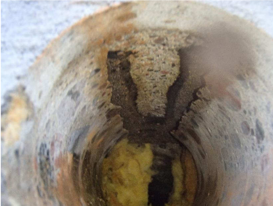
Kuva 5. Rakenneavaus vuonna 1967 rakennetun osan sokkelirakenteeseen.
