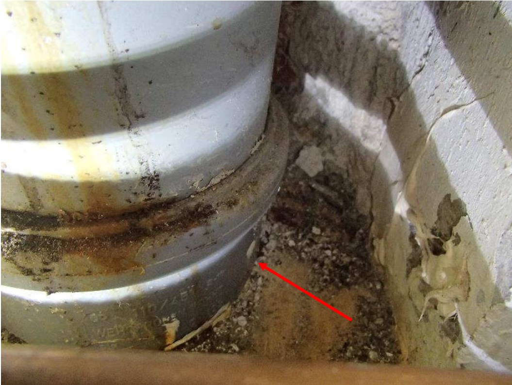
Kuva 92. Kotitalousluokan läpivienti alapohjaan.
