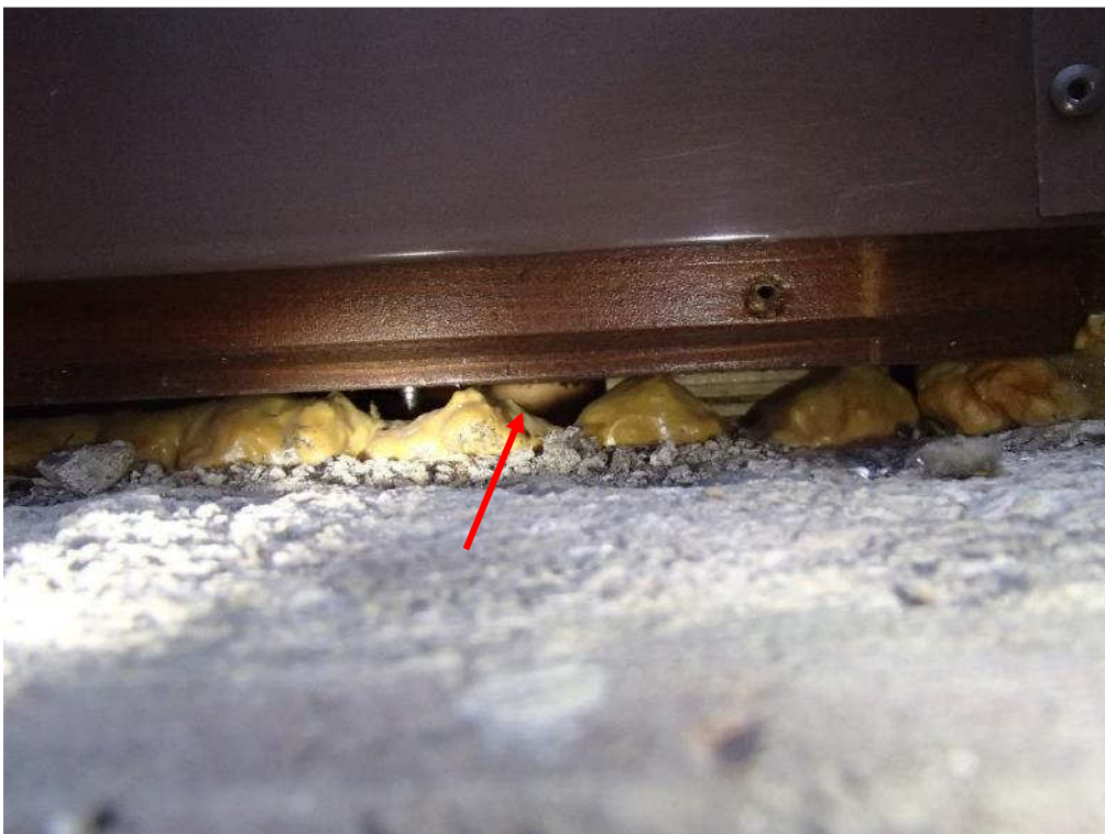
Kuva 40. Valopihan ikkunoiden karmirakenteet ja apukarmin välissä havaittiin eristevajausta.
