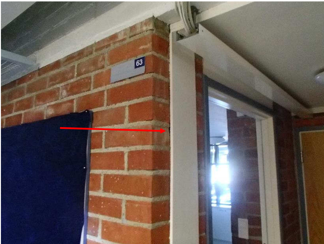
Kuva 48. Vanhojen julkisivujen aukkoja on peitetty levyillä, joiden reunoilta on suora ilmayhteys käytävään.
