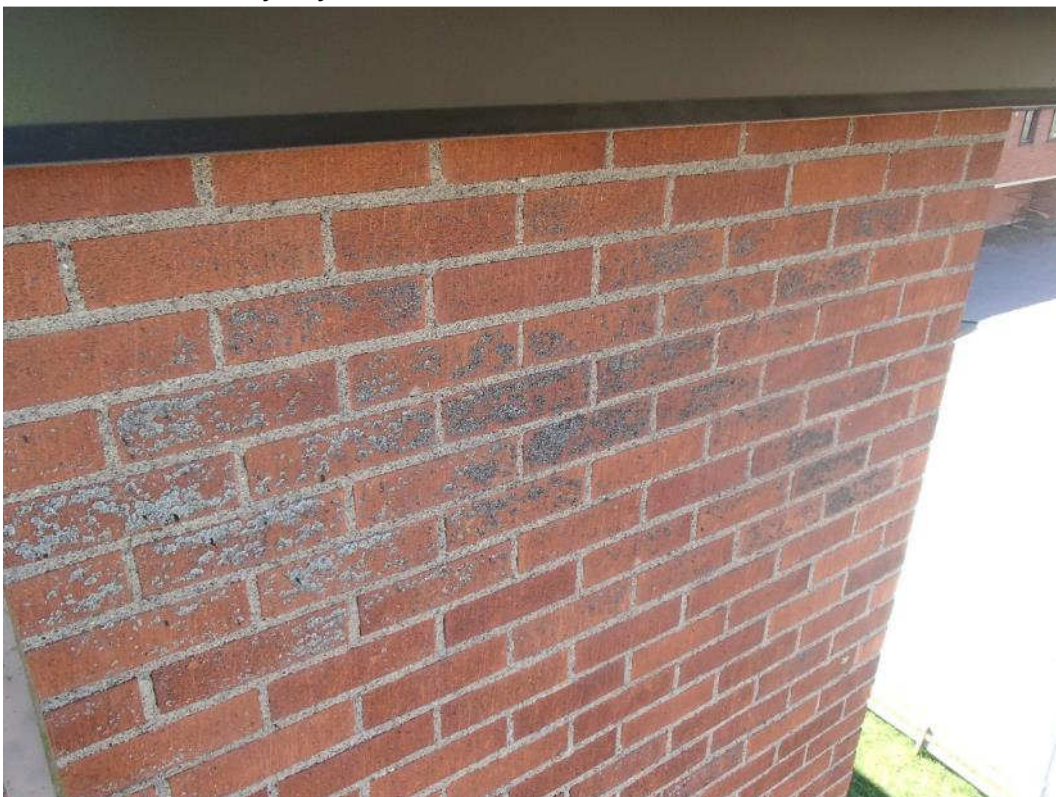
Kuva 18. Tiilipinnoilla havaittiin jäkälän kasvua.
