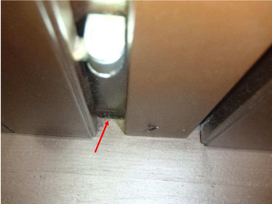
Kuva 17. Luokkahuoneiden sisältä tarkastettuna ikkunoiden ja tiilimuurattujen rajapinnassa on tilketilasta suora yhteys sisäilmaan.
