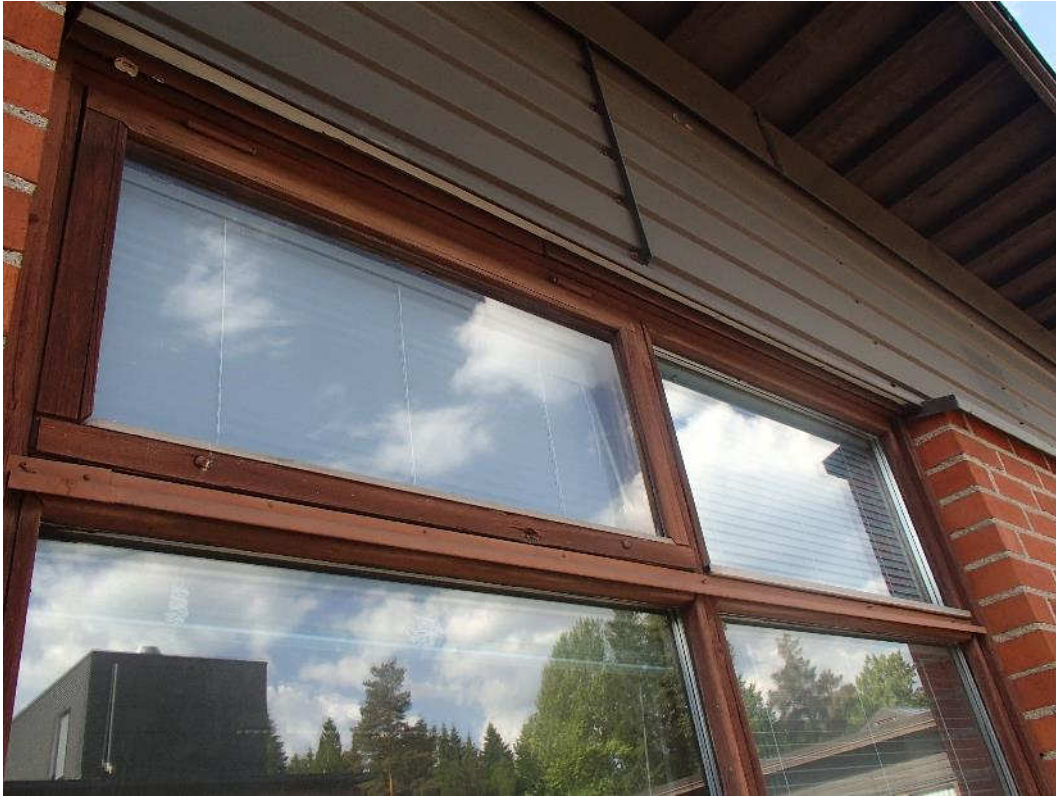
Kuva 112. Ikkunoiden puumateriaalit ovat ikääntyneet.
