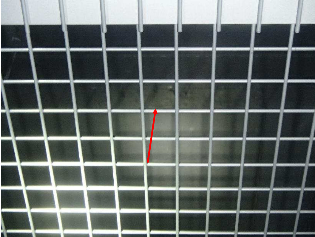
Kuva 145. Yläkoulun käytävien katoissa havaittiin esillä olevia maalattuja mineraalivilloja.
