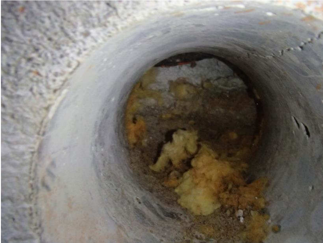
Kuva 39. Valopihojen sokkeleiden eristehalkaisun mineraalivillat ovat paikoin maata vasten.
