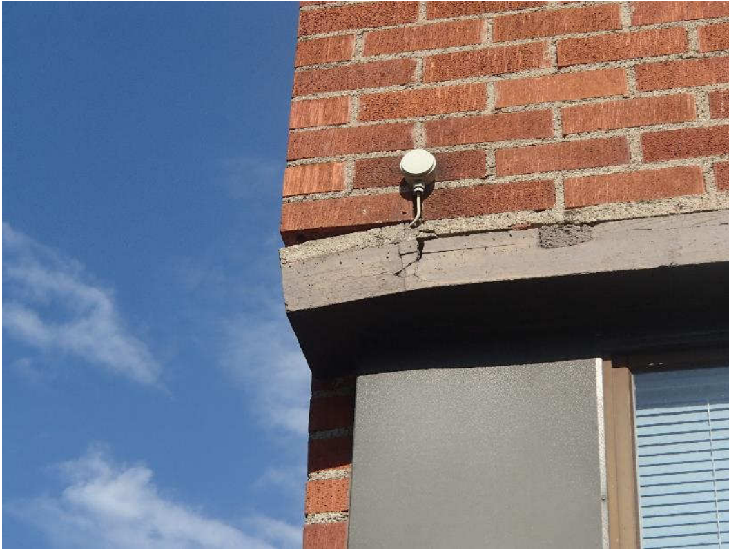
Kuva 11. Julkisivujen betonirakenteista on irtoamassa betonikappaleita.
