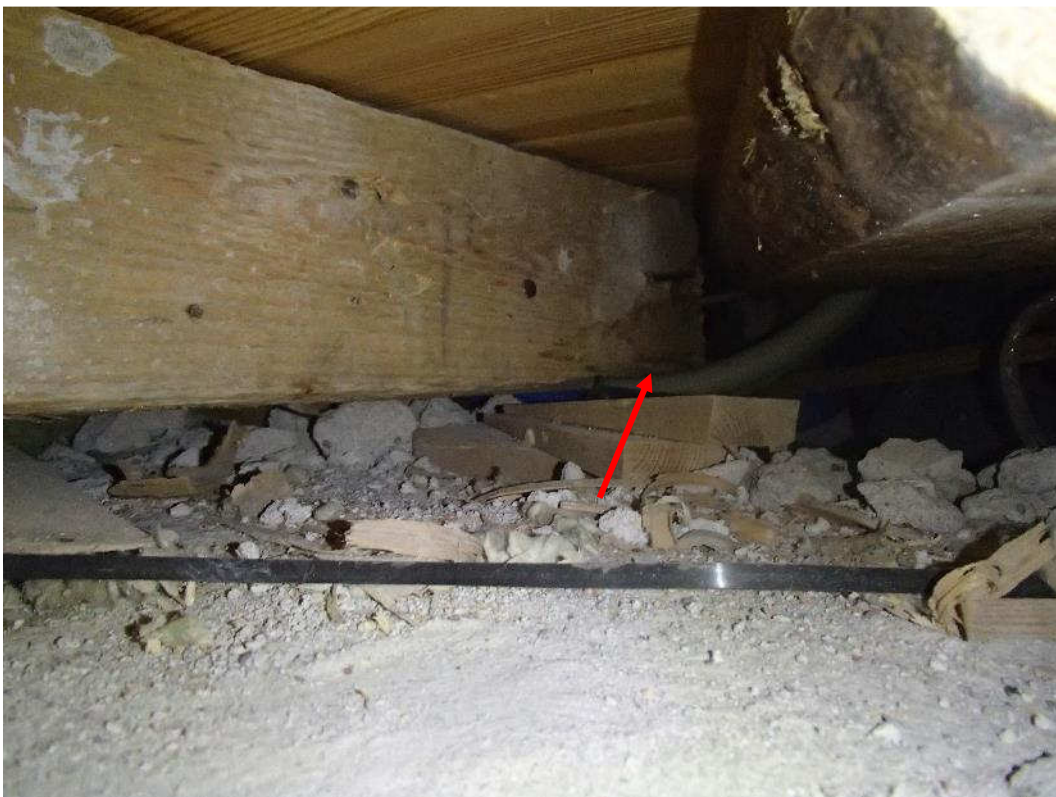
Kuva 89. Kotitalousluokan eristetilassa havaittiin rakennusaikaista puujäänteitä ja puurun- gossa havaittiin vanhoja kosteusjälkiä.
