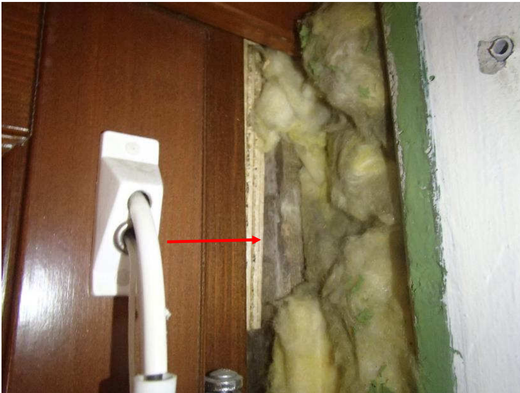
Kuva 118. Tiilimuurausten ja ikkunarakenteiden välisissä eristeissä havaittiin tummentumista ja apukarmeissa kosteusrasitukseen viittaavia tekijöitä.
