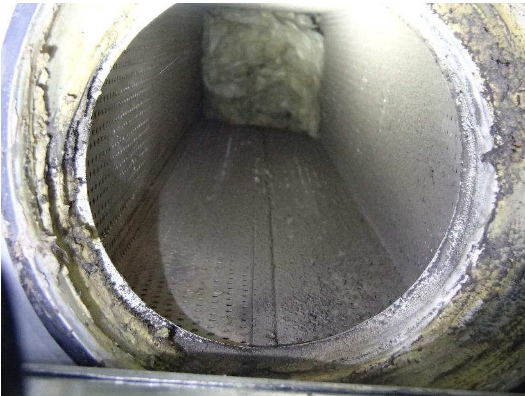
Kuva 72. Yläpohjassa havaittiin kotitalousluokan alakaton yläpuolella vanha likainen ja mineraalivillalla tukittu IV-kanava.
