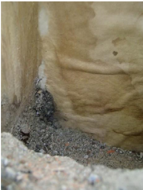
Kuva 45. Valopihan kevytrakenteisen seinän alaosissa havaittiin kosteusvaurioita rakennuspaperissa.
