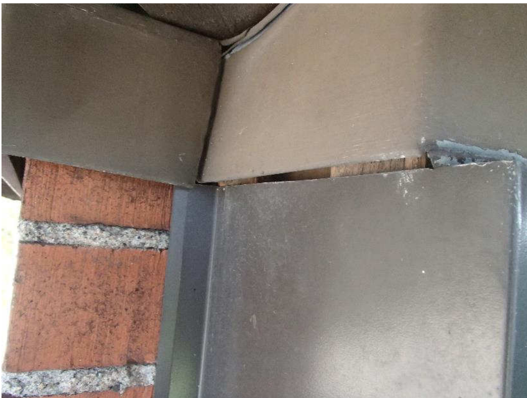
Kuva 101. Pellityksien liitoskohdissa on rakoja rakenteiden sisään.
