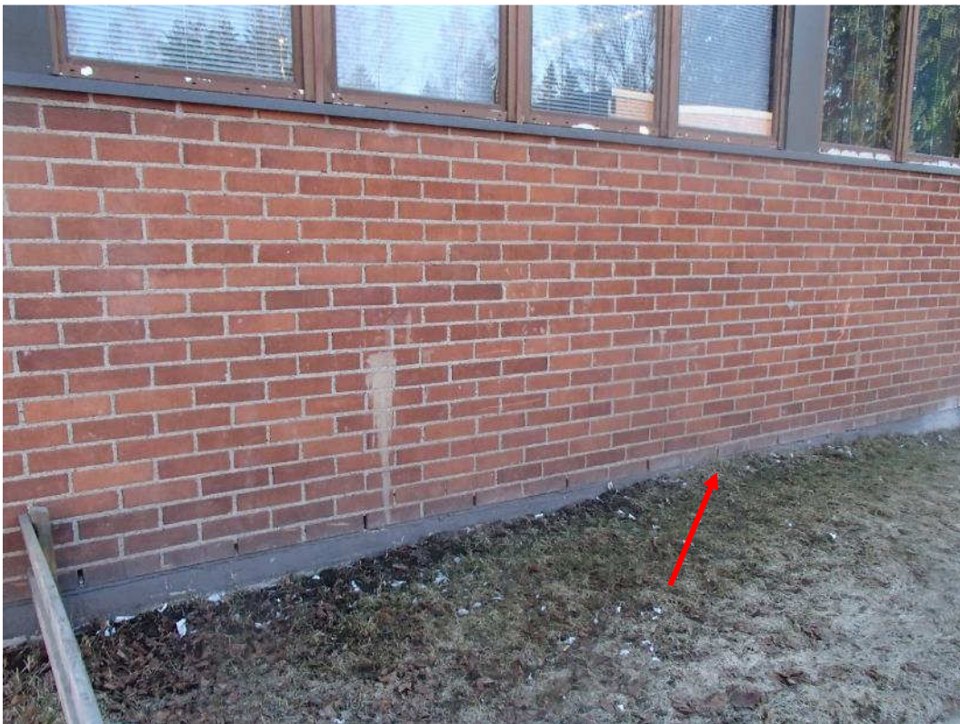
Kuva 26. Sokkelit ovat paikoin matalat.
