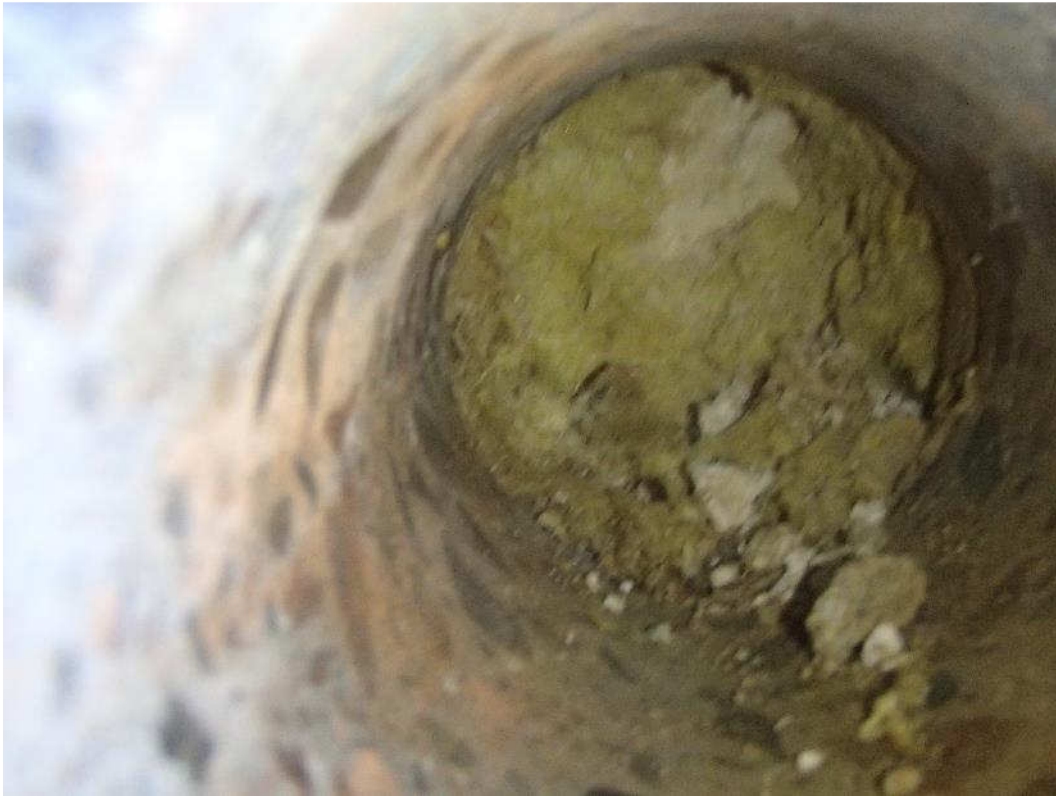
Kuva 97. Rakenneavaus vuonna 1976 rakennetun osan sokkelirakenteeseen.
