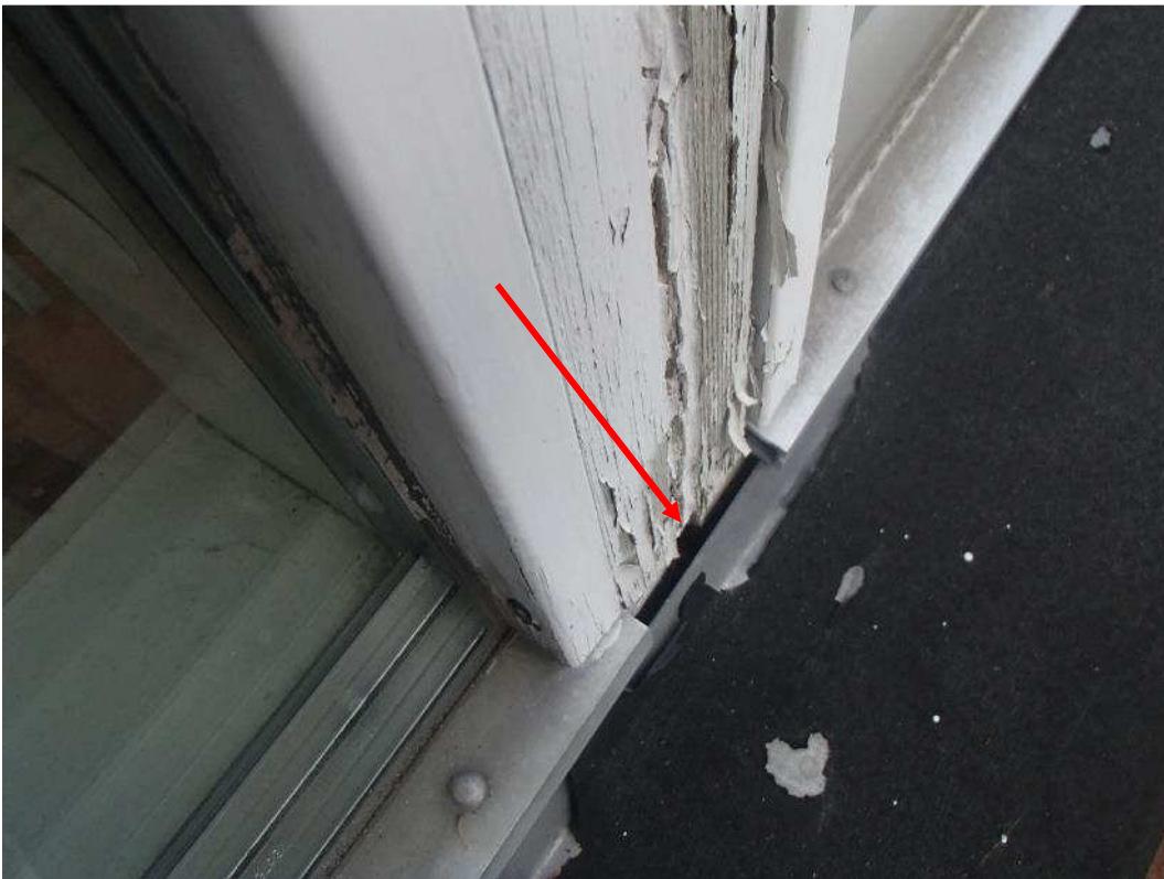
Kuva 23. Sisäpihan vesipeltien ja ikkunoiden rajapinnoissa on rakoja rakenteisiin.
