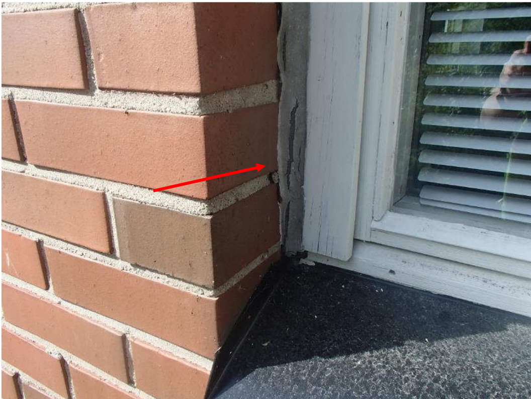
Kuva 13. Julkisivujen elastiset saumamassat ovat vaurioituneet.
