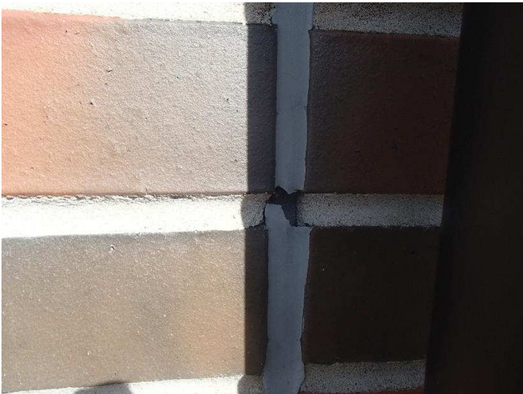
Kuva 77. Julkisivujen elastiset saumamassat ovat vaurioituneet.
