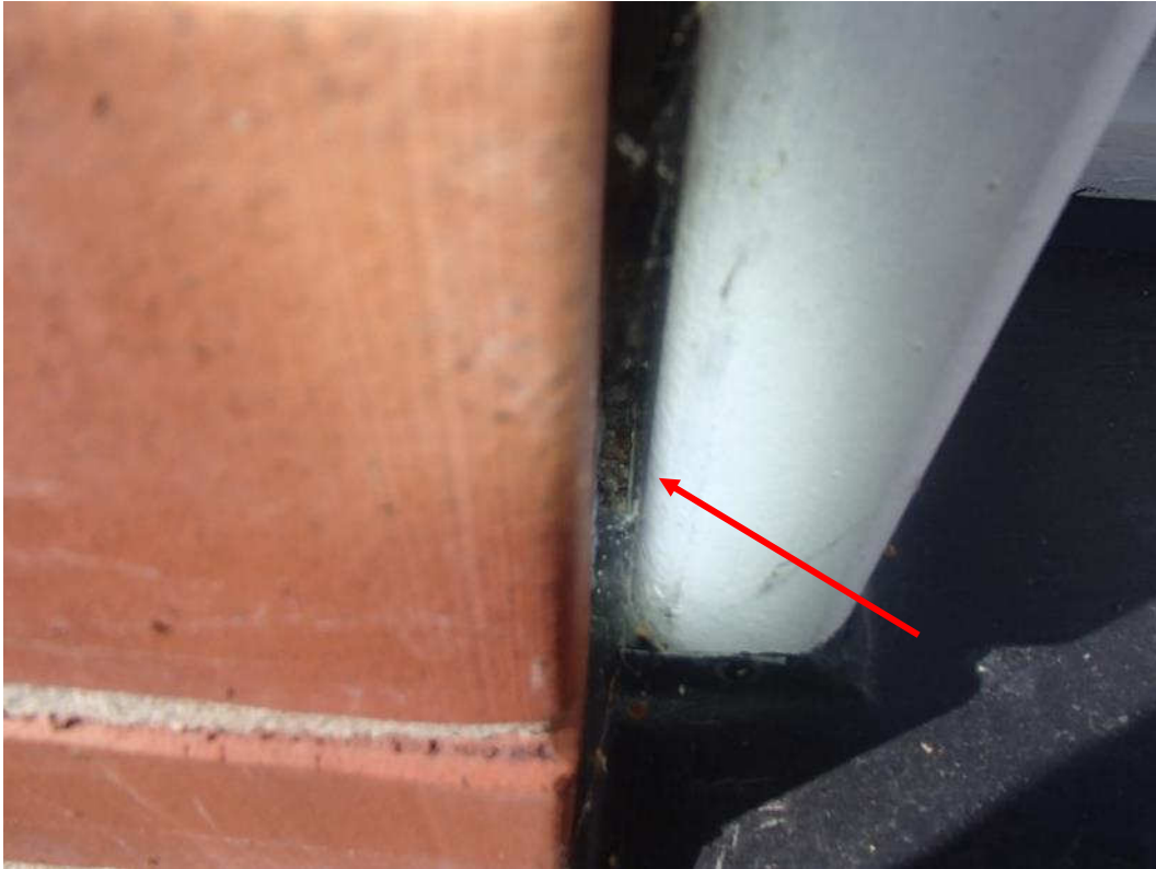
Kuva 18. Julkisivumuurausten ja ikkunarakenteiden välissä on rakoja, joista sadevesi pääsee kulkeutumaan rakenteisiin.
