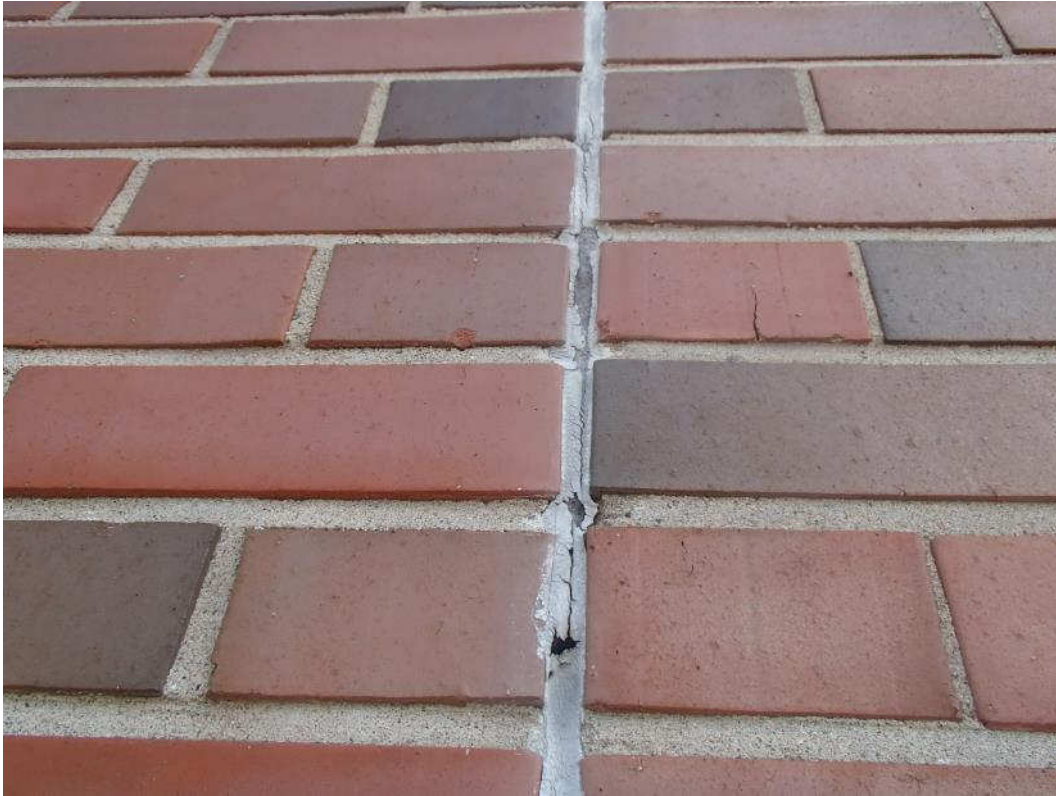
Kuva 14. Julkisivujen elastiset saumamassat ovat vaurioituneet.
