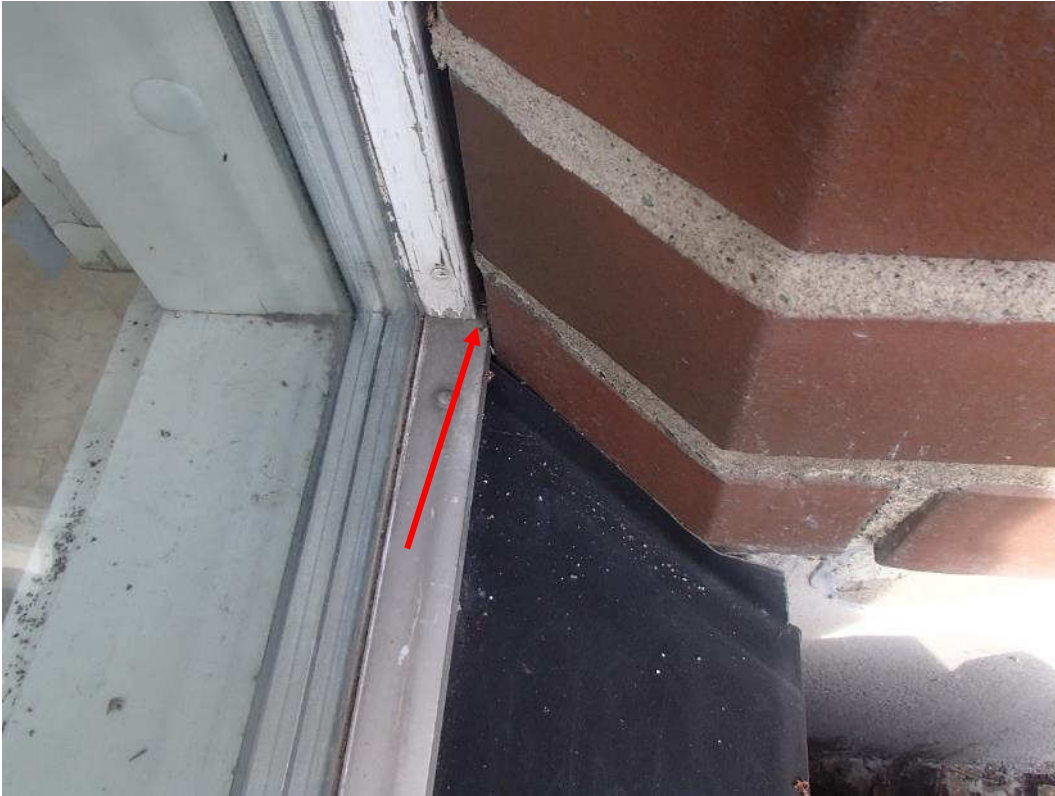
Kuva 22. Sisäpihan tiilimuurausten, vesipeltien ja ikkunoiden rajapinnoissa on rakoja rakenteisiin.
