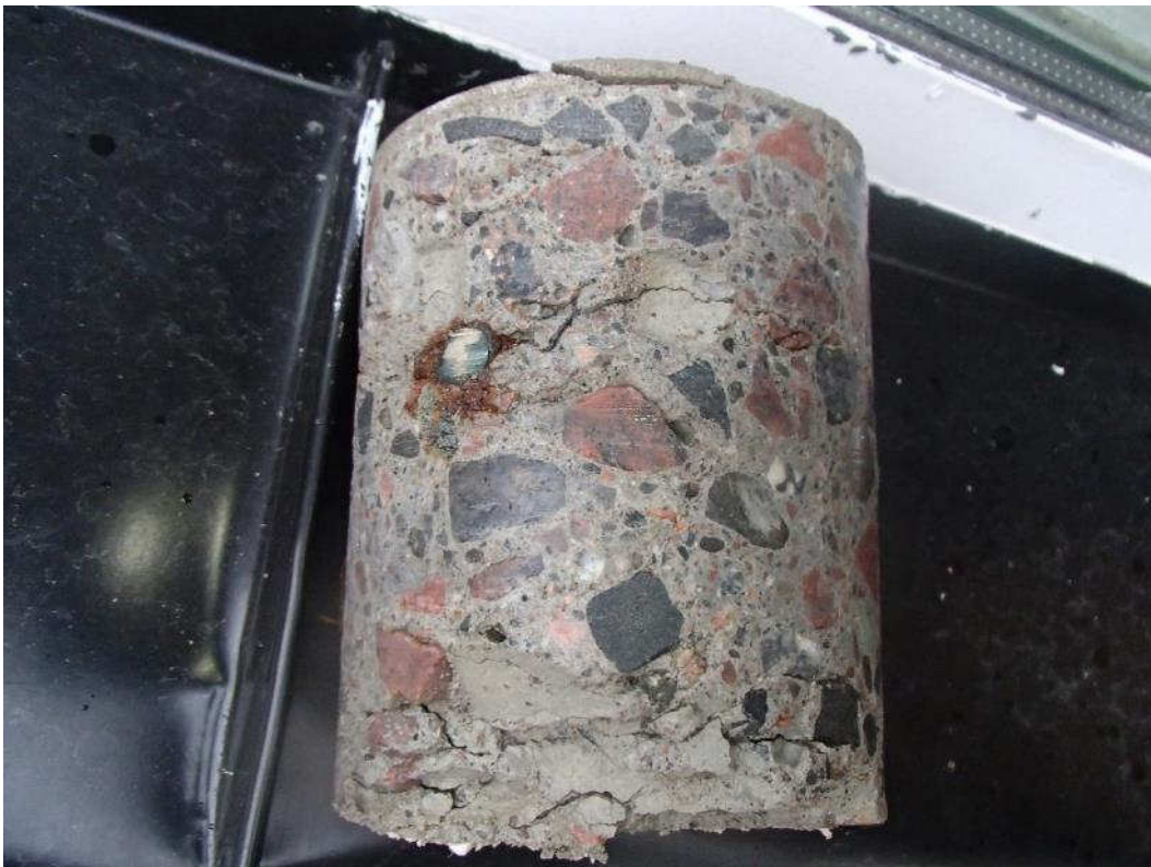
Kuva 31. Sokkelit ovat paikoin pahoin rapautuneet sekä sokkelissa on havaittavissa betoniteräskorroosiosta.
