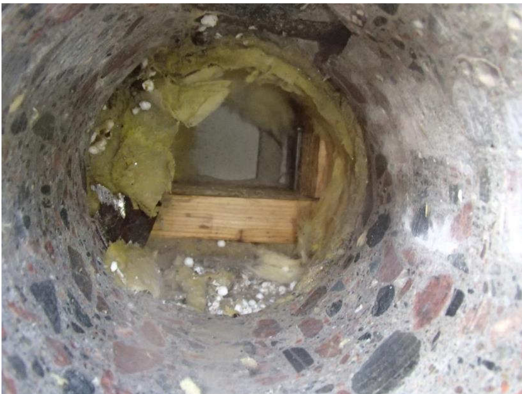
Kuva 27. Ulkoseinärakenteen sisällä kulkevat ikkunoiden apukarmien puutolpat on asennettu sokkelin päälle asetetun laudan (alajuoksun) päälle.
