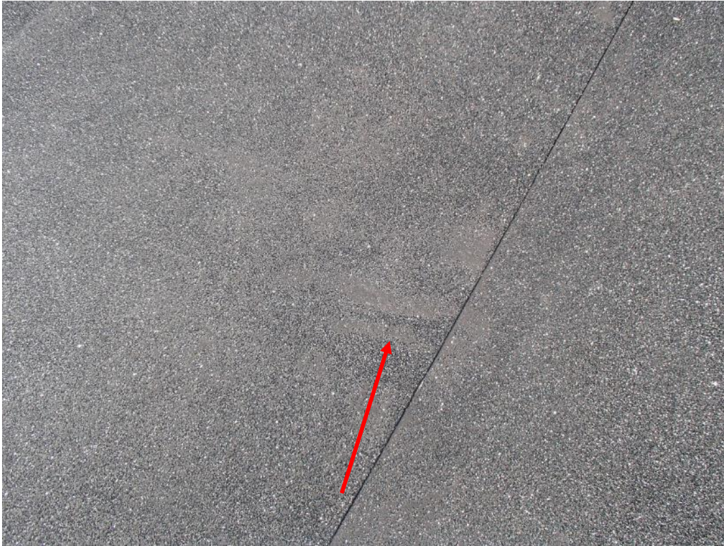
Kuva 42. Pintakatteesta irtoaa paikoin sirotetta.
