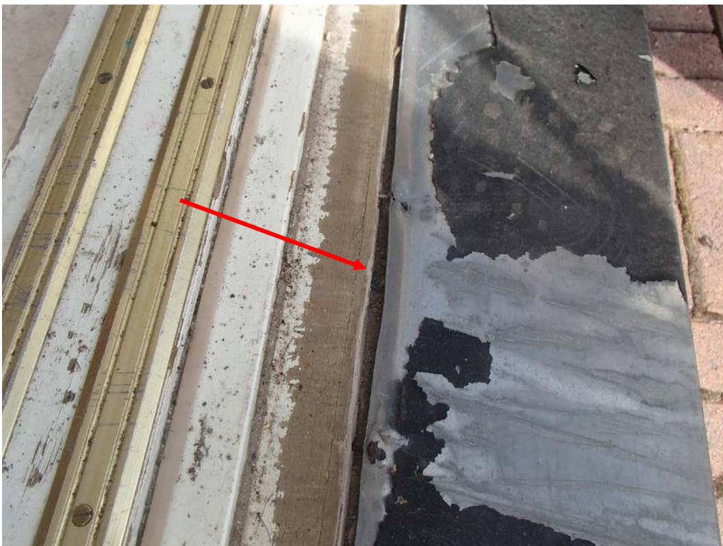
Kuva 25. Sisäpihan vesipellitykset ovat paikoin irronneet kiinnityksestään.
