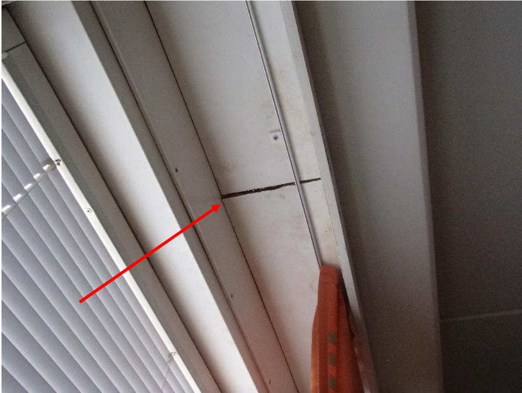
Kuva 52. Luokassa 1012 on ikkunan yläpuolen lastulevyssä kosteusvaurioita.
