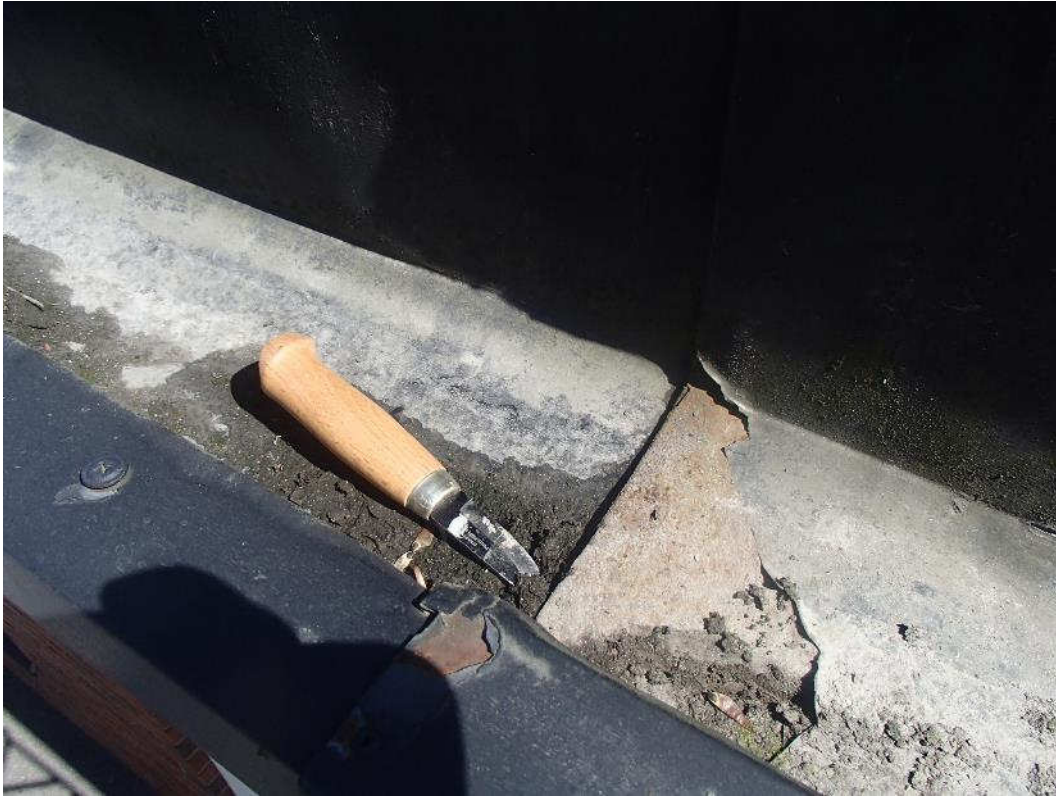
Kuva 48. Sadevesikourujen liitokset eivät ole kaikkialla tiiviitä.
