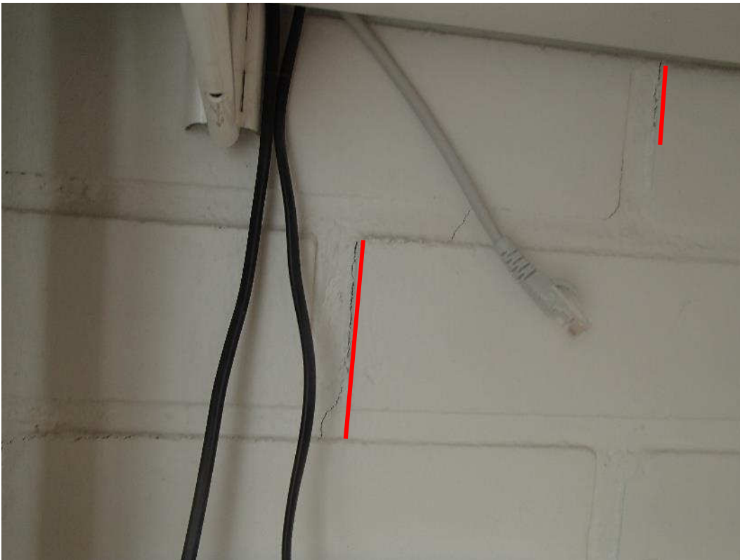
Kuva 127. Ilmavuotoja havaittiin tilimuurauksen halkeamista.
