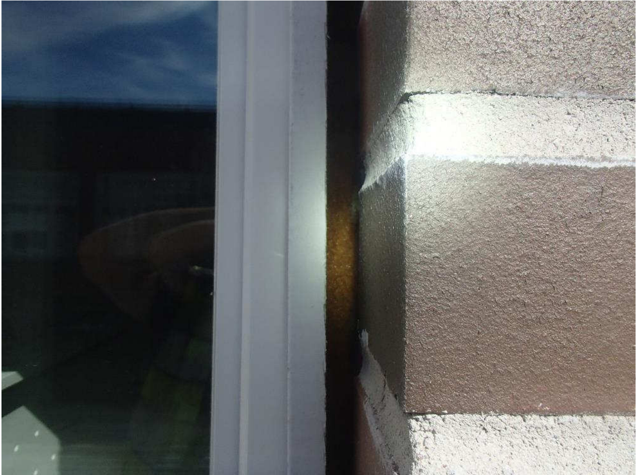
Kuva 96. Tiilimuurauksen ja pielilautojen välissä havaittiin rakoja rakenteisiin.
