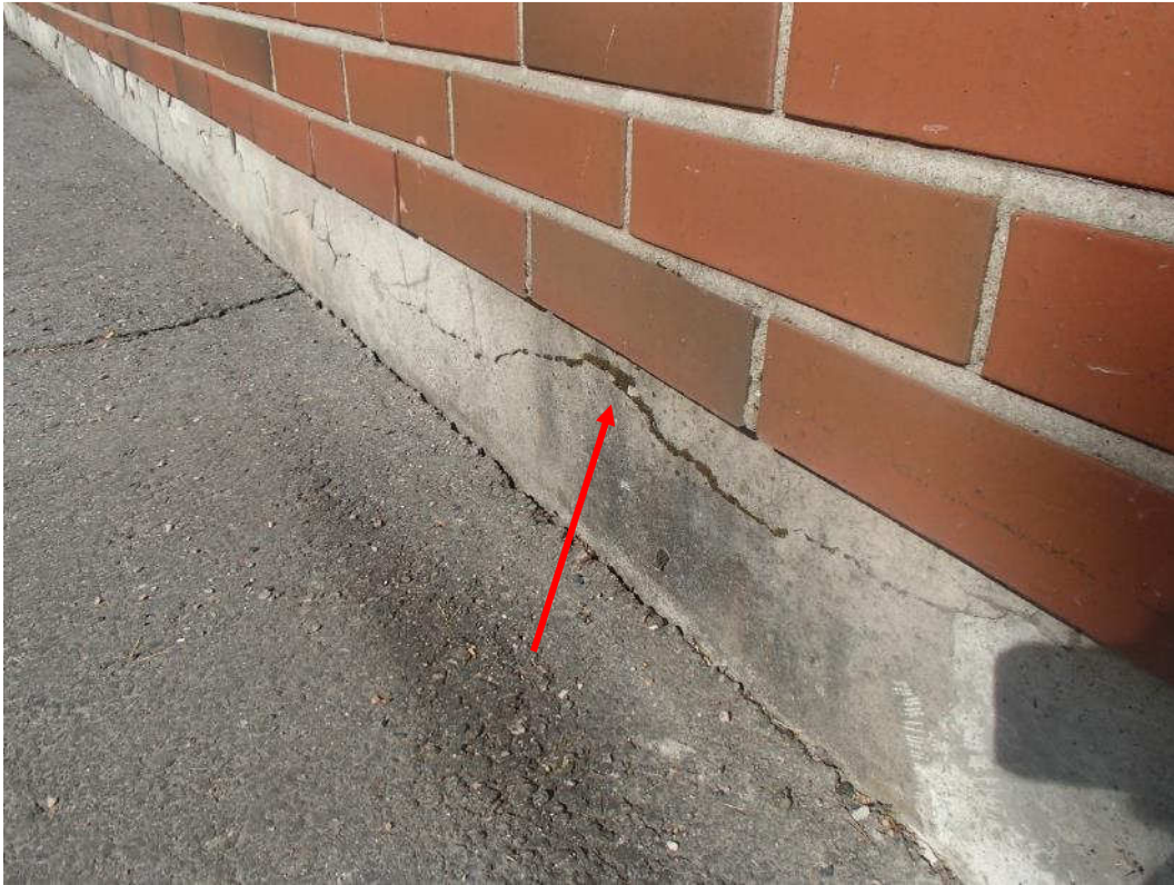
Kuva 36. Sokkelin halkeamissa kasvaa paikoin sammalta.
