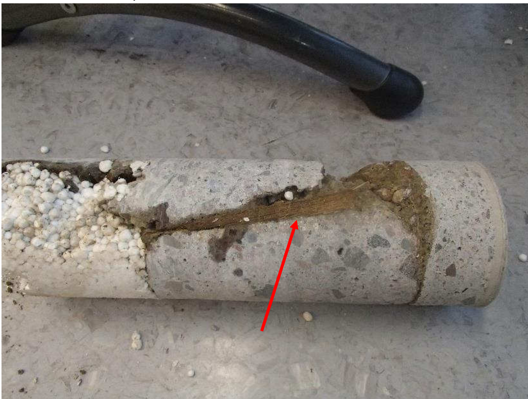
Kuva 66. Luokan 10021 alapohjan rakenneavauksen yhteydessä havaittiin kantavassa beto- nilaatassa lahonnutta puumateriaalia.
