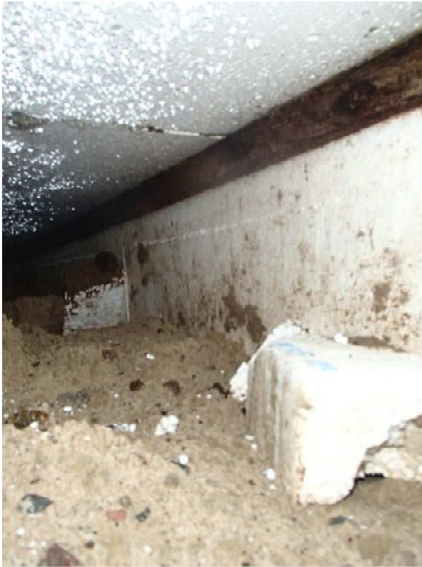
Kuva 63. Alapohjan maa-ainekset ovat painuneet sokkelin vierestä sekä EPS-eristeen alapintaan tiivistyy kosteus ja alapohjan ulkolaidassa kulkee lahonnut puurima.
