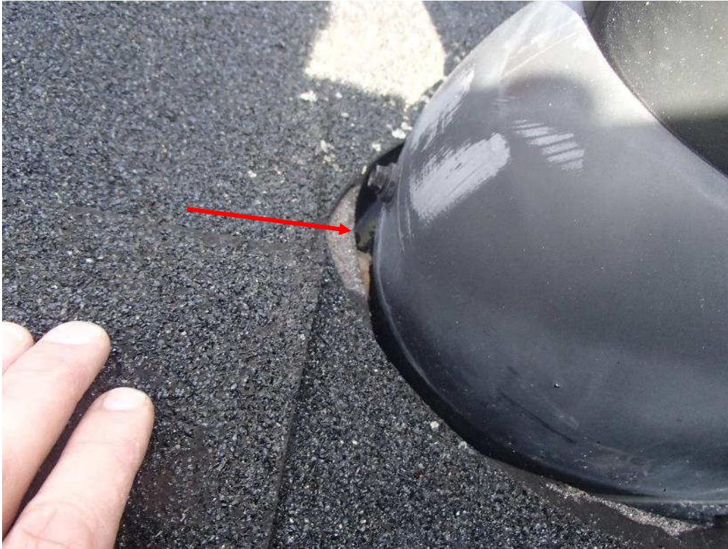
Kuva 44. Kattotuotteiden ja bitumikermin rajapinnoissa e havaittu tiivistystä.
