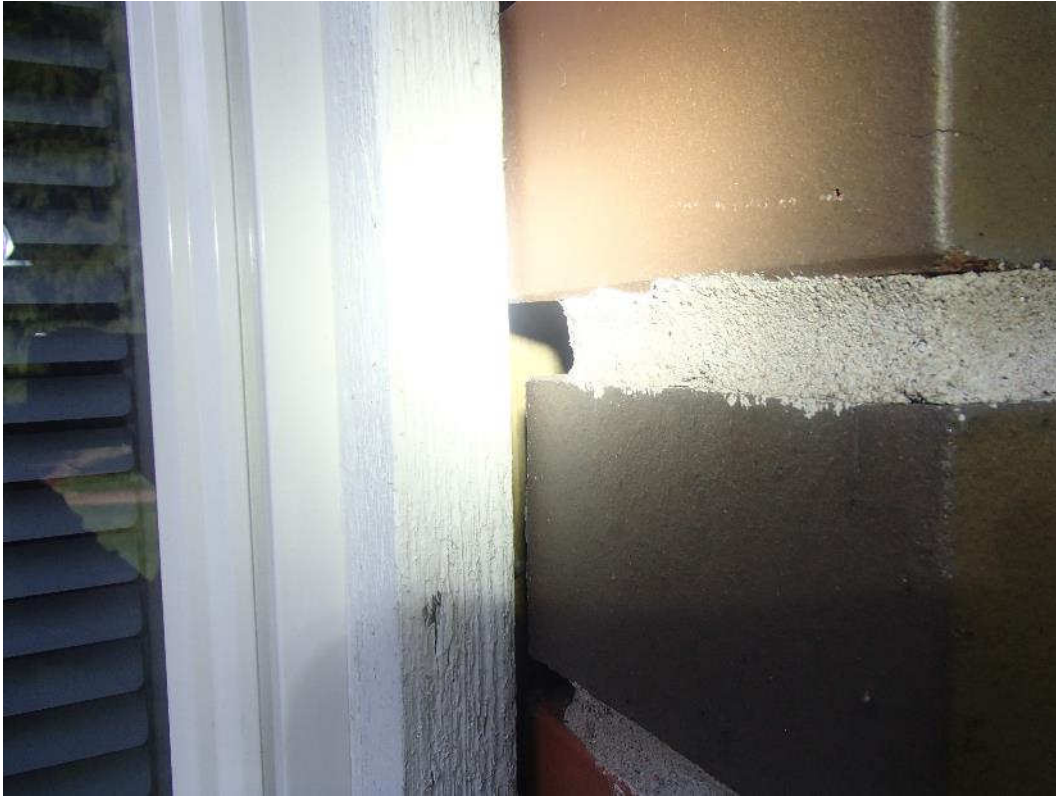
Kuva 78. Ikkunoiden pielilaudoituksien ja tiilimuurausten välissä havaittiin rakoja rakenteisiin.
