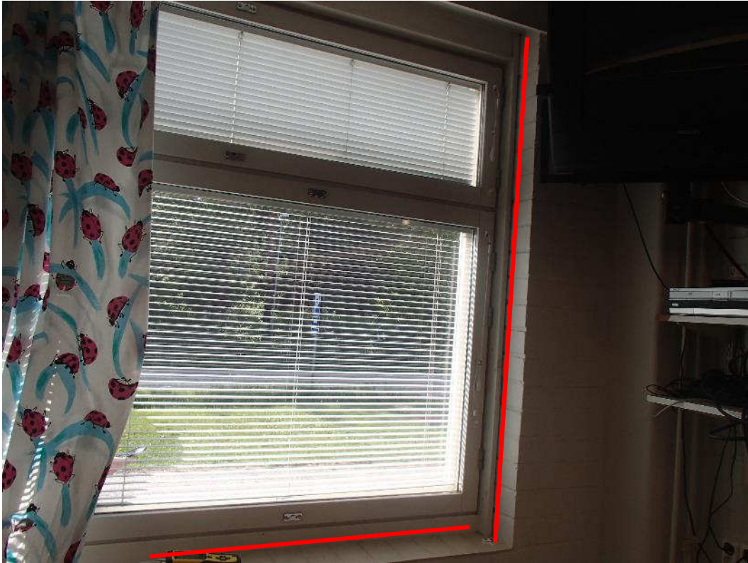
Kuva 128. Ilmavuotoja havaittiin ikkunoiden ja pieliin rajapinnoista.
