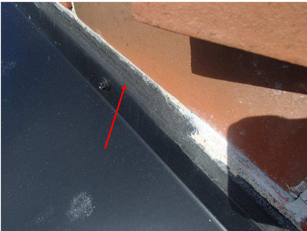
Kuva 55. Vesikaton pellityksien ylösnostojen tiivistysmassat ovat ikääntyneet.
