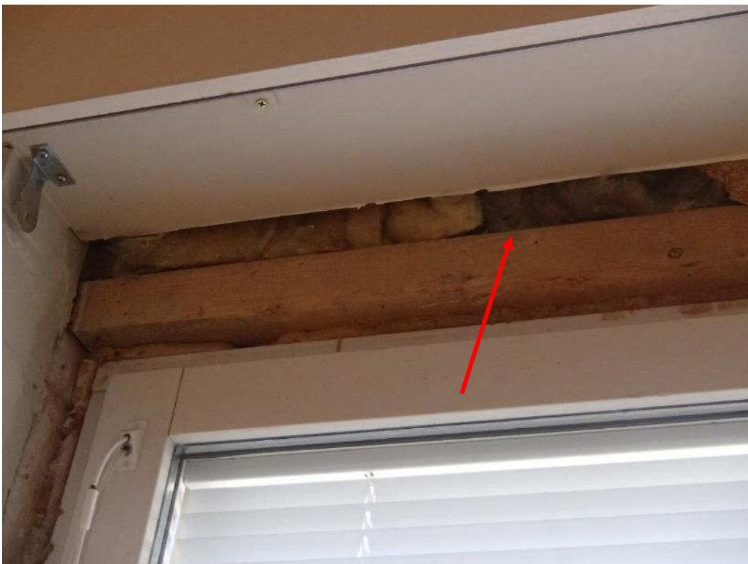
Kuva 15. Ulkoseinärakenteiden mineraalivillaeristeet ovat paikoin tummuneet.
