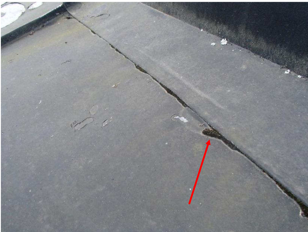
Kuva 47. Konesaumapeltikatteen hakasaumoissa kasvaa paikoin sammalta.
