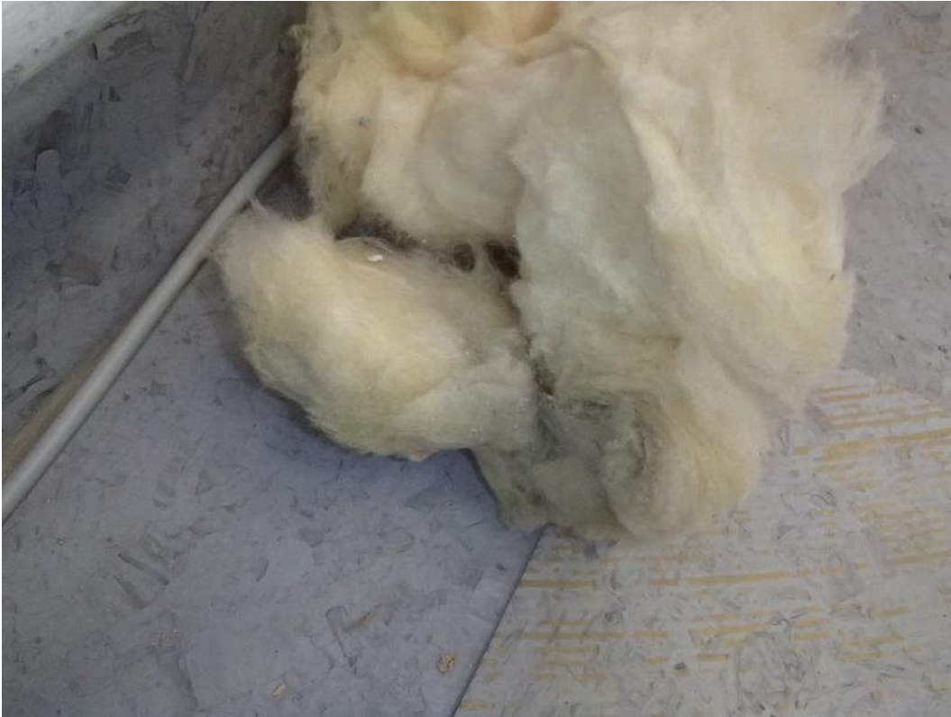
Kuva 16. Ulkoseinärakenteiden mineraalivillaeristeet ovat paikoin tummuneet.
