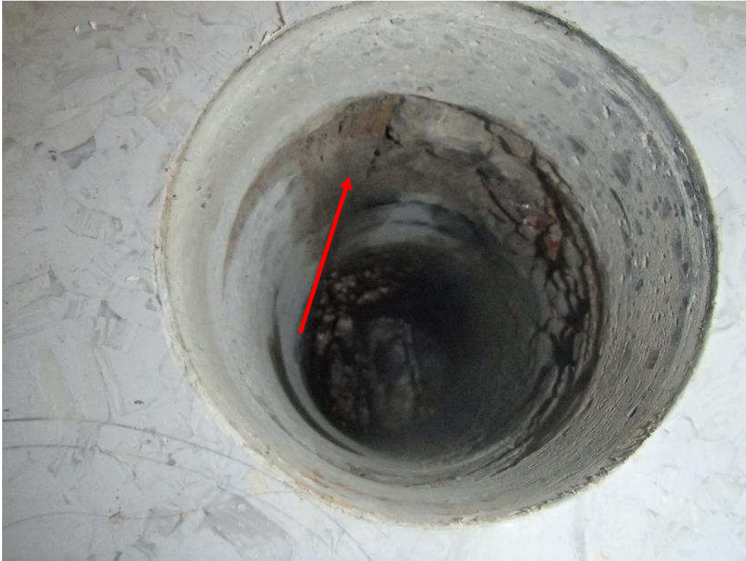
Kuva 65. Luokan 1001 alapohjan rakenneavauksen yhteydessä havaittiin kantavassa betoni- laatassa lahonnutta puumateriaalia.
