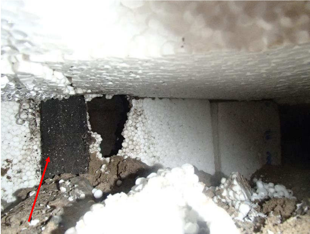
Kuva 67. Luokan 10021 alapohjan rakenneavauksen yhteydessä havaittiin kantavassa betonilaatassa lahonnutta puumateriaalia.
