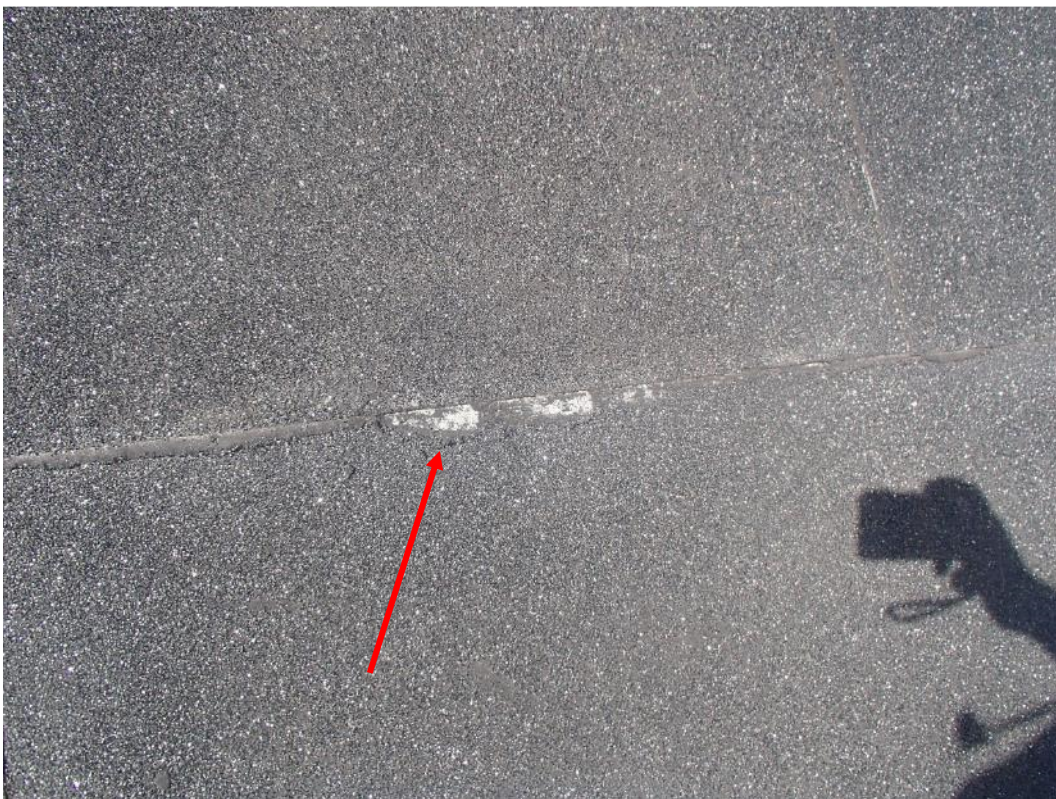
Kuva 43. Pintakatteesta irtoaa paikoin sirotetta.
