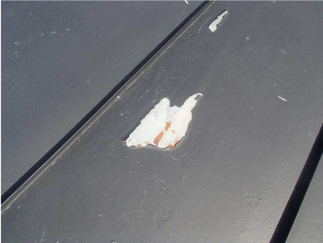
Kuva 46. Konesaumapeltikatteesta on paikoin perusmetallin korroosiota.
