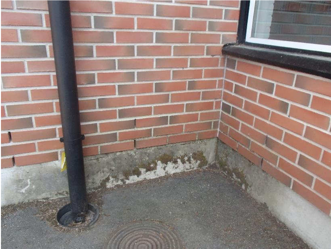
Kuva 80. Rakennuksen sokkelissa havaittiin kosteusrasitukseen viittaavia huomioita.
