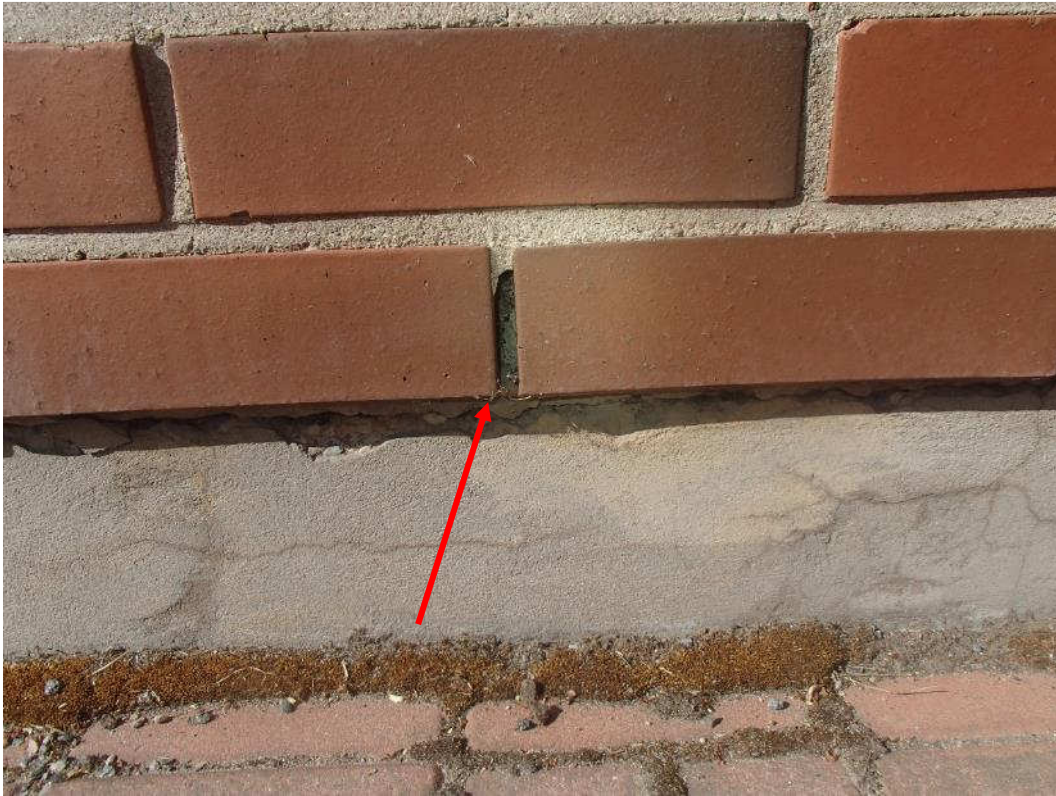
Kuva 12. Paikoin alimman tiilimuurausrivin tuuletusraot on tukossa.
