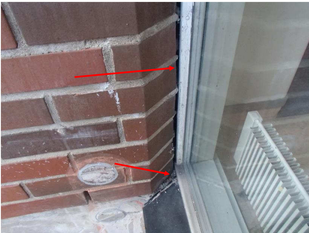
Kuva 21. Sisäpihan tiilimurausten, vesipeltien ja ikkunoiden rajapinnoissa on rakoja rakenteisiin.
