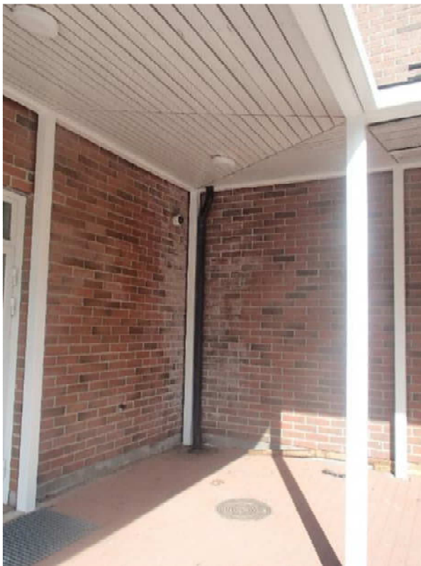
Kuva 35. Rakennuksen kulmassa on tiilimuurauksessa havaittavissa kosteusrasitukseen viittaavaa kalkkihärmemuodostumaa.
