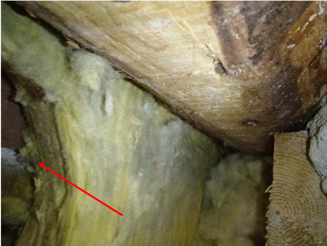
Kuva 9. Eristetilassa on ikkunoiden runkona puumateriaalia sekä tuulensuojalevyn ja julkisivutiilimuurauksen välissä ei ole paikoin työ-/tuuletusrakoa.
