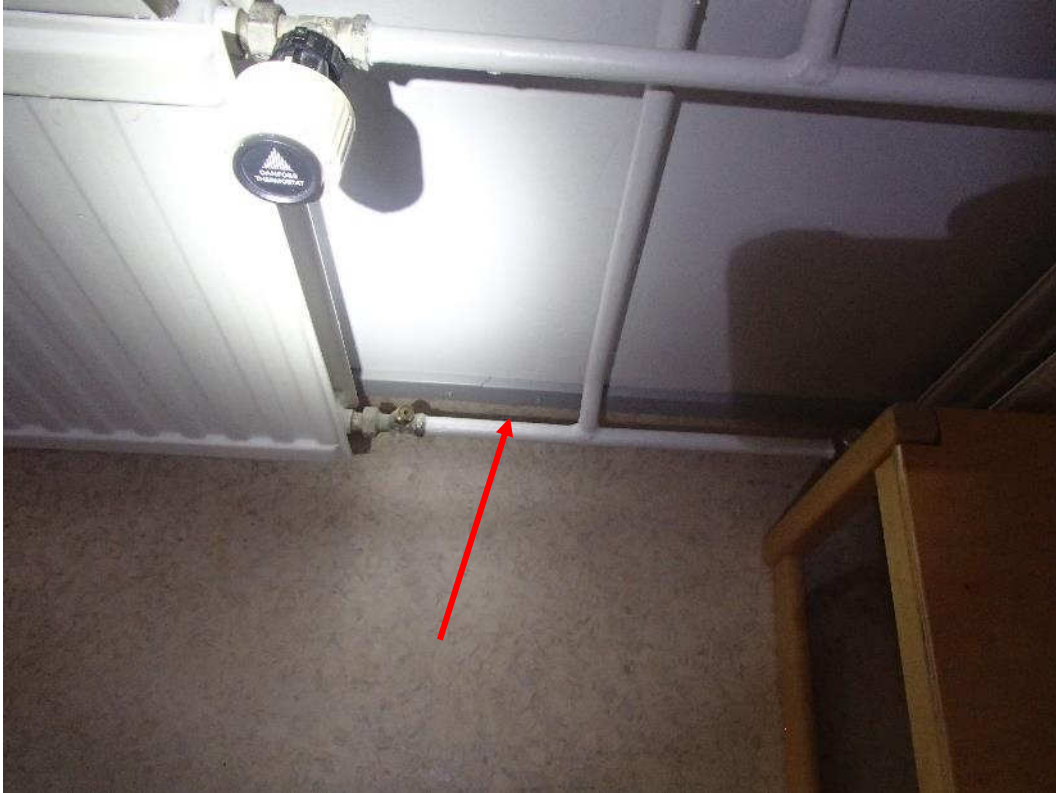
Kuva 60. Lattiamatot on osassa luokkahuoneessa nostettu seinille.
