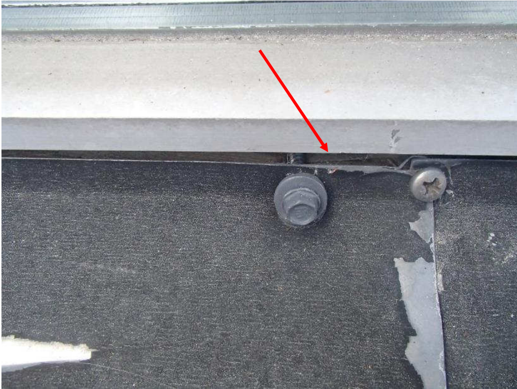
Kuva 24. Sisäpihan vesipellitykset ovat paikoin irronneet kiinnityksestään.
