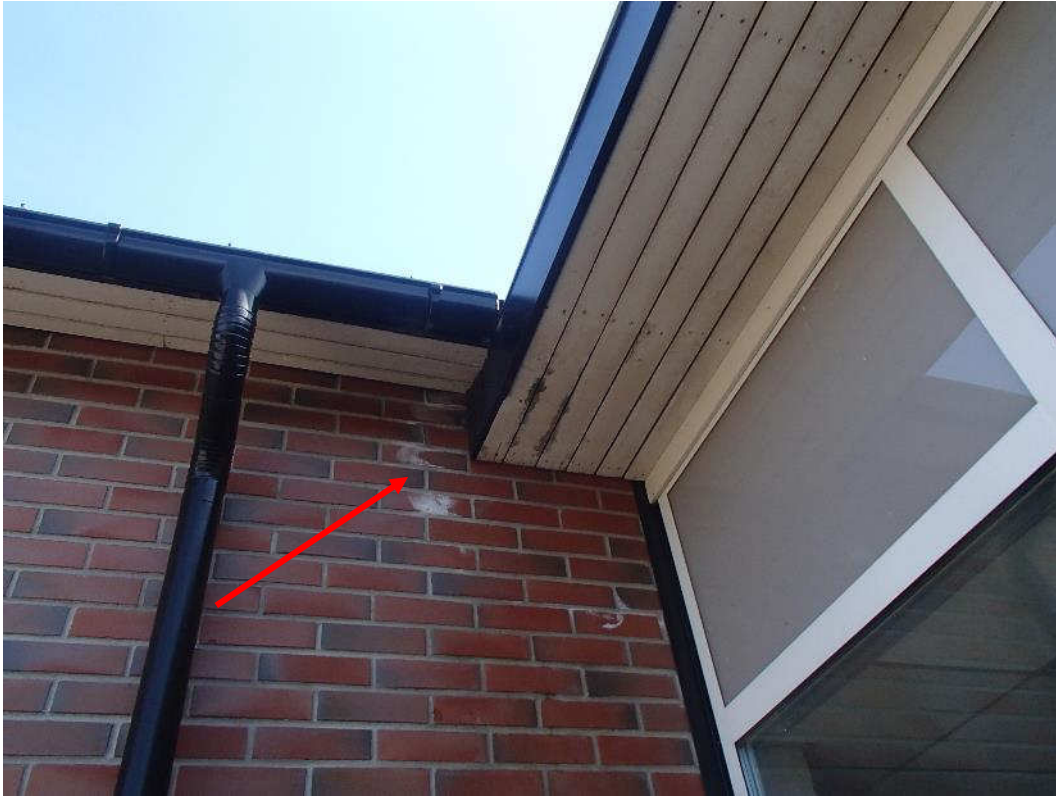
Kuva 86. Julkisivun tiilimuurauksen pinnalla havaittiin sadevesikourujen vuotamista.
