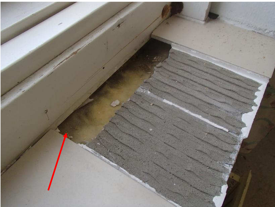
Kuva 17. Tilketilan mineraalivilla eristeet ovat paikoin tummuneet.
