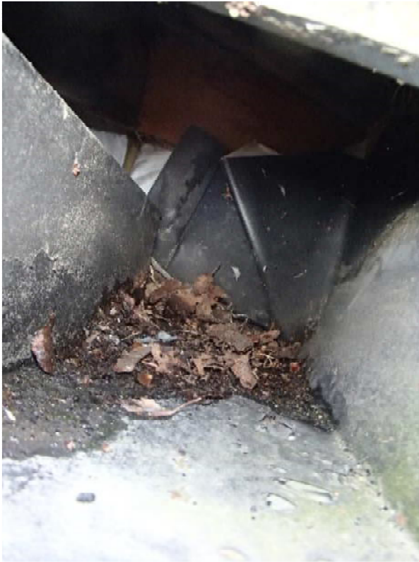
Kuva 50. Paikoin sadevesikourujen päät ovat epätiivittä.
