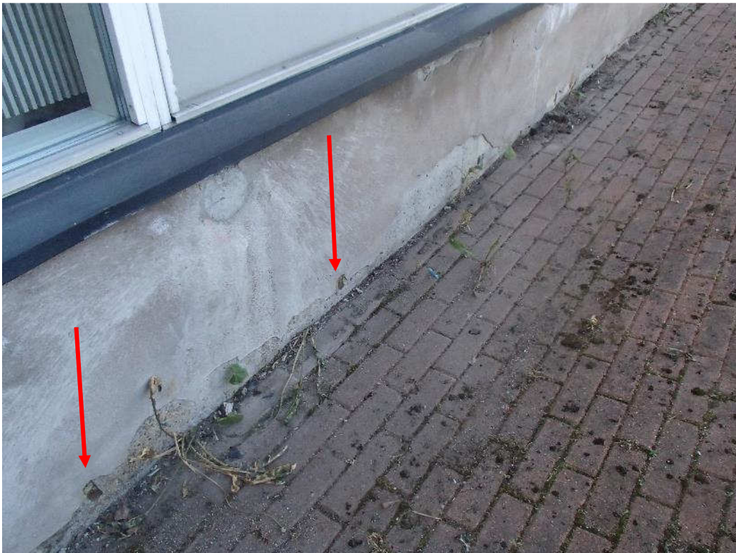
Kuva 37. Sisäpihan sokkelissa havaittiin rakennusaikaisia muottilaudoituksen tappeja.
