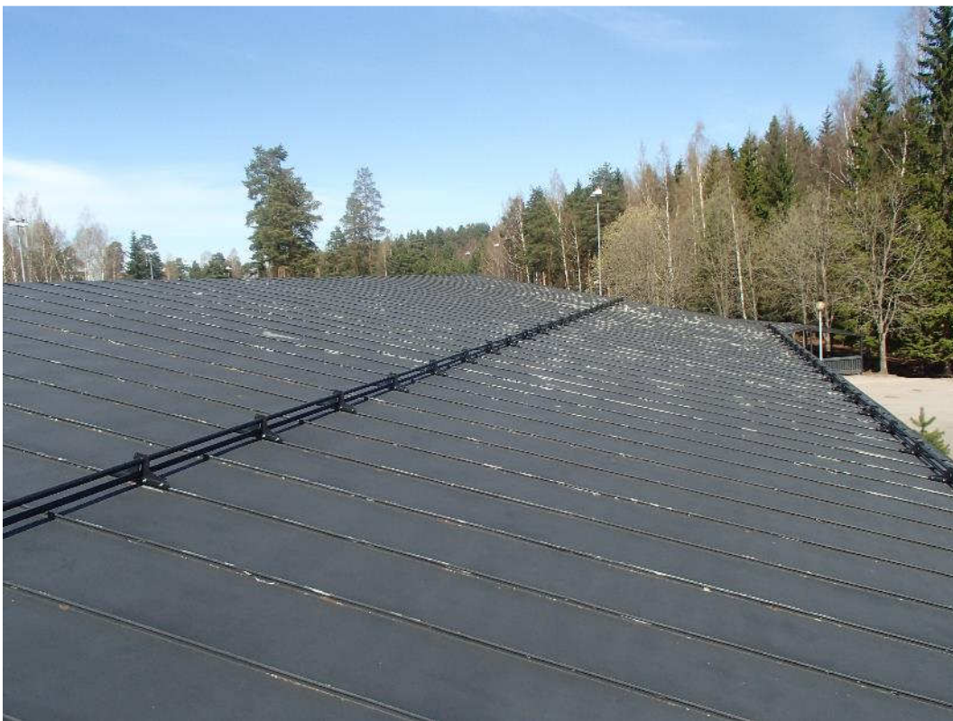
Kuva 45. Konesaumapeltikatteesta irtoilee pinnoitetta.
