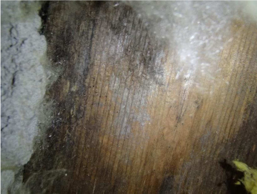
Kuva 28. Paikoin ulkoseinärakenteiden sisällä olevassa puumateriaalissa havaittiin mikrobi- kasvustoa.
