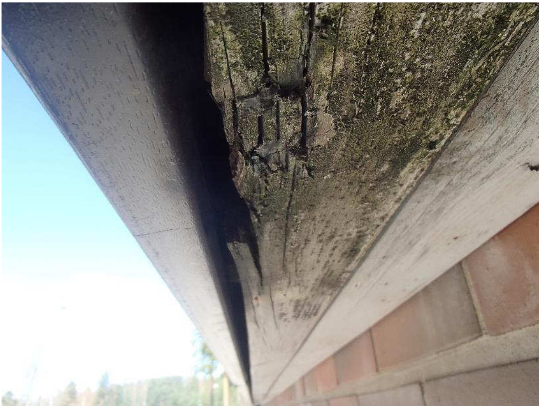
Kuva 49. Sadevesikourujen liitoksien kautta vuotanut vesi on lahottanut räystääsaluslautoja.
