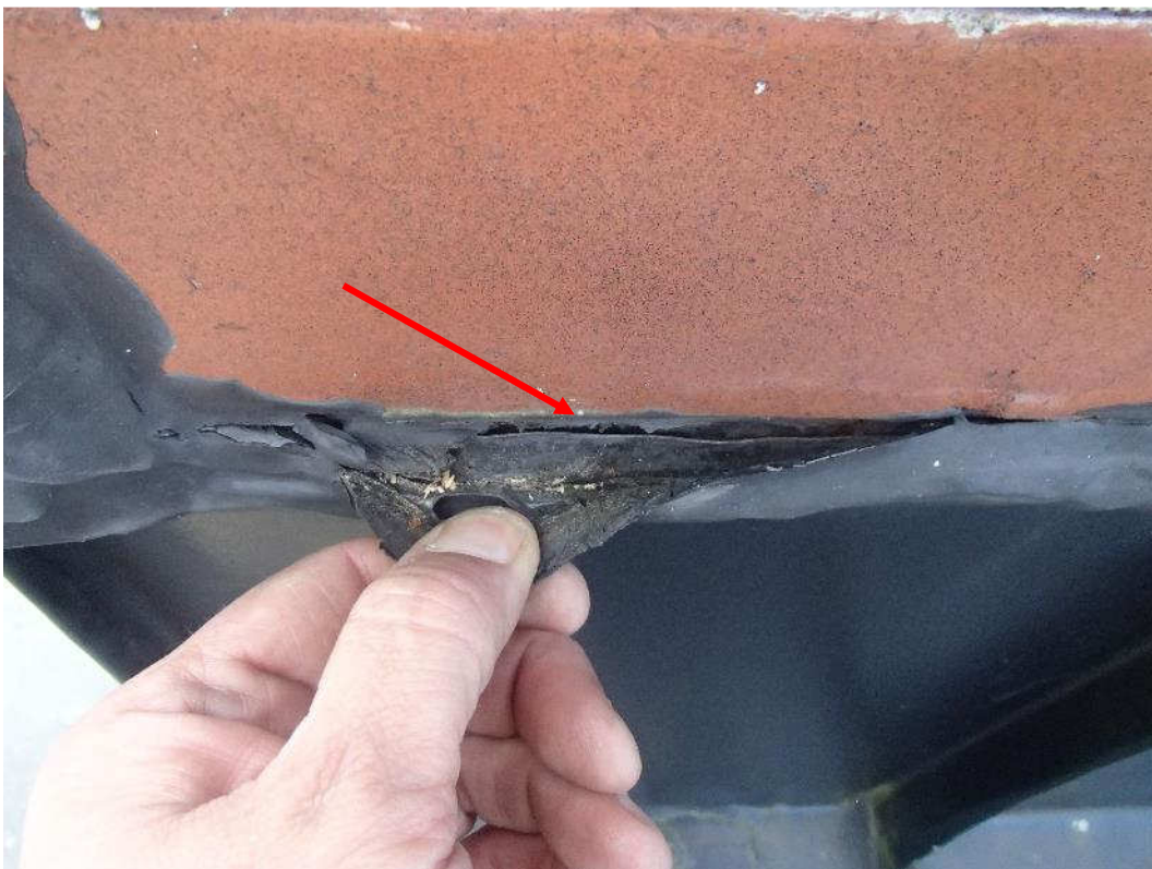
Kuva 53. Vesikaton pellityksien ylösnostojen tiivistysmassat ovat irronneet kiinnityksestään.
