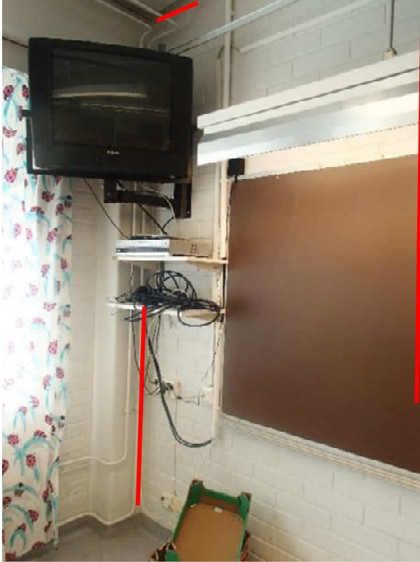
Kuva 126. Ilmavuotoja havaittiin rakenneosien liitoksissa.
