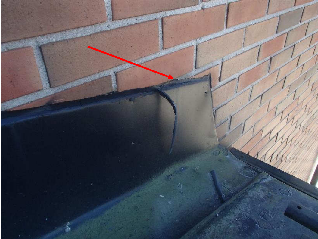
Kuva 54. Vesikaton pellityksien ylösnostojen tiivistysmassat ovat irronneet kiinnityksestään.
