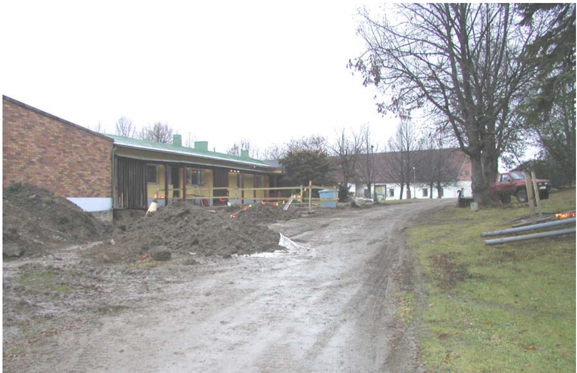
Kuva 9 Lämpökeskuksen kulmalta navetalle, öljyvahingon puhdistustyöt käynnissä
