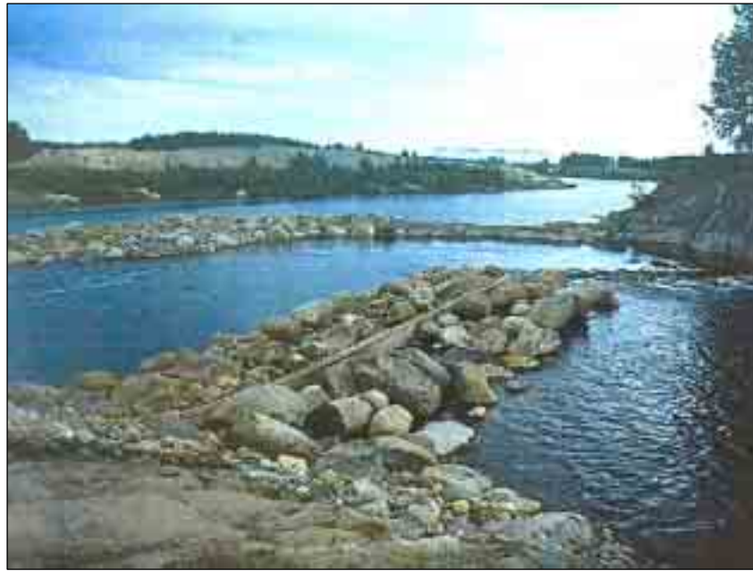
Kuva 52 Malkakosken luonnonmukaisen pohjapadon patorakenteita. Kuvälähde: Jormola – Harjula - Sarvilinna / Luonnonmukainen vesirakentaminen – Uusia näkökulmia vesistösuunnitteluun
